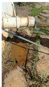
Foto 1 - Vazamento na tubulação
