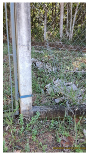
Foto 1 - Alamedado danificado no cercamento
