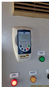
Foto 7 - Detalhe para visor do painel de comando
