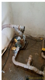
Foto 3 - Destaque para a bomba da elevatória
