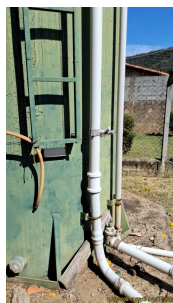
Foto 5 - Tubulação de entrada, saída e extravasor do reservatório
