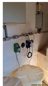
Foto 4 - Dosadores de cloro e flúor feita no reservatório
