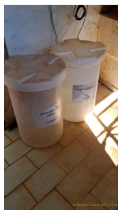
Foto 5 - Armazenamento do cloro e flúor
