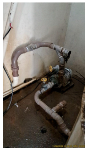
Foto 5 - Destaque para a bomba da elevatória
