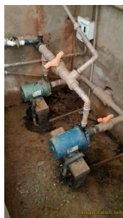
Foto 1 - Sistema de bombeamento da elevatória
