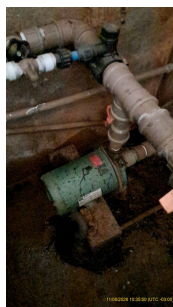
Foto 3 - Destaque para bomba
