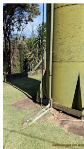
Foto 3 - Base do reservatório
