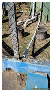
Foto 6 - Saída do tubo extravasor
