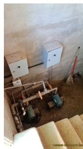
Foto 4 - Vista geral da elevatória
