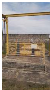
Foto 8 - Poços e talha para içamento.
