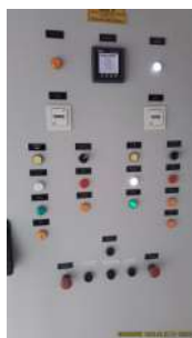
Foto 7 - Painel de comando.
