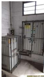
Foto 5 - Painéis da elevatória.
