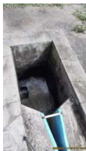
Foto 7 - Saída do tratamento preliminar após a calha parshall
