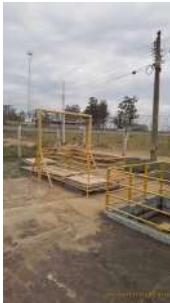
Foto 4 - Poços e talha para içamento.
