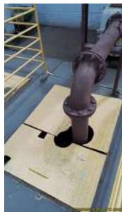
Foto 9 - Poço de sucção.
