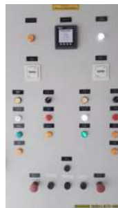
Foto 10 - Painel de comando.
