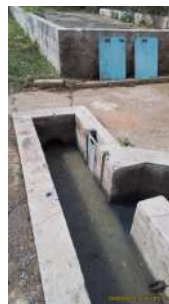
Foto 4 - Entrada do efluente.
