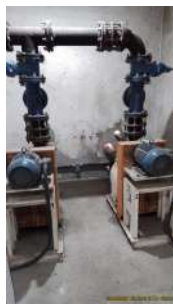
Foto 7 - Bombas da elevatória.
