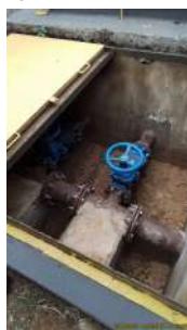
Foto 5 - Barrilete das bombas
