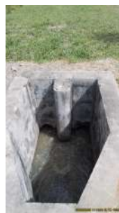
Foto 9 - Saída do tratamento preliminar em direção às lagoas.
