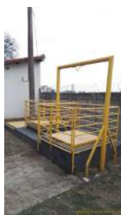
Foto 3 - Poços e talha para içamento.
