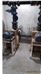
Foto 4 - Bombas da elevatória.
