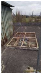
Foto 3 - Barrilete das bombas
