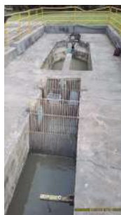
Foto 7 - Gradeamento na entrada do efluente.
