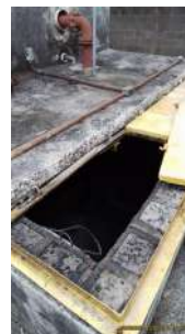
Foto 8 - Poço de sucção
