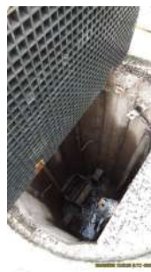
Foto 4 - Poço com cesto peneira.
