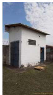
Foto 12 - Abrigo do gerador e dos painéis.
