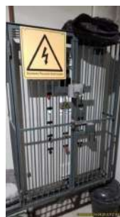
Foto 8 - Paine de comando.
