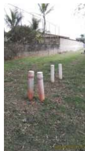
Foto 10 - Tubulação para inspeção da vala de filtração.
