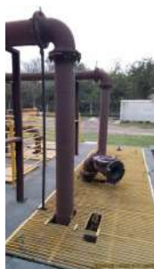
Foto 11 - Recalque das bombas.
