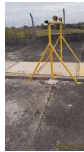
Foto 4 - Poço do cesto peneira e talha para içamento.
