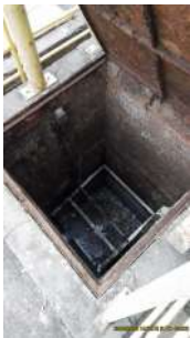
Foto 4 - Cesto peneira no poço de entrada do efluente.
