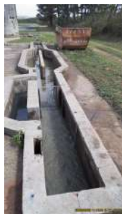
Foto 3 - Entrada do efluente com gradeamento, caixa de areia e calha parshall.
