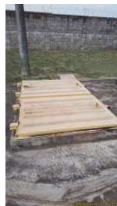
Foto 10 - Poço das bombas
