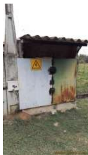
Foto 7 - Painel de comando.
