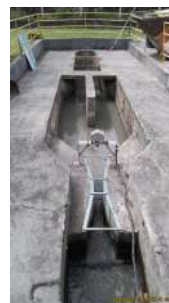
Foto 6 - Calha parshall e medidor de vazão na entrada.
