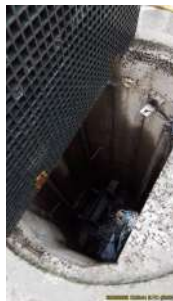
Foto 5 - Poço com cesto peneira.
