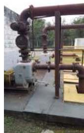
Foto 10 - Bombas da elevatória.
