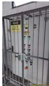
Foto 6 - Paine de comando.
