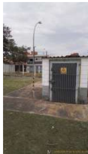
Foto 11 - Abrigo do gerador e dos painéis.
