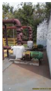
Foto 8 - Bombas da elevatória.
