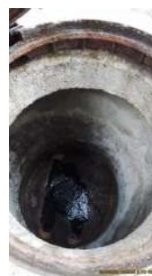
Foto 8 - Saída do UASB para a vala de filtração
