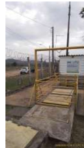
Foto 10 - Poços e talha para içamento.
