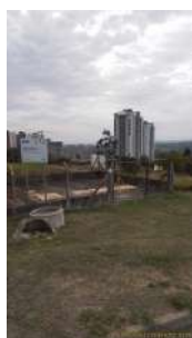
Foto 1 - Visão geral da elevatória.
