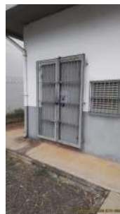
Foto 12 - Abrigo do gerador
