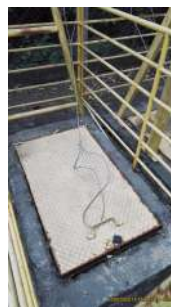
Foto 6 - Poço de sucção com duas bombas.
