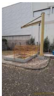
Foto 3 - Poços e talha para içamento.
