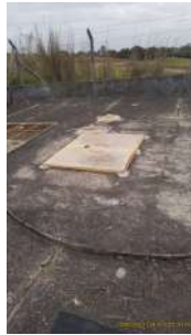
Foto 5 - Poço de sucção com duas bombas.
