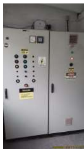
Foto 5 - Painel de comando,
