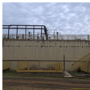
Foto 15 - Vista lateral do tratamento físico-químico
