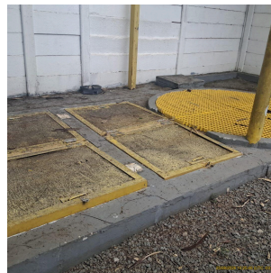
Foto 3 - Vista do interior da estação elevatória de esgoto José Cortez
