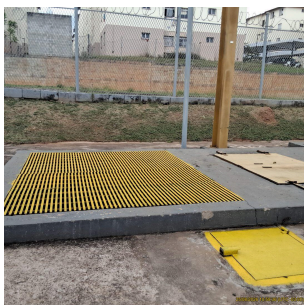
Foto 5 - Poço de sucção
