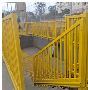
Foto 4 - Vista do interior da estação elevatória de esgoto Rubi
