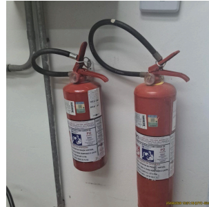
Foto 7 - Extintores de incêndio
