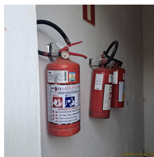
Foto 5 - Extintores de incêndio
