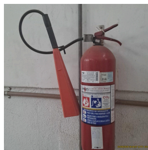
Foto 13 - Extintor de incêndio
