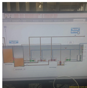
Foto 10 - Vista da tela do centro de controle operacional indicando a vazão de entrada
