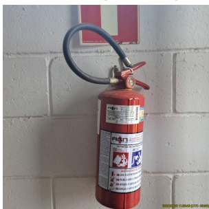
Foto 7 - Extintor de incêndio
