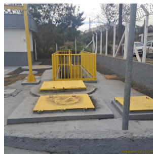
Foto 9 - Vista do interior da estação elevatória de esgoto Interlagos
