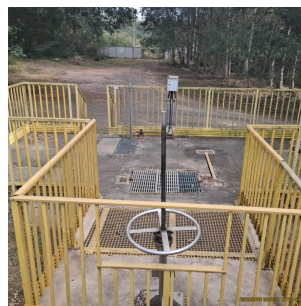
Foto 2 - Entrada do esgoto bruto
