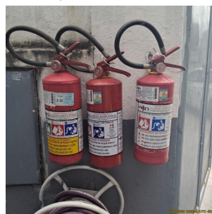
Foto 5 - Extintores de incêndio
