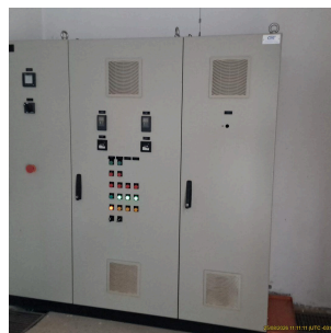
Foto 7 - Pannel de comando e controle
