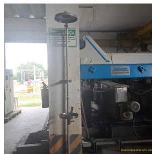
Foto 9 - Chuveiro de emergência
