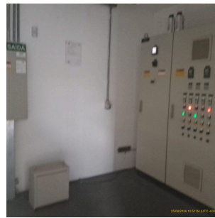
Foto 6 - Painel de comando e controle
