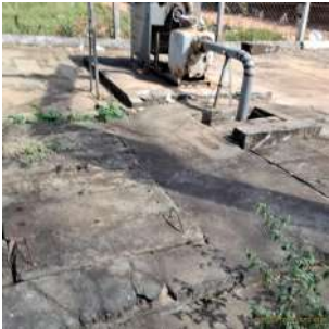
Foto 1 - Vista geral do conjunto motobomba para recalque de esgoto
