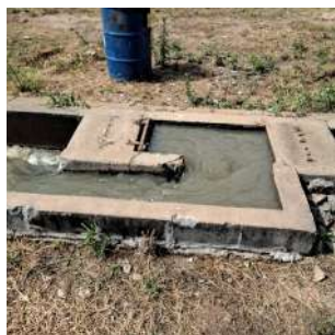
Foto 1 - Passagem de esgoto bruto.
