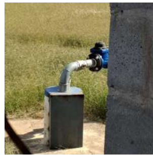
Foto 4 - Tubo medição de nível e macromedidor.
