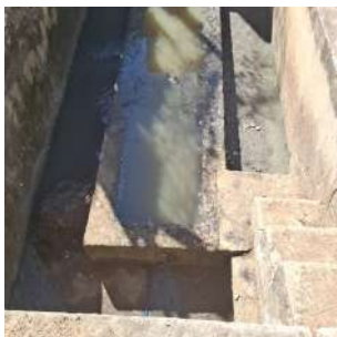
Foto 1 - Devido ao acúmulo de sujeira no gradeamento, o esgoto não escoa adequadamente para a estação elevatória, havendo risco de extravasamento.
