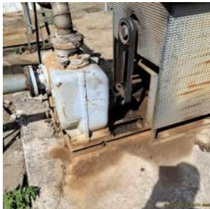
Foto 6 - Conjunto motobomba (em operação).
