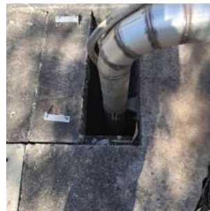
Foto 4 - Poço de sucção.
