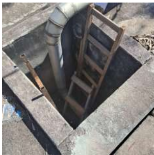
Foto 5 - Tubulação de recalque.
