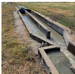
Foto 3 - Caixas de areia do sistema de tratamento preliminar de esgoto.
