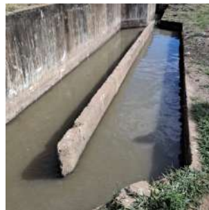
Foto 2 - Caixas de areia do sistema de tratamento preliminar de esgoto.
