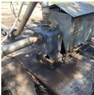
Foto 3 - Conjunto moto bomba em operação.
