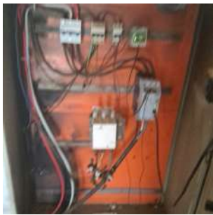
Foto 3 - Painel elétrico para acionamento do conjunto motobomba.
