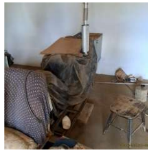
Foto 5 - Gerador (sem funcionamento).
