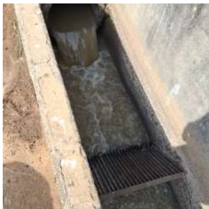
Foto 1 - Ponto de entrada do esgoto bruto e gradeamento.
