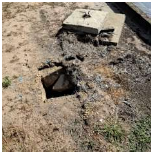
Foto 1 - Abertura sem tampa.
