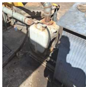
Foto 2 - Conjunto moto bomba (em operação).
