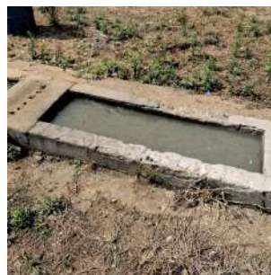
Foto 2 - Ponto de entrada do esgoto bruto.
