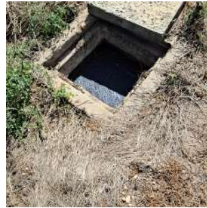
Foto 4 - Abertura sem tampa.
