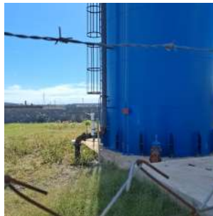
Foto 2 - Ponto de adição de produto químico.
