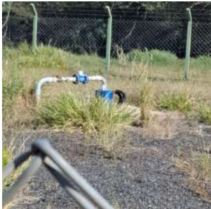
Foto 2 - Macromedidor, tubo de nível e laje de proteção.
