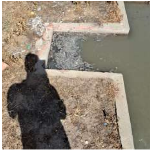
Foto 3 - Acúmulo de resíduos sólidos após a passagem pelo gradeamento grosseiro.
