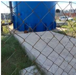
Foto 3 - Base do reservatório, com destaque para a tubulação de saída de água para a rede de distribuição e medidor de nível.
