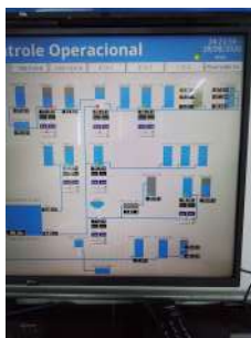
Foto 1 - Visualização dos níveis de reservatórios operados pelo DAAE através de telemetria. Dentre eles, o reservatório Panorama, nome alternativo ao reservatório Paineiras.
