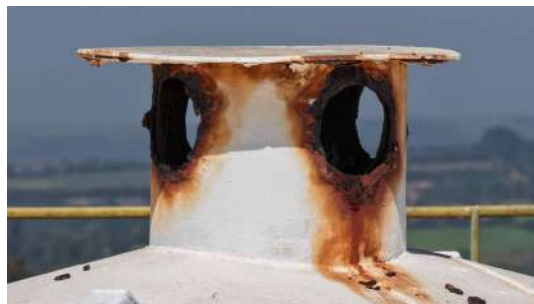
Foto 2 - Chaminé de ventilação sem tela de proteção.
