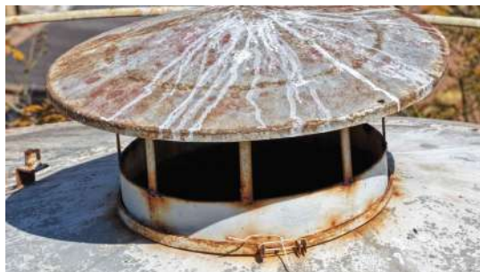
Foto 1 - Chaminé de ventilação sem tela de proteção.
