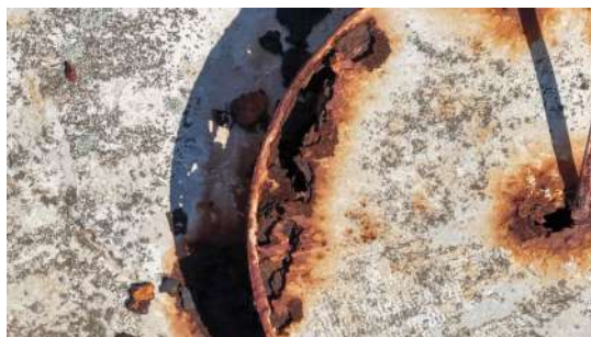
Foto 3 - Corrosão e abertura na tampa de inspeção.
