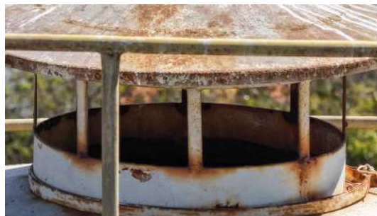
Foto 2 - Chaminé de ventilação sem tela de proteção.
