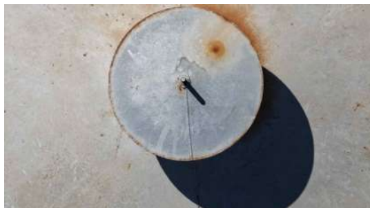
Foto 9 - Chapéu de ventilação.
