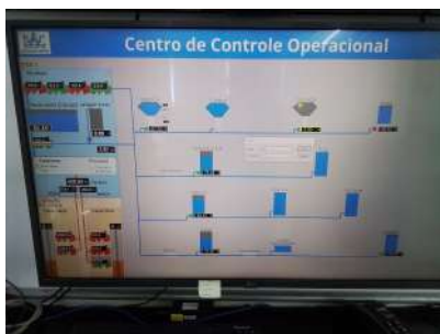
Foto 1 - Visualização do nível de reservatórios por telemetria, dentre eles o Centro Sul.
