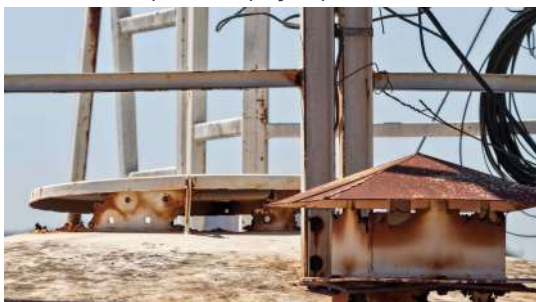
Foto 5 - Corrosão e aberturas na chaminé de ventilação e na tampa de inspeção.
