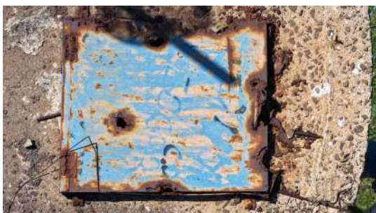
Foto 1 - Tampa de inspeção corroída e com aberturas,
