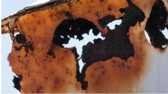
Foto 3 - Corrosão avançada na chaminé de ventilação.
