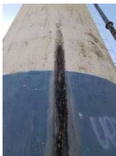
Foto 1 - Vazamentos no reservatório.
