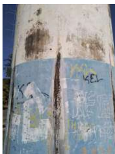
Foto 5 - Vazamentos no reservatório.
