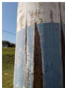
Foto 2 - Vazamentos no reservatório.
