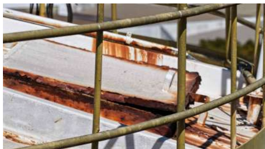
Foto 3 - Tampa de inspeção com corrosão e parcialmente aberta.
