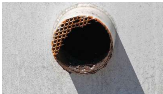
Foto 2 - Abertura do reservatório sem tela de proteção.
