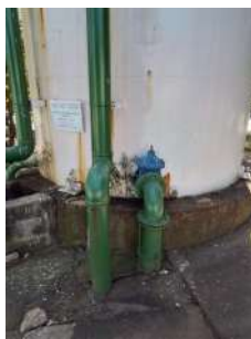
Foto 7 - Alimentação e saída do reservatório
