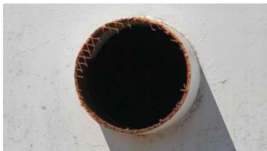
Foto 1 - Abertura do reservatório sem tela de proteção.
