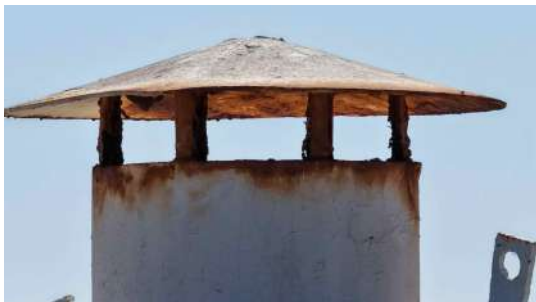
Foto 1 - Chaminé de ventilação sem tela de proteção.
