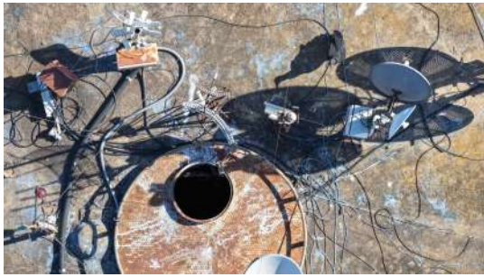
Foto 3 - Ausência de tampa de inspeção.
