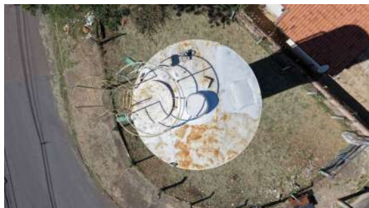
Foto 9 - Cobertura do reservatório. Visualiza-se, à direita, reparo realizado onde havia uma abertura, verificado em inspeções anteriores.
