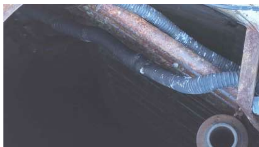
Foto 2 - Interior o reservatório exposto devido à ausência de tampa.
