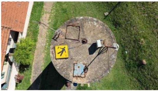
Foto 1 - Ausência de guarda-corpo na cobertura ou dispositivo para segurança.
