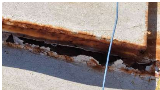
Foto 3 - Abertura aparente na tampa de inspeção, além de muita corrosão.
