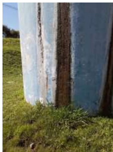
Foto 3 - Vazamentos no reservatório.
