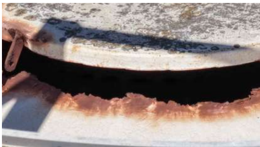
Foto 3 - Tampa de inspeção parcialmente aberta.
