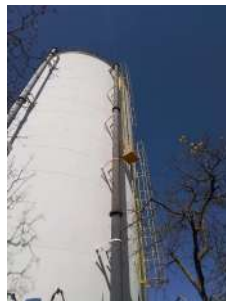
Foto 3 - Escada e extravasor
