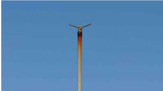
Foto 12 - Haste do SPDA na cobertura.
