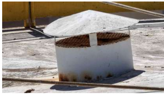
Foto 10 - Chaminé de ventilação.
