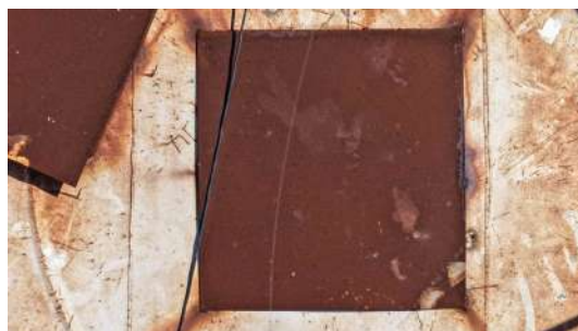
Foto 2 - Tampa de inspeção corroída.
