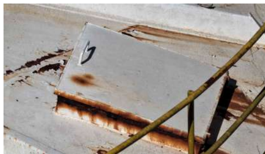
Foto 2 - Recomenda-se avaliar o avanço da corrosão próximo à tampa de inspeção e realizar tratamento.
