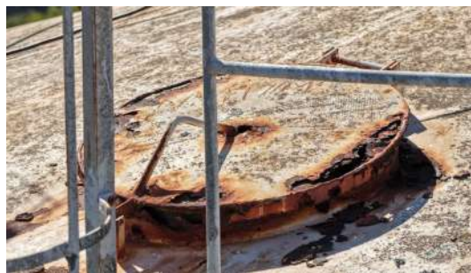
Foto 4 - Corrosão e abertura na tampa de inspeção.
