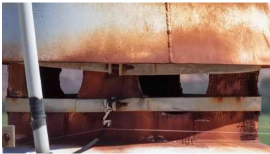
Foto 1 - Chaminé de ventilação sem tela de proteção.
