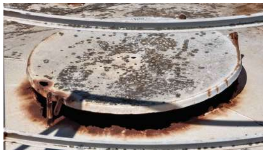
Foto 4 - Tampa de inspeção parcialmente aberta.
