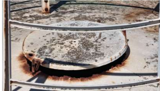
Foto 2 - Tampa de inspeção parcialmente aberta.
