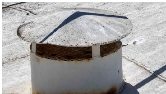
Foto 14 - Chaminé de ventilação.
