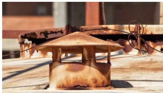
Foto 2 - Chaminé de ventilação sem tela de proteção.
