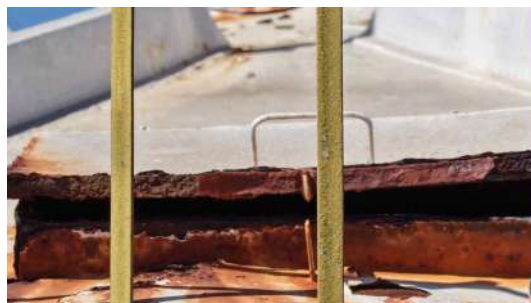
Foto 4 - Tampa de inspeção com corrosão e parcialmente aberta.
