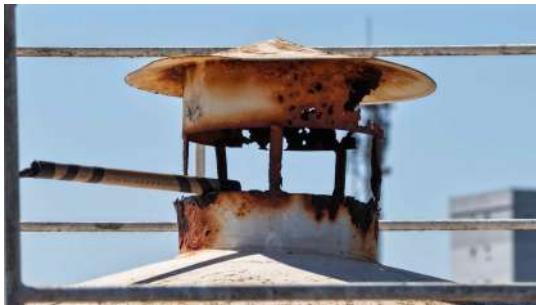
Foto 1 - Chaminé de ventilação com muita corrosão.
