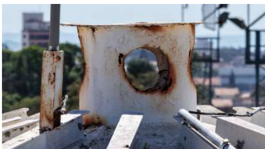
Foto 1 - Chaminé de ventilação sem tela de proteção.
