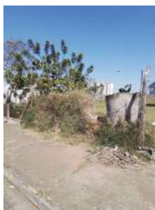
Foto 1 - Cerca danificada e aberta
