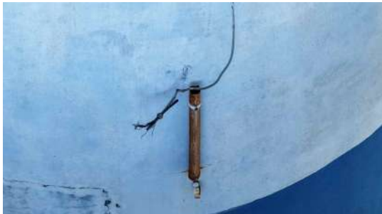
Foto 3 - Cabo de aterramento seccionado.
