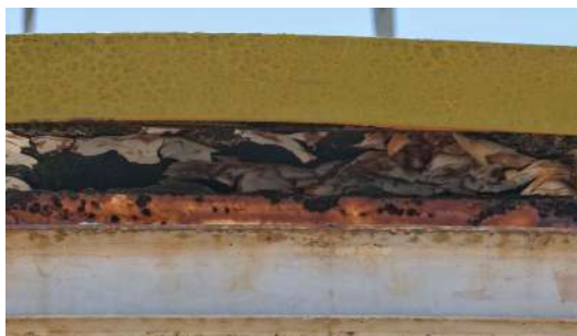
Foto 2 - Abertura aparente e corrosão na tampa de inspeção.
