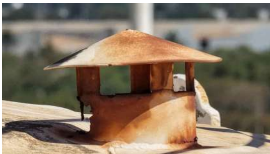
Foto 1 - Chaminé de ventilação sem tela de proteção.
