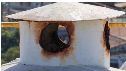
Foto 1 - Chaminé de ventilação sem tela de proteção.
