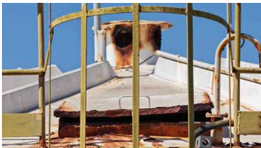
Foto 1 - Chaminé de ventilação sem tela de proteção.
