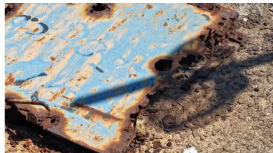
Foto 3 - Corrosão na tampa de inspeção.
