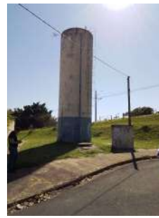
Foto 2 - Visão geral do reservatório. Não há cercamento.
