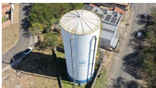
Foto 4 - Visualiza-se tubulações de alimentação e extravasor.
