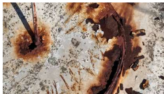
Foto 2 - Corrosão e abertura na tampa de inspeção.
