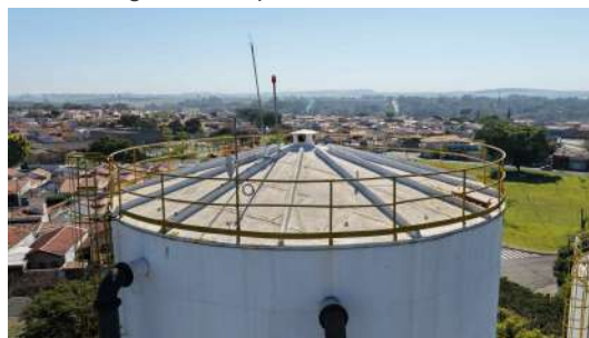
Foto 10 - Para-raios na cobertura.
