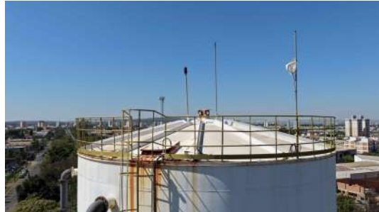
Foto 13 - Haste do SPDA na cobertura.
