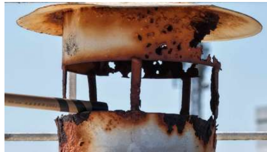
Foto 2 - Corrosão avançada na chaminé de ventilação, devendo ser substituída.
