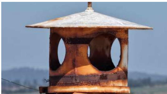
Foto 1 - Chaminé de ventilação sem tela de proteção.
