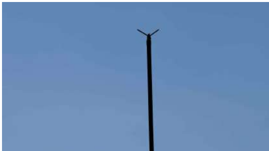
Foto 10 - SPDA na cobertura.
