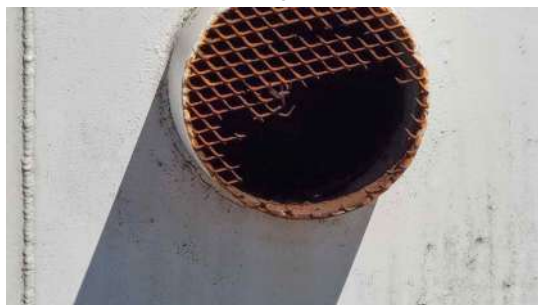
Foto 3 - Abertura do reservatório sem tela de proteção.
