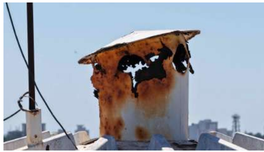
Foto 2 - Corrosão avançada na chaminé de ventilação.
