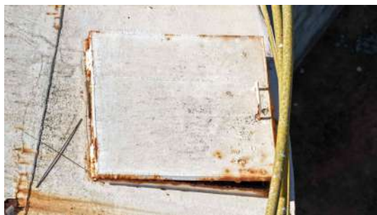
Foto 1 - Tampa de inspeção aparentemente aberta.
