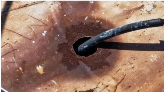
Foto 2 - Abertura na cobertura.
