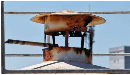
Foto 1 - Chaminé de ventilação sem tela de proteção.
