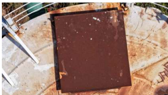
Foto 1 - Tampa de inspeção corroída.
