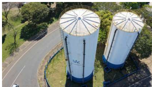
Foto 8 - Visualiza-se o extravasor, escada e guarda-corpo do reservatório.
