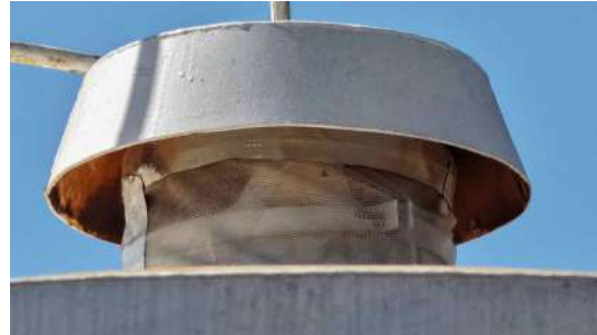
Foto 14 - Tela de proteção na chaminé de ventilação.
