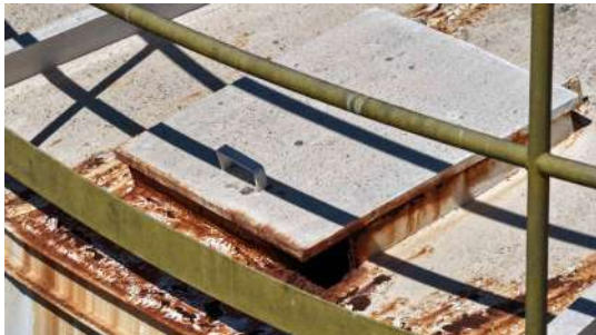
Foto 13 - Tapa de inspeção.
