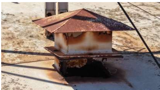
Foto 1 - Chaminé de ventilação sem tela de proteção.
