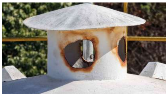
Foto 1 - Chaminé de ventilação sem tela de proteção.
