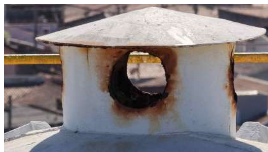
Foto 2 - Chaminé de ventilação sem tela de proteção.
