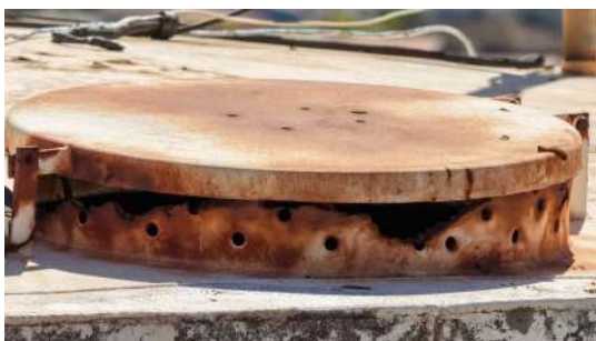
Foto 1 - Tampa de inspeção possui aberturas.
