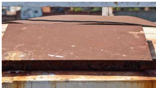
Foto 3 - Tampa de inspeção corroída.
