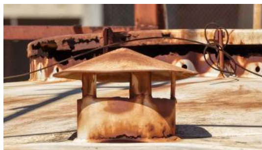
Foto 2 - Aberturas na tampa de inspeção, ao fundo.
