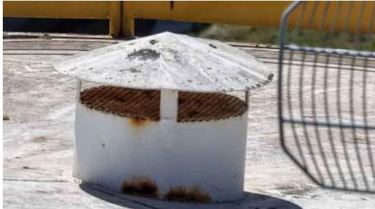
Foto 11 - Chaminé de ventilação.
