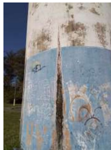
Foto 4 - Vazamentos no reservatório.
