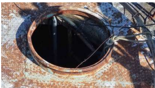
Foto 1 - Ausência de tampa de inspeção.
