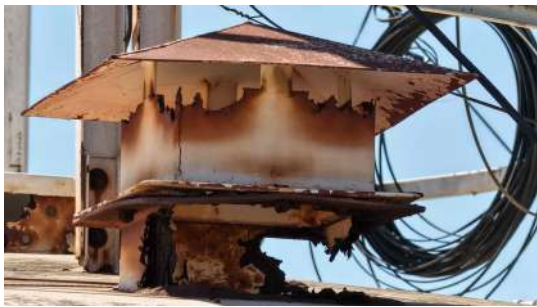
Foto 1 - Corrosão e abertura no chapéu de ventilação.
