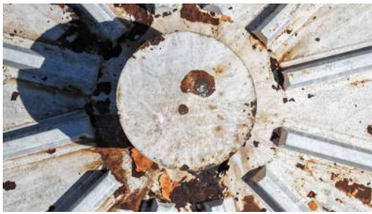
Foto 1 - Corrosão avançada na chaminé de ventilação.
