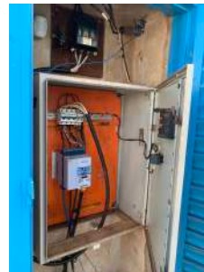
Foto 10 - Interior do painel elétrico.
