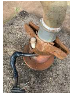
Foto 4 - Tubo de medição de nível.
