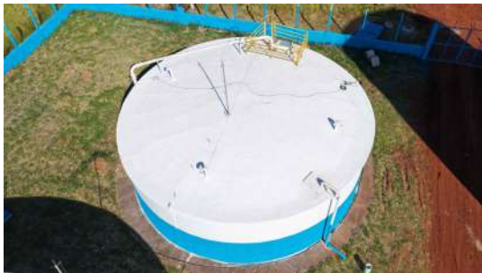
Foto 1 - Ausência de cabeamento de descida do SPDA.
