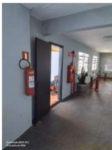
Foto 15 - Extintor próximo aos filtros.
