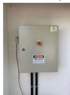
Foto 8 - Painel elétrico do poço.
