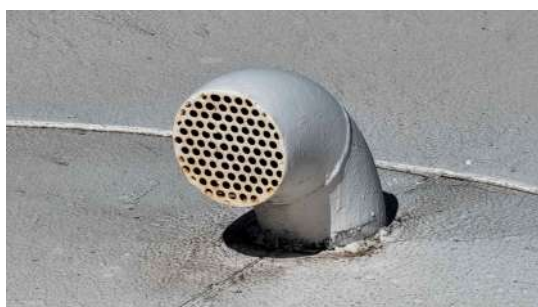
Foto 1 - Tubulação de ventilação sem tela de proteção contra entrada de insetos e pequenos animais.
