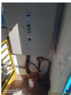
Foto 3 - Painel de energia da EEAT e extintor.
