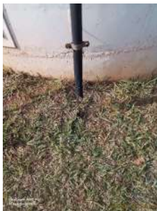
Foto 3 - Aterramento do SPDA.
