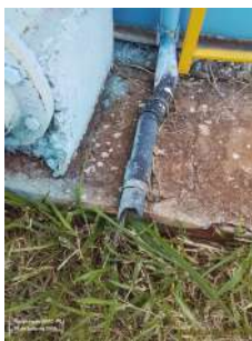
Foto 3 - Aterramento do SPDA.
