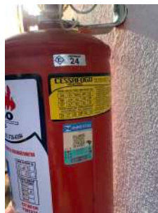
Foto 4 - Validade do extintor.
