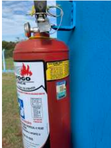
Foto 15 - Validade do extintor.
