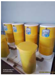
Foto 31 - Sistema de aplicação de cloro.
