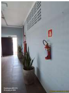
Foto 1 - Extintor de incêndio no acesso à ETA.
