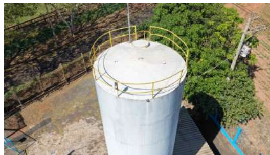
Foto 2 - Guarda-corpo superior sem barra de rodapé.
