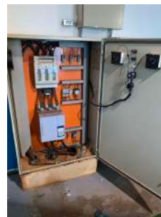
Foto 11 - Interior do painel elétrico.
