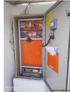
Foto 6 - Interior do painel de energia.
