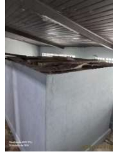
Foto 34 - Caixa de saída de água tratada.
