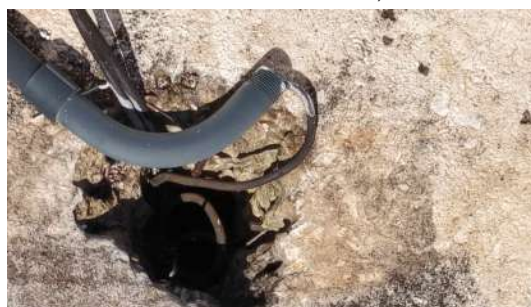
Foto 17 - Buraco de entrada de fiação (imagem de drone de 05/08/2026).
