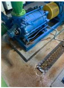
Foto 1 - Bomba 2 com dois pontos de drenagem de gaxetas.
