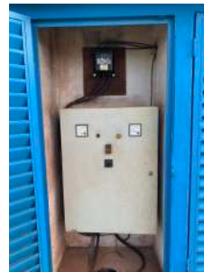
Foto 10 - Pannel elétrico do poço.
