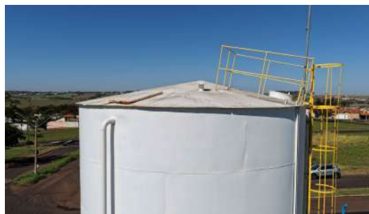
Foto 2 - Guarda-corpo superior sem barra de rodapé.
