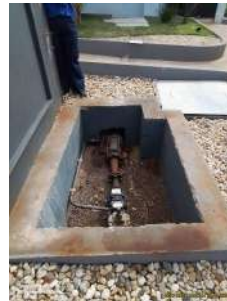
Foto 14 - Macromedidor de entrada.
