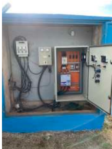
Foto 13 - Interior do painel elétrico.
