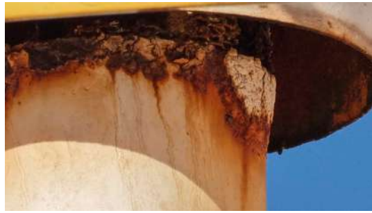
Foto 4 - Tubulação de ventilação com corrosão.
