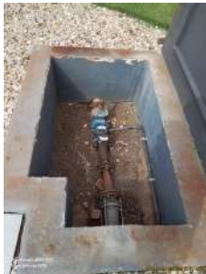
Foto 13 - Macromedidor de entrada.
