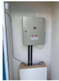
Foto 12 - Painel elétrico do poço.
