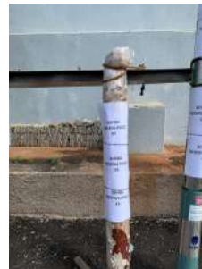
Foto 19 - Bomba reserva do poço 16.
