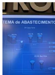
Foto 19 - Detalhes da unidade no CCO.
