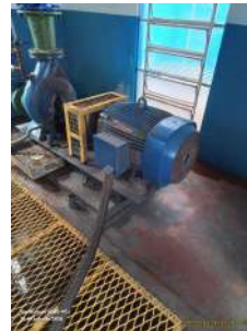
Foto 6 - Conjunto 2 de motor e bomba.
