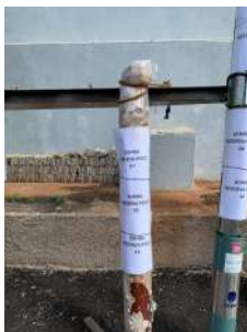
Foto 19 - Bomba reserva do poço 10.
