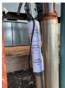
Foto 18 - Bomba reserva do poço 8.
