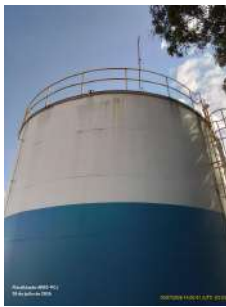
Foto 1 - Guarda-corpo superior sem barra de rodapé.
