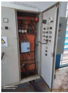
Foto 12 - Interior do painel elétrico.
