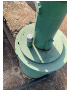
Foto 4 - Tubo de medição de nível.
