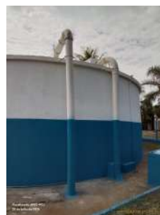
Foto 8 - Apenas uma tubulação de alimentação funciona e vem da EEAT 5.
