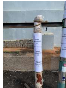
Foto 18 - Bomba reserva do poço 7.
