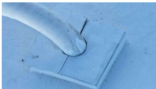
Foto 10 - Tubulação de alimentação (imagem de drone de 05/08/2026).
