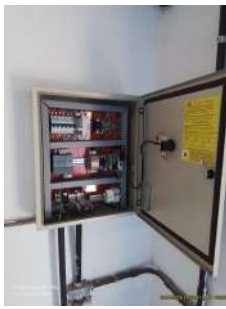
Foto 13 - Interior do painel elétrico.
