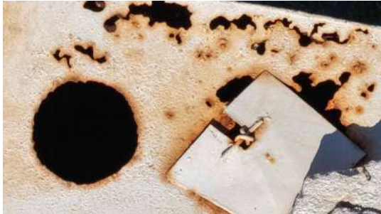
Foto 1 - Eliminar a abertura e pontos de corrosão e evitar a entrada de contaminantes externos e água de chuva no interior do reservatório.
