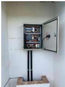
Foto 11 - Interior do pannel elétrico.
