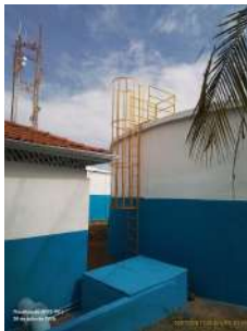
Foto 2 - Guarda-corpo da escada e superior.
