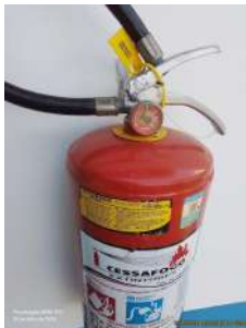
Foto 9 - Pressurização e validade do extintor.
