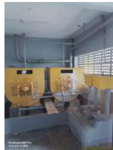
Foto 20 - Sistema de aplicação de cal desativado.
