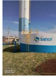
Foto 4 - Guarda-corpo do reservatório.
