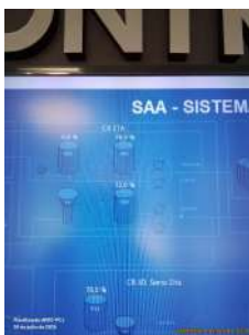
Foto 9 - Detalhes da unidade no CCO.
