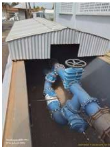
Foto 38 - Macromedidor de saída.
