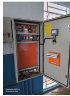
Foto 13 - Interior do painel elétrico.
