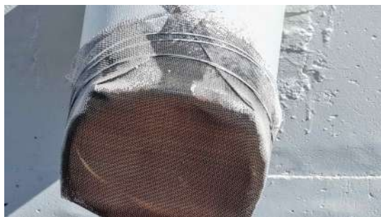
Foto 10 - Extravasor (imagem de drone de 05/08/2026).
