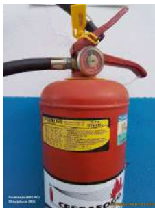
Foto 16 - Pressurização e validade do extintor.
