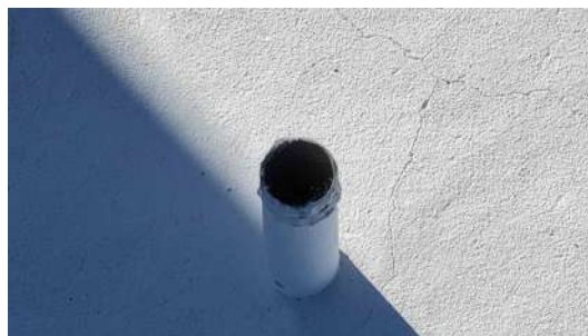
Foto 2 - Adequar tubulação de ventilação para impedir entrada de água de chuva.
