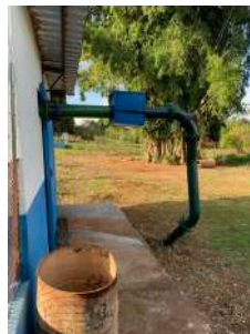
Foto 17 - Tubulação de recalque da EEAT.
