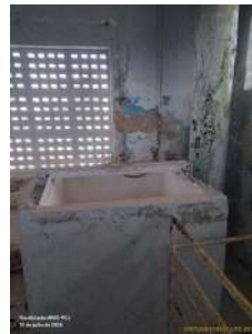
Foto 18 - Sistema de aplicação de cal desativado.
