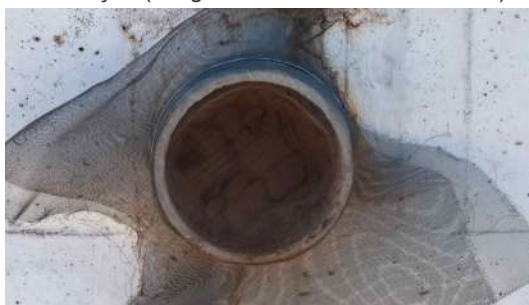
Foto 13 - Extravasor (imagem de drone de 05/08/2026).
