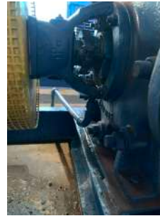
Foto 4 - Sistema de drenagem na parte central da bomba 2.
