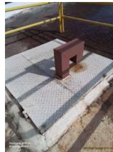
Foto 6 - Tampa de inspeção e tubulação de ventilação.
