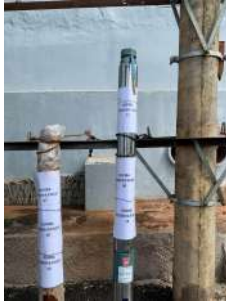
Foto 15 - Bomba reserva do poço 6.
