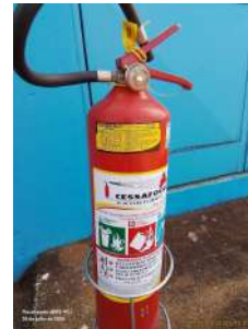
Foto 8 - Pressurização e validade do extintor.
