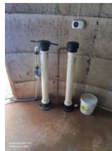
Foto 7 - Sistema de dosagem química no reservatório.
