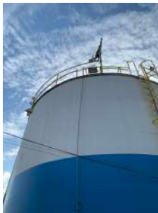
Foto 1 - Guarda-corpo superior sem barra de rodapé.
