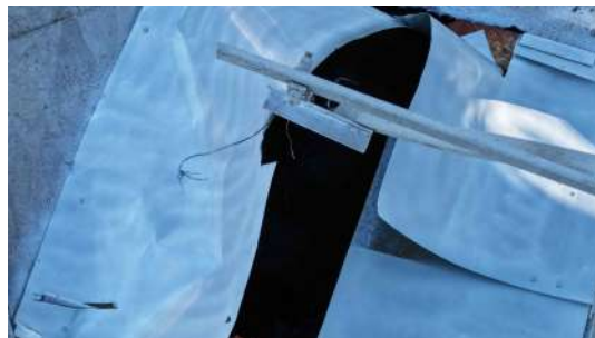
Foto 2 - Corrigir o acesso da tubulação e garantir a estanqueidade do reservatório contra entrada de contaminantes.
