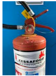
Foto 12 - Pressurização do extintor.
