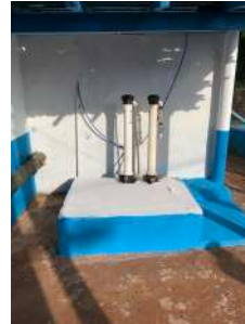
Foto 16 - Sistema de dosagem de produtos químicos no reservatório R 26.
