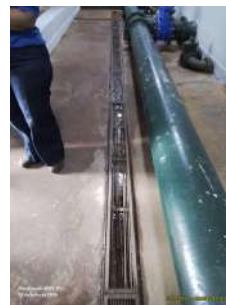
Foto 4 - Grelhas de piso danificadas nas saídas dos filtros.
