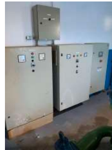
Foto 10 - Painel elétrico da EEAT.
