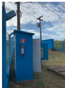
Foto 8 - Extintor de incêndios.
