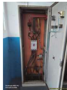
Foto 11 - Interior do painel elétrico.
