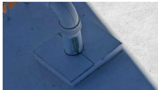
Foto 9 - Tubulação de alimentação (imagem de drone de 05/08/2026).
