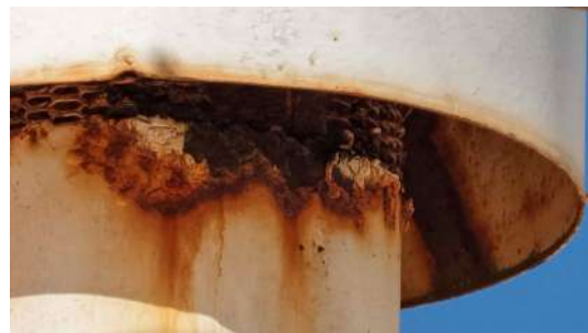
Foto 2 - Tubulação de ventilação com corrosão.
