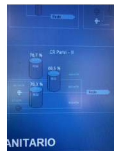
Foto 22 - Detalhes da unidade no CCO.
