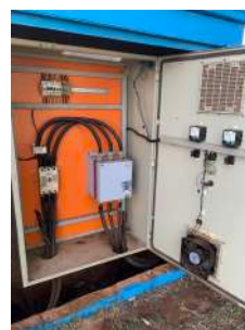
Foto 10 - Interior do painel elétrico.
