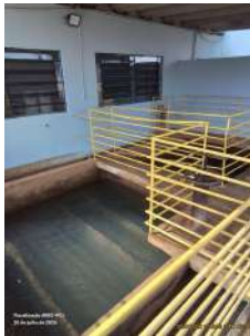
Foto 25 - Vista dos filtros 4 e 3.
