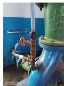
Foto 2 - Registro com vazamento.
