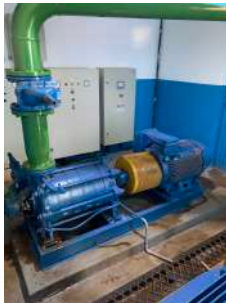
Foto 7 - Conjunto motor e bomba 2.
