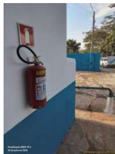
Foto 8 - Extintor de incêndios.
