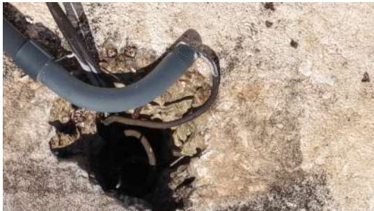
Foto 1 - Buraco na laje para acesso da fiação.
