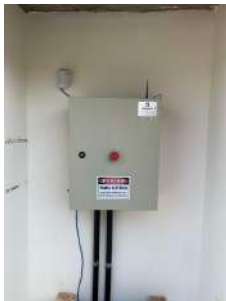
Foto 9 - Painel elétrico do poço.
