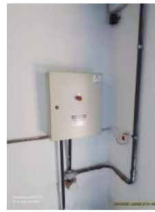
Foto 14 - Painel elétrico do poço.
