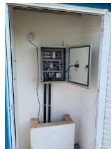
Foto 8 - Interior do painel elétrico.
