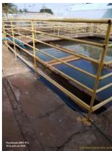
Foto 3 - Barra do guarda-corpo solta no decantador 2.
