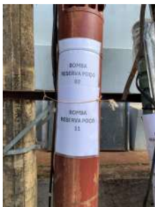
Foto 16 - Bomba reserva do poço 11.
