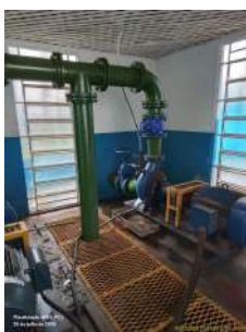
Foto 1 - Vista da localização do registro com vazamento.
