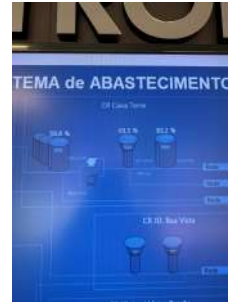
Foto 15 - Detalhes da unidade no CCO.
