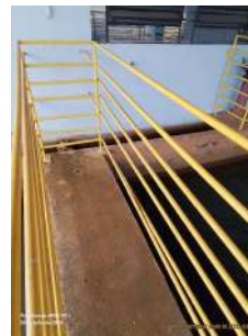
Foto 2 - Barra do guarda-corpo solta no filtro 3.
