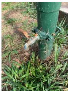
Foto 1 - Vazamento na torneira.
