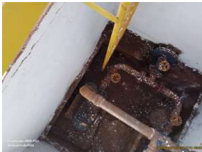
Foto 1 - Vazamento no registro da esquerda na imagem.
