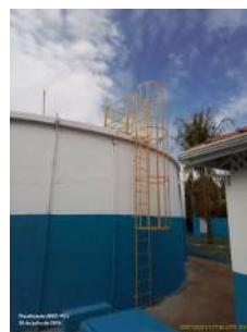
Foto 6 - Guarda-corpo da escada e superior.
