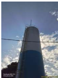
Foto 1 - Guarda-corpo superior sem barra de rodapé.
