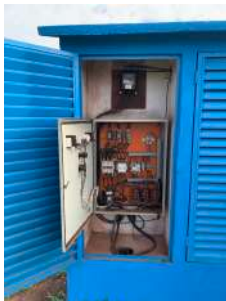
Foto 9 - Interior do pannel elétrico.
