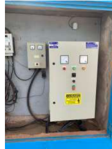
Foto 14 - Painel elétrico do poço.
