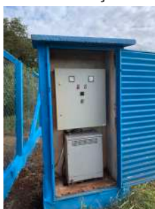
Foto 9 - Painel elétrico do poço.
