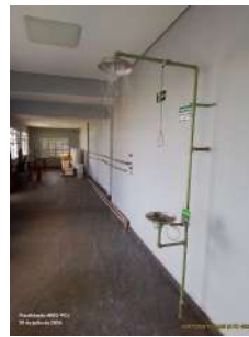
Foto 12 - Chuveiro de emergência.
