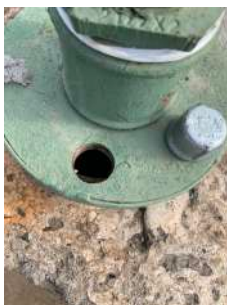
Foto 1 - Ausência de tubo de medição de nível.
