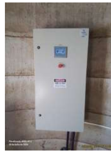
Foto 8 - Painel de automação.
