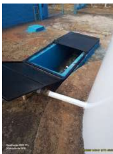
Foto 7 - Macromedidor de saída do reservatório.
