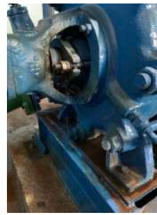
Foto 2 - Extremidade junto à tubulação de recalque sem sistema de drenagem.
