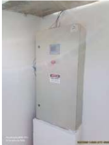
Foto 5 - Painel de energia da EEAT.
