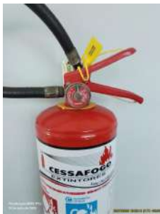
Foto 3 - Pressurização do extintor.
