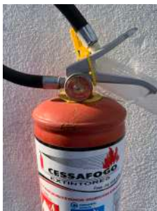
Foto 3 - Pressurização do extintor.
