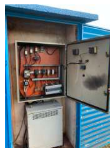
Foto 10 - Interior do painel elétrico.
