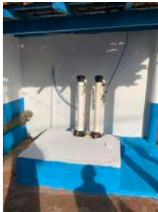
Foto 15 - Sistema de dosagem de produtos químicos no reservatório R 26.
