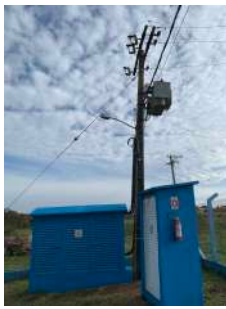
Foto 13 - Entrada e transformador de energia.
