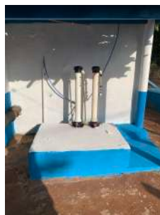
Foto 14 - Sistema de dosagem de produtos químicos no reservatório R 26.
