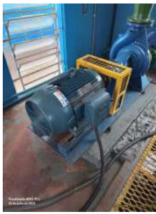
Foto 3 - Conjunto 1 de motor e bomba.
