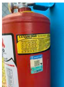
Foto 10 - Validade do extintor.
