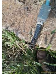
Foto 4 - Conduíte com aterramento do SPDA.
