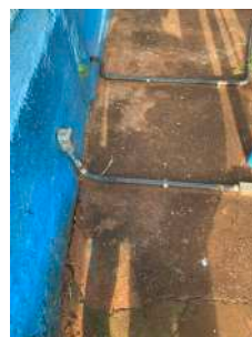
Foto 8 - Conduíte com aterramento do SPDA.
