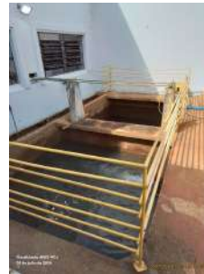
Foto 26 - Vista dos filtros 2 e 1.
