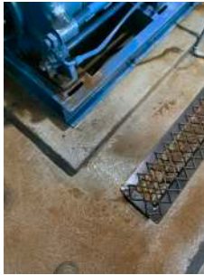
Foto 3 - Piso molhado devido à ausência de sistema de drenagem.
