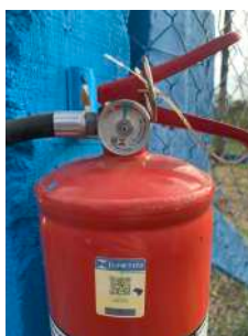
Foto 7 - Pressurização do extintor.
