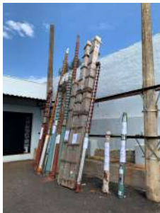
Foto 18 - Estoque de bombas reservas dos poços na ETA.
