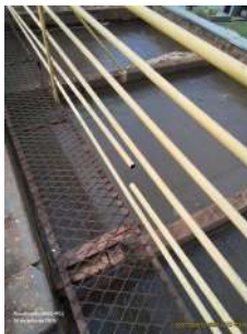
Foto 1 - Barra do guarda-corpo solta no floculador.
