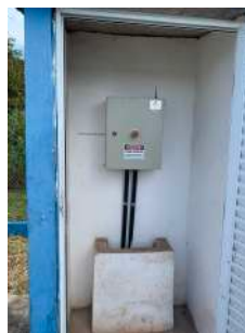
Foto 12 - Painel elétrico do poço.
