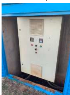
Foto 9 - Painel elétrico do poço.
