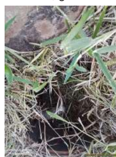
Foto 4 - Aterramento do SPDA.
