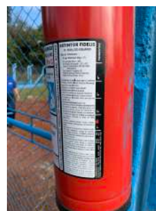
Foto 8 - Validade do extintor.
