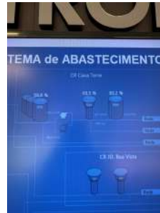
Foto 23 - Detalhes da unidade no CCO.
