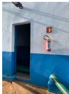
Foto 2 - Extintor e acesso à EEAT.
