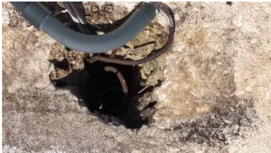
Foto 2 - Buraco na laje para acesso da fiação.
