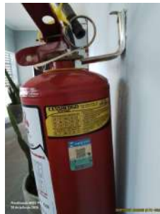
Foto 2 - Validade do extintor.
