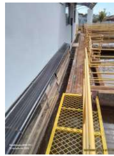
Foto 22 - Canal de distribuição para os decantadores.
