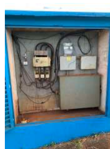
Foto 8 - Pannel elétrico do poço.
