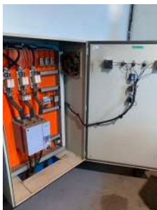
Foto 12 - Interior do painel elétrico.
