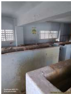
Foto 19 - Sistema de aplicação de cal desativado.
