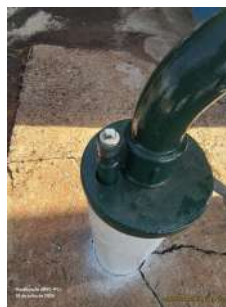
Foto 4 - Tubo de medição de nível.
