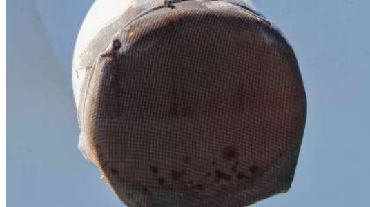
Foto 6 - Extravasor (imagem de drone de 05/08/2026).
