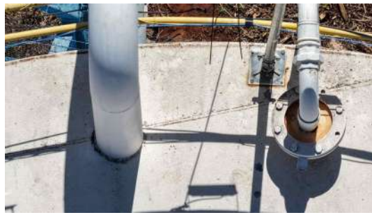
Foto 14 - Tubos de alimentação (imagem de drone de 05/08/2026).
