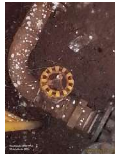
Foto 2 - Detalhe do registro com vazamento.
