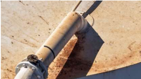
Foto 3 - Tubulação de alimentação (imagem de drone de 05/08/2026).
