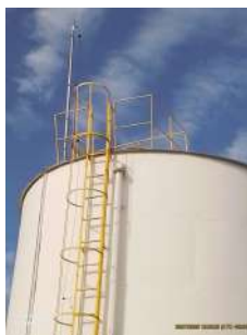
Foto 1 - Guarda-corpo superior sem barra de rodapé.
