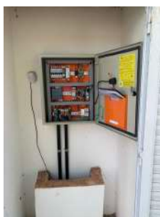
Foto 7 - Interior do painel elétrico.
