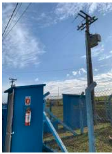
Foto 11 - Extintor e entrada e transformador de energia.
