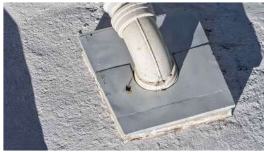
Foto 12 - Tubulação de alimentação (imagem de drone de 05/08/2026).
