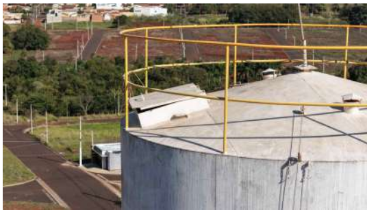
Foto 1 - Guarda-corpo superior sem barra de rodapé.
