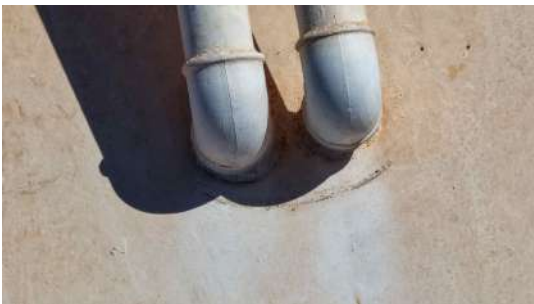
Foto 4 - Tubulação de alimentação (imagem de drone de 05/08/2026).
