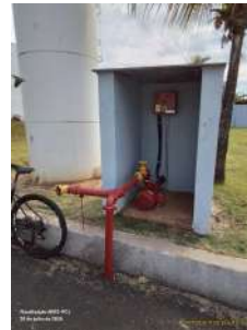
Foto 37 - Sistema de combate a incêndio.
