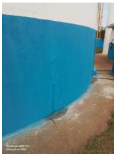
Foto 1 - Vazamentos na parede do reservatório.
