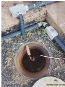
Foto 3 - Aterramento do SPDA.
