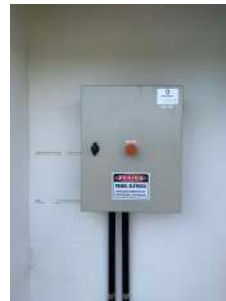
Foto 12 - Pannel elétrico do poço.
