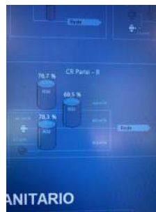
Foto 26 - Detalhes da unidade no CCO.
