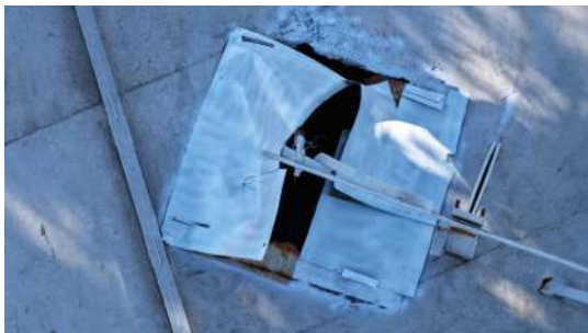
Foto 1 - Corrigir o acesso da tubulação e garantir a estanqueidade do reservatório contra entrada de contaminantes.
