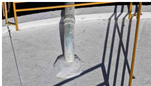
Foto 9 - Tubulação de alimentação (imagem de drone de 05/08/2026).
