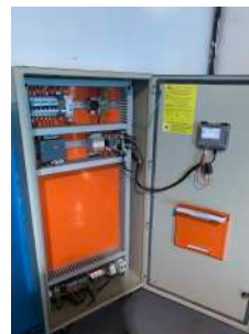
Foto 13 - Interior do painel elétrico.
