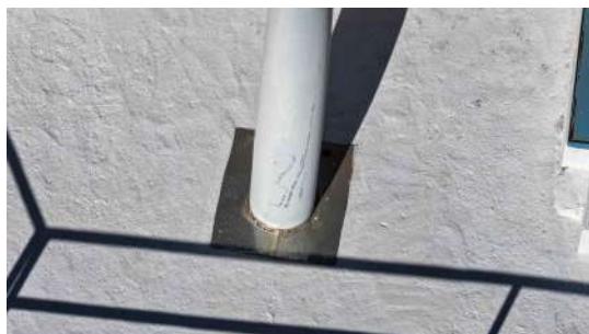
Foto 8 - Tubulação de alimentação (imagem de drone de 05/08/2026).
