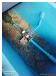
Foto 8 - Macromedidor de saída do reservatório.
