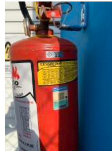
Foto 13 - Validade do extintor.
