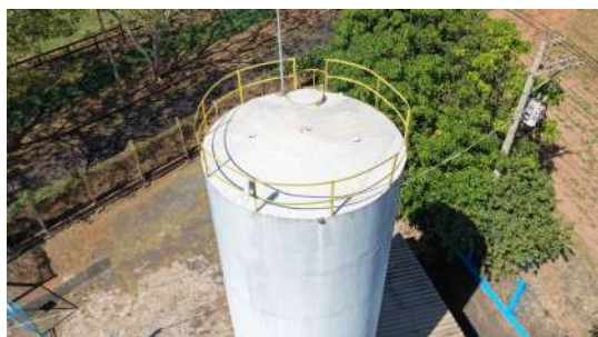
Foto 1 - Ausência de tubulação de ventilação.
