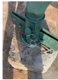
Foto 4 - Tubo de medição de nível.
