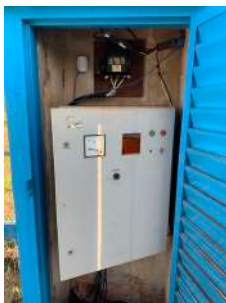
Foto 11 - Painel elétrico do poço.
