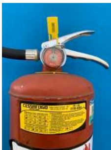
Foto 7 - Pressurização do extintor.
