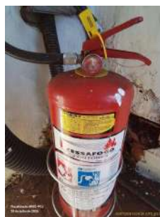
Foto 4 - Pressurização e validade do extintor.
