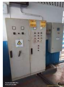
Foto 10 - Painel elétrico da EEAT.
