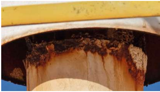
Foto 3 - Tubulação de ventilação com corrosão.
