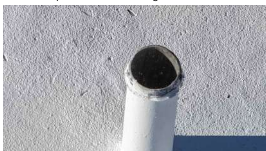
Foto 3 - Adequar tubulação de ventilação para impedir entrada de água de chuva.
