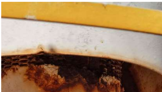
Foto 1 - Tubulação de ventilação com corrosão.
