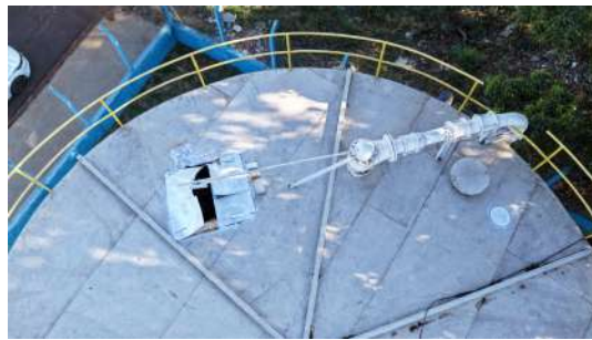
Foto 2 - Guarda-corpo superior sem barra de rodapé.
