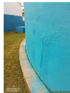
Foto 2 - Vazamentos na parede do reservatório.
