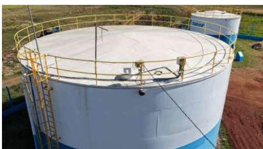
Foto 1 - Guarda-corpo superior sem barra de rodapé.
