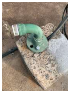
Foto 4 - Ausência de tubo de medição de nível.
