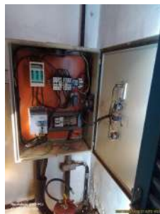
Foto 6 - Interior do painel de energia.
