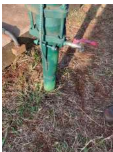
Foto 1 - Torneira para tomada de água bruta inoperante (sem vazão).
