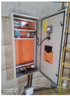
Foto 7 - Interior do painel de automação.
