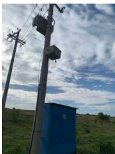
Foto 13 - Entrada e transformador de energia.
