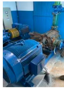
Foto 6 - Conjunto motor e bomba 1.
