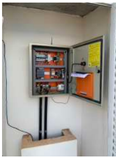
Foto 11 - Interior do painel elétrico.
