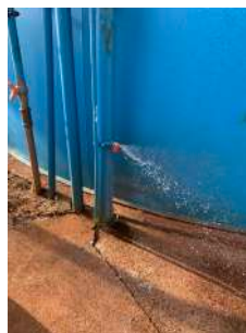
Foto 16 - Tomada de água bruta no reservatório R 26.
