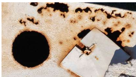
Foto 5 - Abertura e corrosão no topo (imagem de drone de 05/08/2026).
