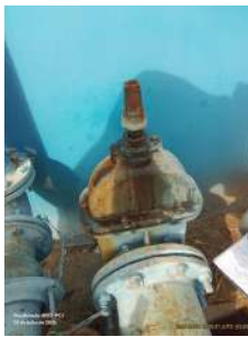
Foto 1 - Vazamento no registro do reservatório.
