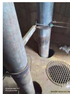
Foto 6 - Tudo da frente: extravasor. Tudo do fundo: alimentação do reservatório pela EEAT 3 local.
