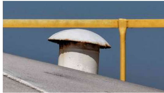
Foto 2 - Tubulação de ventilação sem tela de proteção contra entrada de insetos e pequenos animais.
