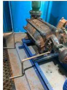
Foto 8 - Drenagem da água de lubrificação das gaxetas da bomba 1.
