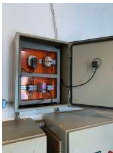
Foto 14 - Interior do painel elétrico.
