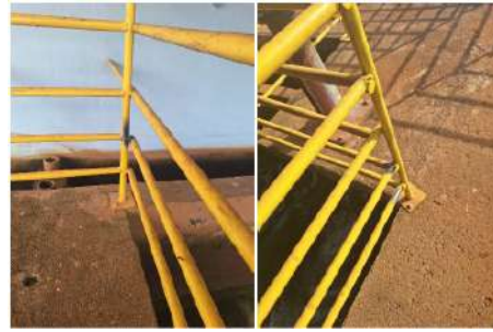
Foto 6 - Adequação no filtro 3 apresentada pelo prestador no Protocolo 1286/2026 em 14/08/2026.
