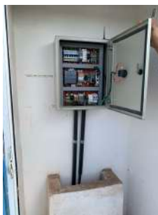
Foto 11 - Interior do painel elétrico.
