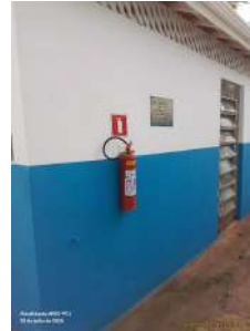
Foto 15 - Extintor de incêndio.
