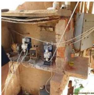
Foto 3 - Detalhe do abrigo das bombas dosadoras.
