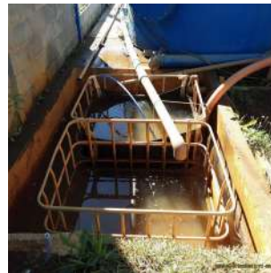
Foto 2 - Detalhe da tubulação de descarga, direcionada para o cesto sem o bag.
