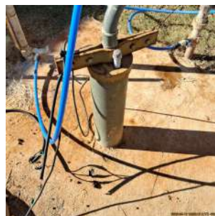
Foto 7 - Tubo de medição de nível.
