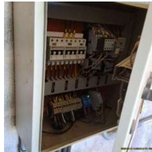
Foto 7 - Painelelétrico instalado no interior da edificação.
