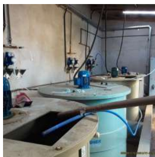
Foto 5 - Resíduos depositados sobre os tanques de produtos químicos.
