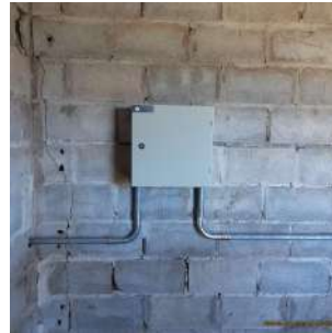
Foto 6 - Painel elétrico instalado no interior da edificação.
