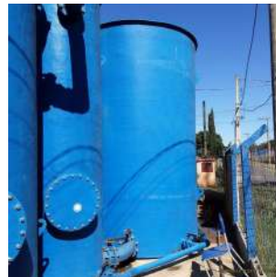
Foto 8 - Vista do decantador a partir do solo.
