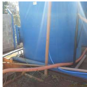
Foto 4 - Instalações improvisadas, com destaque para os fios elétricos enrolados na tampa de inspeção do decantador.
