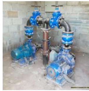
Foto 4 - Vista geral da elevatória. Há dois conjuntos moto-bomba instalados, um em funcionamento e o segundo como reserva.
