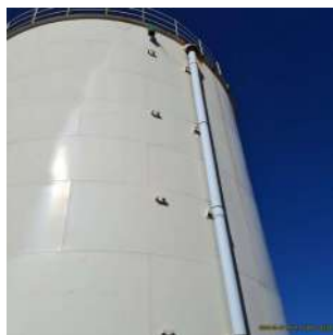
Foto 5 - Tubulação de entrada de água no reservatório. À esquerda é possível observar o tubo extravasor.
