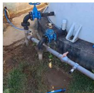
Foto 7 - Tubulações de saída para a rede de distribuição.
