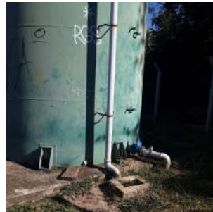
Foto 3 - Tubulações de entrada de água no reservatório (à esquerda) e de saída para abastecimento (à direita).
