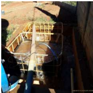
Foto 1 - Estrutura de tratamento de lodo.
