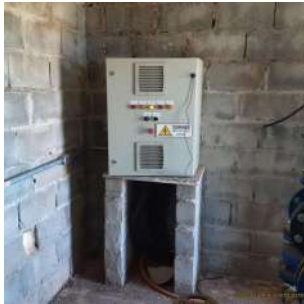
Foto 5 - Painel elétrico instalado no interior da edificação.
