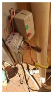
Foto 5 - Disjuntores e dispositivos elétricos da elevatória.
