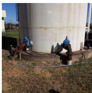
Foto 9 - Tubulações de saída do reservatório.
