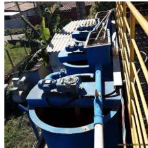
Foto 5 - Vista superior dos três floculadores mecânicos.
