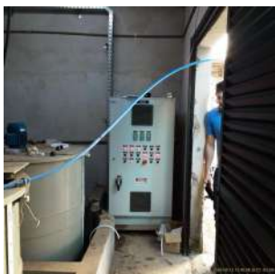
Foto 13 - Painel elétrico instalado no interior da sala de produtos químicos.
