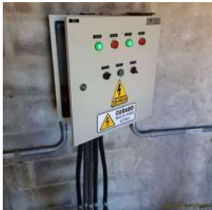
Foto 6 - Painelelétrico instalado no interior da edificação.
