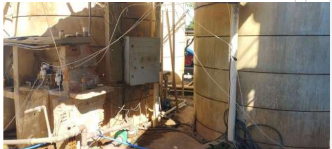
Foto 2 - No fundo, estruturas da antiga ETA mantidas no local; À frente, mangueiras das bombas dosadoras de produtos químicos suspensas sobre áreas de circulação de funcionários.
