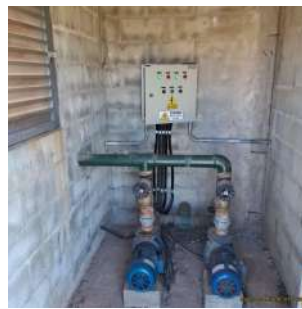
Foto 4 - Vista geral da elevatória.
