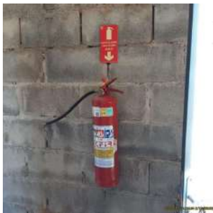
Foto 7 - Extintor de incêndio instalado no interior da edificação.
