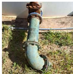
Foto 6 - Tubulação de saída para a rede de distribuição.
