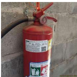
Foto 1 - Detalhe da etiqueta de controle de manutenções do extintor - fora da validade.
