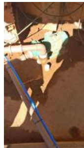
Foto 3 - Conjunto moto-bomba reserva.
