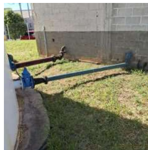
Foto 7 - Tubulações de saída do reservatório para as elevatórias Cidade Jardim e Jardim Brasília.
