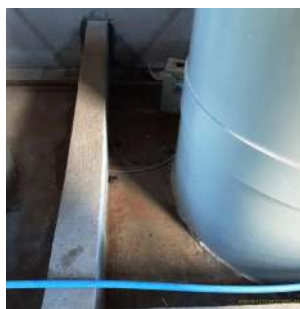
Foto 6 - Resíduos depositados no interior do dique de contenção.
