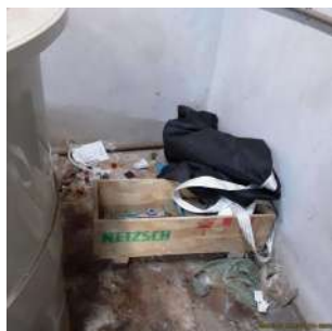
Foto 7 - Resíduos depositados no interior do dique de contenção.
