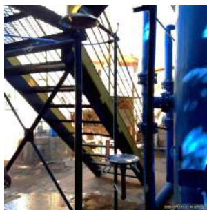
Foto 14 - Chuveiro de emergência instalado próximo à sala de produtos químicos.
