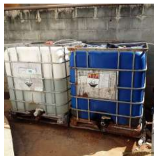
Foto 2 - Tanques de produtos químicos armazenados de forma inadequada.
