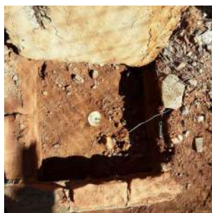
Foto 1 - Macromedidor instalado próximo ao portão de acesso, atualmente inoperante.
