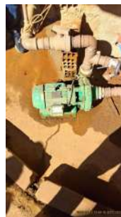
Foto 2 - Conjunto moto-bomba em operação.
