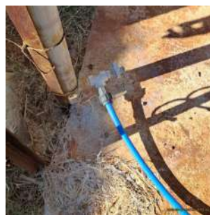
Foto 6 - Torneira para coleta de água bruta.
