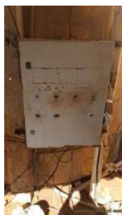
Foto 4 - Painel elétrico da elevatória.
