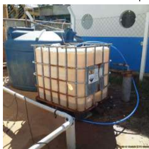
Foto 3 - Tanques de produtos químicos armazenados de forma inadequada.
