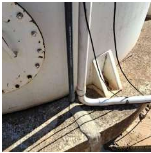
Foto 8 - Detalhe do aterramento do para-raios.
