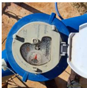
Foto 5 - Macromedidor de vazão. O visor apresentava condensação interna no momento da fiscalização, dificultando a leitura do medidor. Recomenda-se a limpeza do visor, de modo a garantir a adequada visualização e a confiabilidade das leituras registradas.
