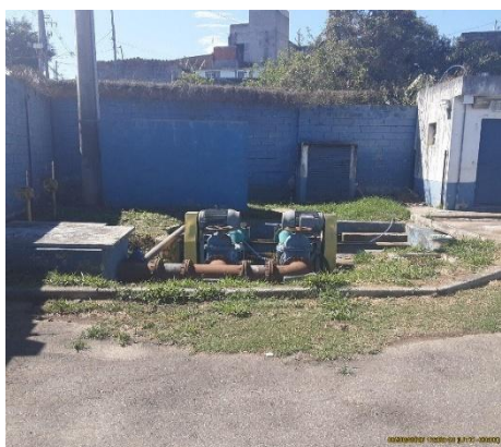
Foto 5 - EEE Oceania: Vista geral da elevatória (agosto/2026).
