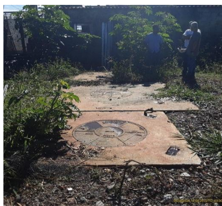
Foto 6 - EEE 2.2 – VARINHAS I: Vista geral da elevatória instalada sob o solo em terreno localizado no início da Rua Padre Albino Bareta.
