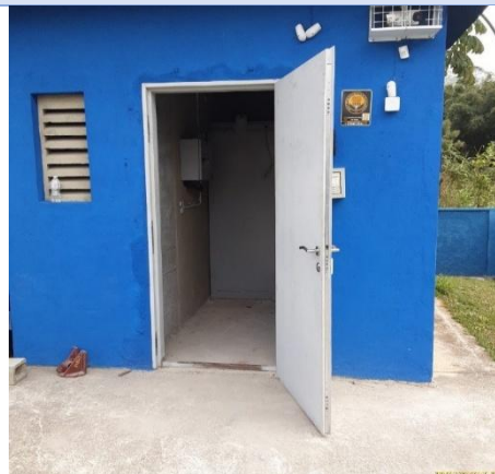
Foto 2 - EEE Botujuru I: Edificação para abrigo de equipamentos e painéis elétricos (julho/2025).
