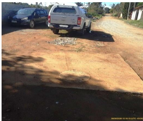
Foto 3 - EEE 1.2 – PADRE ALBINO: Vista geral da elevatória instalada sob a Rua Padre Albino Bareta, na altura do nº 31.
