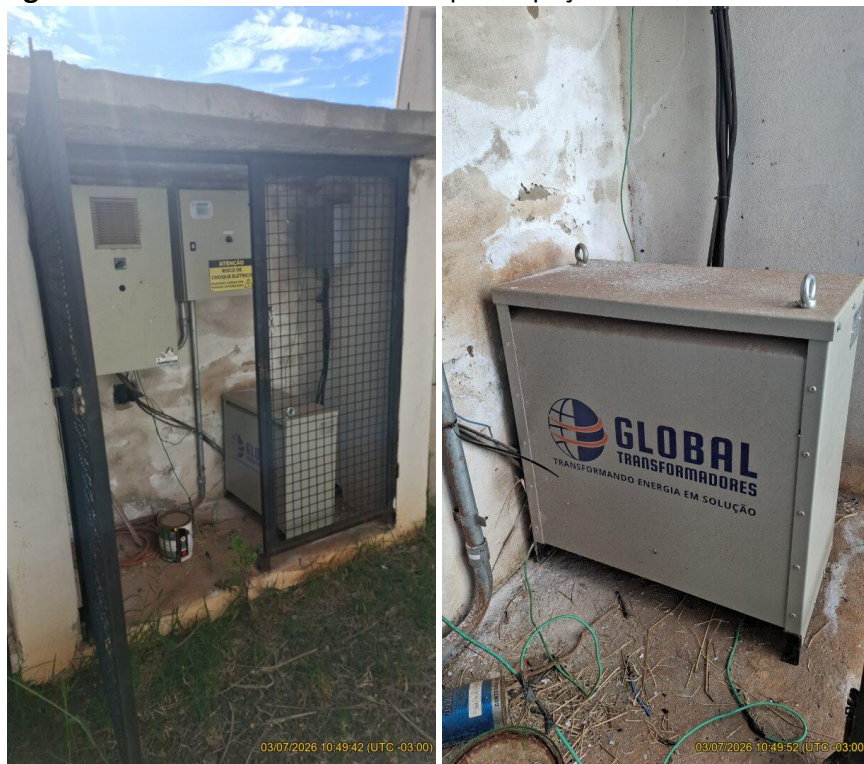
Figura TEC 3 – Novo transformador para o poço do bairro Lourdes Abel.
