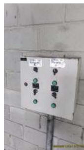
Foto 13 - Paineis das bombas dosadoras de polímero.
