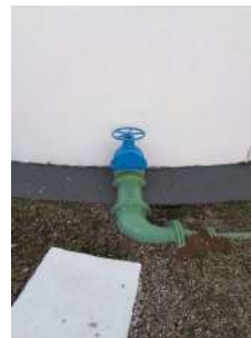
Foto 6 - Uma das saídas do reservatório.
