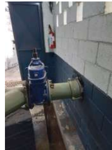
Foto 7 - Tubulação proveniente do reservatório apoiado.
