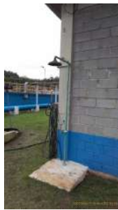
Foto 1 - Chuveiro próximo ao tratamento de lodo
