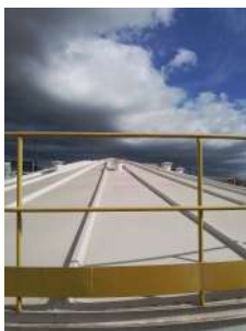
Foto 3 - Chaminés de ventilação
