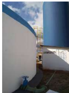
Foto 8 - Saída do reservatório para a elevatória que recalca para o elevado, ao fundo.
