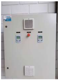
Foto 5 - Pannel de comando.
