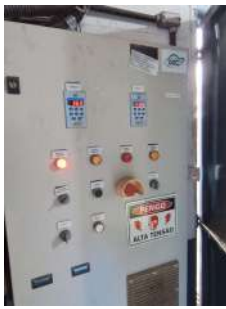
Foto 3 - Painel de comando das bombas.
