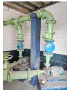
Foto 4 - Bombas e recalque.
