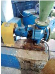
Foto 5 - Drenagem da água de lubrificação da gaxeta.
