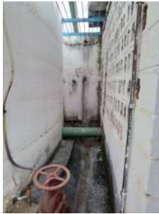
Foto 5 - Saída do reservatório para a elevatória que abastece o reservatório elevado.
