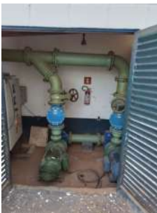
Foto 1 - Elevatória que abastece o reservatório elevado Pq São João a partir do apoiado.
