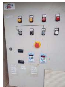
Foto 4 - Painel de comando das bombas.
