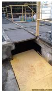
Foto 17 - Efluente passando pelo tratamento preliminar.
