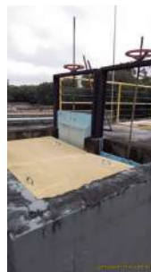
Foto 10 - Entrada no tratamento preliminar após a elevatória.
