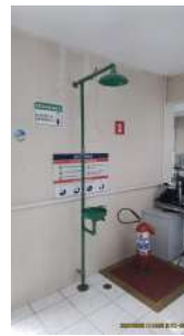
Foto 2 - Chuveiro de emergência no laboratório.
