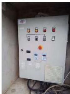
Foto 3 - Painel de comando das bombas.
