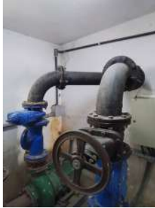
Foto 6 - Recalque para reservatório elevado.
