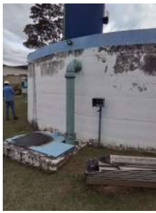
Foto 3 - Alimentação do reservatório apoiado.
