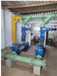
Foto 8 - Bombas da elevatória.
