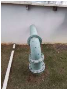
Foto 4 - Tubulação no reservatório.
