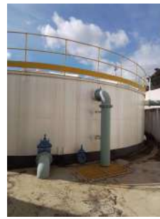
Foto 8 - Extravasor e saída de um dos reservatórios metálicos.
