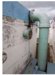
Foto 2 - Tela de proteção no reservatório
