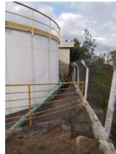
Foto 5 - Reservatório metálico. Ao fundo, elevatória que teve projeto descontinuado.
