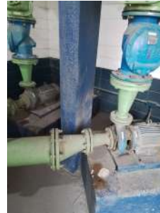
Foto 6 - Bombas da elevatória.
