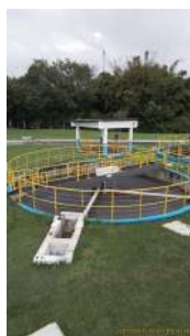
Foto 1 - Adensadores de lodo.
