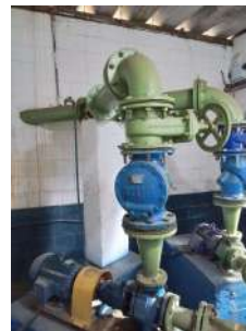
Foto 9 - Recalque para reservatório elevado.
