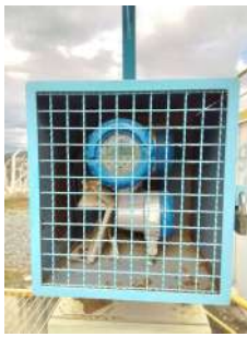
Foto 3 - Medidor de vazão na saída do reservatório.
