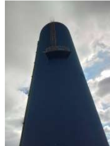
Foto 4 - Escada para manutenção.
