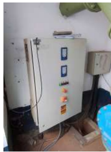
Foto 4 - Painele de comando.
