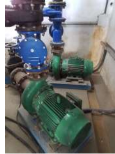
Foto 7 - Bombas com selo mecânico.
