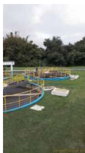
Foto 2 - Adensadores de lodo.
