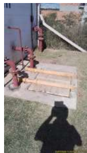
Foto 14 - Poço que abriga o gradeamento
