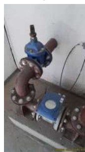
Foto 7 - Medidor de vazão no recalque.
