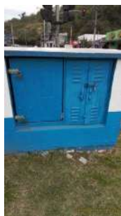
Foto 3 - Paineleletrico e de comando.
