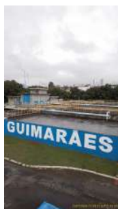
Foto 13 - ETE Vista a partir do tratamento preliminar.
