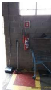
Foto 12 - Extintor na unidade de lodo.
