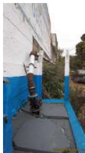
Foto 4 - Recalque da elevatória.
