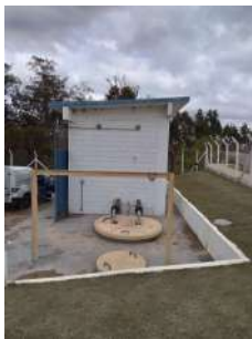
Foto 2 - Visão geral da elevatória.
