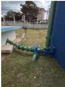
Foto 5 - Alimentação do reservatório a partir da elevatória.
