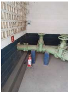
Foto 3 - Sucção da elevatória.
