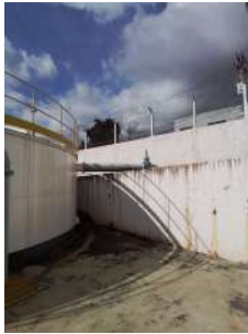
Foto 9 - Alimentação de um dos reservatórios.
