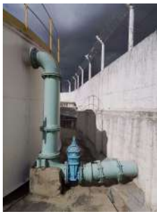
Foto 7 - Alimentação de um dos reservatórios metálicos.
