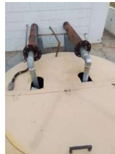
Foto 12 - Sucção das bombas.
