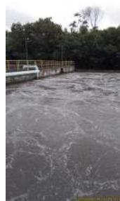
Foto 22 - Módulo de aeração por difusores.
