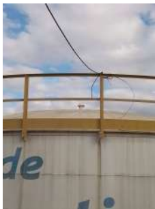
Foto 2 - Chaminé de ventilação.
