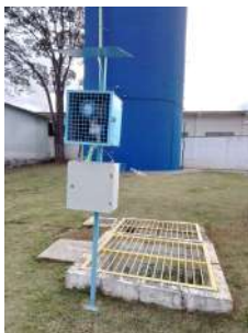
Foto 9 - Medidor de vazão saída do reservatório elevado.
