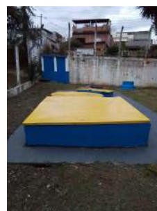
Foto 2 - Poços da elevatória.
