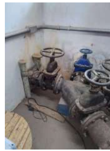
Foto 5 - Tubulação proveniente do reservatório apoiado.
