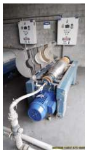
Foto 16 - Centrífugas em manutenção preventiva.
