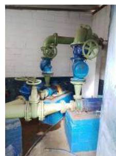
Foto 2 - Bombas da elevatória.
