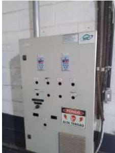
Foto 5 - Pannel das bombas.
