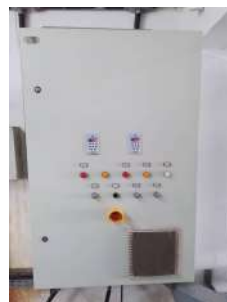
Foto 3 - Painel de comando das bombas.
