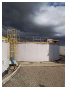
Foto 4 - Reservatórios metálicos apoiados.
