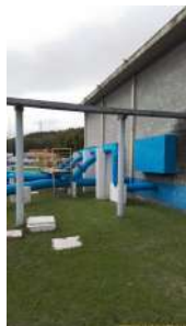
Foto 36 - Saída dos sopradores.
