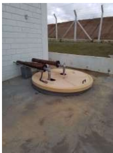
Foto 3 - Poço de sucção.
