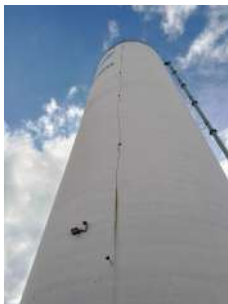
Foto 4 - Descida do aterramento.
