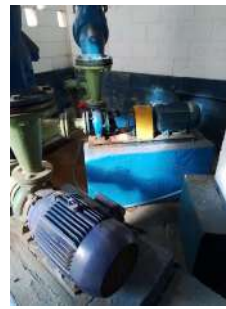
Foto 4 - Bombas, sendo uma com selo mecânico e outra com gaxeta.
