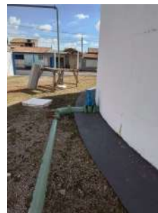
Foto 8 - Uma das saídas do reservatório.
