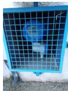
Foto 9 - Medidor de vazão de uma das saídas.
