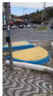
Foto 4 - Elevatoria situada no passeio de avenida movimentada.
