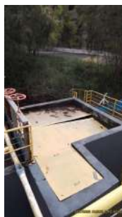
Foto 15 - Caixa de gordura.
