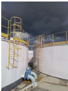
Foto 5 - Escadas de acesso para manutenção.
