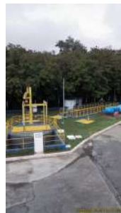
Foto 18 - Elevatória e caixa de areia.
