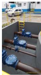
Foto 6 - Barriletes da elevatória.
