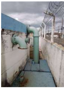
Foto 1 - Alimentação e extravasor do reservatório semi enterrado
