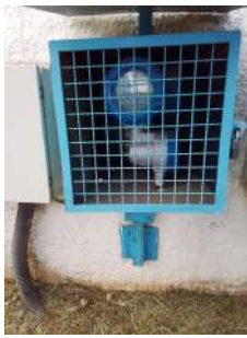
Foto 10 - Medidor de vazão.
