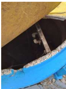
Foto 9 - Poço de sucção.
