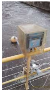
Foto 24 - Medidor de oxigênio de um dos tanques de aeração.
