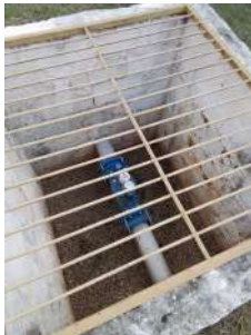
Foto 7 - Macromedidor na saída do reservatório elevado.
