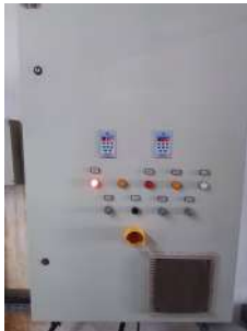
Foto 8 - Painel de comando quando uma das bombas foi acionada.
