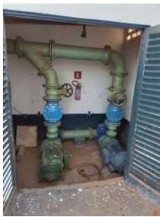
Foto 3 - Bombas centrífugas com selo mecânico.
