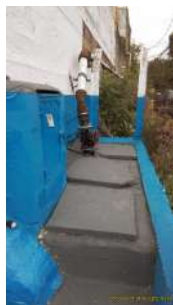
Foto 3 - Recalque da elevatória.
