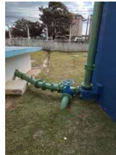
Foto 9 - Recalque da elevatória para o reservatório elevado.
