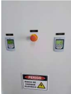
Foto 6 - Paineis de comando.
