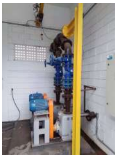
Foto 4 - Bombas da elevatória.
