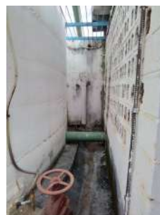
Foto 2 - Tubulação proveniente do reservatório apoiado de concreto que encaminha água para a elevatória.
