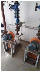
Foto 10 - Bombas da elevatória.
