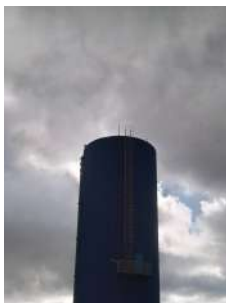
Foto 8 - Captor do SPDA e escada.
