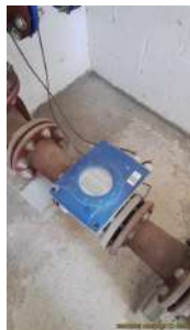
Foto 9 - Macromedidor no recalque.
