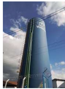
Foto 8 - Alimentação e saída do reservatório elevado.
