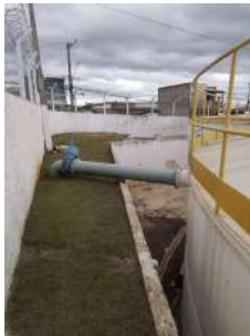
Foto 13 - Alimentação de um dos reservatórios.
