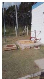
Foto 5 - Poço de sucção.
