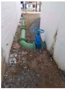
Foto 5 - Saída do reservatório apoiado encaminhando para e elevatória.
