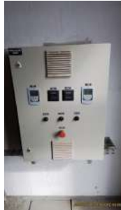
Foto 12 - Painel de comando.
