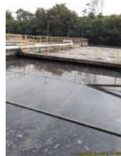
Foto 19 - Reator 1. São 3 reatores, cada um dividido em módulos A, B e C.
