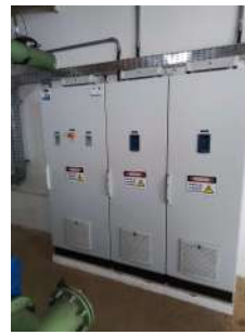
Foto 5 - Paineis de comando.
