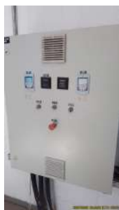
Foto 11 - Painele comando das bombas.
