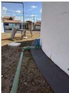
Foto 7 - Saída do reservatório apoiado que encaminha água para a elevatória.
