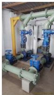
Foto 1 - Bombas que recalcam do Itapeva para o loteamento Vic Verona.
