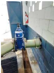
Foto 8 - Tubulação proveniente do reservatório apoiado é canaleta para escoar água.
