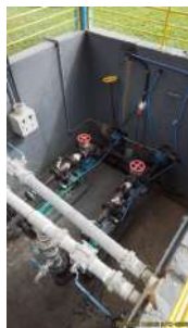
Foto 7 - Bombas que encaminham o lodo para a centrífuga.
