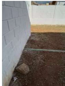
Foto 6 - Tubulação proveniente do reservatório apoiado.
