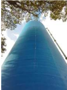
Foto 7 - Descida do aterramento.
