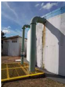
Foto 5 - Alimentação e extravasor.
