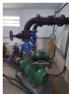
Foto 2 - Bombas que recalcam para o reservatório elevado Itapeva.
