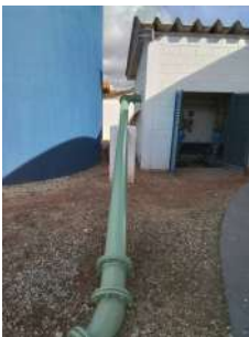
Foto 2 - Tubulação de recalque.
