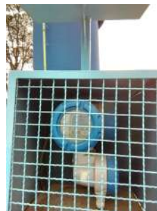
Foto 10 - Display do medidor de vazão.
