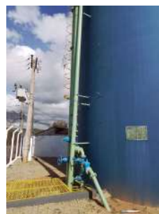
Foto 4 - Tubulações de alimentação e extravasor do reservatório.
