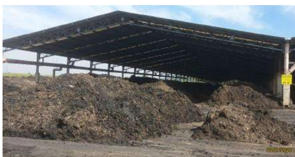
Foto 92 - Vista geral de um dos galpões de compostagem do lodo gerado na ETEJ.
