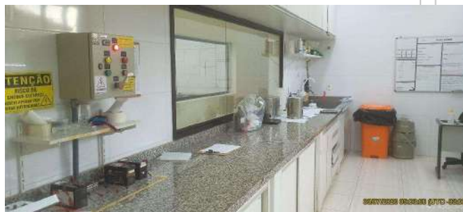
Foto 26 - Vista interna da sala de monitoramentos externos.
