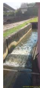
Foto 91 - Saída 3 de efluente tratado. Detalhe para a câmera de monitoramento.
