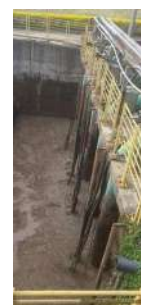
Foto 48 - Vista interna do tanque de sucção e tubulações de recalque do esgoto.
