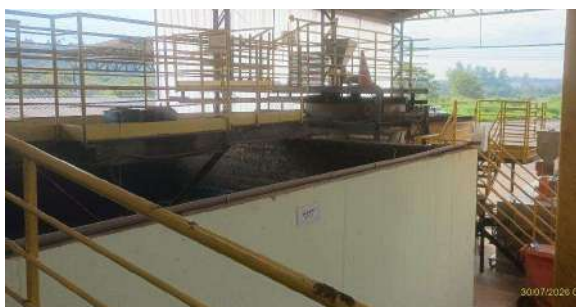
Foto 58 - Tanques de preparo do polímero e mistura com o lodo vindo das lagoas.
