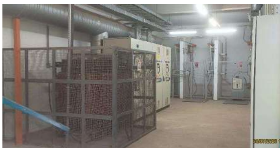
Foto 78 - Vista interna do segundo abrigo dos sopradores.
