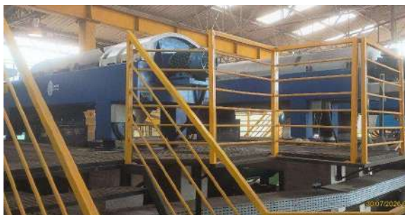
Foto 54 - Centrífugas de lodo.
