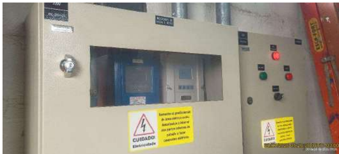
Foto 44 - Vista interna de parte dos equipamentos elétricos da estação elevatória.
