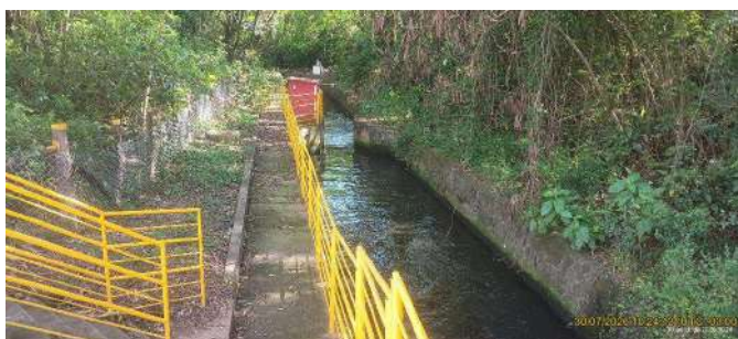
Foto 83 - Abrigo do medidor de vazão. Medição apenas instantânea, sem telemetria e sem registros contínuos.
