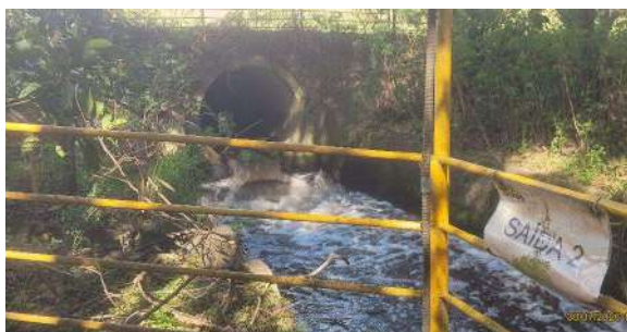
Foto 86 - Saída 2 do efluente tratado.
