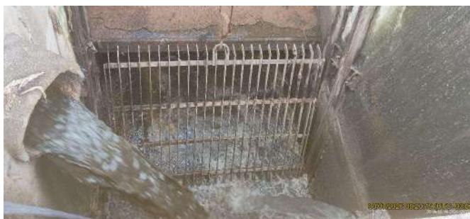
Foto 33 - Ponto de mistura do esgoto da rede pública com demais efluentes (EVC, retorno da amostragem e retorno do desaguamento do lodo) e passagem pela primeira grade.
