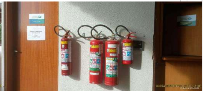
Foto 4 - Extintores de incêndio do local.
