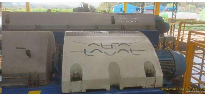
Foto 55 - Centrífugas de lodo.
