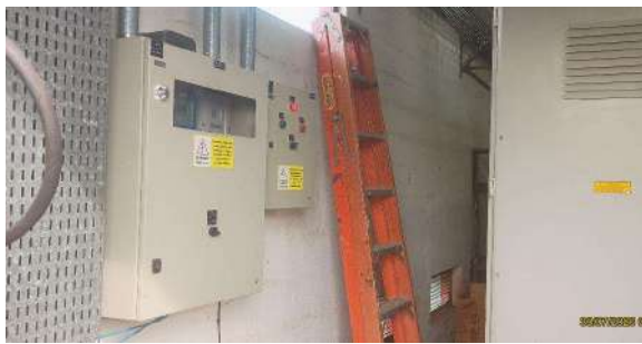
Foto 42 - Vista interna de parte dos equipamentos elétricos da estação elevatória.
