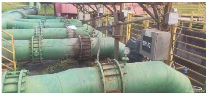
Foto 3 - Vazamentos identificados no momento da fiscalização.
