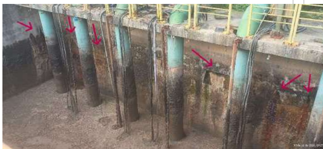
Foto 9 - Tanque de sucção do bombeamento, com indicação dos locais com vazamentos na parede.
