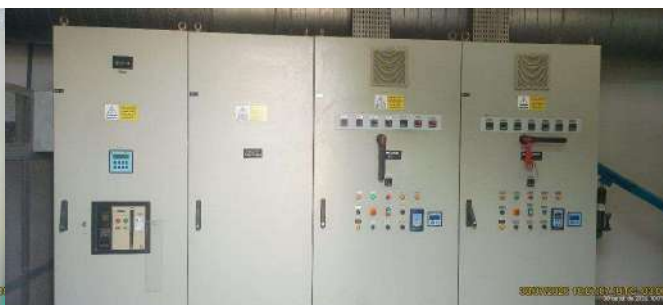
Foto 79 - Vista de parte dos equipamentos elétricos do segundo abrigo de sopradores.
