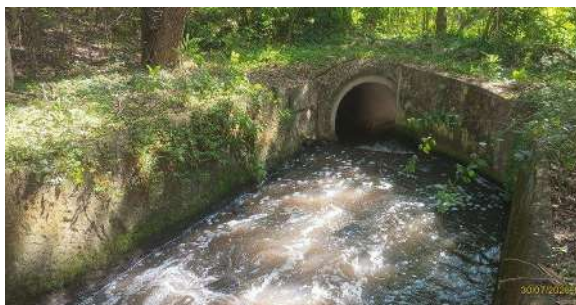
Foto 88 - Saída 2 do efluente tratado.
