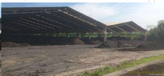
Foto 93 - Vista geral de um dos galpões de compostagem do lodo gerado na ETEJ.
