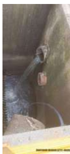
Foto 32 - Ponto de mistura do esgoto da rede pública com demais efluentes (EVC, retorno da amostragem e retorno do desaguamento do lodo).
