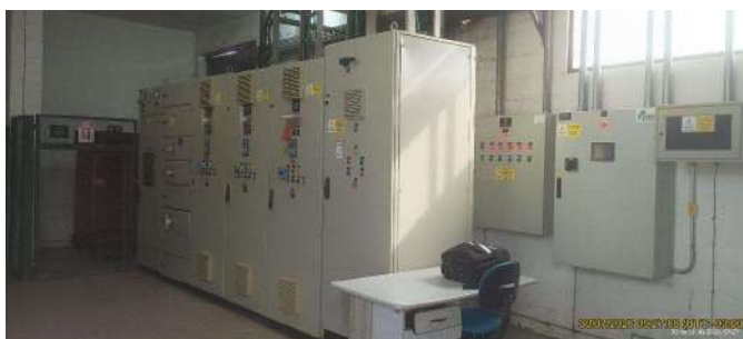
Foto 47 - Vista interna de parte dos equipamentos elétricos da estação elevatória.
