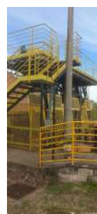
Foto 37 - Sistema de gradeamento.
