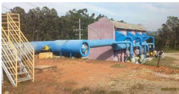
Foto 76 - Segundo abrigo dos sopradores.
