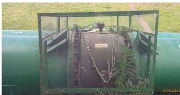
Foto 51 - Medidor de vazão após elevatória do gradeamento.
