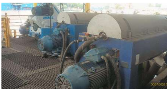
Foto 56 - Centrífugas de lodo.
