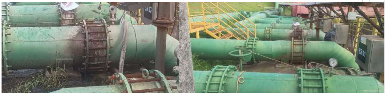
Foto 1 - Vazamentos identificados no momento da fiscalização.
