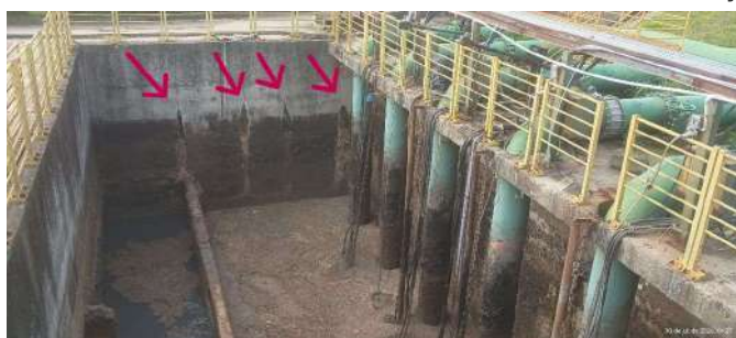
Foto 10 - Tanque de sucção do bombeamento, com indicação dos locais com vazamentos na parede.
