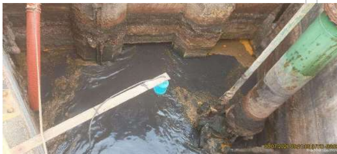
Foto 35 - Sensor de nível do gradeamento.
