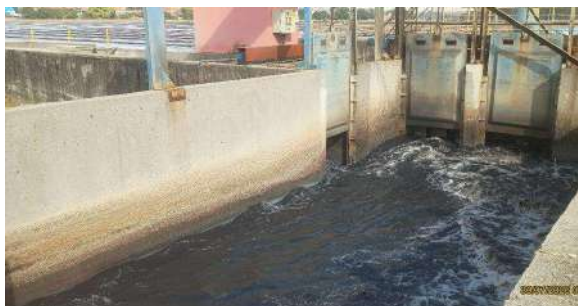
Foto 72 - Ponto de distribuição das vazões do esgoto para as lagoas de aeração.
