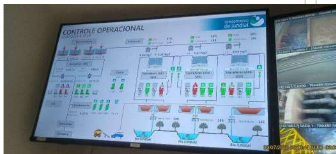
Foto 29 - Tela do sistema de controle operacional da ETEJ.
