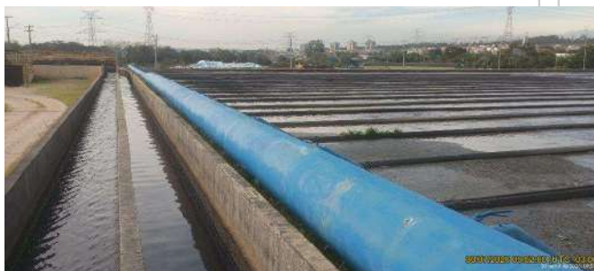
Foto 71 - Canal de distribuição das vazões do esgoto para as lagoas de aeração.
