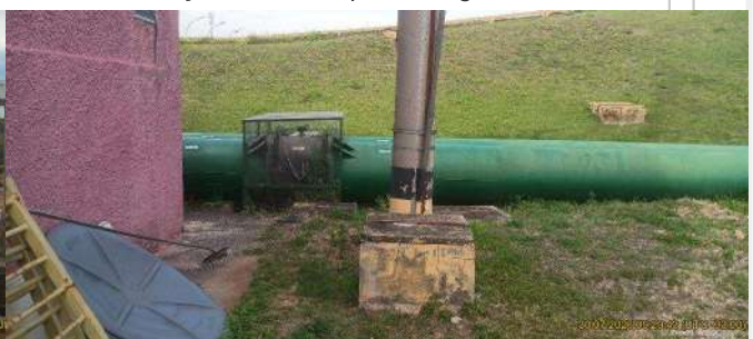
Foto 50 - Medidor de vazão pós bombeamento do esgoto (antes dos desarenadores).
