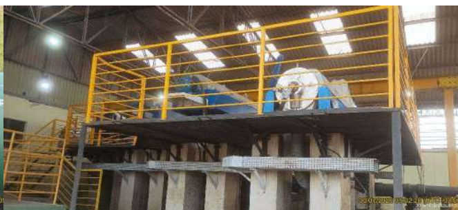
Foto 52 - Centrífugas de lodo.
