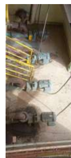
Foto 61 - Conjuntos motobomba de recalque do lodo para as centrífugas.
