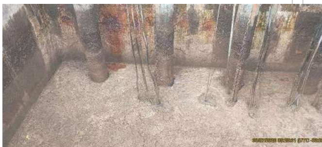
Foto 41 - Vista interna do tanque de sucção e tubulações de recalque do esgoto.
