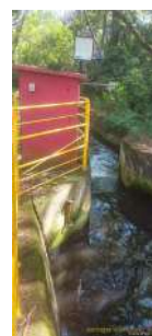
Foto 84 - Abrigo do medidor de vazão.
