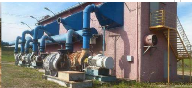
Foto 77 - Segundo abrigo dos sopradores.
