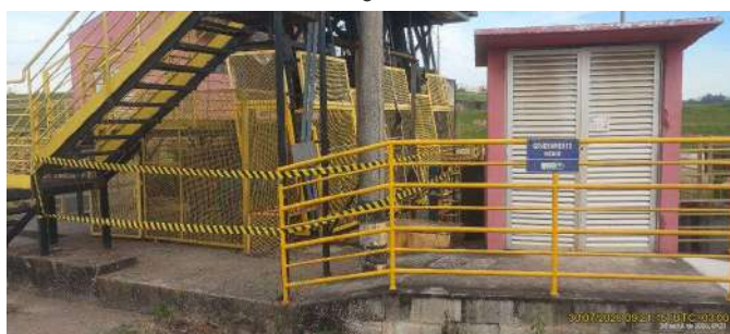
Foto 36 - Sistema de gradeamento.
