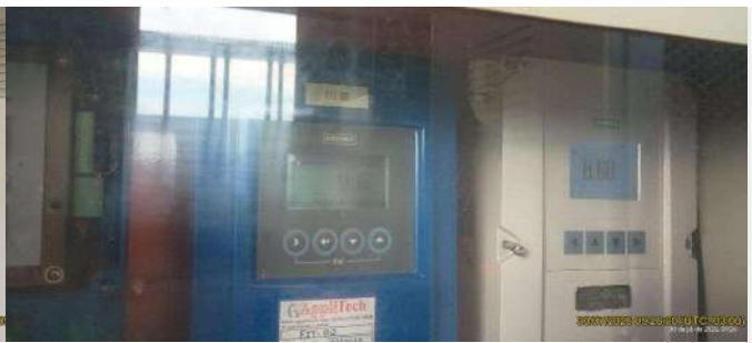
Foto 43 - Vista interna de parte dos equipamentos elétricos da estação elevatória.
