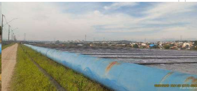
Foto 75 - Lagoas de aeração e tubulação (azul) de distribuição de ar dos sopradores.
