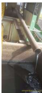
Foto 60 - Chegada do lodo das lagoas.
