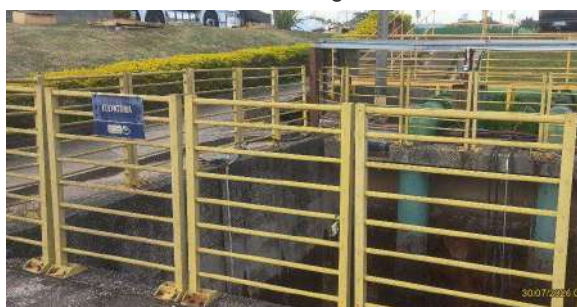
Foto 38 - Tanque de sucção das bombas da elevatória pós-gradeamento.
