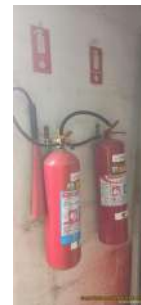
Foto 45 - Extintores de incêndio do local.
