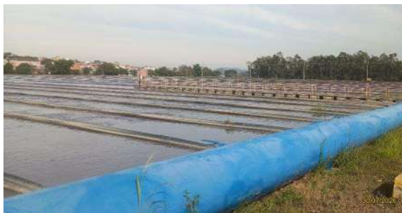
Foto 74 - Lagoas de aeração e tubulação (azul) de distribuição de ar dos sopradores.
