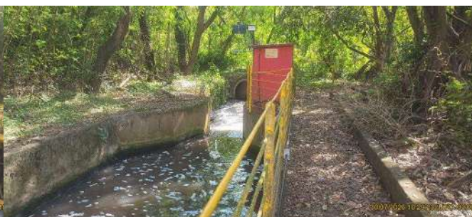
Foto 87 - Abrigo do medidor de vazão. Medição apenas instantânea, sem telemetria e sem registros contínuos.
