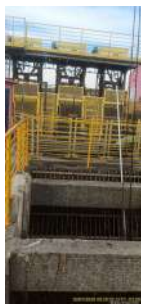
Foto 34 - Sistema de gradeamento.
