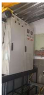
Foto 17 - Painel elétrico e de comando da EEE.
