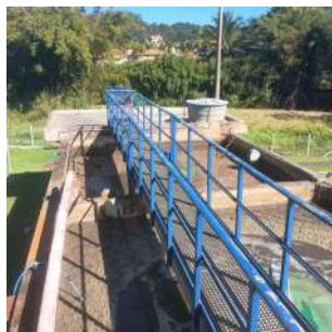
Foto 8 - Visa dos tanques de aeração da ETE.
