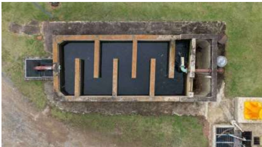
Foto 15 - Sistema de desinfecção (chicanas) da ETE.
