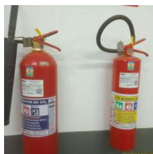
Foto 13 - Extintores de incêndio do local.
