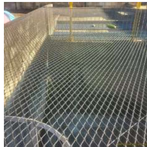
Foto 4 - Tela de cobertura do tanque de acúmulo e, ao fundo, chegada de esgoto.
