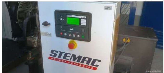
Foto 20 - Gerador instalado no local.
