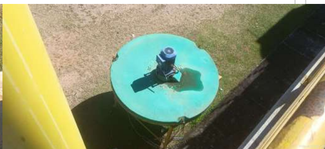
Foto 20 - Equipamento reserva da ETE.
