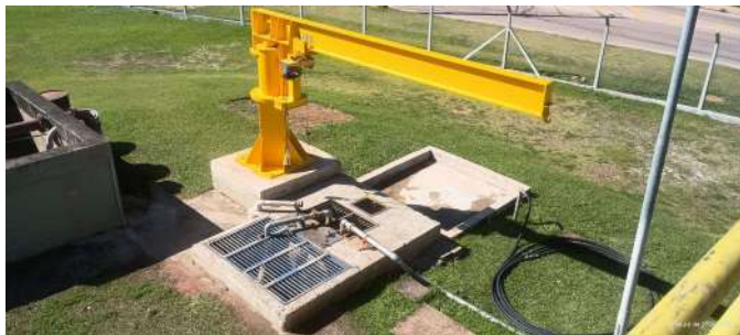
Foto 5 - Entrada do esgoto e EEE de recalque para o início do tratamento.
