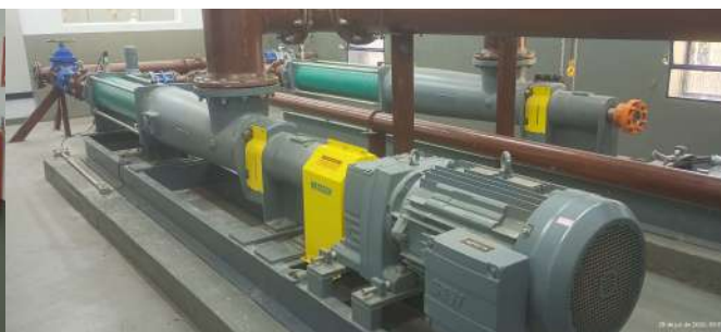
Foto 15 - Conjuntos motobomba novos da EEE.
