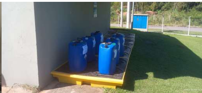
Foto 20 - Produtos químicos armazenados na ETE.
