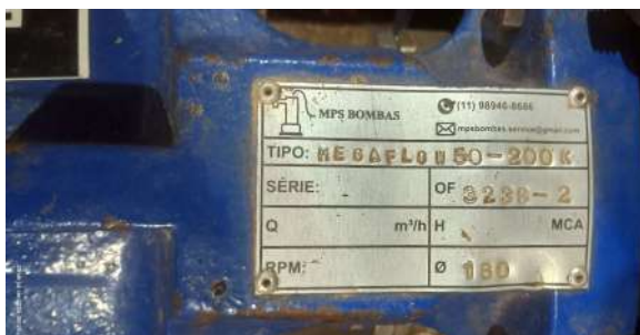
Foto 30 - Placa de especificações técnicas da bomba do conjunto motobomba do meio.
