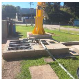
Foto 4 - Entrada do esgoto e EEE de recalque para o início do tratamento.
