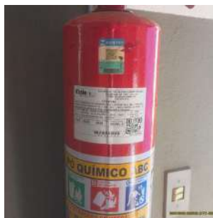
Foto 10 - Validade do extintor de incêndio.
