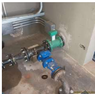
Foto 11 - Medidor de vazão na saída do recalque.
