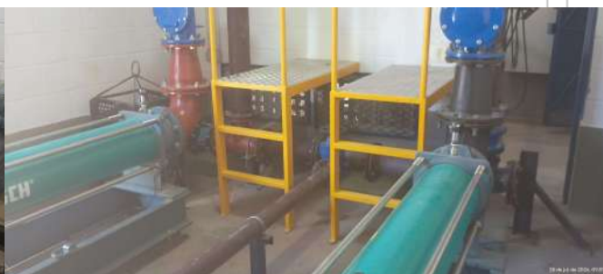
Foto 10 - Conjuntos motobomba da EEE.
