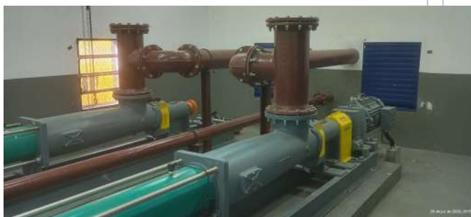
Foto 21 - Vista geral dos conjuntos motobomba.
