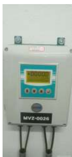
Foto 20 - Visor do medidor de vazão da nova casa de bombas.
