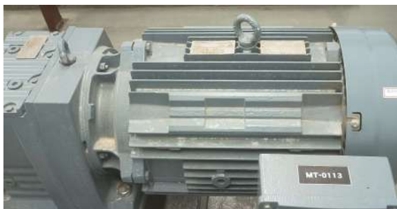
Foto 16 - Motor do conjunto motobomba 1
