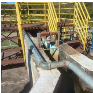
Foto 7 - Calha Parshal e medidor de vazão.
