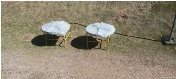
Foto 21 - Equipamento reserva da ETE.
