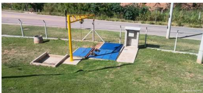
Foto 1 - Vista da EEE.
