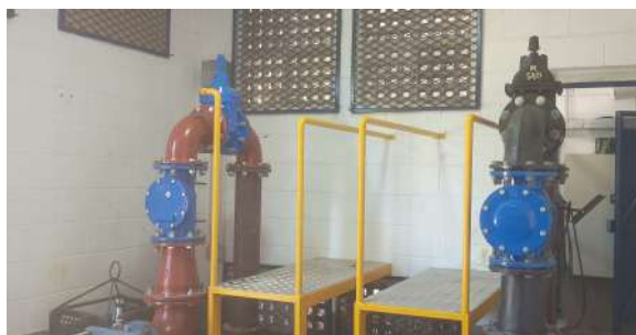
Foto 11 - Barrilete de recalque.
