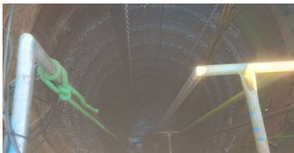
Foto 11 - Vista interna do tanque de sucção da EEE.
