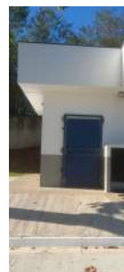
Foto 34 - Abrigo do segundo gerador da EEE.
