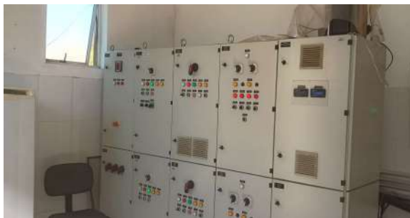
Foto 19 - Painéis elétricos e de comando da ETE.
