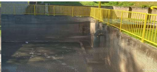
Foto 24 - Tanque pulmão, coberto com tela para evitar entrada de materiais que possam danificar os equipamentos.
