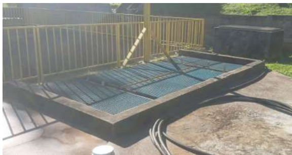
Foto 23 - Gradeamento na segunda entrada de esgoto.
