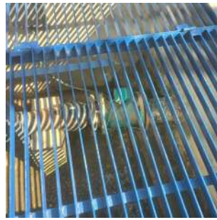
Foto 6 - Medidor de vazão da EEE.
