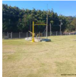
Foto 9 - EEE na chegada do esgoto na ETE.
