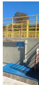
Foto 22 - Tanque de contato para desinfecção.
