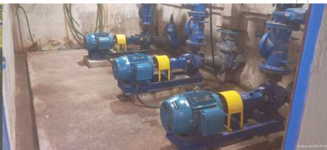
Foto 26 - Vista interna dos conjuntos motobomba da antiga casa de bombas.
