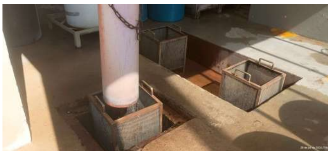
Foto 26 - Cestos de desaguamento do material retido no gradeamento fino.
