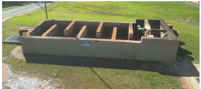
Foto 16 - Sistema de desinfecção (chicanas) da ETE.
