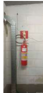
Foto 18 - Extintor de incêndios do local.
