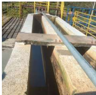
Foto 6 - Tratamento preliminar (gradeamento e caixa desarenadora)
