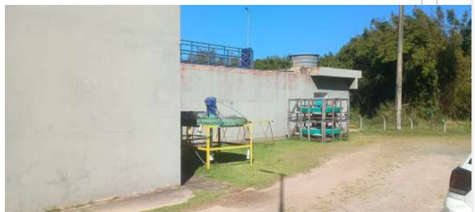
Foto 18 - Equipamentos reservas de aeração dos tanques da ETE.
