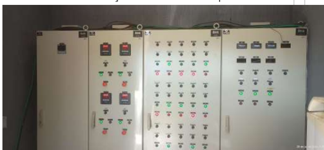
Foto 29 - Vista geral dos painéis elétricos e de comando da ETE.
