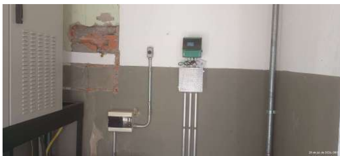
Foto 18 - Medidor de vazão da EEE.
