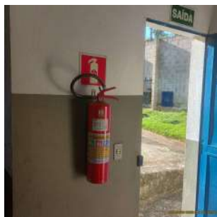
Foto 9 - Extintor de incêndio da EEE.
