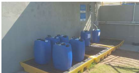
Foto 27 - Dosagem de hipoclorito para desinfecção.
