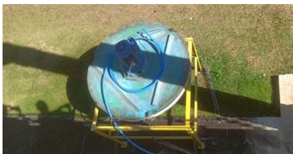
Foto 19 - Equipamento reserva da ETE.
