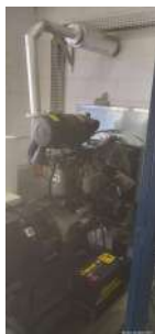
Foto 19 - Gerador instalado no local.
