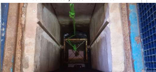
Foto 14 - Cesto de gradeamento.
