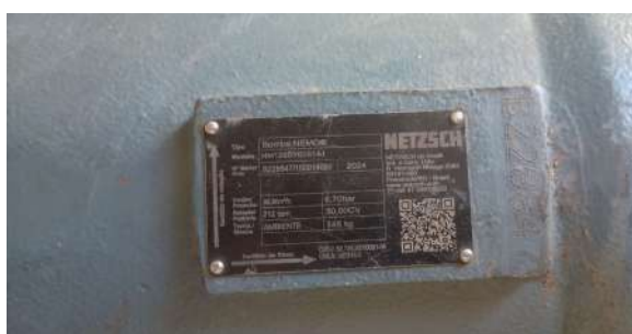
Foto 13 - Placa de especificações técnicas da bomba de um dos conjuntos motobomba.
