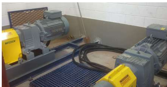
Foto 9 - Conjuntos motobomba da EEE.
