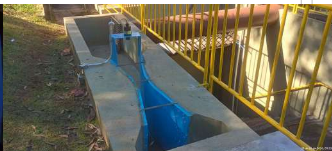
Foto 31 - Medidor de vazão para casos de extravasamento de esgoto.
