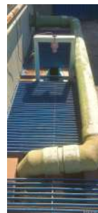
Foto 24 - Medidor de vazão na saída.
