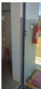
Foto 25 - Um dos extintores de incêndio da ETE.
