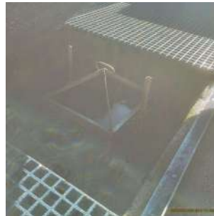
Foto 2 - Cesto de gradeamento de uma das linhas de entrada.
