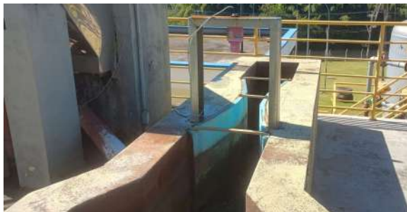
Foto 17 - Calha Parshall e medidor de vazão.
