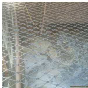
Foto 6 - Fundo do tanque de acúmulo e bombas submersas.
