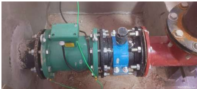
Foto 21 - Medidor de vazão da saída.
