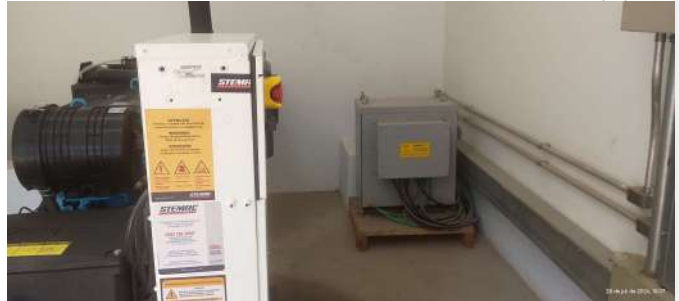
Foto 8 - Gerador situado na ETE.
