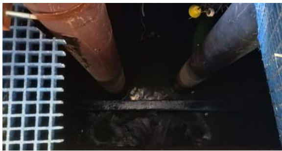
Foto 15 - Tanque de sucção.
