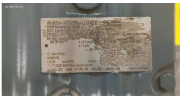
Foto 18 - Placa de especificações técnicas do motor do conjunto 1.
