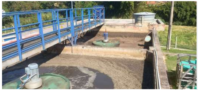
Foto 10 - Vista dos tanques de aeração da ETE.
