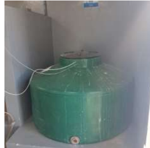
Foto 8 - Armazenamento e bomba dosadora de Cloro
