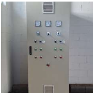
Foto 5 - Painel de comando e controle dos conjuntos de recalque
