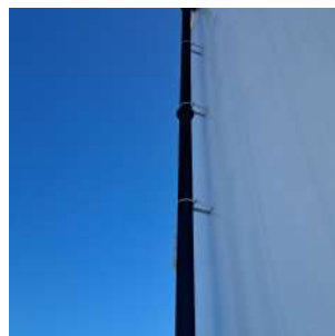
Foto 5 - Descida do tubo extravasor do reservatório apoiado Cedrinho
