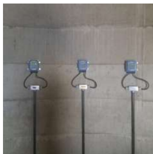
Foto 4 - Display do medidores de vazão localizado no reservatório Cedrinho elevado
