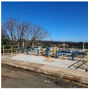
Foto 7 - Caixa de passagem para os reatores UASB
