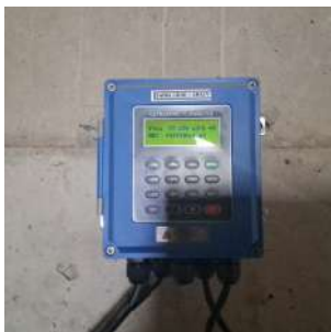
Foto 11 - Display do medidor de vazão localizado no reservatório elevado Cedrinho da saída CDHU/Aracy
