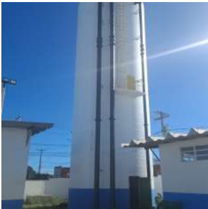
Foto 1 - Vista do reservatório Cedrinho elevado mostrando as tubulações de entrada do poço, do recalque Cedrinho e o extravasor
