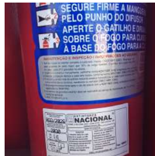
Foto 10 - Extintor de incêndio (dentro da validade)
