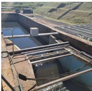
Foto 14 - Dosagem PAC Férrico
