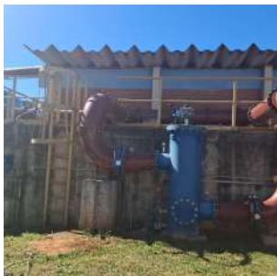
Foto 18 - Filtro antes das câmaras de saturação
