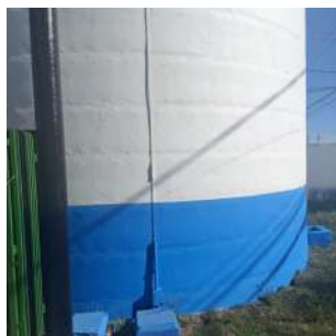
Foto 7 - Sistema de aterramento do SPDA do reservatório Cedrinho elevado
