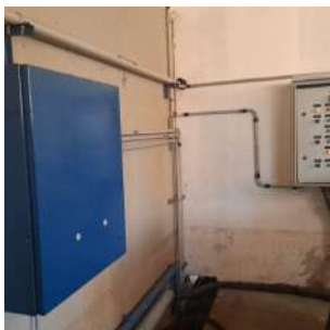
Foto 20 - Painéis do sistema de saturação
