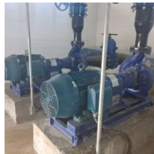
Foto 6 - Conjuntos motobombas com capacidade nominal de 250m³/h
