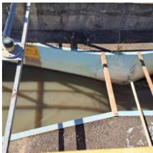
Foto 5 - Calha parshal com medição de vazão
