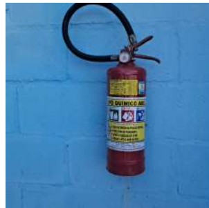
Foto 23 - Extintor de incêndio
