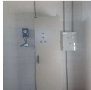
Foto 4 - Painel de automação da telemetria e dosadoras de cloro e flúor
