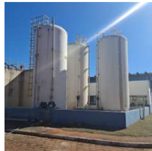
Foto 13 - Armazenamento de produto químico com bacia de contenção
