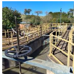
Foto 4 - Guarda-corpos no tratamento preliminar
