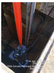
Foto 3 - Evidência da bomba reserva instalada no poço de sucção fornecida pelo SAAE em 17/08/2026
