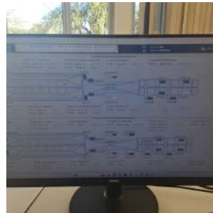
Foto 31 - Tela do centro de controle operacional mostrando a medição de vazão da entrada
