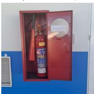
Foto 7 - Extintor de incêndio
