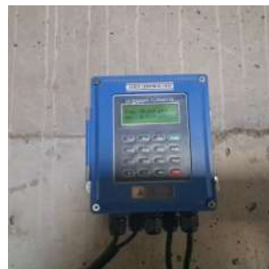
Foto 12 - Display do medidor de vazão localizado no reservatório elevado Cedrinho da saída Cedrinho/MRV
