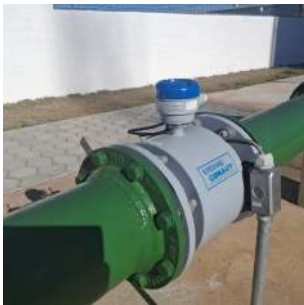
Foto 2 - Macromedidor de vazão do poço Cedrinho
