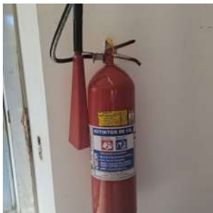
Foto 32 - Extintor de incêndio
