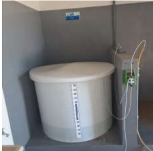
Foto 7 - Armazenamento e bomba dosadora de flúor
