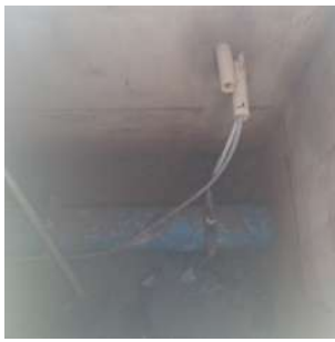
Foto 5 - Ponto de dosagem do cloro e flúor
