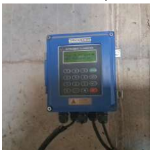
Foto 13 - Display do medidor de vazão localizado no reservatório elevado Cedrinho da saída Maracanã
