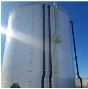
Foto 6 - Tubulações de entrada de água
