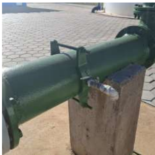
Foto 3 - Tomada para coleta de água bruta
