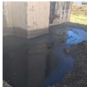
Foto 4 - Detalhe do vazamento próximo ao tanque de lodo
