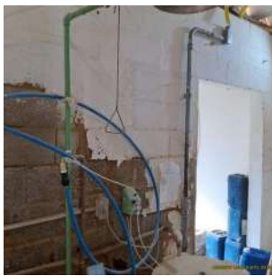
Foto 3 - Chuveiro de emergência.
