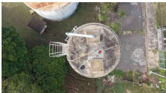
Foto 1 - Topo do reservatório sem guarda-corpo
