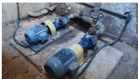
Foto 4 - Há dois conjuntos moto-bomba instalados, um em funcionamento e o segundo como reserva.
