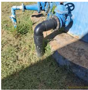
Foto 9 - Tubulação de distribuição.
