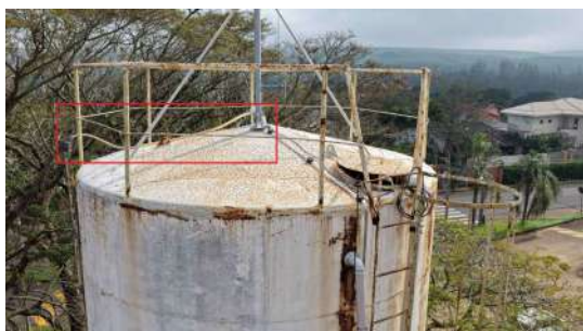
Foto 1 - Abertura de ventilação do reservatório, utilizada aparentemente para a adição de produto químico (retângulo vermelho).
