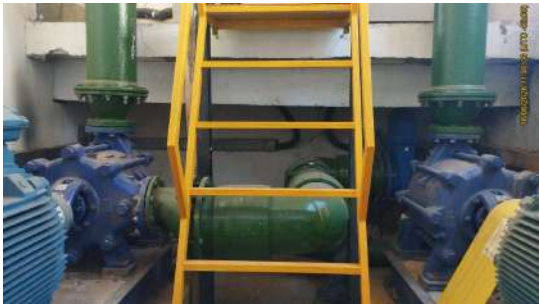
Foto 3 - Vista geral das tubulações e escada de acesso aos conjuntos motobomba (Capotuna).
