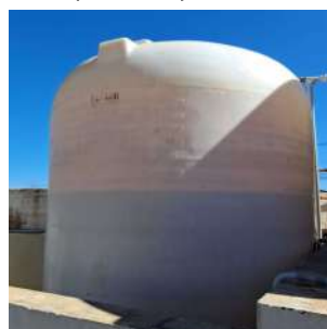
Foto 4 - Tanque de armazenamento sem identificação.
