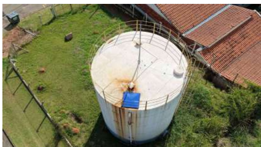
Foto 3 - Reservatório com diversas áreas com ferrugem.
