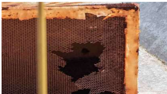
Foto 1 - Tela de proteção deteriorada.
