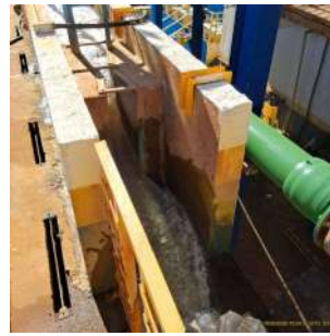
Foto 47 - Saída da calha Parshall.
