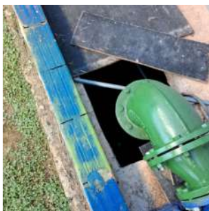
Foto 3 - Aberturas junto aos pontos de recalque, expondo a água tratada ao ambiente externo.
