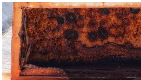
Foto 4 - Abertura de ventilação sem tela de proteção, com estrutura apresentando elevado grau de corrosão.
