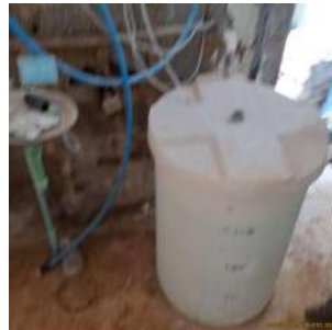
Foto 6 - Tanque de produto químico.
