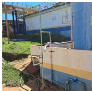
Foto 83 - Chuveiro de emergência.
