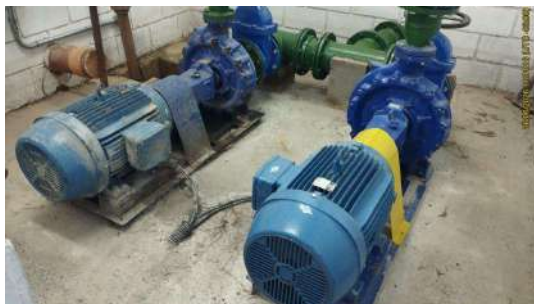
Foto 3 - Há dois conjuntos moto-bomba instalados, um em funcionamento e o segundo como reserva.
