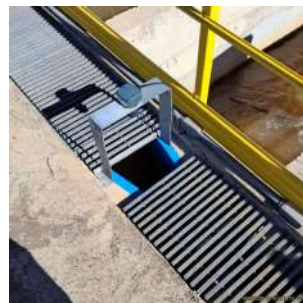
Foto 25 - Ponto de entrada no modulo 6, com calha Parshall e macromedidor.
