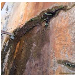
Foto 1 - Vazamento na prede do módulo 1.
