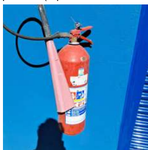
Foto 89 - Extintor de incêndio.
