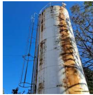
Foto 4 - Sinais de ferrugem na estrutura do reservatório.
