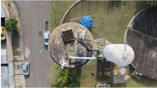
Foto 1 - Topo do reservatório sem guarda-corpo.
