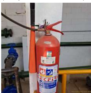
Foto 12 - Extintor de incêndio.
