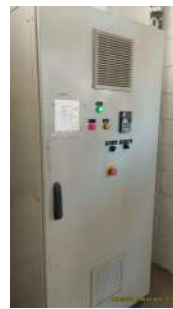
Foto 6 - Painelelétrico do conjunto motobomba 1 (Capotuna).
