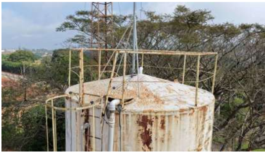
Foto 3 - Sinais de ferrugem na estrutura do reservatório.
