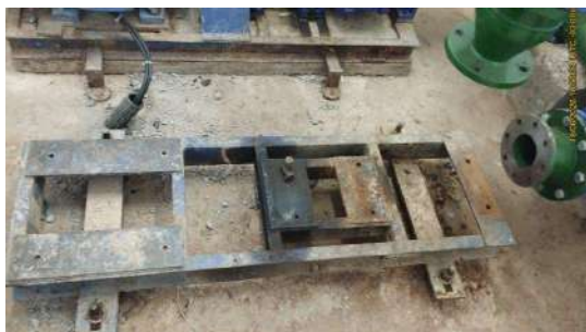
Foto 1 - Detalhe do ponto de instalação do conjunto motobomba reserva.
