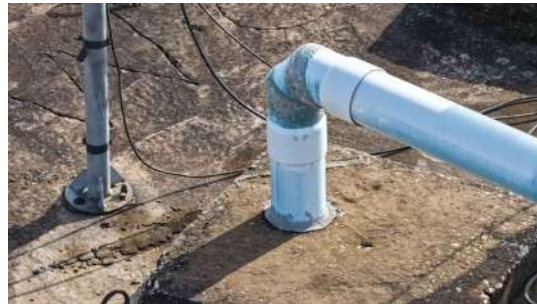
Foto 13 - Ponto de abastecimento detalhado.
