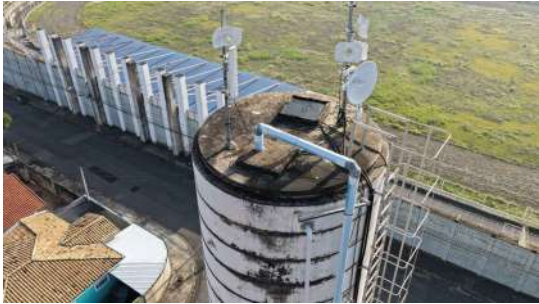
Foto 2 - Topo do reservatório sem guarda-corpo.
