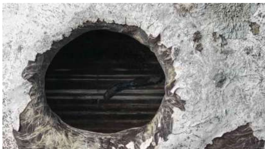
Foto 2 - Tubo extravasor sem tela de proteção.
