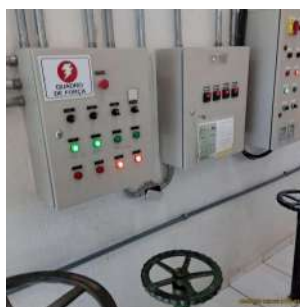
Foto 63 - Painéis elétricos para operação dos módulos.
