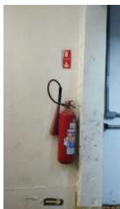
Foto 6 - Extintor de incêndio instalado no interior da edificação.
