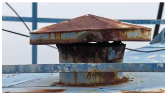
Foto 14 - Tubulação de ventilação.
