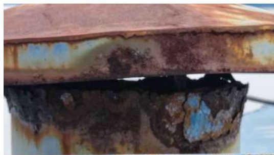
Foto 13 - Tubulação de ventilação.
