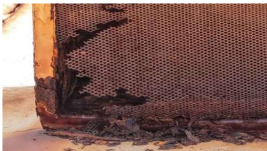
Foto 3 - Tela de proteção deteriorada.
