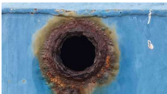
Foto 1 - Tubo extravasor sem tela de proteção.
