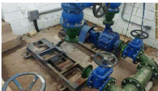
Foto 3 - Vista geral da elevatória.
