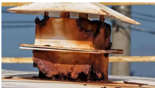
Foto 1 - Tubo de ventilação em elevado estado de corrosão.
