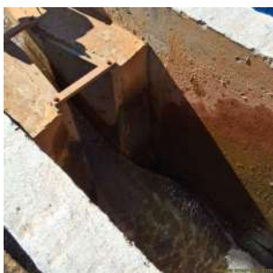
Foto 34 - Saída da calha Parshall.
