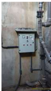
Foto 5 - Pannel elétrico da elevatória.
