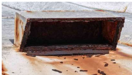
Foto 6 - Abertura de ventilação sem tela de proteção, com estrutura apresentando elevado grau de corrosão.
