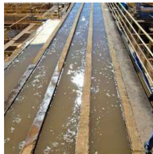
Foto 6 - Canaletas onde se inicia o processo de formação de flocos.
