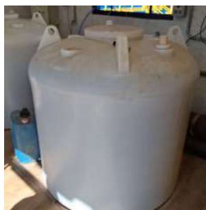
Foto 87 - Tanque de armazenamento de produto químico (hipoclorito de sódio).
