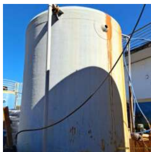
Foto 81 - Tanque de armazenamento de produto químico.
