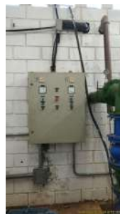
Foto 5 - Painel elétrico da elevatória.
