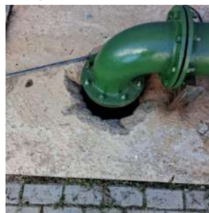
Foto 4 - Aberturas junto aos pontos de recalque, expondo a água tratada ao ambiente externo.
