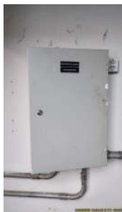
Foto 4 - Painel elétrico da elevatória.
