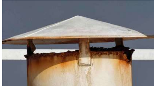
Foto 20 - Tubulação de ventilação.
