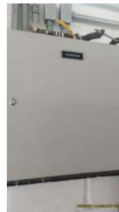
Foto 8 - Painele dos equipamentos de telemetria.
