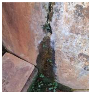
Foto 2 - Vazamento na prede do módulo 1.
