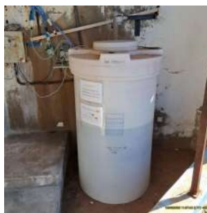
Foto 72 - Tanque de armazenamento de produto químico (hipoclorito de sódio);
