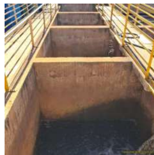
Foto 14 - Conjunto de filtros (módulo 4).
