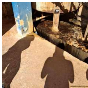
Foto 11 - Canaleta de drenagem da água de descarga dos decantadores e de lavagem dos filtros.
