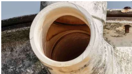
Foto 4 - Tubulação de ventilação sem tela de proteção.
