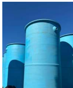
Foto 17 - Tanques de fibra da nova ETA, que entrará em operação em substituição à ETA Ana Helena.
