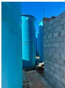
Foto 18 - Tanques de fibra da nova ETA, que entrará em operação em substituição à ETA Ana Helena.
