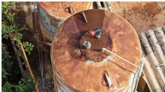
Foto 14 - Vista do topo do floculador/decantador.
