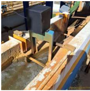
Foto 46 - Calha Parshall e macromedidor instalados na entrada do Módulo 2.
