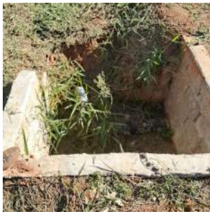
Foto 1 - Abertura sem proteção.
