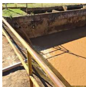
Foto 70 - Lagoa de decantação do lodo gerado na ETA.
