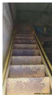
Foto 2 - Escada de acesso aos equipamentos da elevatória.
