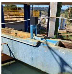
Foto 56 - Calha Parshall e macromedidor instalados na entrada do Módulo 1.
