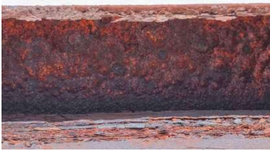
Foto 2 - Proteção metálica da abertura de ventilação com elevado grau de corrosão.
