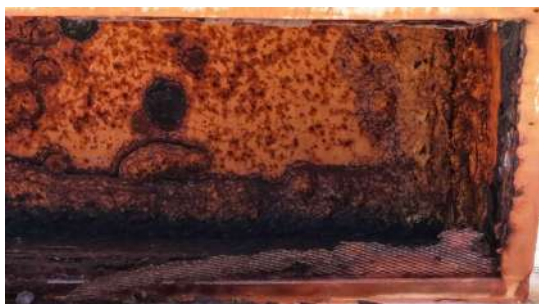
Foto 5 - Abertura de ventilação sem tela de proteção, com estrutura apresentando elevado grau de corrosão.
