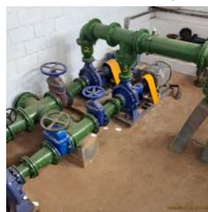
Foto 11 - Vista geral do conjunto de moto-bombas (Nassif)
