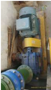
Foto 4 - Detalhe do conjunto moto bomba 1 (Capotuna).
