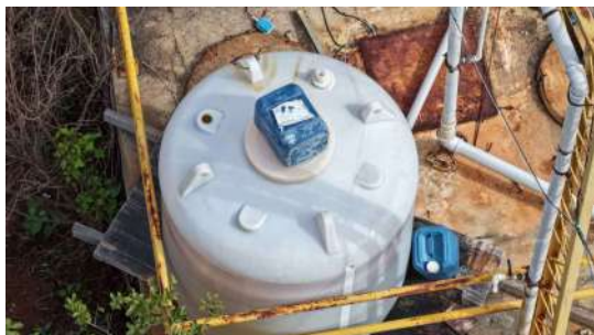
Foto 16 - Tanque de hipoclorito de sódio.
