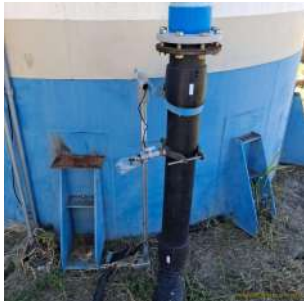
Foto 3 - Sistema de telemetria.
