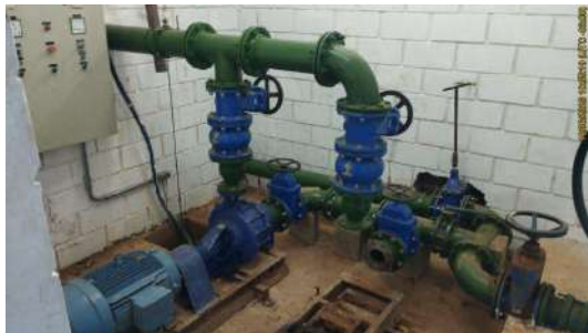
Foto 2 - Vista geral da elevatória.
