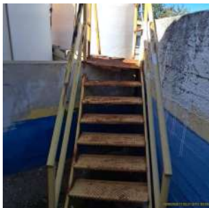
Foto 1 - Escada de acesso ao topo do reservatório com diversos pontos de corrosão.
