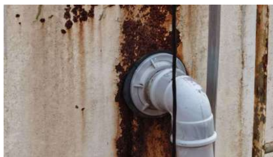
Foto 2 - Sinais de ferrugem na estrutura do reservatório.
