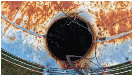
Foto 1 - Abertura do no topo do reservatório permitindo a entrada de contaminantes.
