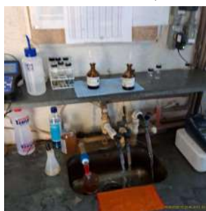
Foto 61 - Torneiras destinadas à coleta de amostras de água nas diferentes etapas do processo de tratamento, localizadas fora do laboratório.
