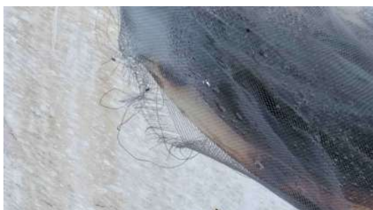
Foto 1 - Tela de proteção com princípio de deterioração.
