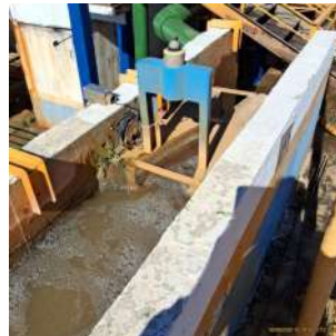
Foto 33 - Calha Parshall e macromedidor instalados na entrada do Módulo 5.
