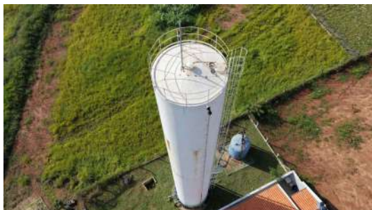
Foto 16 - Vista lateral do reservatório, com destaque para o ponto de abastecimento.
