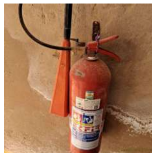
Foto 9 - Extintor de incêndio.
