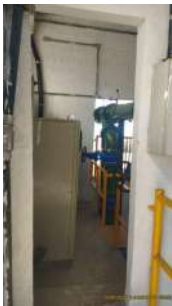
Foto 1 - Sala de bombas da elevatória.
