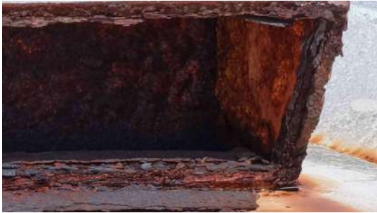
Foto 1 - Proteção metálica da abertura de ventilação com elevado grau de corrosão.
