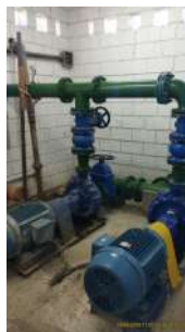
Foto 2 - Vista geral da elevatória.
