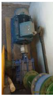
Foto 5 - Detalhe do conjunto moto bomba 2 (Capotuna).
