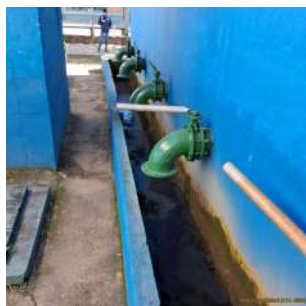
Foto 75 - Pontos de descarga.
