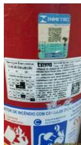
Foto 7 - Detalhe da etiqueta de controle de manutenções do extintor.
