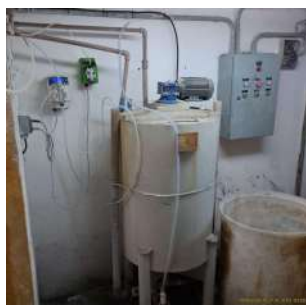
Foto 67 - Tanque de armazenamento de ácido fluossilícico e bomba dosadora.
