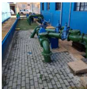
Foto 78 - Tubulação de recalque para os reservatórios.
