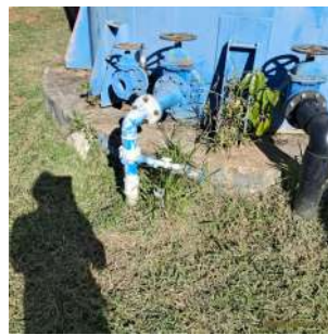
Foto 10 - Tubulação de distribuição.
