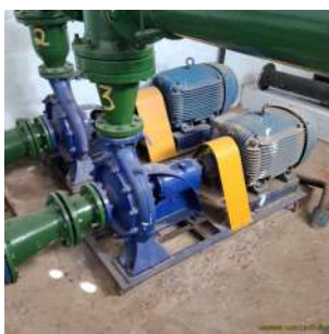
Foto 10 - Conjunto de moto-bombas, sendo uma em operação e outra reserva (Nassif)
