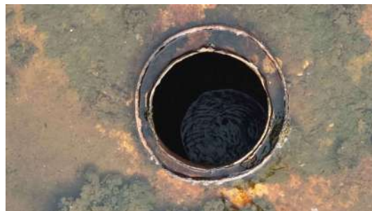
Foto 2 - Tubo de ventilação sem proteção.
