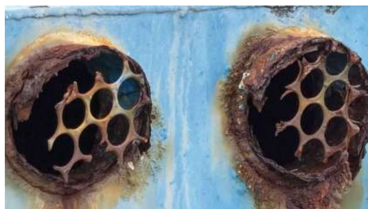
Foto 2 - Tubo extravasor com tela de proteção deteriorada.
