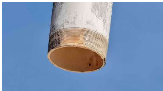
Foto 3 - Tubulação de ventilação sem tela de proteção.
