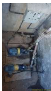
Foto 3 - Vista geral da elevatória.
