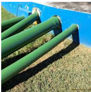
Foto 5 - Tubulações de interligação com a estação de tratamento e os demais reservatórios.
