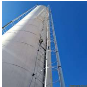
Foto 6 - Detalhe do cabo de aterramento do SPDA.
