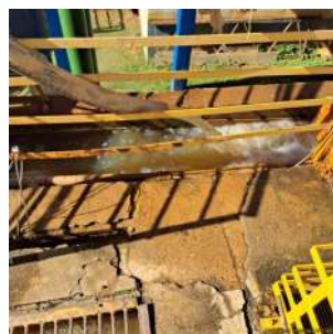
Foto 35 - Mangueira instalada de forma adaptada para direcionar a água bruta ao Módulo 2.
