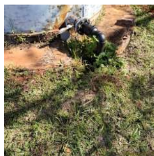
Foto 2 - Tubulação de distribuição.
