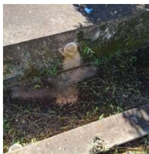
Foto 4 - Tubulação de ventilação com tela de proteção.
