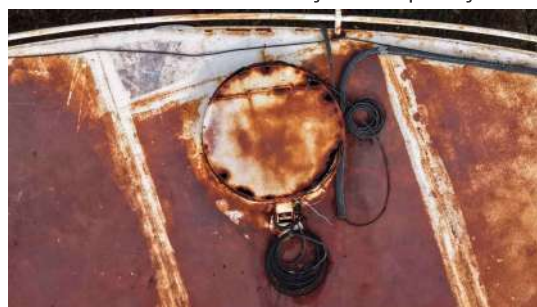
Foto 4 - Reservatório com diversas áreas com marcas de ferrugem.
