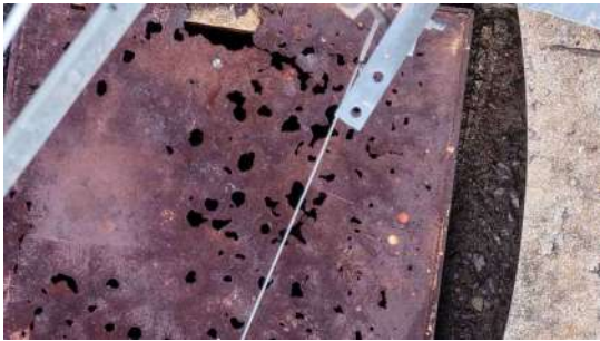
Foto 1 - Tampa de inspeção deteriorada.
