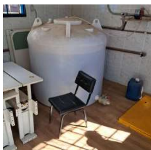
Foto 3 - Tanque de armazenamento de produto químico sem dique de contenção e sem a devida identificação. Adicionalmente, observa-se que a sala aparenta ser utilizada como ambiente de permanência de operador, situação incompatível com o armazenamento de produtos químicos.
