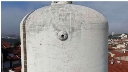
Foto 1 - Tubo extravasor sem tela de proteção.
