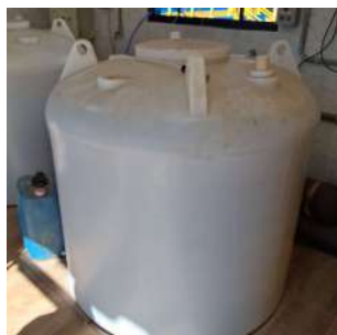
Foto 1 - Tanque de armazenando de produto químico sem dique de proteção e identificação.
