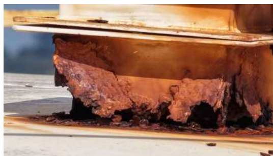
Foto 2 - Tubo de ventilação em elevado estado de corrosão.
