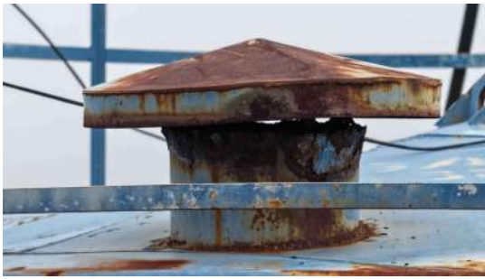
Foto 3 - Tubo de ventilação sem tela de proteção.
