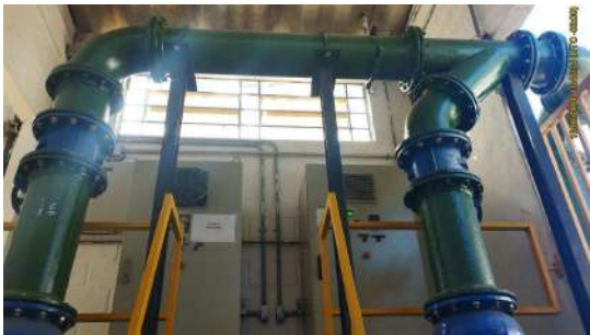
Foto 2 - Vista geral das tubulações e escada de acesso aos conjuntos motobomba (Capotuna).
