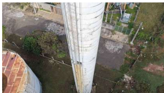
Foto 13 - Cabo de aterramento do SPDA.
