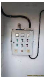
Foto 4 - Painel elétrico da elevatória.
