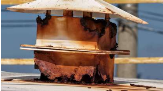
Foto 12 - Tubo de ventilação.
