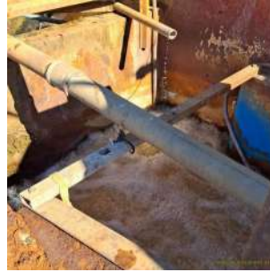
Foto 2 - Ponto de adição de produto químico (PAC).
