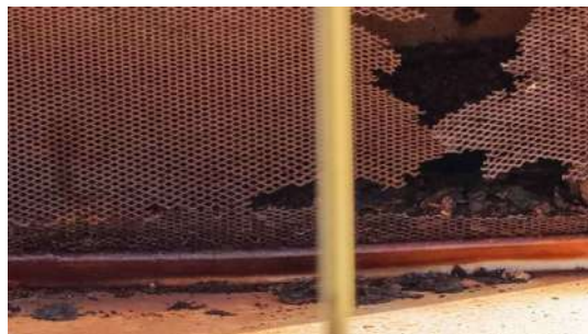
Foto 2 - Tela de proteção deteriorada.
