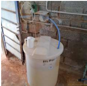
Foto 5 - Tanque de produto químico.
