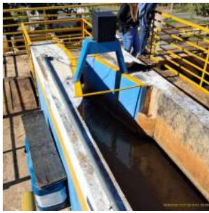
Foto 9 - Calha Parshall e macromedidor instalados na entrada do Módulo 4.
