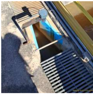
Foto 17 - Calha Parshall e macromedidor instalados na entrada do Módulo 5.
