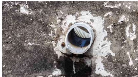
Foto 17 - Tubo pra liberação da água acumulada na parte superior do reservatório.
