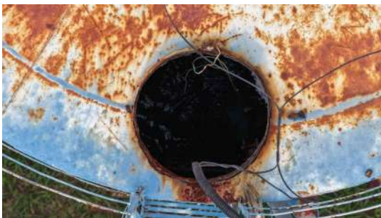
Foto 1 - Abertura de inspeção sem tampa.
