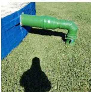
Foto 3 - Tubulação de interligação com os demais reservatórios.
