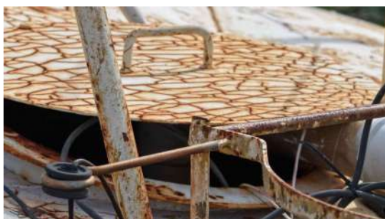
Foto 1 - Tampa de inspeção sem vedação adequada em razão da instalação da tubulação de abastecimento.
