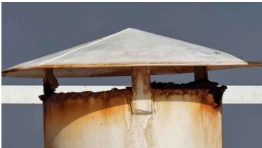
Foto 1 - Tubulação de ventilação sem tela de proteção.
