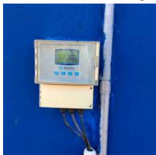
Foto 85 - Um dos displays de monitoramento da vazão, com indicação das leituras dos macromedidores instalados nos pontos de entrada de cada módulo da ETA.
