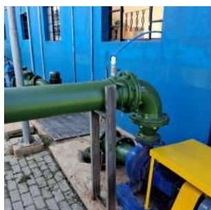
Foto 88 - Tubulação de saída da água tratada, após os processos de desinfecção e fluoretação. A partir desse ponto, a água é recalçada para os reservatórios.
