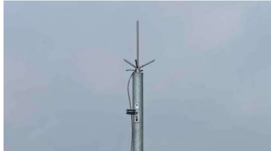
Foto 3 - Para-raios (instalado no reservatório elevado).
