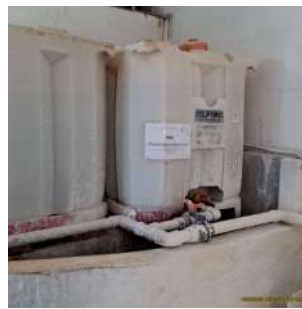
Foto 4 - Tanque de PAC (policloreto de alumínio).
