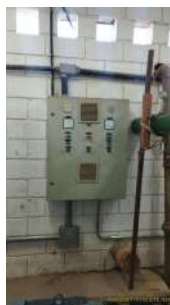
Foto 5 - Painel elétrico da elevatória.
