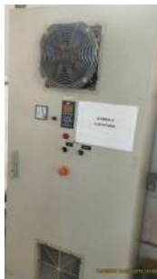
Foto 7 - Painelelétrico do conjunto motobomba 2 (Capotuna).
