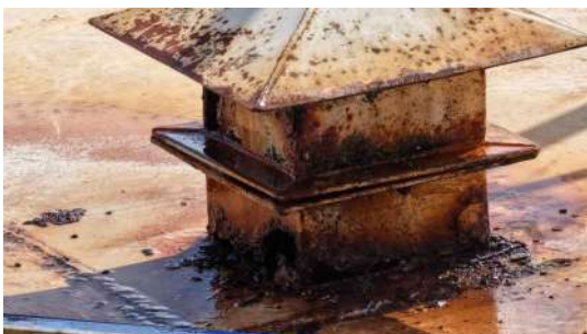
Foto 16 - Tubo de ventilação.
