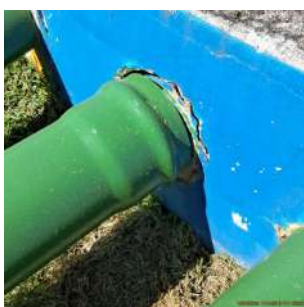
Foto 1 - Abertura ao redor da passagem da tubulação pela parede do reservatório.
