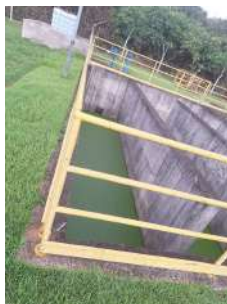
Foto 3 - Tanque de contato do cloro sem passagem do efluente tratado.
