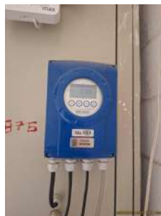
Foto 8 - Conversor do macromedidor
