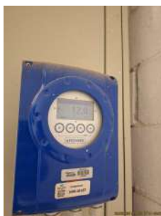
Foto 9 - Conversor do macromedidor
