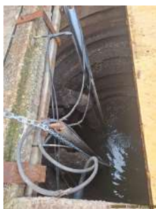
Foto 5 - Poço de sucção
