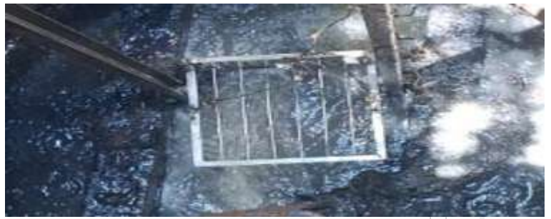
Foto 2 - Gradeamento instalado - evidência do prestador
