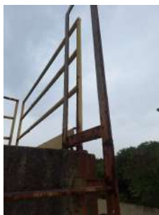
Foto 1 - Escada de acesso com estrutura oxidada
