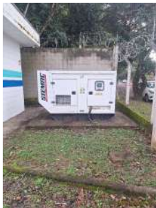
Foto 2 - Gerador de energia
