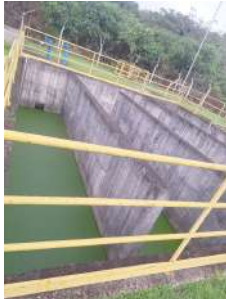
Foto 7 - Tanque de contato de cloro com chicanas
