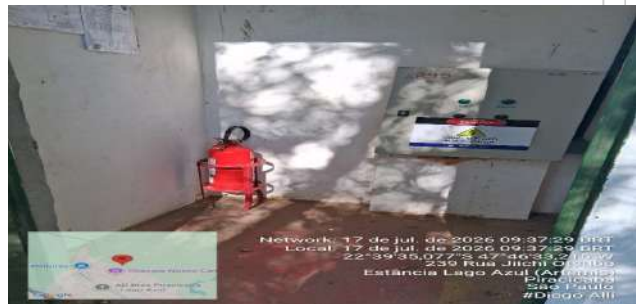
Foto 2 - Extintor instalado - evidência do prestador
