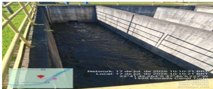
Foto 4 - Tanque de contato do cloro funcionando - evidência do prestador
