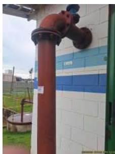
Foto 7 - Linha de recalque
