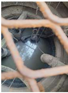
Foto 1 - Um conjunto motobomba instalado
