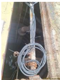
Foto 5 - Poço de sucção com dois conjuntos motobomba instalados
