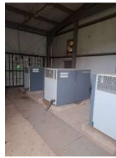
Foto 6 - Sala de sopradores
