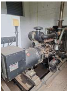
Foto 5 - Gerador e energia
