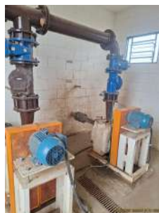
Foto 6 - Dois conjuntos motobombas instalados
