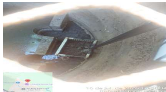
Foto 2 - Gradeamento instalado - evidência do prestador
