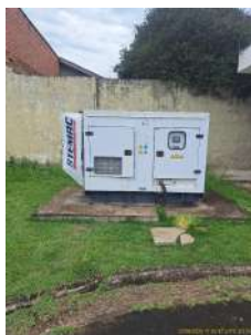
Foto 3 - Gerador de energia
