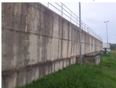
Foto 3 - Visão geral lateral - taques de aeração
