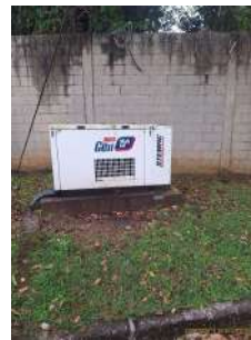
Foto 2 - Gerador de energia
