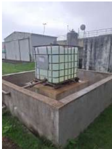
Foto 9 - Tanque de hipoclorito de sódio
