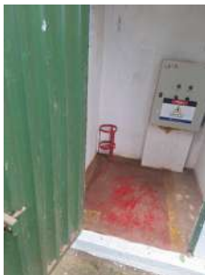
Foto 1 - Local destinado a extintor sem o equipamento
