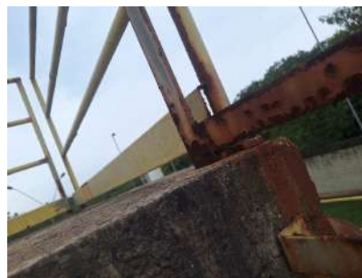
Foto 2 - Detalhe de estrutura oxidada
