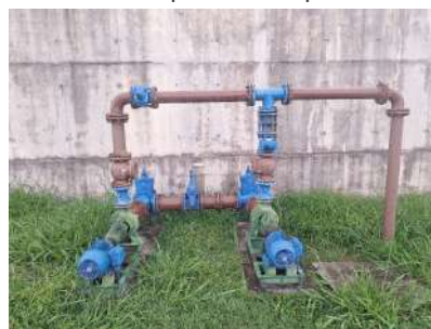
Foto 4 - Recirculação do lodo
