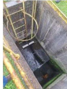
Foto 8 - Medidor parshall na saída do efluente com sensor de macromedição
