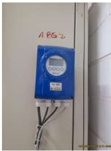
Foto 7 - Conversor do macromedidor
