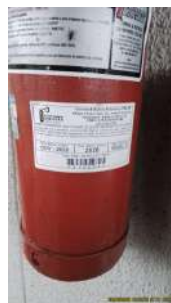
Foto 8 - Validade do extintor das centrífugas.
