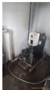
Foto 67 - Sistema atual de recalque de água do poço.
