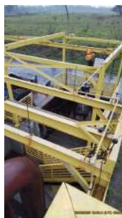
Foto 25 - Poço de chegada com concha de limpeza, trole e talha.
