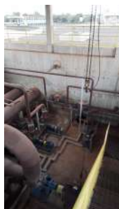
Foto 101 - EEE dos decantadores secundários 1, 2 e 3.
