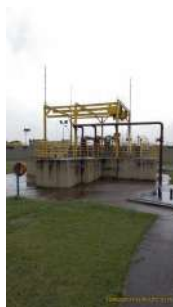
Foto 53 - Recirculação de lodo.
