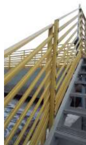
Foto 4 - Corrimão solto no reator aeróbio 6.
