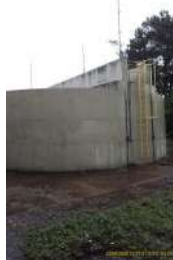
Foto 11 - Reservatório de adensamento de lodo.
