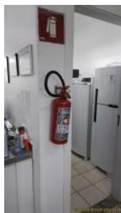
Foto 17 - Extintor do laboratório.
