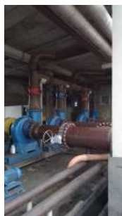
Foto 127 - Recirculação de lodo aquecido para os biodigestores.
