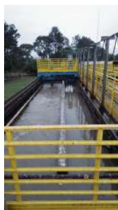
Foto 33 - Duas caixas de areia e gordura.
