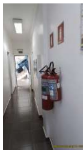
Foto 4 - Extintores do laboratório.
