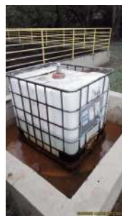
Foto 65 - Armazenamento do hipoclorito de sódio para água de reúso.
