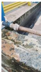
Foto 3 - Vazamento de água de reúso no tratamento preliminar.
