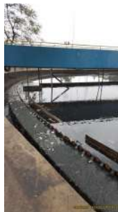
Foto 4 - Reparar defletor ausente no decantador secundário 1.
