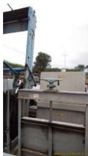
Foto 41 - Última peneira automática instalada.
