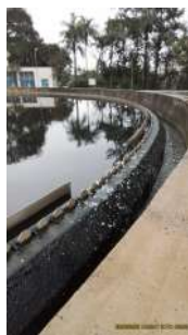
Foto 5 - Reparar defletor ausente no decantador secundário 2.
