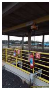
Foto 80 - Extintor dos decantadores secundários.
