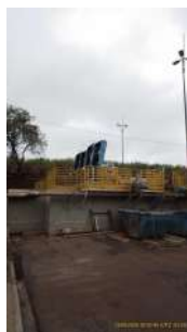
Foto 39 - Vista do tratamento preliminar.
