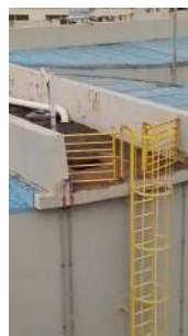
Foto 6 - Abertura no topo do tanque Tampão 2 sem proteção contra queda.
