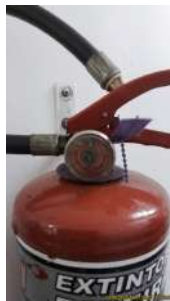
Foto 6 - Pressão do extintor do laboratório.
