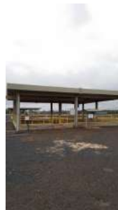
Foto 100 - EEE dos decantadores secundários 1, 2 e 3.
