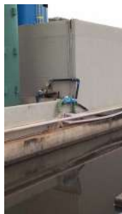
Foto 144 - Macromedidor do poço.
