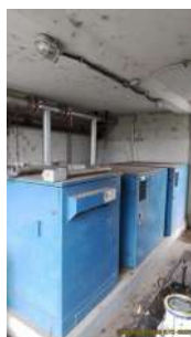
Foto 39 - Sopradores do preliminar.
