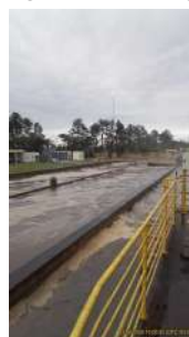
Foto 42 - Carrossel 2 de lodos ativados por aeração prolonga com detenção de 14 dias.
