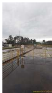
Foto 40 - Carrossel 2 de lodos ativados por aeração prolonga com detenção de 14 dias.
