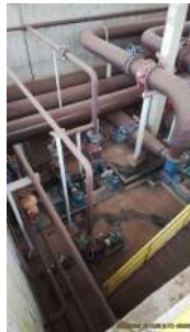
Foto 83 - EEE dos decantadores secundários 4, 5 e 6.
