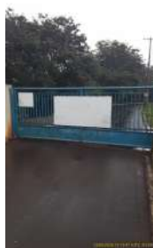
Foto 1 - Placa de identificação no portão de acesso apagada.
