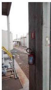
Foto 111 - Extintor do tratamento de lodo.
