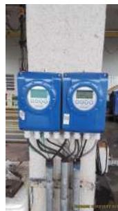
Foto 12 - Registro de vazão de lodo na centrífuga.
