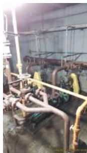
Foto 9 - Sistema de elevatória do lodo para centrifugação.
