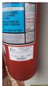
Foto 61 - Validade do extintor do decantador primário.
