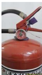
Foto 8 - Pressão do extintor do laboratório.
