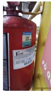
Foto 82 - Validade do extintor.
