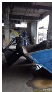
Foto 32 - Concha e caçambe de remoção de resíduos sólidos da EEE.
