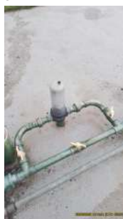
Foto 70 - Sistema de pastilha para adição de produtos químicos.
