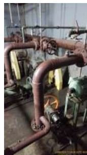
Foto 10 - Sistema de elevatória do lodo para centrifugação.
