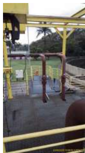
Foto 58 - Descarte de lodo com duas bombas sendo uma reserva.
