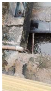
Foto 4 - Vazamento de água de reúso no tratamento preliminar.
