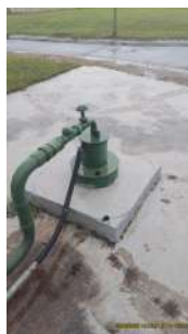
Foto 72 - Laje de proteção do poço e tubo de medição de nível.
