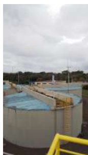
Foto 123 - Vista superior dos tanques adensadores e tampão.
