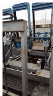
Foto 4 - Instalar equipamento de gradeamento fino ausente para manutenção.
