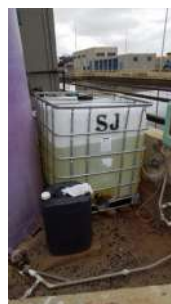
Foto 141 - Hipoclorito para água do poço e reúso.
