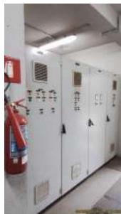
Foto 18 - CCE comando de motores com extintor.
