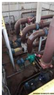
Foto 79 - EEE dos decantadores secundários 4, 5 e 6.
