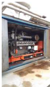
Foto 134 - Motor 2 de cogeração próximo ao gasômetro.
