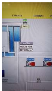
Foto 150 - CCO ETE Caiçara. Vazão no momento da fiscalização.
