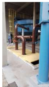
Foto 112 - No chão a câmara de mistura de lodo do decantador secundário flotado com o lodo do primário adensado.
