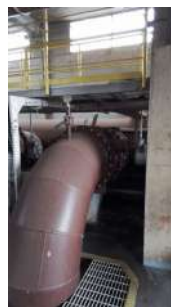
Foto 2 - Vazamento na retenção da bomba C da EEE de chegada.
