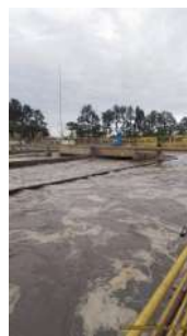
Foto 44 - Carrossel 1 de lodos ativados por aeração prolonga com detenção de 14 dias.
