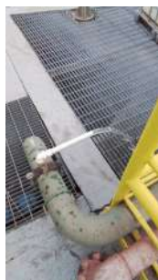
Foto 146 - Tomada de água bruta do poço.
