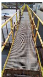
Foto 1 - Corrosão no guarda-corpo e gradil do reator aeróbio 1.
