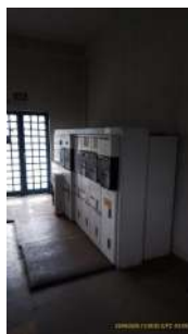
Foto 15 - Trafo da ETE.
