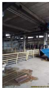
Foto 28 - Vista interna da EEE de chegada.
