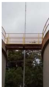
Foto 7 - Corrosão na viga da passarela entre os biodigestores 2 e 3.
