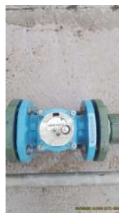
Foto 69 - Macromedidor do poço.
