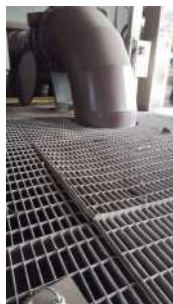
Foto 1 - Corrigir gradil desencaixada na passarela da EEE de chegada.
