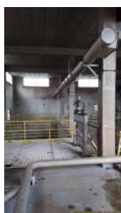
Foto 29 - Vista interna da EEE de chegada.
