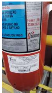
Foto 81 - Validade do extintor.
