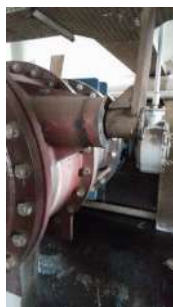
Foto 1 - Vazamento na retenção da bomba C da EEE de chegada.
