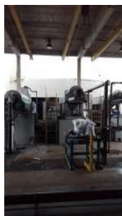
Foto 107 - Três centrífugas de lodo.
