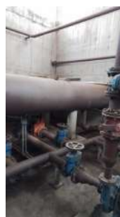
Foto 8 - Vazamento na válvula da EEE dos decantadores secundários 1, 2 e 3..
