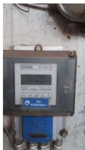
Foto 103 - Medidor de vazão de lodo.
