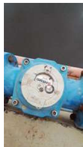
Foto 145 - Macromedidor do poço.
