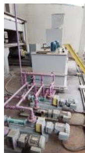
Foto 108 - Sistema de preparação e dosagem de polímero no lodo.
