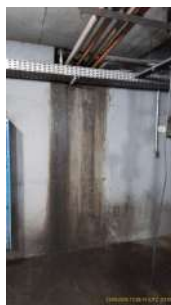
Foto 1 - Vazamento na parede subterrânea da EEE de lodo para a centrífuga.
