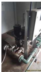
Foto 66 - Novo sistema ainda inoperante de recalque de água do poço.
