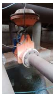
Foto 7 - Vazamento na válvula da EEE dos decantadores secundários 1, 2 e 3..
