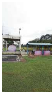
Foto 63 - Sistema de reúso de água com hipoclorito de sódio.
