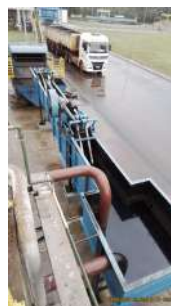
Foto 31 - Sistema de lavagem de areia.
