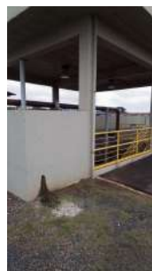
Foto 6 - Vazamento na alvenaria da EEE dos decantadores primários.
