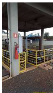
Foto 60 - Extintor EEE decantador primário.
