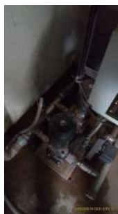
Foto 4 - Vazamento no booster do poço.
