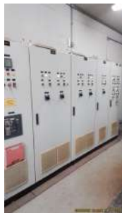
Foto 17 - CCE comando de motores.
