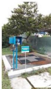
Foto 48 - Medidor de vazão de entrada.
