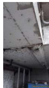
Foto 2 - Vazamento na junta de dilatação do tratamento preliminar.
