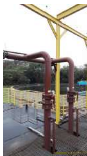
Foto 56 - Descarte de lodo com duas bombas sendo uma reserva.
