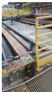
Foto 5 - Vazamento de água de reúso no tratamento preliminar.
