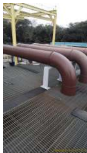
Foto 57 - Recirculação de lodo com três bombas sendo um reserva.
