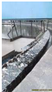
Foto 3 - Reparar defletor ausente no decantador secundário 1.
