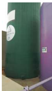
Foto 140 - Reservatório de água de reúso.
