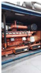
Foto 136 - Motor 1 de cogeração original.
