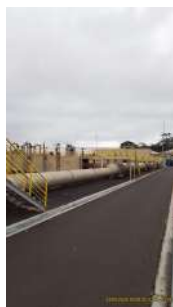
Foto 62 - Tubulação de distribuição de efluente nos reatores aeróbios.
