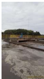
Foto 45 - Carrossel 1 de lodos ativados por aeração prolonga com detenção de 14 dias.
