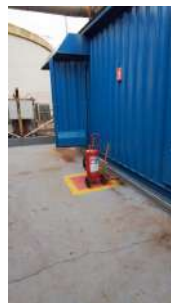
Foto 135 - Extintor do motor de cogeração.
