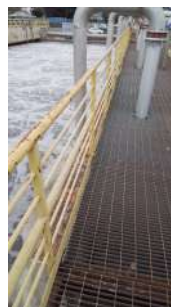
Foto 2 - Corrosão no guarda-corpo e gradil entre os reatores aeróbios 5 e 6.
