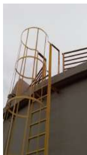
Foto 5 - Corrosão no guarda-corpo do tanque Tampão 2.
