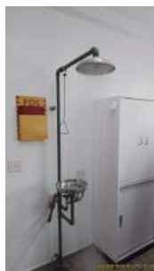
Foto 25 - Chuveiro de emergência.
