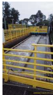
Foto 32 - Duas caixas de areia e gordura.
