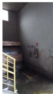
Foto 36 - Extintor da EEE.
