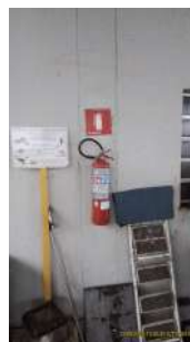
Foto 6 - Extintor das centrífugas.
