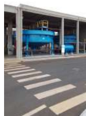
Foto 106 - Três flotadores de lodo dos decantadores secundários.
