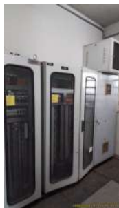
Foto 19 - CCE comando de motores.
