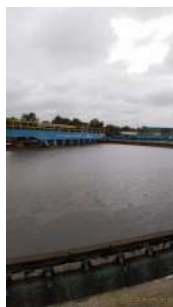
Foto 90 - Decantador secundário 3 parado pra troca da roda da ponte rolante.
