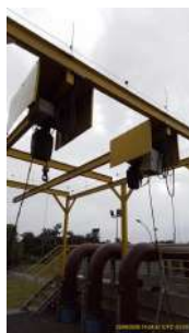
Foto 55 - Trole e talha para remoção de bombas da recirculação de lodo.
