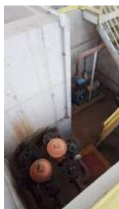
Foto 95 - EEE sobrenadantes dos decantadores 3 e 4.
