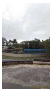
Foto 47 - Vista do decantador secundário 1.
