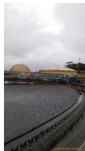
Foto 51 - Vista do decantador primário 2. Remove aproximadamente 27% de dbó.
