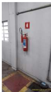
Foto 16 - Extintor do trafo.
