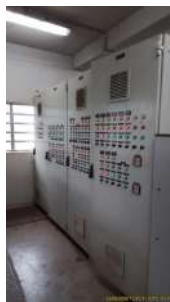
Foto 20 - CCE comando de motores.
