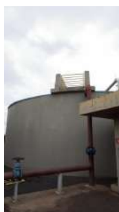
Foto 113 - Adensador de lodo primário 1.
