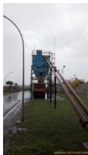
Foto 13 - Silo de lodo centrifugado.
