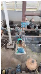
Foto 1 - Ausência de bomba reserva na EEE dos decantadores primários.
