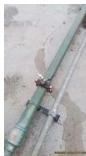
Foto 71 - Tomada de água bruta do poço.
