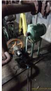
Foto 1 - Ausência de bomba reserva na EEE de lodo para a centrífuga.
