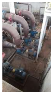
Foto 102 - EEE dos decantadores secundários 1, 2 e 3.
