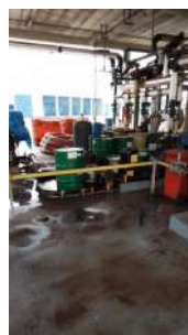
Foto 131 - Armazenamento de produtos químicos.
