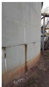
Foto 9 - Vazamentos na alvenaria do biodigestor 3.
