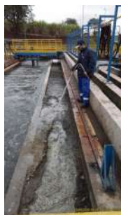
Foto 43 - Caixa de areia e gordura com limpeza no momento da fiscalização.
