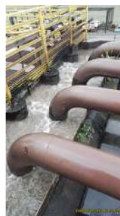
Foto 26 - Entrada do preliminar - recalque do poço.
