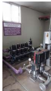
Foto 139 - Tratamento de água de reúso.
