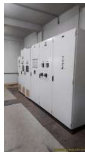
Foto 14 - CCE comando de motores.
