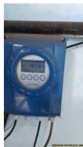
Foto 18 - Painel do macromedidor (momento 2).
