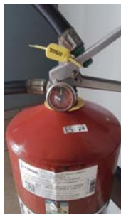
Foto 6 - Pressão do extintor.
