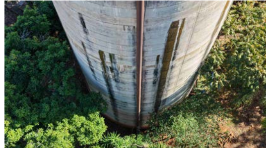
Foto 6 - Vazamento na alvenaria.
