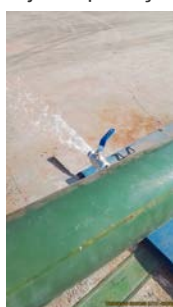
Foto 5 - Tomada de água bruta.
