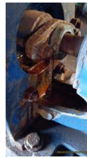
Foto 2 - Vazamento na gaixeta da bomba 1.
