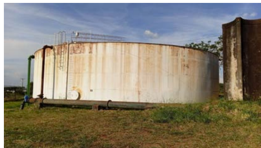
Foto 3 - Pontos de corrosão no reservatório.
