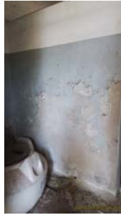
Foto 1 - Paredes danificadas pela ação dos reagentes químicos e acúmulo de sujeira no local.
