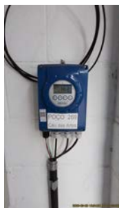
Foto 16 - Painel do macromedidor (momento 1).
