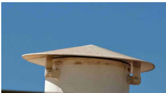
Foto 9 - Tubulação de ventilação com tela (imagem de drone de 08/06/2026).
