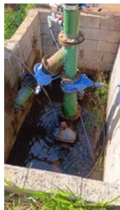
Foto 1 - Acúmulo de água na caixa de passagem adjacente à EEA.
