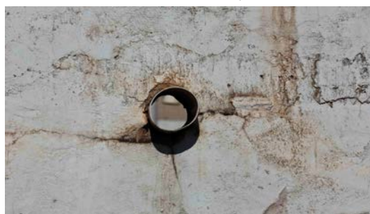
Foto 16 - Dreno da laje (imagem de drone de 08/06/2026).
