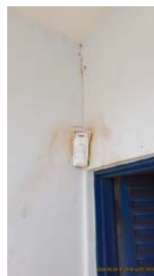
Foto 12 - Sistema de alarme contra furtos.
