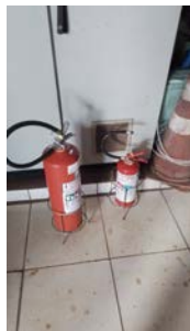
Foto 5 - Extintores de incêndio do local.
