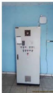
Foto 15 - Painel de energia do poço.
