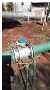
Foto 8 - Macromedidor do poço.
