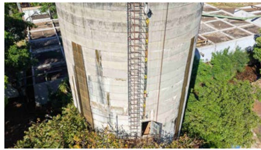
Foto 4 - Guarda-corpo com aspecto de corrosão.
