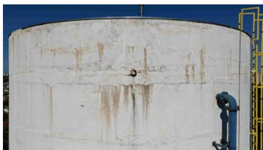
Foto 15 - Dreno da laje (imagem de drone de 08/06/2026).
