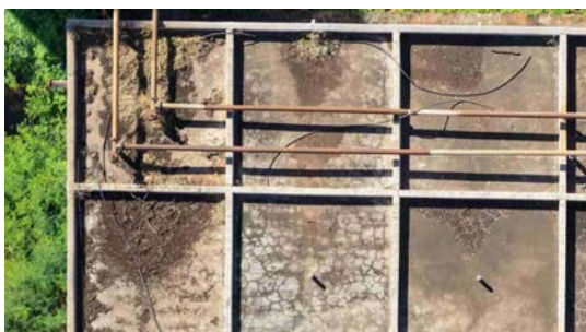
Foto 1 - Sujeira acumulada no topo do reservatório.
