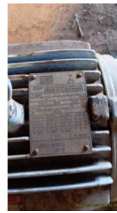
Foto 4 - Motor da bomba 1.
