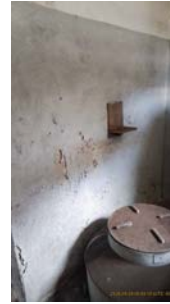
Foto 2 - Paredes danificadas pela ação dos reagentes químicos e acúmulo de sujeira no local.
