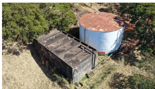
Foto 4 - Tubulação de ventilação e extravasor (imagem de drone de 08/06/2026).
