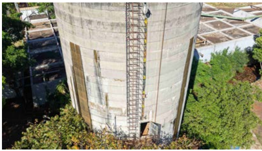
Foto 3 - Vazamento na alvenaria.
