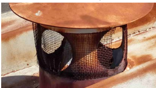
Foto 13 - Tubulação de ventilação sem tela (imagem de drone de 08/06/2026).
