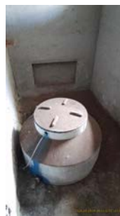
Foto 16 - Armazenamento de cloro.
