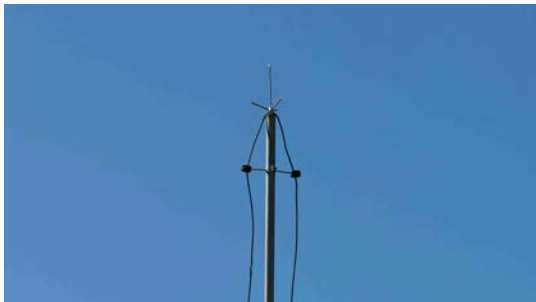
Foto 17 - Captor tipo Franklin (imagem de drone de 08/06/2026).
