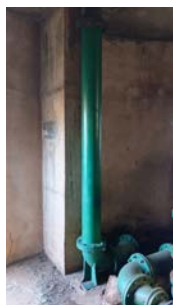
Foto 19 - Tubo extravasor do reservatório.
