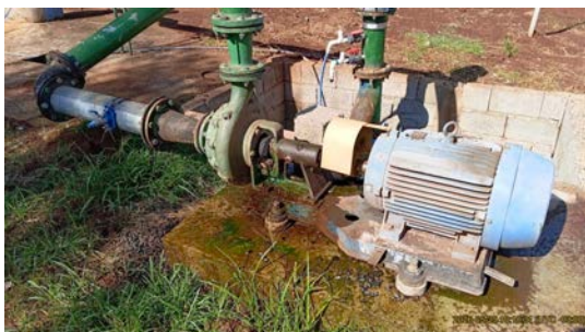
Foto 3 - Vista geral da EEA.
