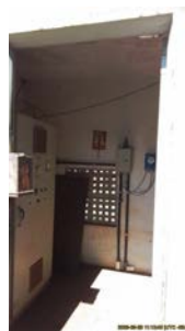
Foto 18 - Painel de energia do poço.
