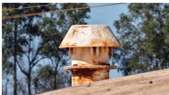
Foto 35 - Tubulação de ventilação (imagem de drone de 08/06/2026).
