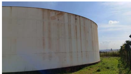
Foto 5 - Pontos de corrosão no reservatório.
