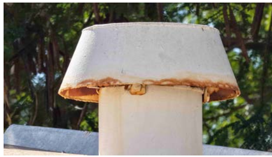
Foto 20 - Tubulação de ventilação (imagem de drone de 08/06/2026).
