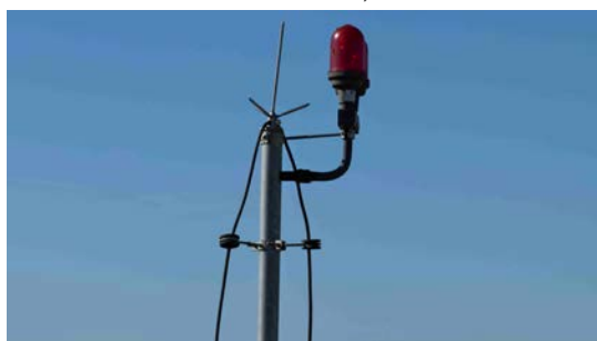
Foto 19 - Captor tipo Franklin (imagem de drone de 08/06/2026).
