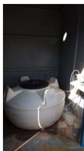
Foto 12 - Armazenamento de cloro.
