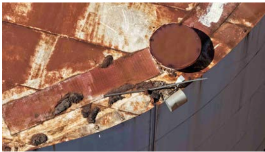
Foto 2 - Tampa de inspeção com corrosão.
