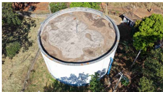
Foto 1 - O guarda-corpo do topo do reservatório deve ter no mínimo 1,10 metros de altura.
