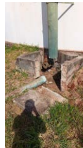
Foto 16 - Caixa de saída do tubo extravasor e tubo de dreno está quebrada.
