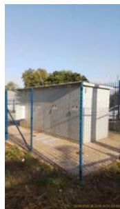
Foto 16 - Vista do transformador e painel elétrico.
