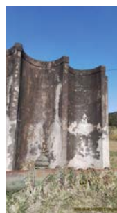
Foto 2 - Vazamento entre o tubo e a alvenaria na saída da adutora.
