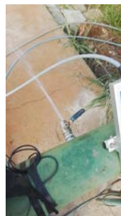
Foto 20 - Tomada de água bruta.
