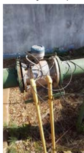
Foto 6 - Macromedidor do poço.
