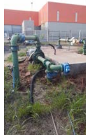
Foto 4 - Vista geral do booster.
