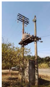
Foto 15 - Padrão de entrada e transformador.
