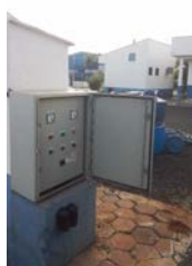
Foto 5 - Painel elétrico do booster.
