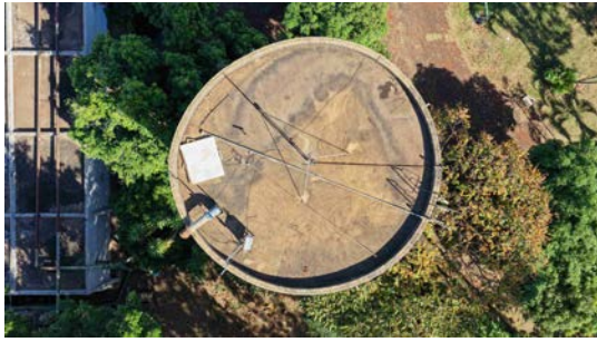
Foto 1 - Ausência de tubulação de ventilação.
