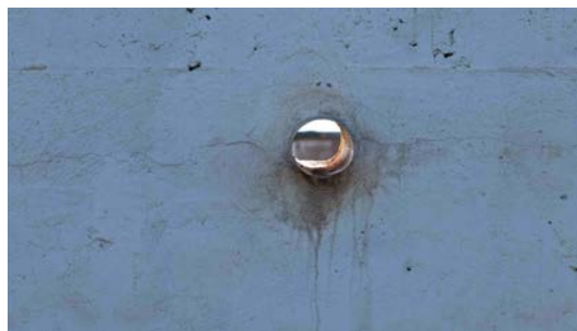
Foto 16 - Dreno da laje (imagem de drone de 08/06/2026).
