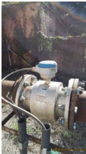
Foto 4 - Macromedidor do poço.
