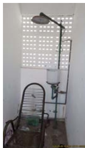
Foto 18 - Chuveiro de emergência desativado.
