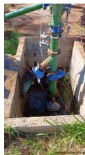
Foto 4 - Caixa de passagem localizada ao lado da EEA.
