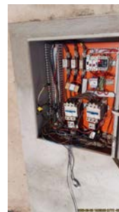
Foto 9 - Painele de comando das bombas.
