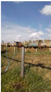
Foto 2 - Vazamento no registro do cavalete do poço.
