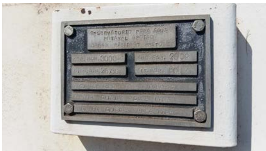
Foto 6 - Placa com dados técnicos da estrutura.
