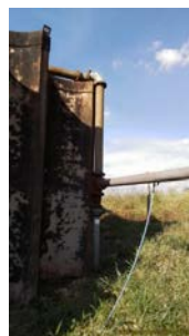
Foto 17 - Abastecimento do reservatório anexo.
