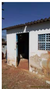
Foto 16 - Acesso ao painel de energia do poço.
