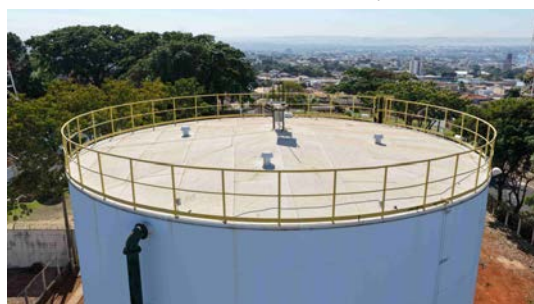
Foto 16 - Guarda-corpo e tubulação de ventilação (imagem de drone de 08/06/2026).
