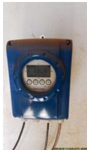
Foto 19 - Painel do macromedidor (momento 1).
