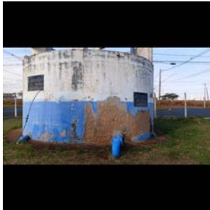
Foto 1 - Reboco se desfazendo na base do reservatório.
