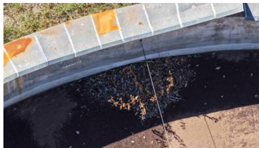
Foto 2 - Sujeira acumulada no topo do reservatório.
