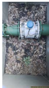
Foto 9 - Macromedidor do poço.
