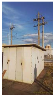
Foto 15 - Vista do transformador e painel elétrico.
