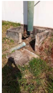
Foto 1 - Caixa de saída do tubo extravasor e tubo de dreno está quebrada.
