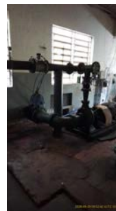
Foto 4 - Vista geral da elevatória.
