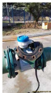
Foto 5 - Macromedidor do poço.
