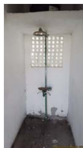
Foto 16 - Chuveiro de emergência desativado.
