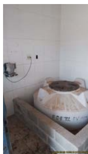
Foto 15 - Armazenamento de cloro.
