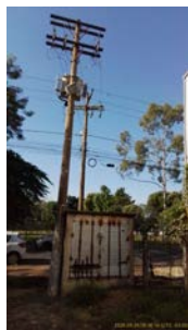
Foto 13 - Tranformador e padrão de entrada.
