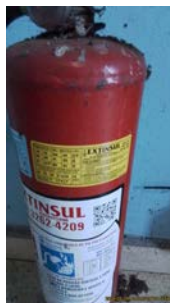
Foto 18 - Validade do extintor vencida em outubro de 2024.
