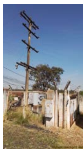
Foto 21 - Padrão de entrada e transformador.
