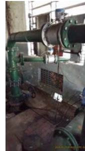
Foto 2 - Diversos fios soltos sobre a EEA.
