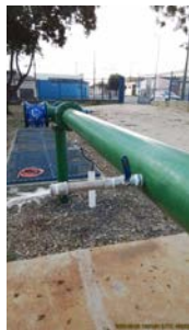
Foto 6 - Tomada de água bruta.
