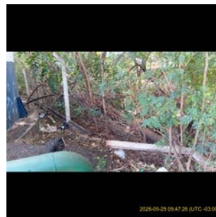
Foto 2 - Dano no cercamento da área.
