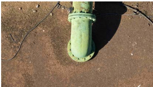
Foto 15 - Tubulação de alimentação (imagem de drone de 08/06/2026).
