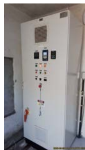
Foto 20 - Painel de energia do poço e booster.
