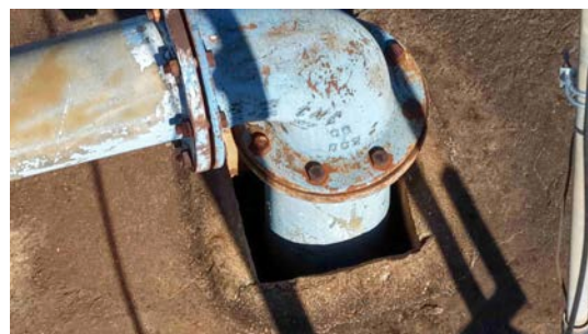
Foto 2 - Buraco na conexão com a tubulação.
