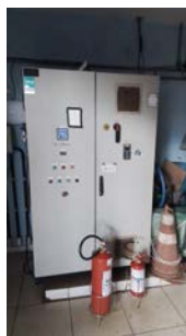
Foto 4 - Painel de energia do poço.
