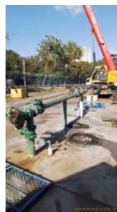
Foto 4 - Vista do cavalete do poço.
