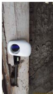
Foto 12 - Sistema de alarme contra furtos.
