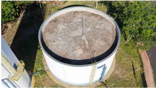
Foto 1 - Ausência de calha em todo o entorno do reservatório.
