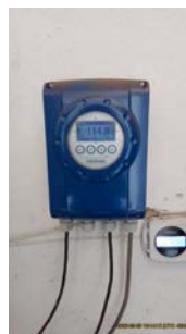
Foto 18 - Painel do macromedidor (momento 1).
