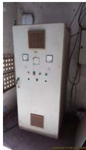
Foto 21 - Painel de energia do poço.
