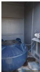
Foto 14 - Armazenamento de cloro.
