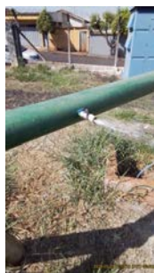
Foto 7 - Tomada de água bruta.
