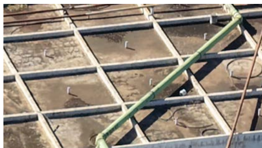
Foto 2 - Tubulação de ventilação sem curvatura contra entrada de chuva.
