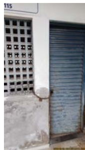
Foto 12 - Abrigo do sistema de dosagem química fechado.
