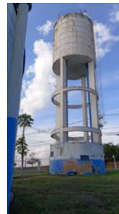
Foto 4 - Pintura do reservatório apresenta desgaste acentuado.
