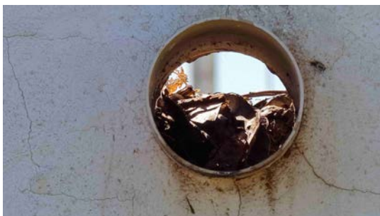
Foto 15 - Dreno da laje (imagem de drone de 08/06/2026).
