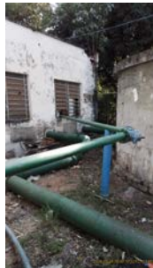
Foto 21 - Tubulação de recalque.
