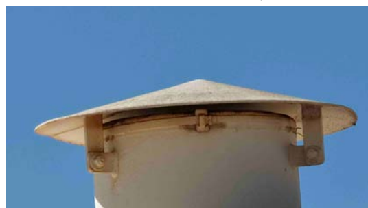
Foto 8 - Tubulação de ventilação com tela (imagem de drone de 08/06/2026).
