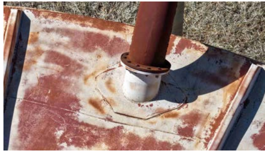
Foto 2 - Tubulação de alimentação com corrosão.
