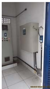
Foto 14 - Painel de energia do poço.
