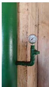
Foto 15 - Manômetro na tubulação de saída, para inferência de nível.
