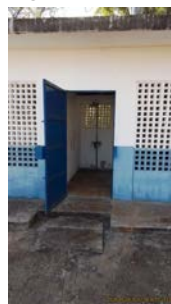
Foto 13 - Abrigo do sistema de dosagem química.
