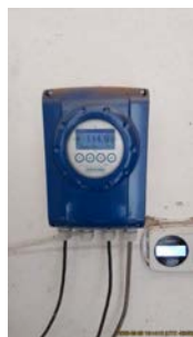
Foto 19 - Painel do macromedidor (momento 2).
