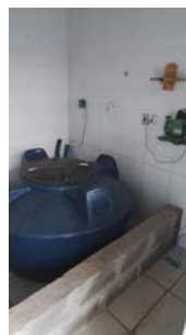
Foto 14 - Armazenamento de cloro.
