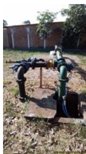
Foto 9 - Tubo preto segue para o reservatório Educandário e tubo verde abastece a rede em marcha.
