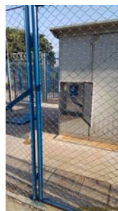
Foto 11 - Vista do painel do macromedidor.
