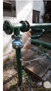
Foto 20 - Tubulação de recalque.
