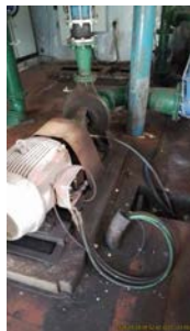
Foto 9 - Drenagem da água de gaxeta.
