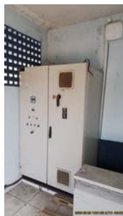
Foto 19 - Painel de energia do poço.
