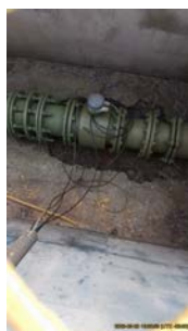
Foto 10 - Macromedidor do poço.
