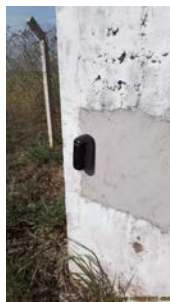
Foto 10 - Sistema de alarme contra furtos.
