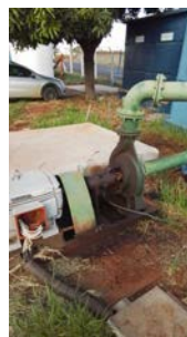
Foto 2 - Vista geral do booster.
