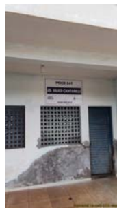
Foto 10 - Abrigo do sistema de dosagem química.
