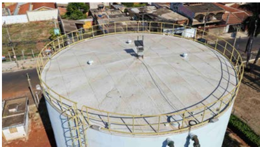
Foto 13 - Guarda-corpo e tubulação de ventilação (imagem de drone de 08/06/2026).
