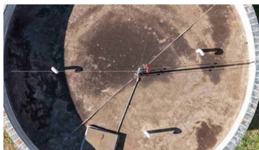
Foto 12 - Para-raio e tubulações de ventilação (imagem de drone de 08/06/2026).
