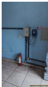
Foto 16 - Extintor e painel do macromedidor.
