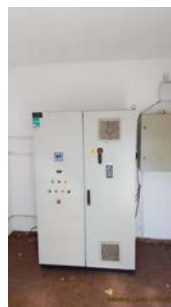
Foto 14 - Painel de energia do poço.
