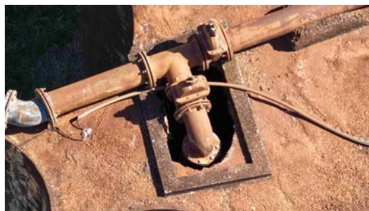
Foto 2 - Aberturas sem proteção que permitem a entrada de impurezas e água de chuva.
