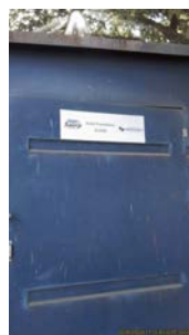
Foto 12 - Identificação e acesso ao armazenamento de flúor.
