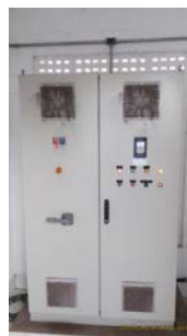
Foto 15 - Painel de energia do poço.
