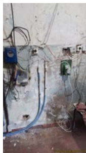
Foto 10 - Sistema de dosagem de produtos químicos no sistema de recalque.
