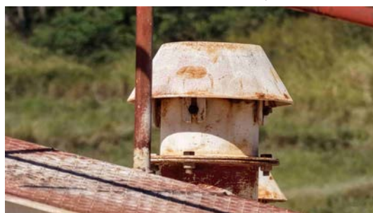
Foto 36 - Tubulação de ventilação (imagem de drone de 08/06/2026).
