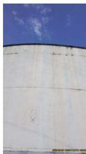
Foto 1 - Início de pontos de corrosão na estrutura.
