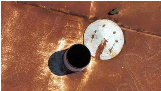
Foto 3 - Tubulação de ventilação aberta, sem curvatura e tela de proteção.
