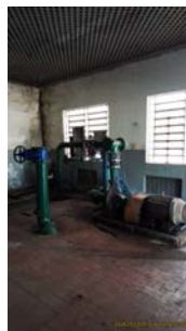
Foto 3 - Vista geral da elevatória.
