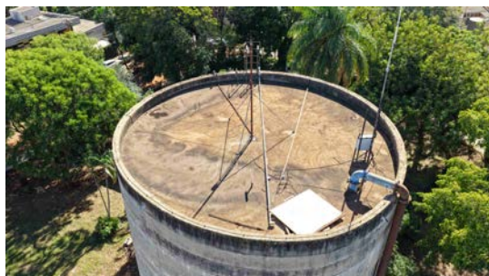
Foto 1 - Ausência de guarda-corpo no topo do reservatório.
