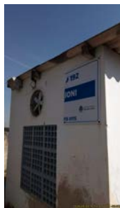
Foto 22 - PLaca de identificação quebrada.
