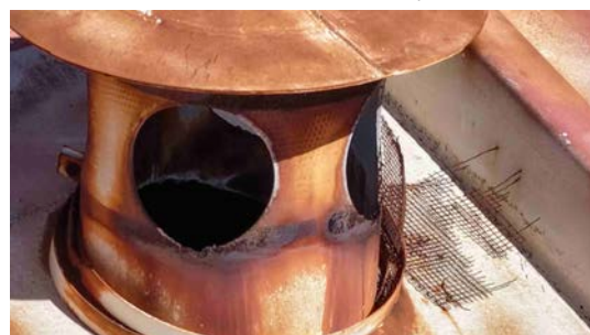
Foto 12 - Tubulação de ventilação sem tela (imagem de drone de 08/06/2026).
