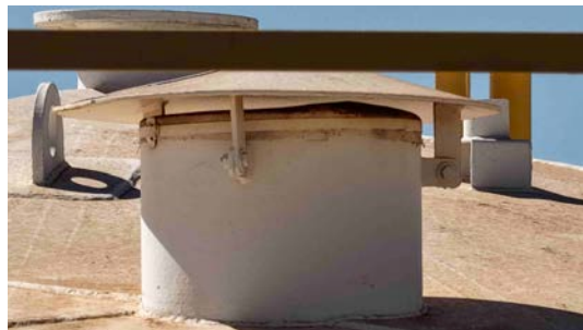
Foto 14 - Tubulação de ventilação com tela (imagem de drone de 08/06/2026).
