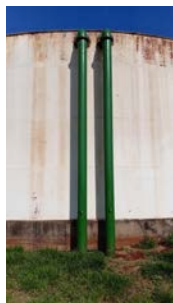
Foto 17 - Tubos de alimentação do reservatório, vindos do poço Feapam (esquerda) e Independência (direita).
