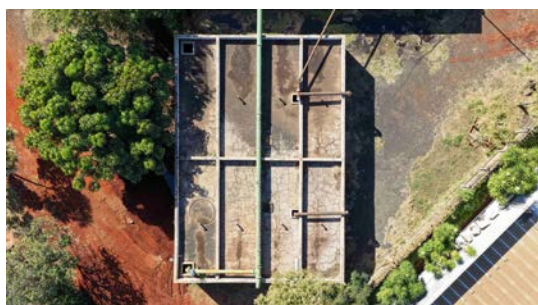
Foto 1 - Topo do reservatório sem guarda-corpo.
