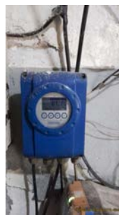
Foto 8 - Painel do macromedidor (momento 2).
