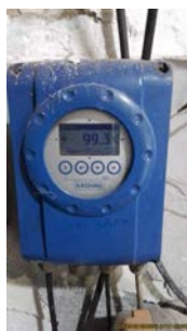
Foto 11 - Painel do macromedidor do recalque (momento 1).
