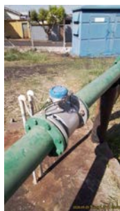
Foto 5 - Macromedidor do poço.
