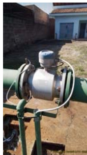
Foto 5 - Macromedidor do poço.
