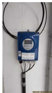
Foto 17 - Painel do macromedidor (momento 2).
