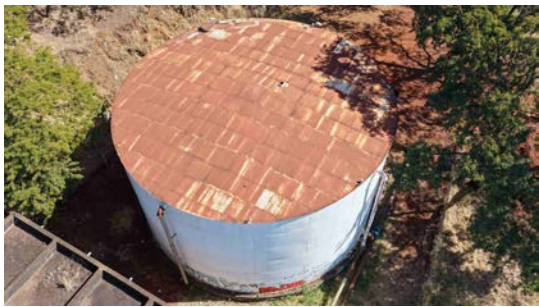
Foto 1 - Topo do reservatório com corrosão.
