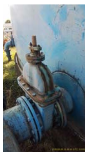
Foto 3 - Vazamento no registro de manobra.
