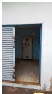
Foto 14 - Acesso ao painel de energia do poço.
