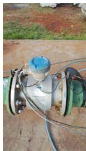
Foto 19 - Macromedidor do poço.
