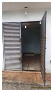
Foto 15 - Acesso ao painel de energia do poço.
