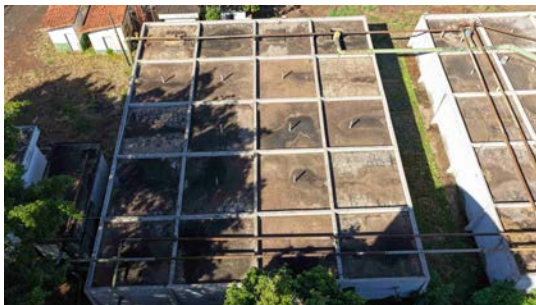
Foto 1 - Topo do reservatório sem guarda-corpo.
