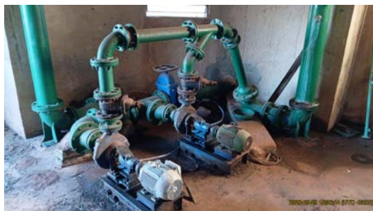
Foto 1 - Vista geral da EEA.
