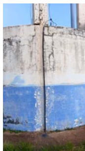
Foto 11 - Descida do condutor do SPDA.
