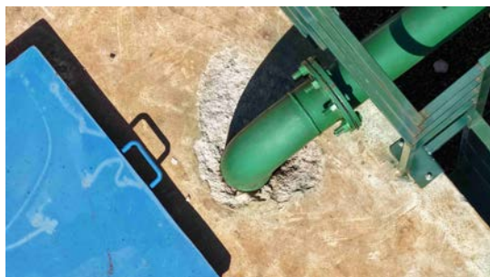
Foto 7 - Tampa de inspeção e tubulação de alimentação (imagem de drone de 08/06/2026).
