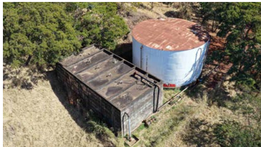
Foto 1 - Sujeira acumulada no topo do reservatório.
