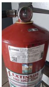
Foto 7 - Validade do extintor abril de 2027.
