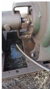
Foto 1 - Tubo de drenagem solto e acúmulo de água na base da bomba.
