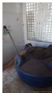
Foto 14 - Armazenamento de cloro.
