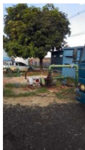
Foto 1 - Vista geral do booster.
