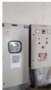
Foto 14 - Painel de energia do poço.
