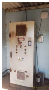
Foto 17 - Painel de energia do poço.
