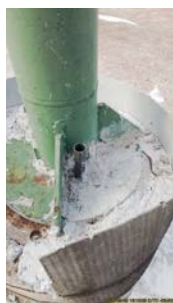
Foto 1 - Tubo de medição de nível aberto.
