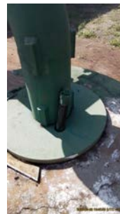
Foto 4 - Tubo para medição de nível.
