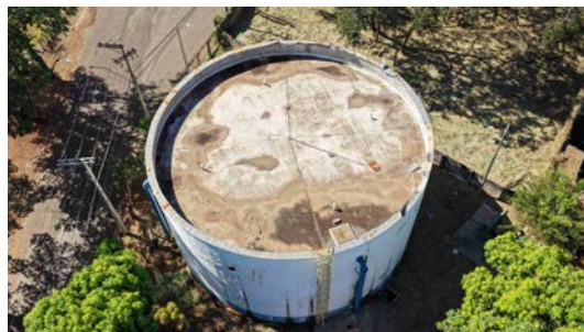
Foto 2 - Diversos pontos de vazamento na alvenaria.
