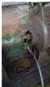
Foto 11 - Drenagem da água de gaxeta.
