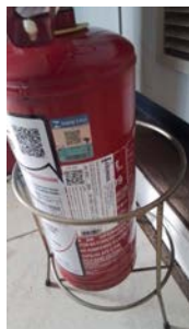
Foto 9 - Validade do extintor abril de 2027.
