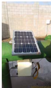
Foto 7 - Alimentação do sistema de monitoramento da água subterrânea.
