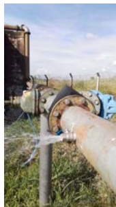
Foto 8 - Tomada de água bruta.
