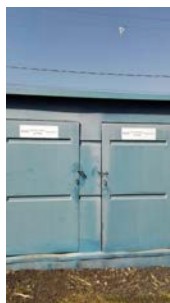
Foto 10 - Abrigo do sistema de dosagem química.
