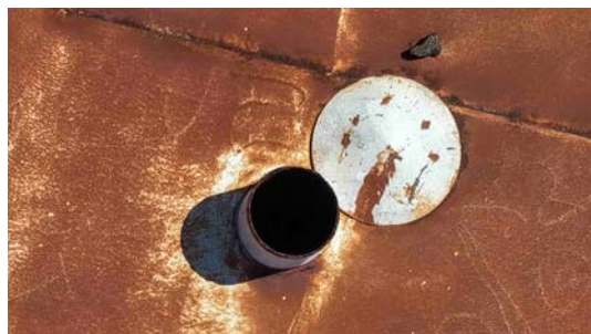
Foto 12 - Tubulação de ventilação (imagem de drone de 08/06/2026).
