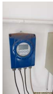
Foto 16 - Painel do macromedidor (momento 2).
