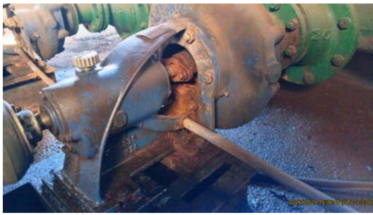
Foto 3 - Drenagem da água de lubrificação de gaixeta da bomba 2.
