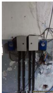
Foto 13 - Painéis de medição de vazão. Esquerda poço e direita recalque.
