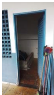
Foto 11 - Abrigo do sistema de dosagem química.
