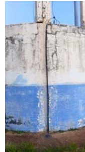
Foto 2 - Pintura do reservatório apresenta desgaste acentuado.
