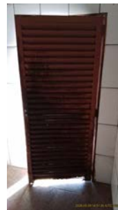
Foto 2 - Realizar manutenção contra ferrugem na porta metálica.
