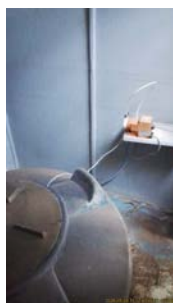
Foto 11 - Armazenamento de cloro.
