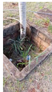
Foto 2 - Caixa de passagem localizada ao lado do reservatório, onde há registro com vazamento.
