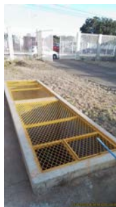
Foto 9 - Caixa de passagem com macromedidor e dosagem de produtos.
