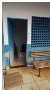
Foto 13 - Abrigo do sistema de dosagem química.
