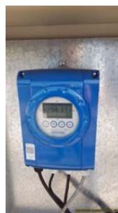
Foto 13 - Painel do macromedidor (momento 2).
