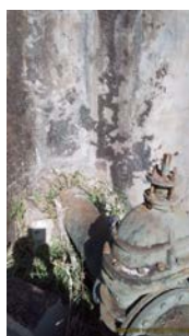
Foto 1 - Vazamento entre o tubo e a alvenaria na saída da adutora.
