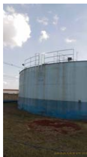
Foto 14 - Vista dos guarda-corpos.
