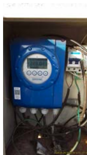
Foto 13 - Painel do macromedidor (momento 1).
