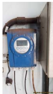
Foto 18 - Painel do macromedidor (momento 2).
