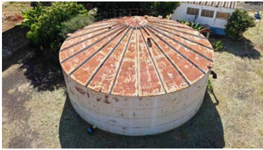
Foto 1 - Topo do reservatório com corrosão.
