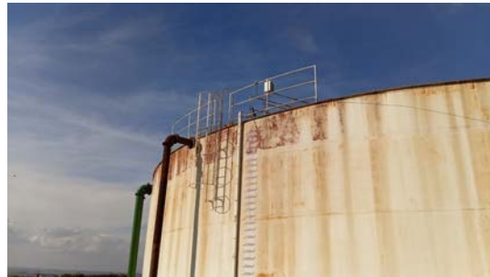
Foto 2 - Pontos de corrosão no reservatório.
