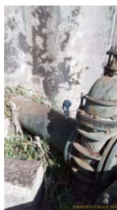
Foto 5 - Manômetro para controle do nível. Segundo o prestador o reservatório enche no período noturno.
