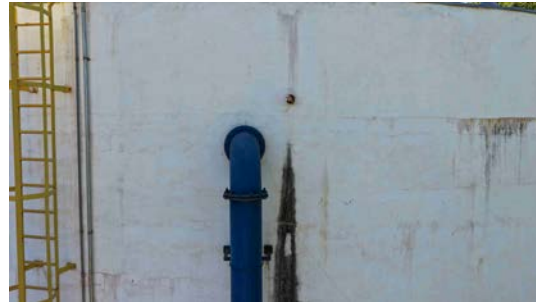
Foto 14 - Dreno da laje (imagem de drone de 08/06/2026).
