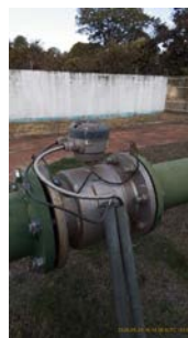
Foto 6 - Macromedidor do poço.
