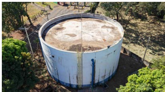
Foto 1 - Diversos pontos de vazamento na alvenaria.
