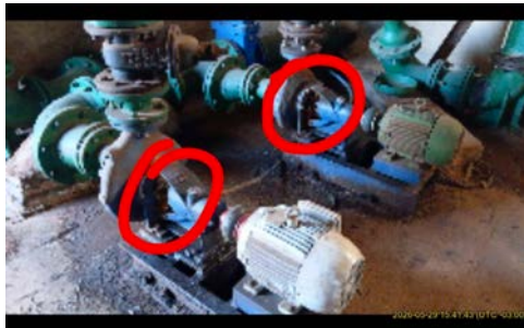
Foto 5 - Pontos onde verificou-se vazamento, mesmo com as bombas desligadas.
