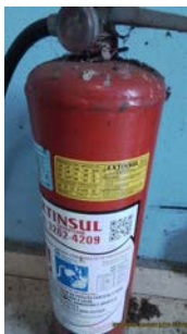
Foto 1 - Extintor com manutenção vencida em outubro de 2024.
