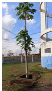
Foto 1 - Caixa de passagem localizada ao lado do reservatório, onde há registro com vazamento. Há uma árvore de grande porte crescendo a partir do interior da caixa.
