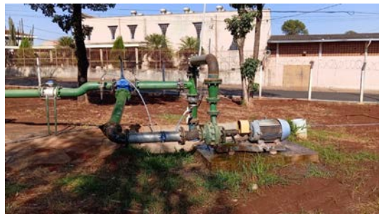
Foto 2 - Vista geral do poço, com o booster instalado na tubulação de saída da captação.
