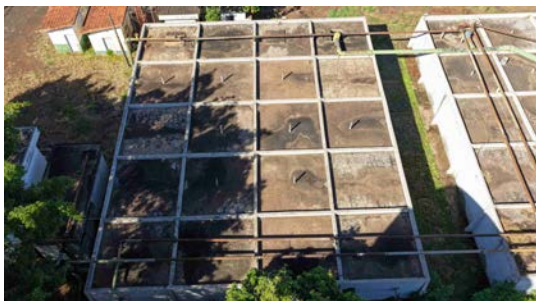
Foto 1 - Tubulação de ventilação sem curvatura contra entrada de chuva.
