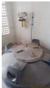
Foto 17 - Armazenamento de cloro.
