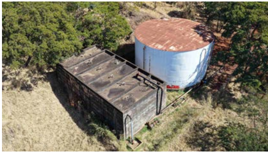
Foto 1 - Topo do reservatório sem guarda-corpo.
