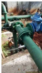
Foto 9 - Tomada de água bruta.
