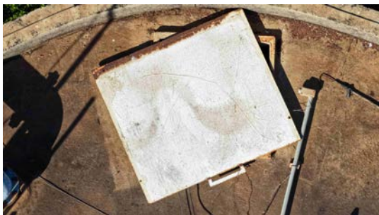
Foto 1 - Tampa de inspeção aberta.
