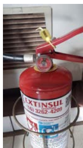
Foto 8 - Pressão do extintor.
