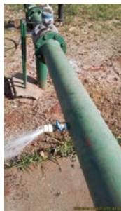
Foto 6 - Tomada de água bruta.
