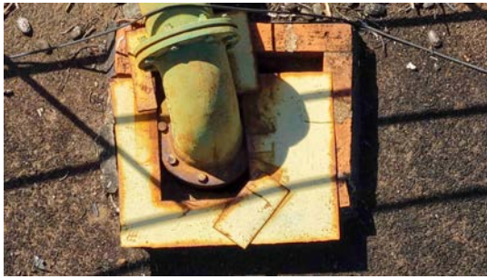
Foto 1 - Adequar a instalação da tubulação de alimentação e evitar a entrada de contaminantes externos.
