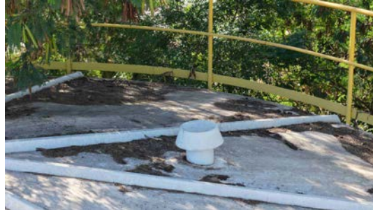
Foto 22 - Tubulação de ventilação (imagem de drone de 08/06/2026).
