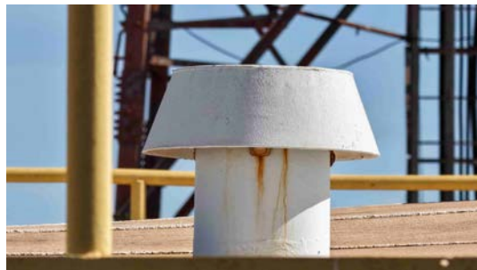
Foto 14 - Tubulação de ventilação (imagem de drone de 08/06/2026).
