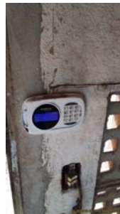
Foto 22 - Sistema de alarme contra furtos.
