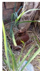
Foto 3 - Registro com vazamento no interior da caixa de passagem.
