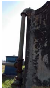
Foto 13 - Tubulação de recalque do poço Educandário.
