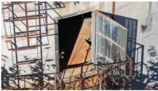
Foto 3 - Guarda-corpo com aspecto de corrosão.
