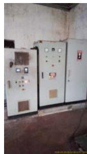
Foto 12 - Painel de energia da EEA e poço.
