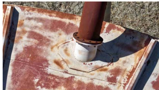
Foto 10 - Tubulação de alimentação (imagem de drone de 08/06/2026).
