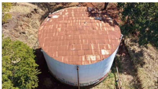
Foto 1 - Topo do reservatório sem guarda-corpo.
