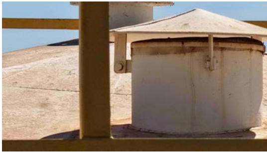
Foto 19 - Tubulação de ventilação com tela (imagem de drone de 08/06/2026).
