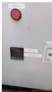
Foto 17 - Controle de nível do reservatório para acionamento do booster.
