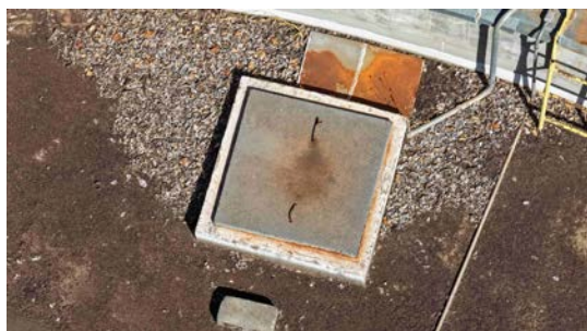
Foto 3 - Tampa de inspeção com corrosão e sujeira acumulada no topo do reservatório.
