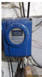
Foto 12 - Painel do macromedidor do recalque (momento 2).
