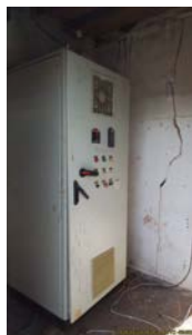
Foto 11 - Painel de energia do poço.
