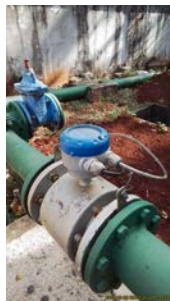
Foto 8 - Macromedidor do poço.
