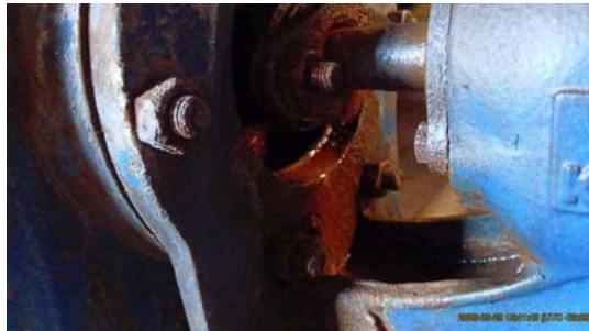
Foto 3 - Vazamento na gaixeta da bomba 2.
