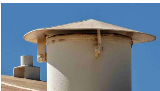
Foto 7 - Tubulação de ventilação com tela (imagem de drone de 08/06/2026).
