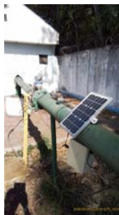
Foto 10 - Sistema de monitoramento do aquífero.
