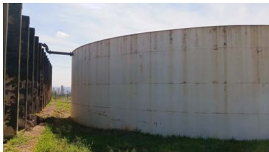
Foto 4 - Pontos de corrosão no reservatório.
