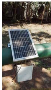
Foto 5 - Sistema de monitoramento do aquífero.
