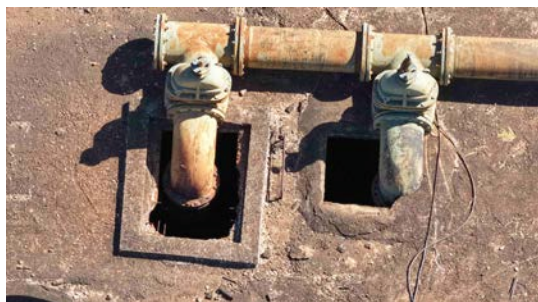
Foto 1 - Aberturas sem proteção que permitem a entrada de impurezas e água de chuva.
