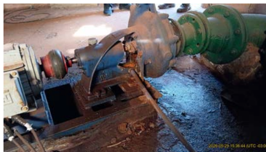
Foto 2 - Drenagem da água de lubrificação de gaixeta da bomba 1.
