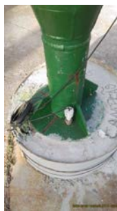
Foto 6 - Tubo de medição de nível.
