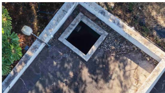
Foto 1 - Sujeira acumulada no topo do reservatório.
