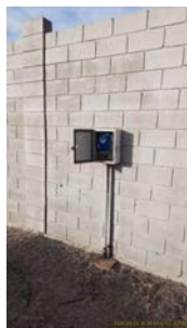
Foto 12 - Vista geral do painel do macromedidor.
