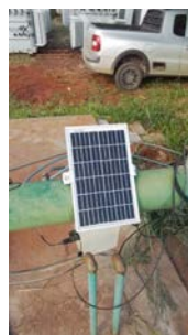
Foto 18 - Sistema de monitoramento do aquífero.
