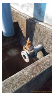
Foto 5 - Vazamento no registro de descarga de fundo.
