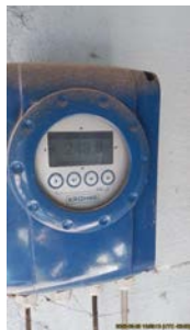
Foto 18 - Painel do macromedidor (momento 1).
