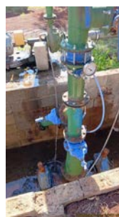
Foto 6 - Manômetro na linha de recalque ba EEA.
