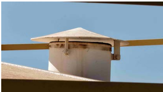
Foto 13 - Tubulação de ventilação com tela (imagem de drone de 08/06/2026).
