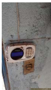
Foto 20 - Sistema de alarme contra furtos.
