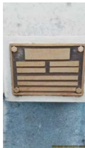
Foto 15 - Placa de capacidade do reservatório.
