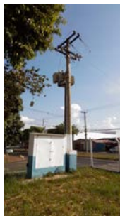
Foto 12 - Padrão de entrada e transformador.
