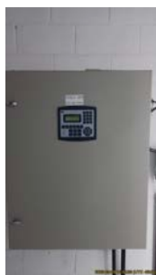
Foto 18 - Painel de energia do poço.
