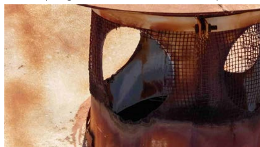
Foto 14 - Tubulação de ventilação sem tela (imagem de drone de 08/06/2026).
