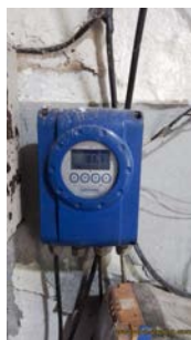
Foto 7 - Painel do macromedidor (momento 1).
