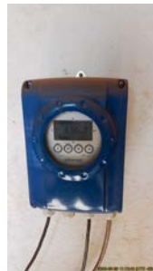
Foto 20 - Painel do macromedidor (momento 2).
