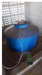
Foto 11 - Armazenamento de cloro.
