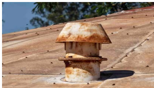
Foto 34 - Tubulação de ventilação (imagem de drone de 08/06/2026).
