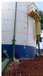
Foto 9 - Medidor de nível instalado no costado.
