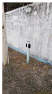
Foto 20 - Sistema de alarme contra furtos.
