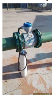
Foto 6 - Macromedidor do poço.
