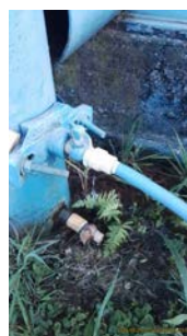
Foto 2 - Vazamento na conexão da mangueira no tubo.
