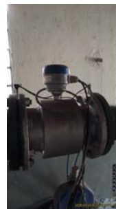
Foto 6 - Macromedidor da elevatória.
