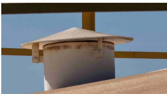
Foto 15 - Tubulação de ventilação com tela (imagem de drone de 08/06/2026).
