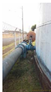
Foto 4 - Vazamento no registro de manobra.
