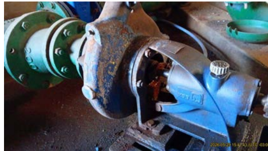
Foto 4 - Vazamento na gaixeta da bomba 2.
