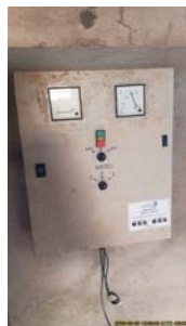
Foto 8 - Painele de comando das bombas.
