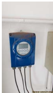
Foto 15 - Painel do macromedidor (momento 1).
