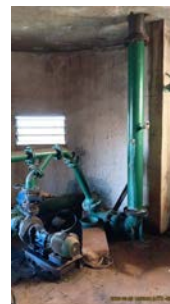
Foto 7 - Tubulação de recalque.
