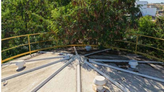
Foto 21 - Tubulação de ventilação (imagem de drone de 08/06/2026).
