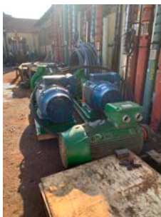
Foto 7 - Estoque de motores.
