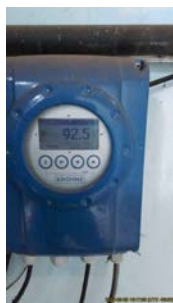
Foto 17 - Painel do macromedidor (momento 1).
