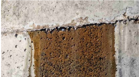
Foto 5 - Vazamento na alvenaria.
