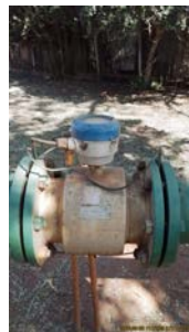
Foto 6 - Macromedidor do poço.
