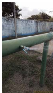
Foto 8 - Tomada de água bruta.
