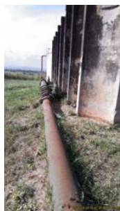
Foto 3 - Tubulação de saída que abastece o Jd. Independência e o Campos Elisios.
