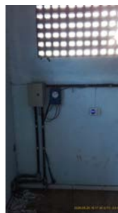
Foto 16 - Sistema de alarme contra furtos.
