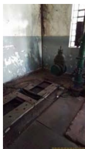
Foto 1 - Ausência de bomba reserva.
