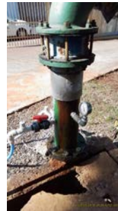
Foto 2 - Vazamento no cavalete junto à dosagem de produtos químicos.
