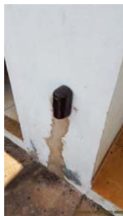
Foto 13 - Sistema de alarme contra furtos.
