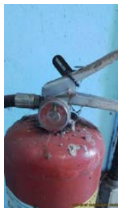
Foto 17 - Pressão do extintor.
