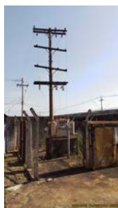
Foto 23 - Padrão de entrada e transformador.
