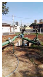
Foto 9 - Sistema de booster no final do cavalete do poço.
