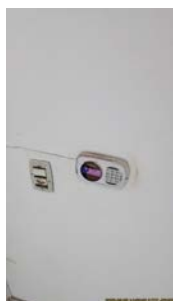
Foto 17 - Sistema de alarme contra furtos.
