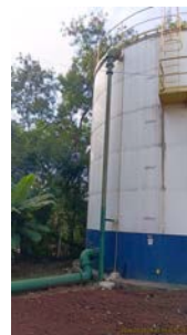
Foto 8 - Tubo de alimentação do reservatório.
