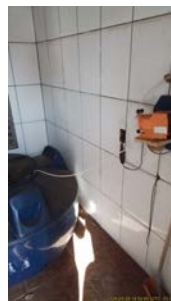
Foto 20 - Armazenamento de cloro.
