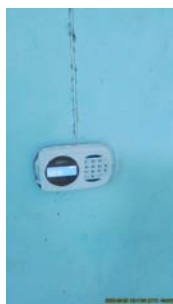
Foto 19 - Sistema de alarme contra furtos.
