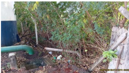
Foto 1 - Dano no cercamento da área.
