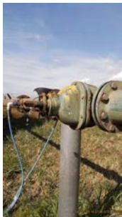
Foto 1 - Vazamento no registro do cavalete do poço.
