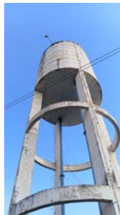
Foto 3 - Pintura do reservatório apresenta desgaste acentuado.
