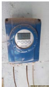
Foto 19 - Painel do macromedidor (momento 2).
