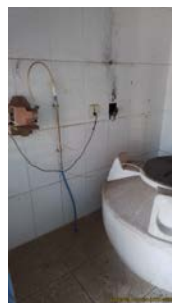
Foto 22 - Armazenamento de cloro.
