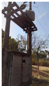
Foto 17 - Padrão de entrada e transformador.
