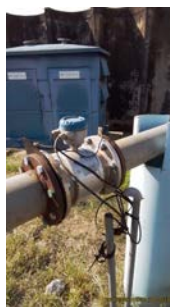
Foto 6 - Macromedidor do poço.
