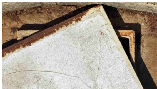
Foto 2 - Tampa de inspeção aberta.
