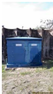
Foto 9 - Abrigo do sistema de dosagem química.
