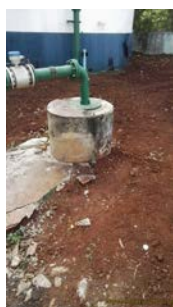
Foto 1 - Ausência de laje de proteção do poço.
