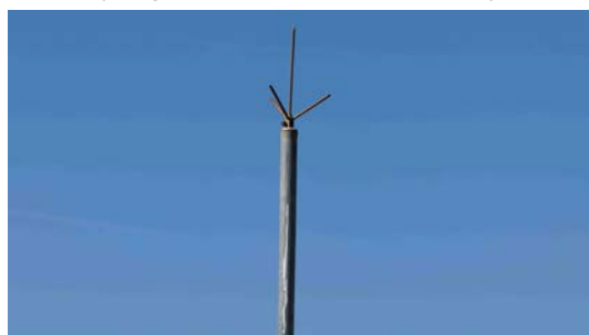
Foto 16 - Captor tipo Franklin (imagem de drone de 08/06/2026).
