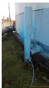
Foto 1 - Vazamento na conexão da mangueira no tubo.
