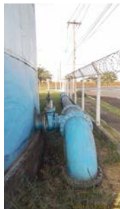
Foto 5 - Tubulação de distribuição.
