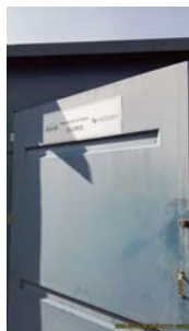
Foto 13 - Identificação e acesso ao armazenamento de cloro.
