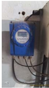
Foto 1 - Painel sem registro da vazão do poço.
