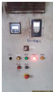
Foto 13 - Painel de energia da EEA.
