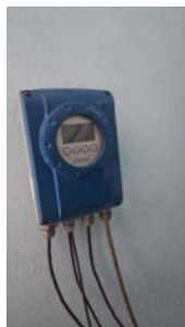
Foto 10 - Painel do macromedidor desativado.
