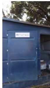
Foto 10 - Identificação e acesso ao armazenamento de cloro.
