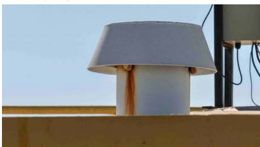
Foto 15 - Tubulação de ventilação (imagem de drone de 08/06/2026).
