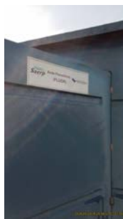
Foto 15 - Identificação e acesso ao armazenamento de flúor.
