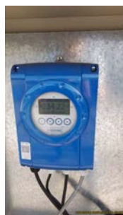
Foto 12 - Painel do macromedidor (momento 1).
