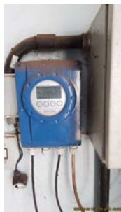
Foto 17 - Painel do macromedidor (momento 1).
