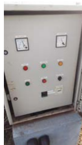
Foto 6 - Painel elétrico do booster.
