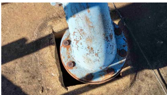
Foto 1 - Buraco na conexão com a tubulação.
