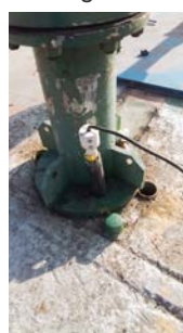
Foto 4 - Tubo de medição de nível.
