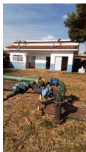
Foto 10 - Vista geral do poço e do abrigo do sistema de dosagem química.
