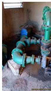
Foto 6 - Tubulação de alimentação das bombas.
