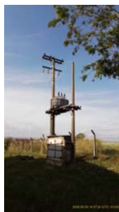
Foto 10 - Padrão de entrada e transformador.
