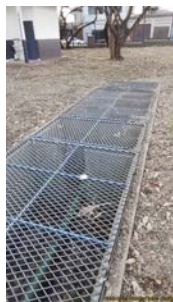
Foto 8 - Caixa de válvulas.
