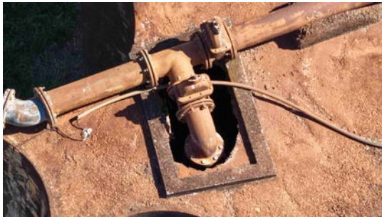
Foto 20 - Abertura de alimentação sem proteção (imagem de drone de 08/06/2026).
