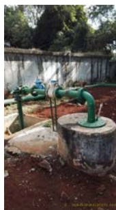
Foto 6 - Ausência de laje de proteção.
