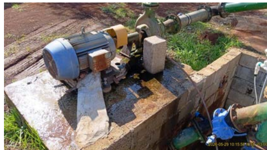
Foto 2 - Drenagem da água de lubrificação de gaxeta é direcionada para a caixa de passagem adjacente.
