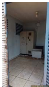
Foto 16 - Acesso ao painel de energia do poço.
