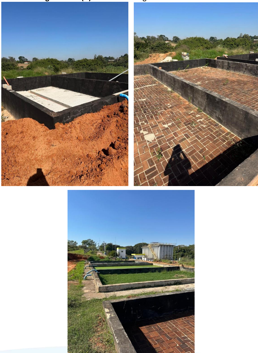
Figura TEC 2(A) – Leito de secagem da ETE Três Barras.
