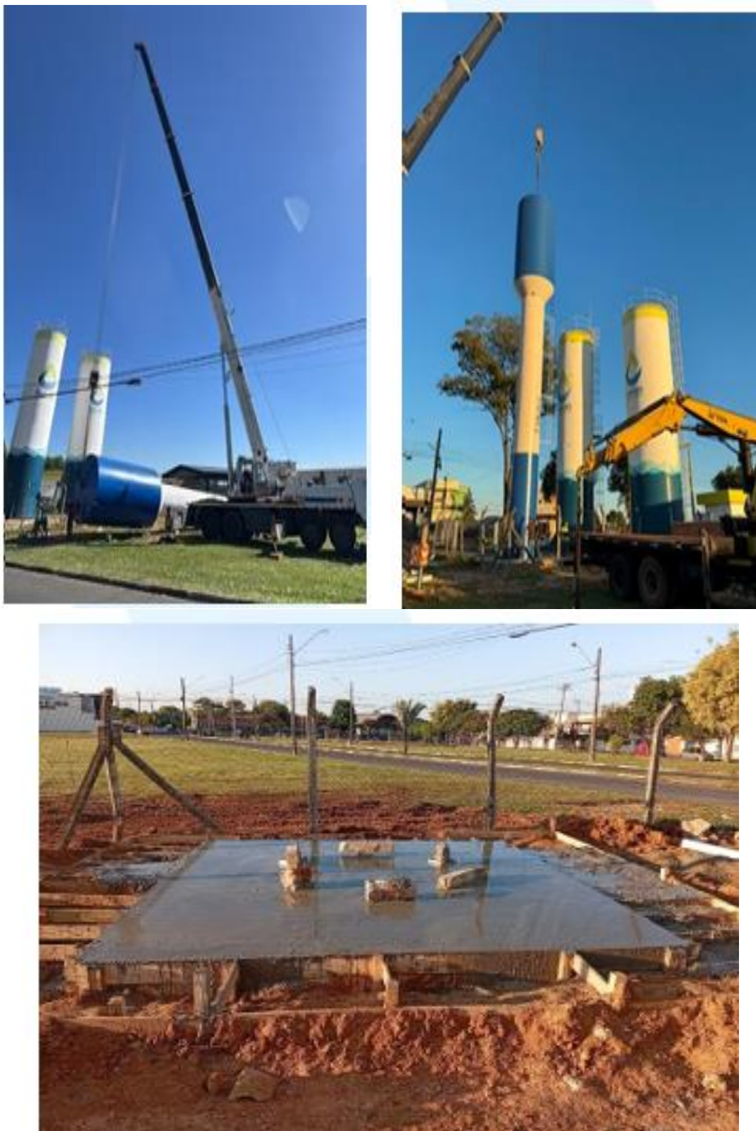
Figura TEC 3(C) – Infraestrutura de Reservação no Jardim Bela Vista II.
