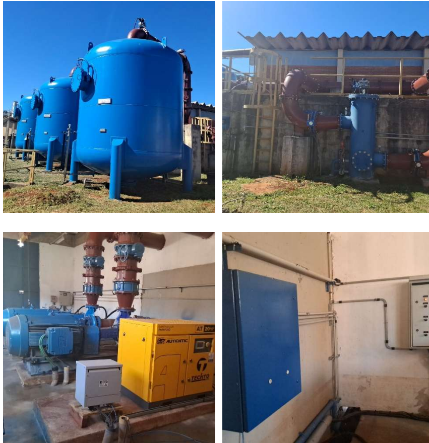
Figura TEC 5 – Equipamentos do Sistema de Saturação ETE Monjolinho
