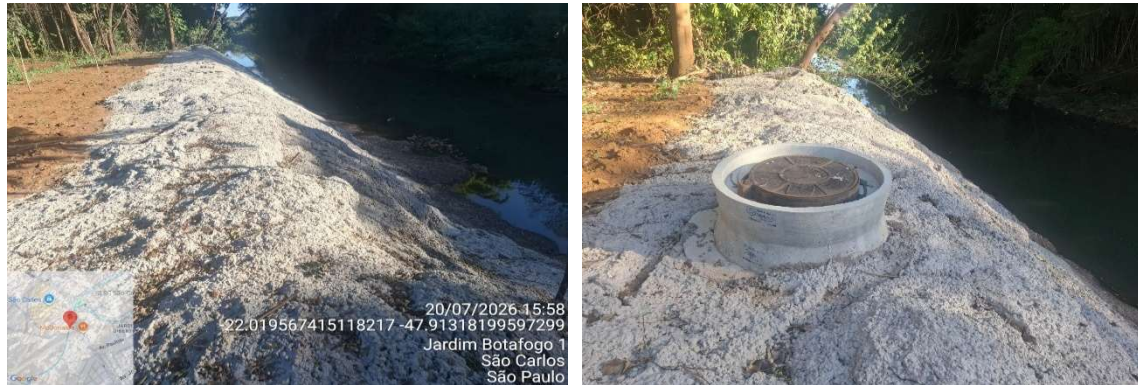
Figura TEC 11 – Trecho do emissário de esgoto substituído na margem esquerda do rio Monjolinho, a jusante da rotatória do Cristo Redentor, em razão do colapso estrutural da tubulação
