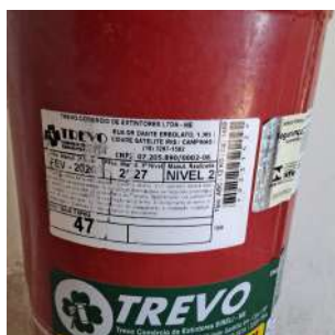
Foto 1 - Extintor com validade expirada (fev/26)
