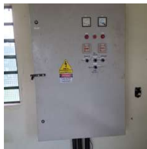
Foto 6 - Painel de comando e controle
