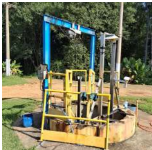
Foto 15 - Estação elevatória de esgoto bruto
