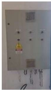
Foto 5 - Painele de comando e controle
