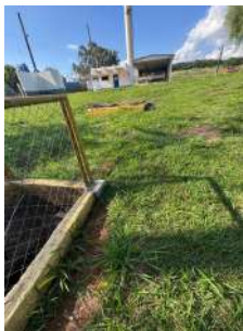
Foto 3 - Indícios de vazamento
