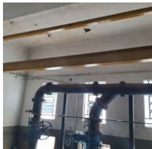
Foto 10 - Talha para içamento de bombas
