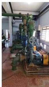
Foto 1 - Elevatórias de água tratada
