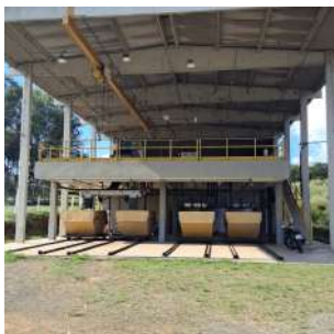
Foto 3 - Tratamento de lodo
