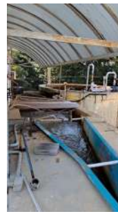
Foto 4 - Medição de vazão na entrada
