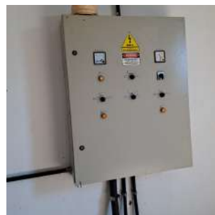
Foto 8 - Pannel de comando e controle
