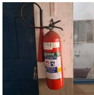
Foto 9 - Extintor de incêndio
