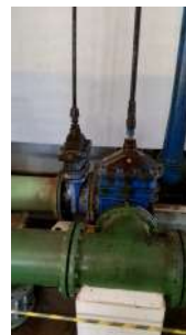
Foto 2 - Registro com vazamento
