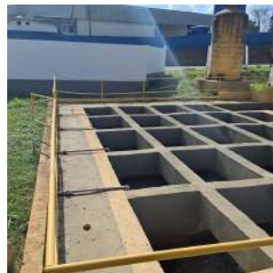
Foto 2 - Tanque de contato
