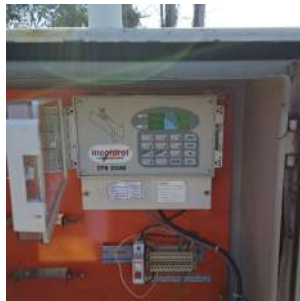
Foto 18 - Macromedidor de vazão
