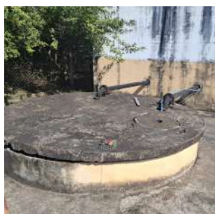
Foto 3 - Poço de sucção
