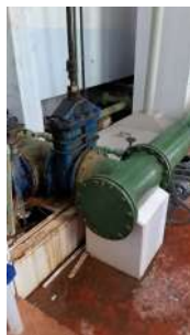
Foto 1 - Registro com vazamento
