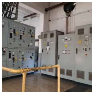
Foto 8 - Painel de comando e controle
