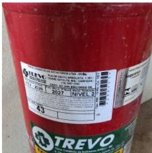
Foto 1 - Extintor com validade expirada (fev/26)
