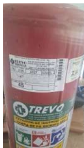
Foto 1 - Extintor com validade expirada (fev/26)
