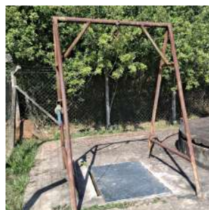
Foto 2 - Talha para içamento do cesto do gradeamento
