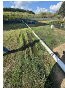
Foto 2 - Indícios de vazamento
