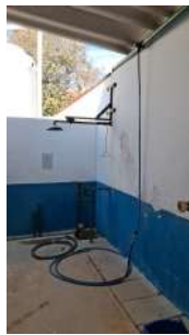
Foto 13 - Chuveiro de emergência
