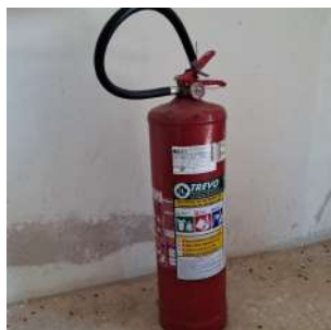
Foto 7 - Extintor de incêndio
