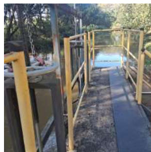
Foto 3 - Guarda-corpos na tomada de água
