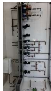
Foto 2 - Sala de bombas dosadoras
