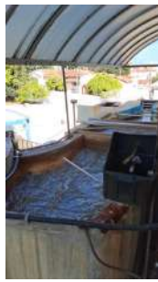
Foto 3 - Entrada de água bruta
