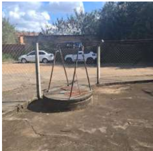
Foto 7 - Sistema de içamento para limpeza do cesto de resíduos
