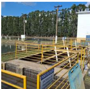
Foto 13 - Canal de entrada de esgoto bruto
