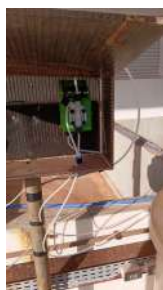
Foto 24 - Bomba peristáltica para dosagem de cloro no poço localizado na mesma área.
