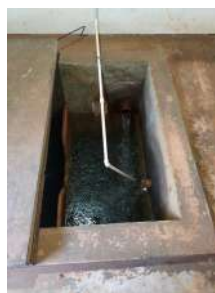
Foto 8 - Caixa que recebe a água dos dois poços existentes no local.
