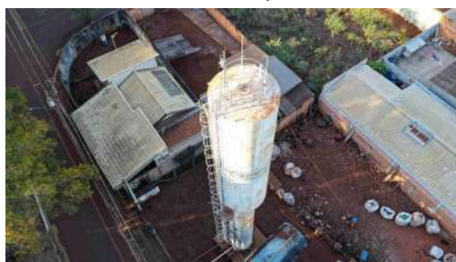
Foto 4 - Corrosão em vários pontos do reservatório.
