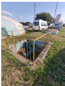
Foto 10 - Caixa de alvenaria adjacente aos reservatório, com registros de manobra.
