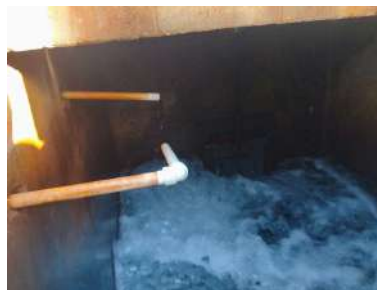
Foto 19 - Cloração e fluoretação da água no poço, realizada em caixa de passagem adjacente a ele.
