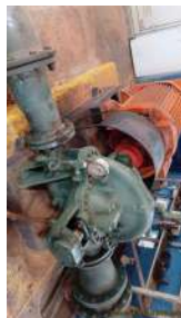
Foto 19 - Manômetro linha de recalque da bomba antiga.
