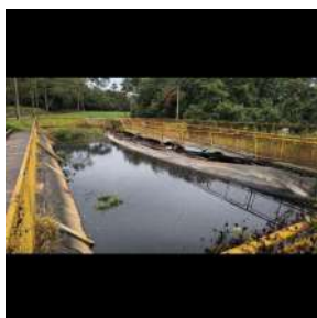
Foto 1 - Os guarda corpos ao redor dos DAFAs 4 e 5 estão colapsando ou ausentes em alguns pontos, incluindo a passarela que passa sobre a estrutura, sendo necessário recuperação.
