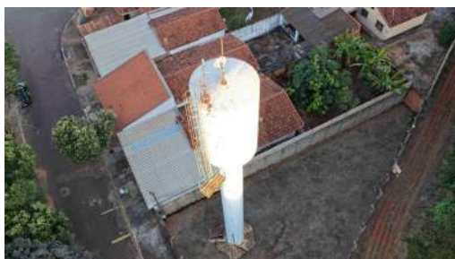
Foto 1 - Ausência de escada e gaiola na metade inferior da estrutura.
