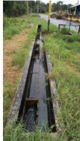
Foto 17 - Caixa de distribuição na entrada do DAFA 1.
