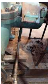
Foto 22 - Drenagem da água de lubrificação de gaixeta da bomba da EEA nova.
