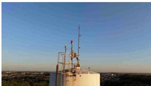
Foto 1 - As ilhoses que servem de suporte para o condutor do SPDA estão vazias.
