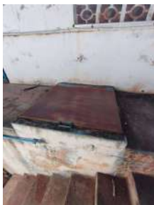
Foto 1 - Tampa de inspeção com corrosão.
