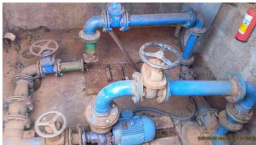
Foto 3 - Interior do recinto das bombas. Uma bomba está em operação, a reserva está ausente.
