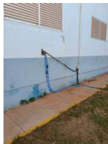
Foto 9 - Mangueiras que conduzem os reagentes até a captação.
