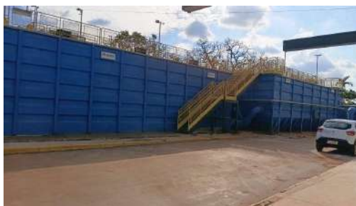
Foto 2 - Vista geral da ETA modular.
