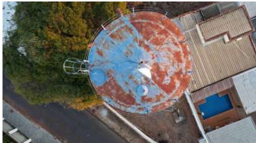
Foto 3 - Corrosão em vários pontos do reservatório.
