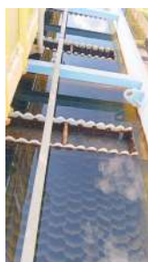
Foto 1 - Módulo de decantadores da linha dois da ETA está fora de nível e foi preciso adaptar vertedores, com os anteparos de plástico fabricados na oficina local da ETA.
