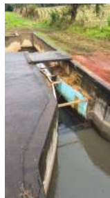
Foto 9 - Calha Parshall no final do desarenador com gradeamento manual.
