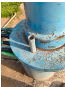
Foto 3 - O tubo de medição de nível está aberto, devendo ser fechado com cap.
