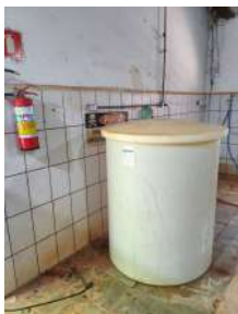
Foto 20 - Tanque do reagente para cloração e respectiva bomba dosadora.
