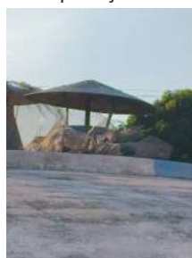
Foto 4 - Aberturas de ventilação sem tela de proteção.
