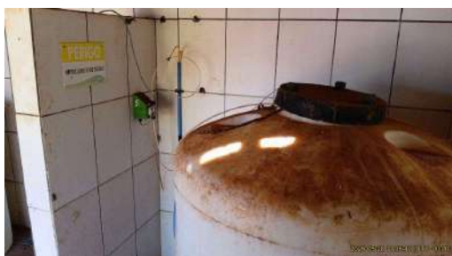
Foto 9 - Tanque para reagente de cloração e respectiva bomba dosadora.
