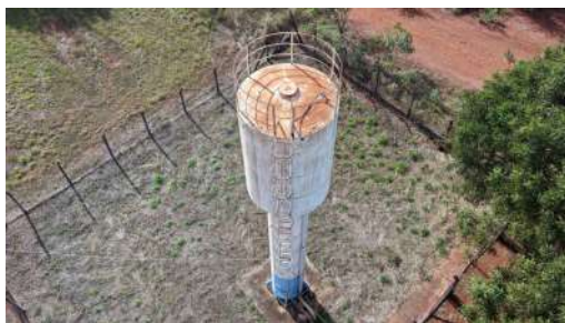
Foto 1 - Reservatório apresenta pintura desgastada e pontos de corrosão.
