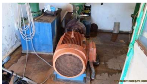
Foto 3 - Conjunto moto bomba 1.
