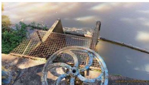
Foto 1 - Ponto de captação.
