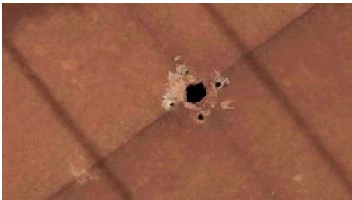
Foto 2 - Perfurações na tapa de inspeção.
