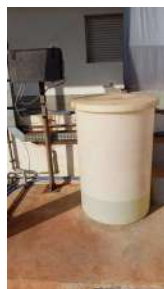
Foto 23 - Reservatório de reagente cloro para poço localizado na mesma área que a ETA.
