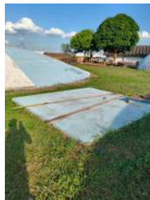
Foto 5 - Caixa de alvenaria adjacente aos reservatórios, contendo registros de manobra.
