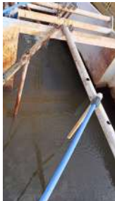
Foto 6 - Na entrada da água é adicionado hipoclorito para oxidação prévia.
