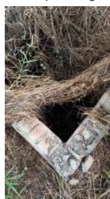
Foto 11 - Caixa de passagem na entrada da lagoa intermediária.
