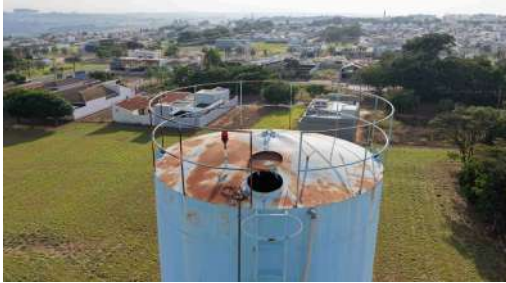
Foto 1 - Ausência de tubo de ventilação no reservatório.
