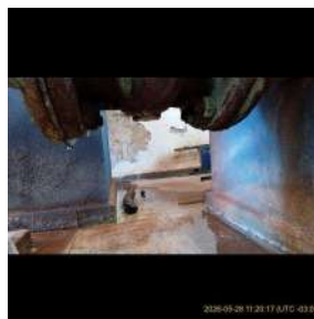
Foto 2 - A água que vaza escorre pela bomba 1 e se acumula sobre o piso.
