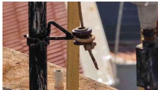
Foto 2 - Ponto de rompimento do condutor do SPDA.
