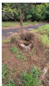
Foto 10 - Caixa de passagem na entrada da lagoa intermediária.
