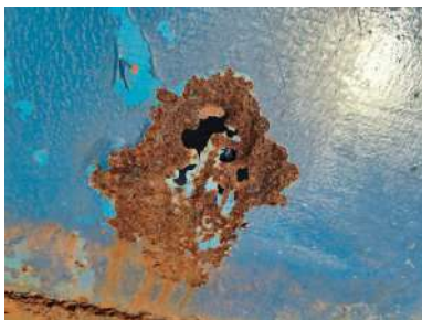
Foto 3 - Tampa de proteção apresenta corrosão.
