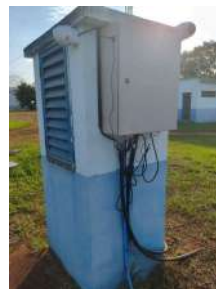
Foto 4 - Pannel elétrico de comando de equipamentos de telemetria.
