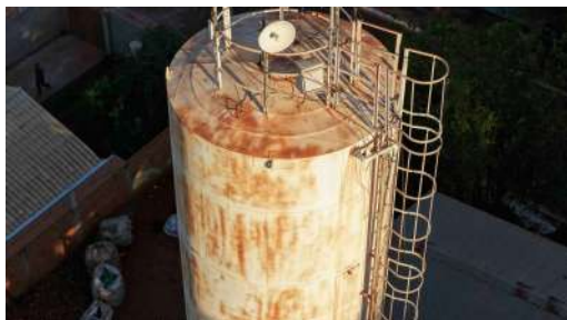
Foto 1 - Corrosão em vários pontos do reservatório.
