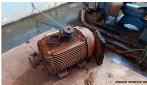
Foto 7 - Posição para a bomba reserva do booster.
