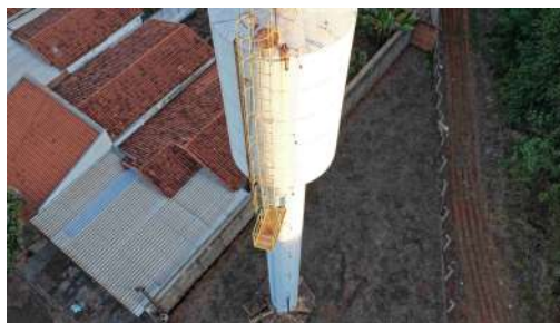
Foto 2 - As ilhoses que servem de suporte para o condutor do SPDA estão vazias.
