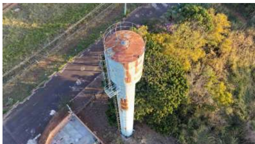
Foto 1 - Corrosão na estrutura.
