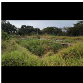
Foto 3 - Vegetação encobre os DAFAs 1 a 3, dificultando até mesmo a identificação dos limites da estrutura.
