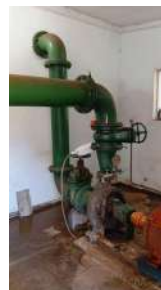
Foto 6 - Tubulação de recalque acima da bomba 2.
