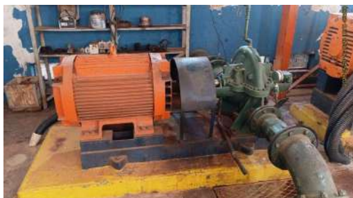
Foto 28 - Conjunto motobomba da EEA antiga (capacidade de bombeamento menor), utilizada como reforço quando necessário.
