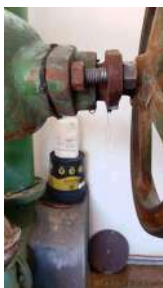
Foto 1 - Vazamento em registro na tubulação de recalque acima da bomba 1.
