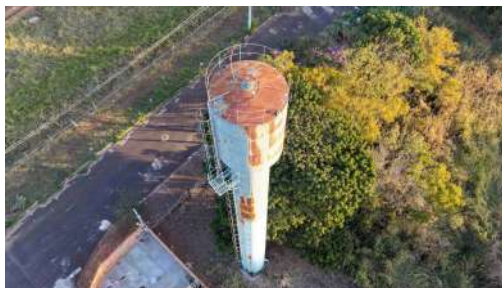
Foto 2 - Corrosão na estrutura.
