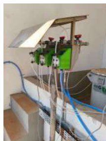
Foto 7 - Bombas peristálticas para dosagem de reagentes.
