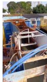
Foto 9 - Calha Parshall na entrada da ETA.
