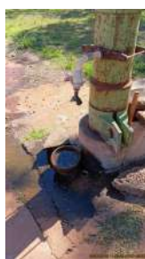
Foto 1 - Vazamento na torneira para coleta de água bruta.
