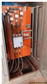
Foto 16 - Quadro de comando da bomba antiga da EEA.
