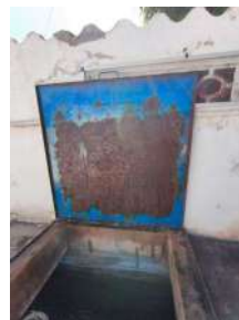
Foto 2 - Tampa de inspeção com corrosão.
