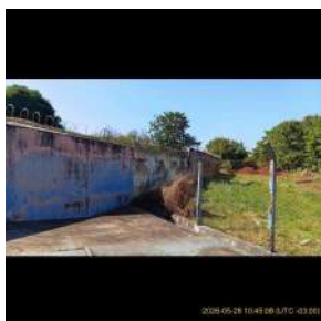
Foto 1 - Dano no cercamento da área.
