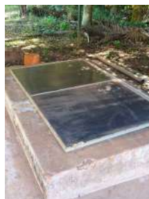
Foto 6 - Caixa de passagem que recebe a água dos dois drenos.
