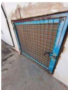
Foto 3 - Tampa de inspeção com corrosão.
