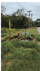
Foto 1 - Corrosão avançada em partes de metal próximo ao DAFA 1.
