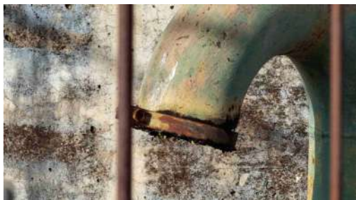
Foto 1 - Tubo de ventilação.
