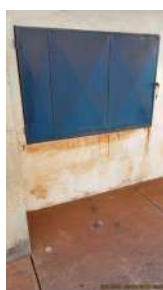
Foto 8 - Dejetos de animais nas laterais do reservatório, próximo a tampa de inspeção.
