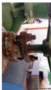
Foto 3 - Vazamento em registro da tubulação de alimentação da bomba 1.
