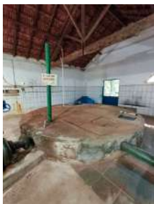
Foto 15 - Interior da edificação que abriga o poço de sucção onde são misturadas a água dos dois poços e dos dois drenos existentes na unidade.
