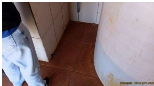
Foto 5 - Necessidade de limpeza na casa de produtos químicos.
