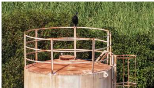
Foto 1 - Não é possível identificar sistema SPDA na estrutura.
