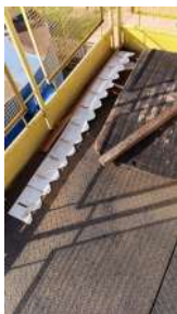
Foto 4 - Anteparos de plástico fabricados na oficina local da ETA.
