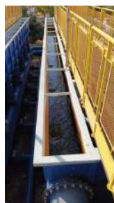
Foto 15 - Canal de distribuição na entrada dos filtros de uma das linhas.
