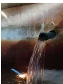
Foto 11 - Entrada de água no reservatório.
