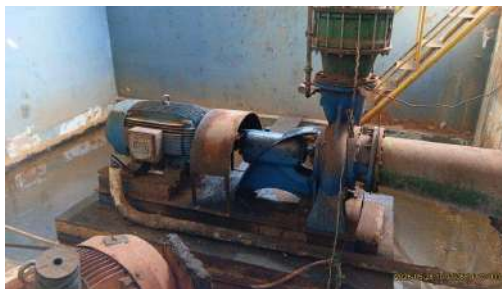
Foto 6 - Há uma lâmina d'água no piso do recinto onde se encontra o booster. Segundo o prestador, a água se deve em razão de infiltração a partir da
