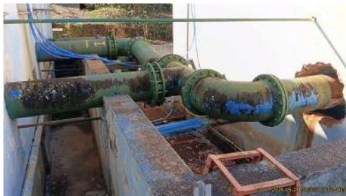
Foto 9 - Tubulação de recalque do booster.
