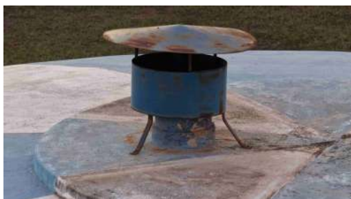
Foto 7 - Abertura de ventilação no topo do reservatório 2, sem tela de proteção.
