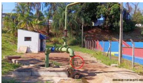
Foto 12 - Torneira para coleta de água bruta (destaque).
