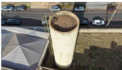
Foto 2 - Não foi evidenciado tubo extravasor na estrutura.
