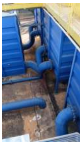
Foto 12 - Em cada linha da ETA, após os floculadores, tem-se dois decantadores. Cada decantador possui duas entradas (note o tubo que divide em dois).
