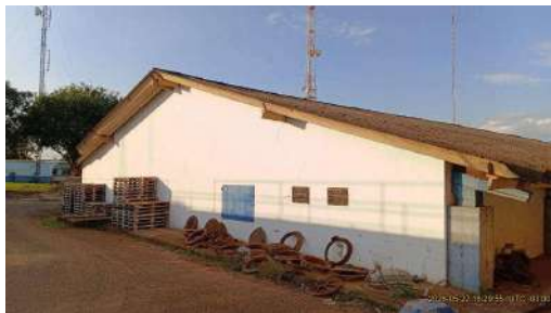
Foto 1 - Os inservíveis acumulados nas laterais do reservatório devem ser removidos.
