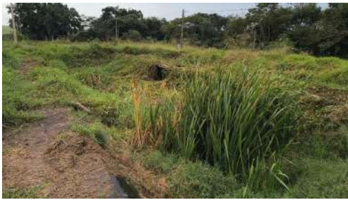
Foto 1 - Ao redor dos DAFAs 1 a 3, localizados próximo ao tratamento preliminar, não existe guarda corpo protegendo o perímetro, há risco de acidente. O mato alto existente no local dificulta a identificação dos limites dos DAFAs.
