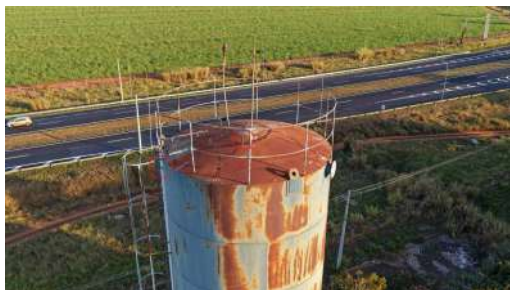
Foto 3 - Antena do SPDA no topo da estrutura e ilhoses vazias (em destaque).
