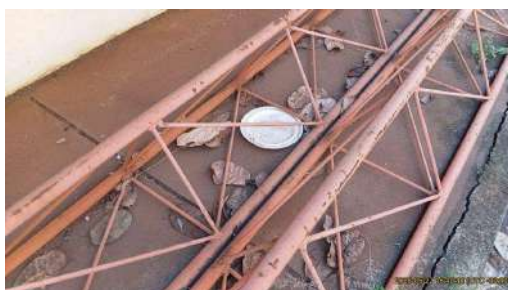
Foto 4 - Treliza metálica e sujeira depositados na lateral do reservatório.
