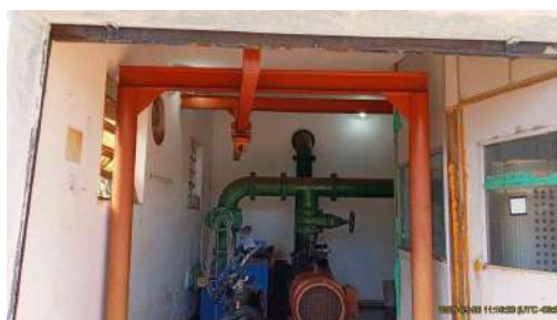
Foto 2 - Estrutura metálica para auxílio em manutenções.
