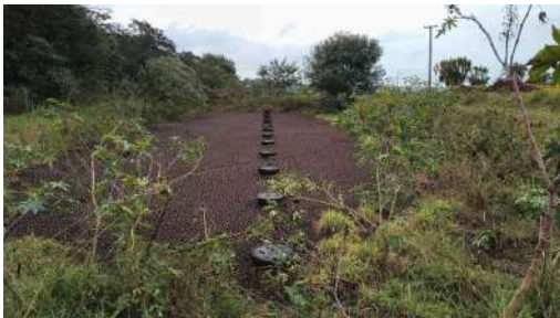
Foto 21 - Leito de secagem próximo aos DAFA 4 e 5. A presença de mato alto e o acúmulo de lodo indica ausência de manutenção.
