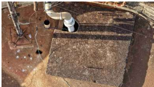
Foto 1 - Tampa de inspeção possui abertura que permite entrada de água de chuva e contaminantes.
