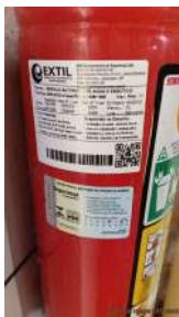
Foto 3 - Extintor de incêndio com prazo de manutenção vencido.
