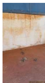
Foto 9 - Dejetos de animais nas laterais do reservatório, próximo a tampa de inspeção.
