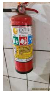
Foto 2 - Extintor de incêndio com prazo de manutenção vencido.
