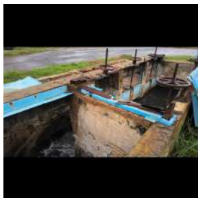
Foto 5 - Caixa de distribuição do efluentes à montante das lagoas apresenta estrutura comprometida pela corrosão em estado avançado.
