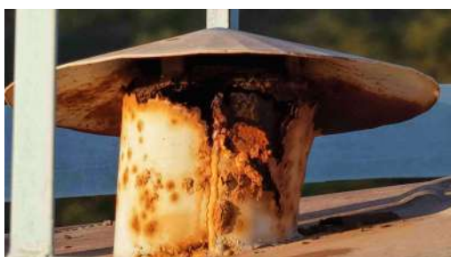
Foto 1 - Tubo de ventilação apresenta corrosão avançada.
