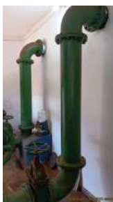
Foto 14 - Tubulação de alimentação das bombas.
