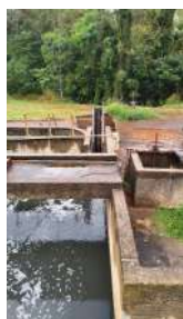
Foto 13 - Sistema de rosca sem fim para remoção do resíduo retido na caixa de areia.
