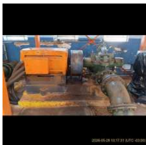
Foto 20 - Conjunto motobomba da EEA nova.
