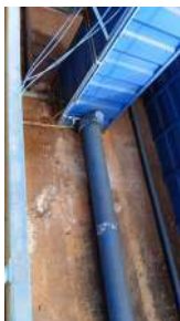
Foto 4 - Tubulação entrada de água.
