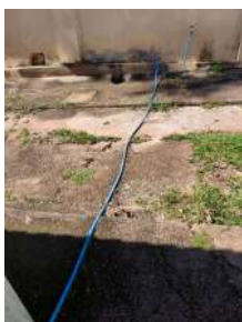
Foto 13 - Tubulação do reagente para cloração.
