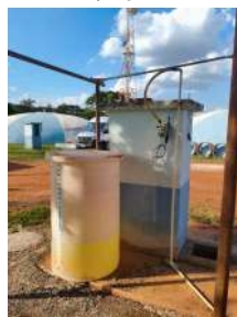
Foto 14 - Tanque de reagente nas vizinhanças do poço, para pré oxidação da água que alimenta a ETA localizada na mesma unidade.
