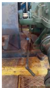
Foto 18 - Drenagem bomba EEA antiga.
