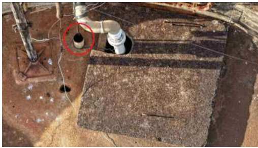
Foto 1 - Abertura de ventilação inadequada.
