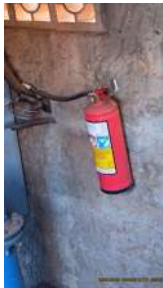
Foto 6 - Extintor presente na unidade.
