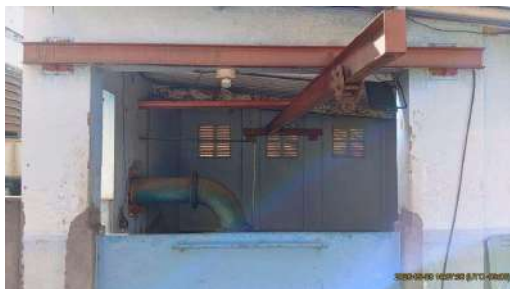
Foto 5 - Estrutura de metal para uso de talha quando da manutenção da bomba booster.
