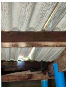
Foto 1 - Telha fora de posição.
