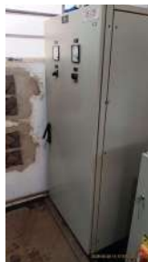
Foto 9 - Quadro de entrada de energia na unidade.
