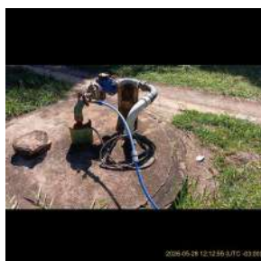
Foto 1 - Existe torneira para coleta de água bruta no cavalete. No momento da fiscalização, uma tubulação
