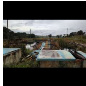
Foto 20 - DAFA 5. A passarela que o atravessava está colapsada.
