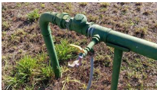
Foto 10 - Torneira para coleta de água bruta.
