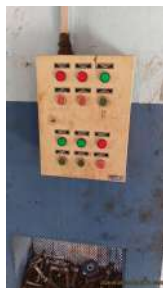
Foto 13 - Quadro de comando das bombas da EEA.
