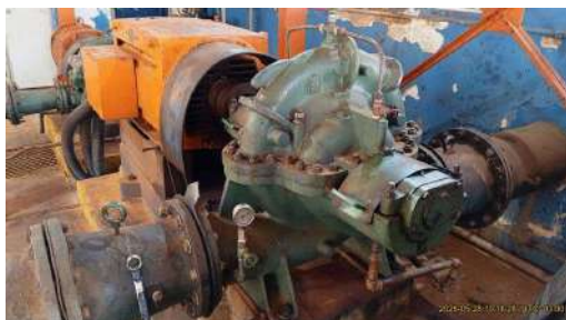
Foto 21 - Conjunto motobomba da EEA nova.
