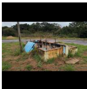
Foto 4 - Caixa de distribuição do efluentes à montante das lagoas apresenta estrutura comprometida pela corrosão em estado avançado.
