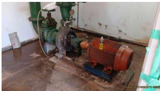
Foto 5 - Conjunto moto bomba 2.
