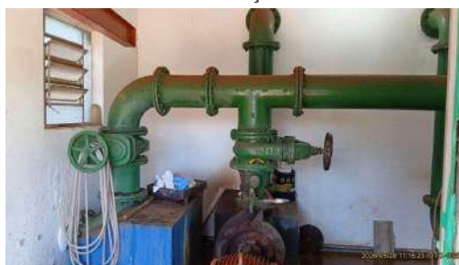
Foto 4 - Tubulação de recalque.
