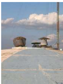
Foto 1 - Aberturas de ventilação sem tela de proteção.
