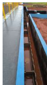
Foto 25 - Distribuidor na entrada dos novos DAFAs.
