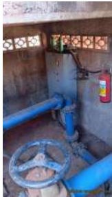
Foto 5 - Extintor presente na unidade.
