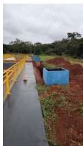
Foto 28 - Caixas de passagem para descarte de lodo dos novos DAFAs.
