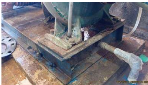
Foto 15 - Drenagem da água de lubrificação de gaixeta da bomba 1.
