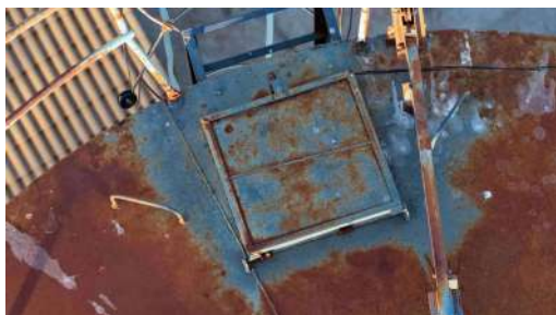
Foto 1 - Tampa de inspeção apresenta corrosão.
