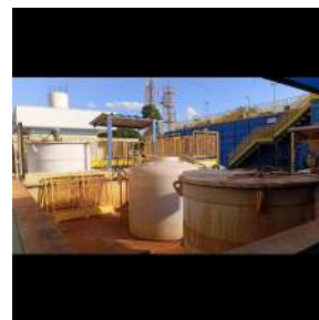
Foto 27 - Tanques dos reagentes \text{FeCl}_3 e cal.
