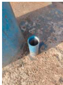
Foto 4 - O tubo da imagem, na base de alvenaria da saída do poço tubular, está aberto e deve ser fechado com cap.
