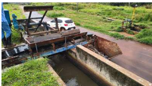
Foto 7 - Sistema de esteira e caçamba para armazenamento do material retido no gradeamento automatizado.
