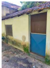
Foto 21 - Vista externa da edificação dentro da qual está o poço de sucção, a EEA e os tanques de reagentes empregados no tratamento.
