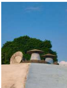
Foto 1 - Aberturas de ventilação sem tela de proteção.
