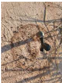
Foto 1 - Apesar do poço estar ligado, não saiu água da torneira indicada pelo representante do prestador para coleta de água bruta.
