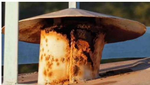
Foto 1 - Abertura de ventilação sem tela.
