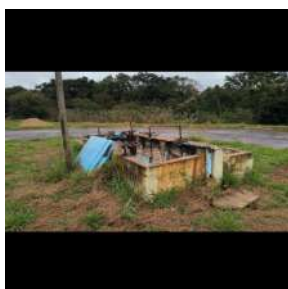
Foto 30 - Caixa de passagem que recebe o efluente dos DAFAs e o efluente vindo do tratamento preliminar, para distribuí-los às lagoas.
