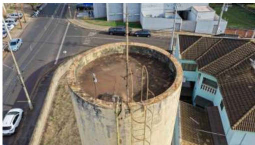
Foto 1 - Parte superior do reservatório sem guarda corpo.
