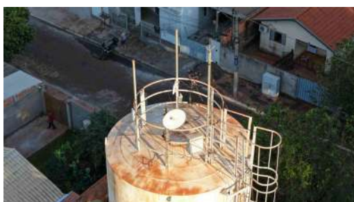
Foto 1 - Ausência de tubo de ventilação no reservatório.
