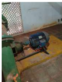
Foto 28 - Conjunto motobomba 2 da EEA.
