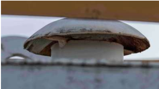
Foto 1 - Abertura de ventilação sem tela de proteção.
