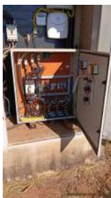
Foto 17 - Pannel elétrico de comando da bomba do poço.
