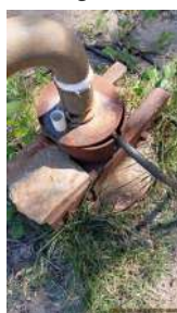
Foto 7 - Tubo para medição de nível. Recomenda-se fechá-lo com cap.
