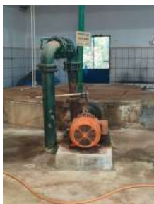
Foto 27 - Conjunto motobomba 1 da EEA.
