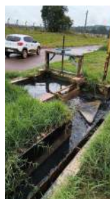
Foto 14 - Caixa de distribuição na entrada do DAFA
