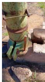
Foto 4 - Tubo para medição de nível. Recomenda-se fechar sua extremidade com cap.
