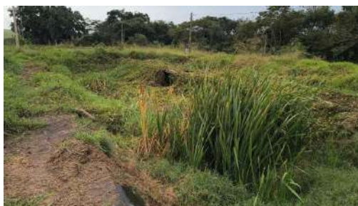
Foto 2 - Vegetação encobre os DAFAs 1 a 3, dificultando até mesmo a identificação dos limites da estrutura.
