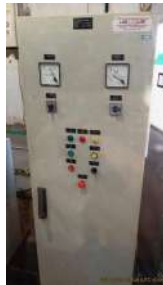
Foto 7 - Painele de controle das bombas da EEA.
