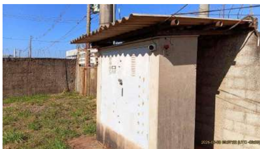
Foto 5 - Cabine com comando elétrico do poço.
