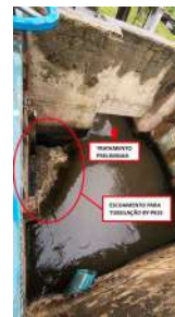
Foto 2 - Escoamento para by-pass constatado durante a fiscalização.
