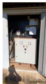
Foto 16 - Pannel elétrico de comando da bomba do poço.
