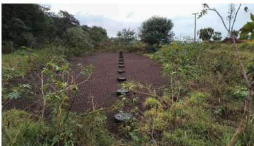
Foto 1 - Leito de secagem de lodos provenientes dos DAFAs apresenta acúmulo de material e mato alto.
