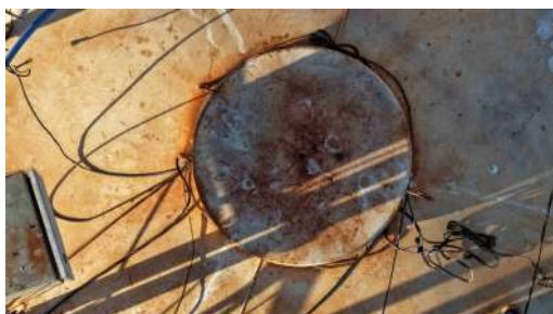
Foto 1 - Tampa de inspeção apresenta corrosão.
