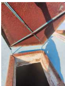
Foto 1 - Tampa de inspeção apresenta corrosão.
