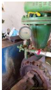
Foto 11 - Manômetro na linha de recalque da bomba 1.
