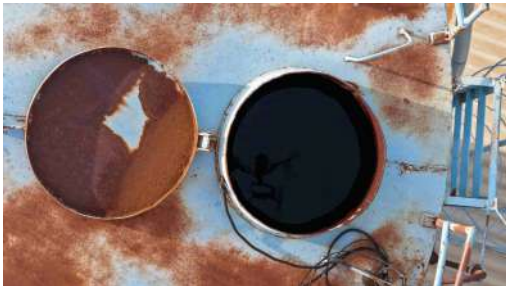
Foto 1 - Tampa de inspeção apresenta corrosão e se encontra aberta.
