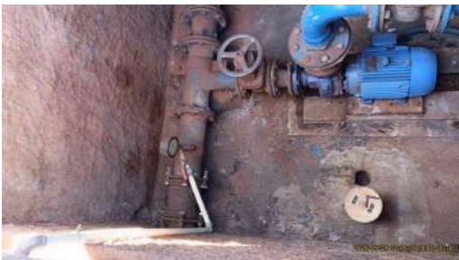
Foto 4 - Manômetro na linha de alimentação.
