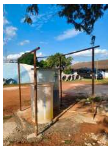
Foto 2 - Tratar a corrosão e pintar a estrutura para cobertura do tanque de cloro. Instalar a cobertura faltante.
