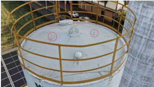
Foto 2 - Em destaque,o que parece ser dois tubos soldados na cobertura do reservatório.
