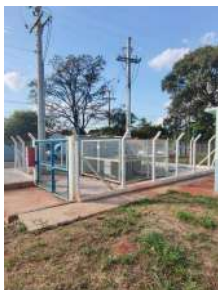
Foto 18 - Entrada de energia na unidade, para alimentação do poço e também da ETA.
