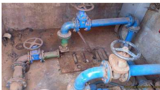
Foto 1 - Bomba reserva ausente.
