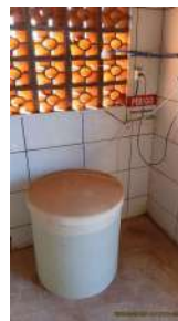
Foto 12 - Tanque de armazenamento de reagente para fluoretação e respectiva bomba para dosagem.
