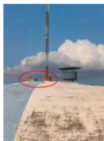
Foto 4 - Ausência de tela de proteção na abertura de ventilação. Aberturas de ventilação assinaladas permitem inclusive a entrada de água de chuva.
