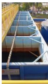
Foto 14 - Em cada linha da ETA, após os decantadores, há sete filtros em paralelo.
