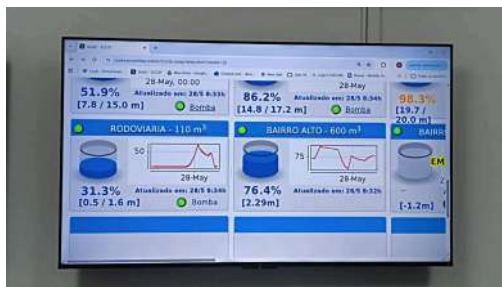
Foto 14 - Interface no CCO do prestador exibindo nível do reservatório.
