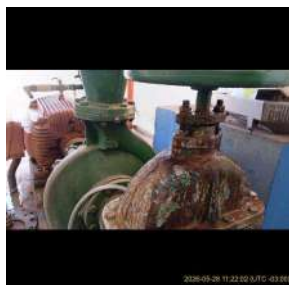
Foto 5 - Registro da tubulação de alimentação da bomba 1.
