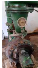
Foto 10 - Manômetro na linha de recalque da bomba 2.
