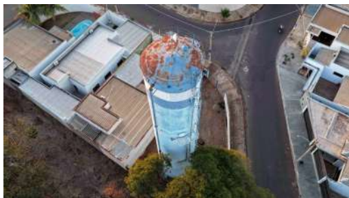
Foto 1 - Corrosão em vários pontos do reservatório.
