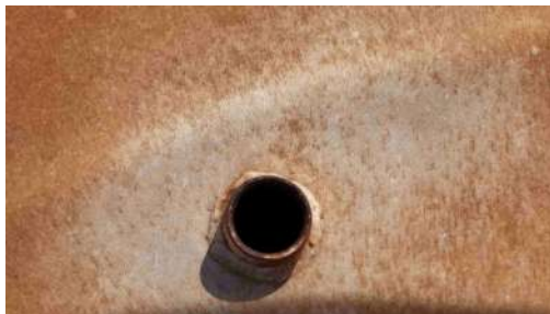
Foto 4 - Aberturas de ventilação (destaque) na parte superior do reservatório não possuem tela de proteção e permitem a entrada de água de chuva.
