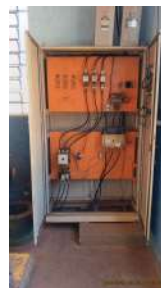
Foto 14 - Quadro de comando do booster.
