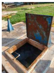
Foto 11 - Caixa de passagem adjacente ao poço.
