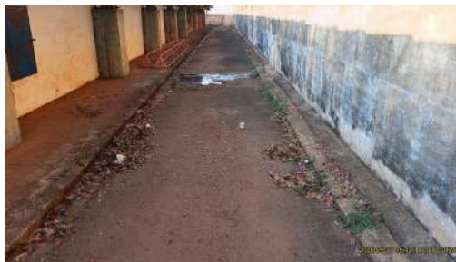
Foto 2 - Acúmulo de sujeira na lateral do reservatório.
