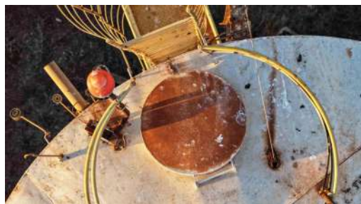
Foto 1 - Tampa de inspeção apresenta corrosão.
