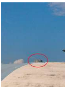
Foto 3 - Abertura de ventilação permite a entrada de água de chuva
