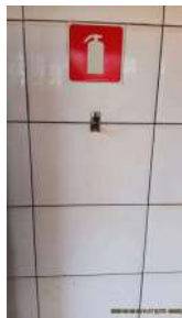
Foto 1 - Ausência de extintor de incêndio.
