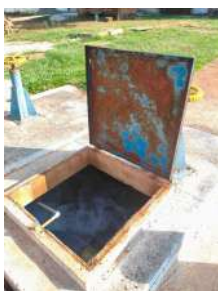
Foto 1 - Tratar a corrosão e pintar a tampa de inspeção da caixa de passagem onde ocorre a adição dos reagentes do tratamento da água captada.
