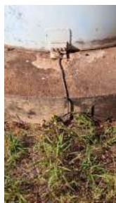
Foto 5 - Condutor de aterramento SPDA.
