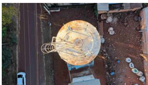
Foto 2 - Ausência de tubo de ventilação no reservatório.
