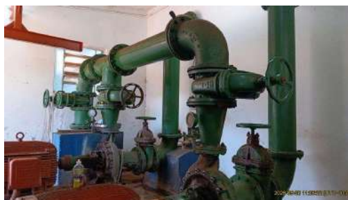
Foto 13 - Tubulação de recalque das bombas.
