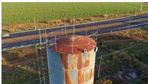
Foto 1 - Ausência de tubulação de ventilação.
