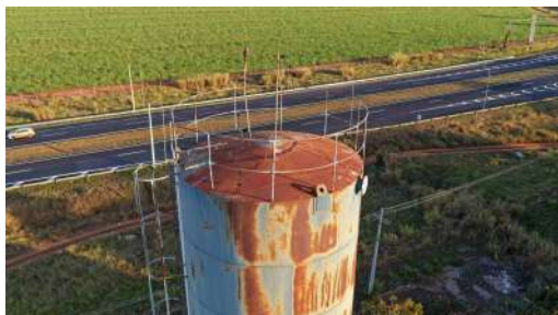
Foto 3 - Corrosão na estrutura.
