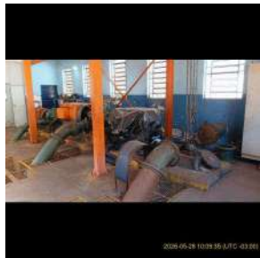
Foto 2 - A bomba reserva da EEA nova (posição à direita) está ausente; segundo representante do prestador, ela está em manutenção.
