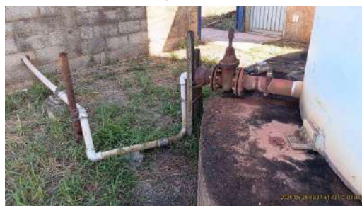
Foto 9 - Tubo de drenagem do reservatório. A torneira é utilizada para coleta de água reservada.
