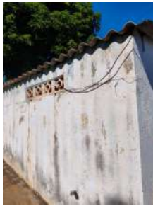
Foto 1 - Abertura de ventilação sem tela.
