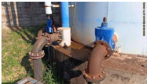
Foto 1 - Foi identificado vazamento no ponto de adição dos reagentes empregados no tratamento. A água que vaza escorre até a base de alvenaria do reservatório.
