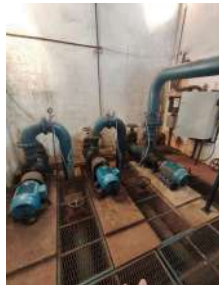
Foto 17 - Vista geral das bombas da EEA.
