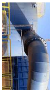
Foto 19 - Ponto de adição de cloro, flúor e ortofosfato, após os filtros e antes do tanque de contato.
