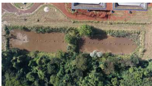
Foto 57 - Leitos de secagem do lodo retirado dos DAFAs.
