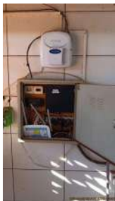
Foto 13 - Pannel elétrico para equipamentos de telemetria.
