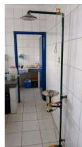
Foto 32 - Chuveiro de emergência e lava olhos.
