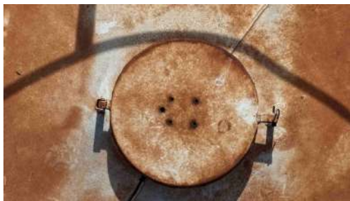
Foto 1 - Tampa de inspeção apresenta corrosão e perfurações.
