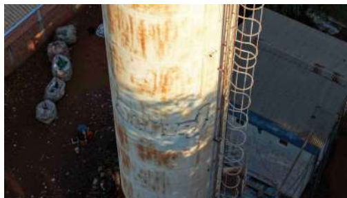
Foto 2 - Corrosão em vários pontos do reservatório.
