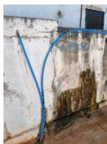
Foto 12 - Mangueiras para dosagem de reagente e vazamento.
