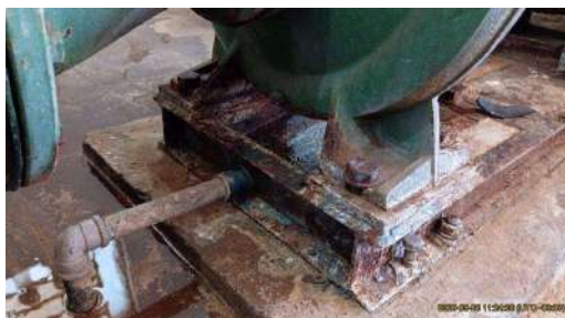
Foto 16 - Drenagem da água de lubrificação de gaixeta da bomba 2.
