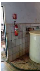
Foto 1 - Extintor de incêndio com prazo de manutenção vencido.
