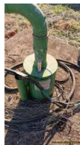
Foto 8 - Tubo de medição de nível.
