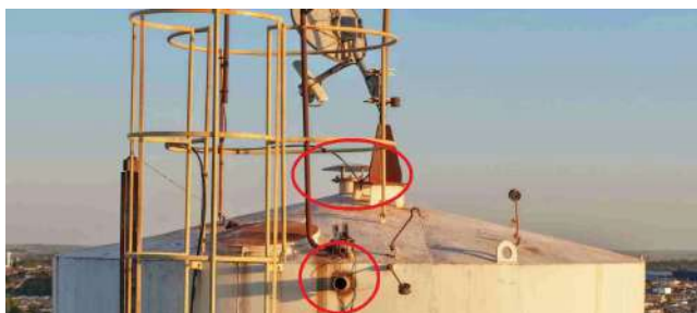
Foto 1 - Abertura de ventilação e tubo extravasor não possuem tela de proteção.
