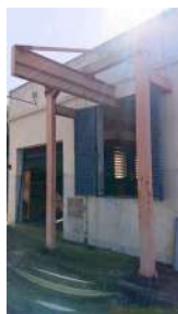
Foto 11 - Estrutura metálica para auxílio quando da manutenção da EEA.
