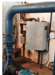
Foto 16 - Painel elétrico comando das bombas.
