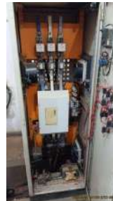
Foto 8 - Painele de controle das bombas da EEA.
