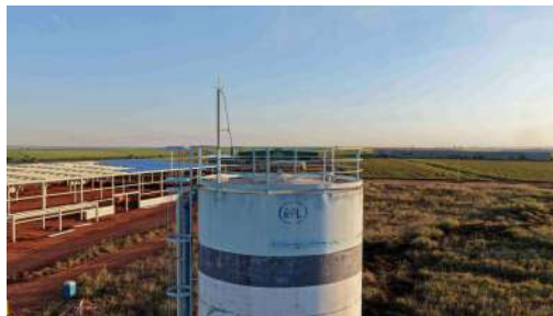
Foto 15 - Vista da parte superior do reservatório, em perfil, indicando antena do SPDA.
