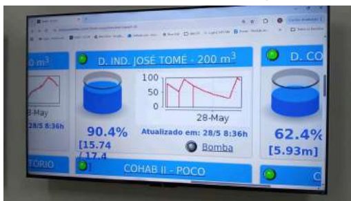
Foto 10 - Interface no CCO do Prestador apresentando nível do reservatório.
