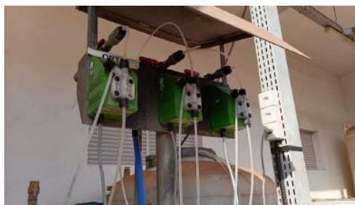
Foto 25 - Bombas para dosagem de ortopolifosfato e flúor para saída da ETA e flúor para poço localizado na mesma área.
