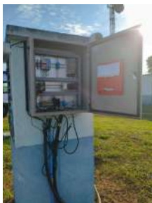
Foto 3 - Pannel elétrico de comando de equipamentos de telemetria.
