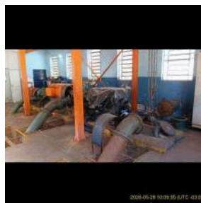
Foto 12 - Da esquerda para a direita tem-se a motobomba da elevatória antiga (década de 60, possui capacidade de bombeamento menor), utilizada em casos de emergência. A bomba do meio e a da direita (ausente, em manutenção) compõem a elevatória construída na década de 80, sendo as bombas atualmente em uso.
