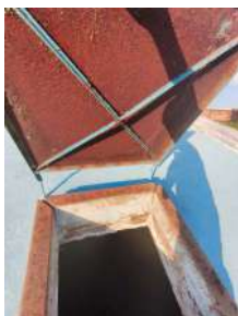
Foto 4 - Face inferior da tampa de inspeção.
