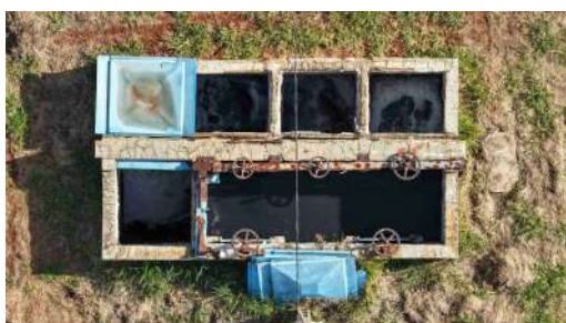
Foto 59 - Caixa de distribuição posicionada a montante das lagoas.
