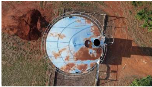
Foto 1 - Corrosão na parte superior do reservatório.
