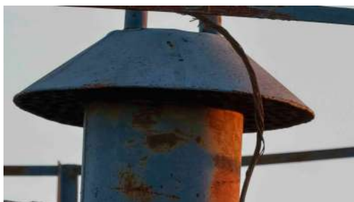
Foto 1 - Abertura de ventilação sem tela de proteção.
