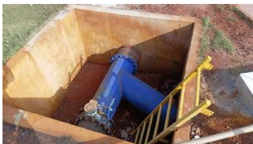
Foto 1 - Caixa de alvenaria com adutora e registro de manobra para alimentação da ETA.
