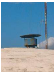
Foto 1 - Ausência de tela de proteção na abertura de ventilação.
