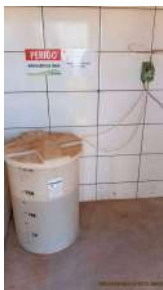
Foto 11 - Tanque de armazenamento de reagente para cloração e respectiva bomba para dosagem.
