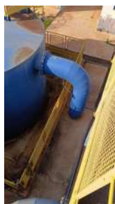
Foto 18 - Tubulação de saída dos tanques de contato. A água segue para reservatório.
