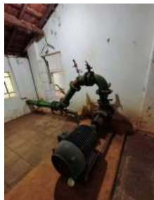
Foto 24 - Conjunto motobomba 2 existente no local, em recinto adjacente ao conjunto motobomba 1.
