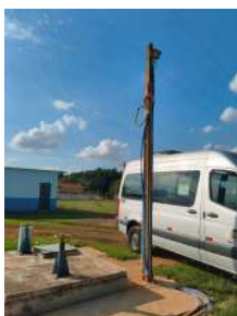
Foto 10 - A adição dos reagentes ocorre na caixa de passagem adjacente ao poço.
