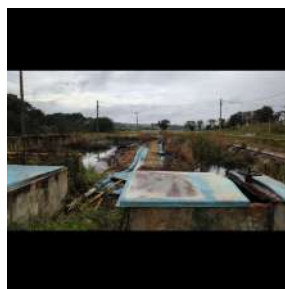
Foto 2 - Os guarda corpos ao redor dos DAFAs 4 e 5 estão colapsando ou ausentes em alguns pontos, incluindo a passarela que passa sobre a estrutura, sendo necessário recuperação.
