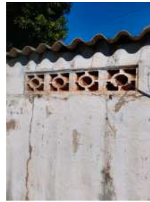
Foto 2 - Abertura de ventilação sem tela.
