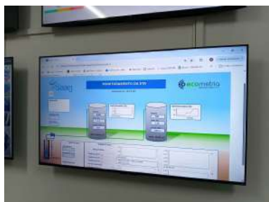
Foto 1 - A interface do CCO do prestador acusa nível 100% para o reservatório, continuamente, em razão da queima do sensor após descarga atmosférica.
