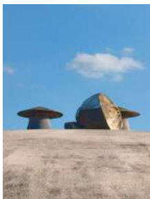
Foto 3 - Aberturas de ventilação sem tela de proteção.
