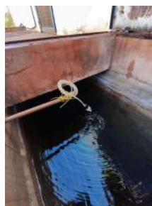
Foto 6 - Vista do interior do reservatório. Dosagem de reagente.
