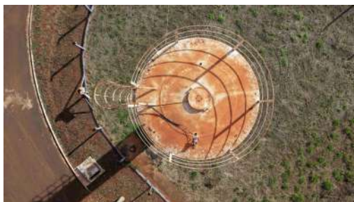
Foto 3 - Reservatório apresenta pintura desgastada e pontos de corrosão.
