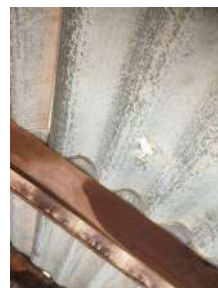
Foto 2 - Dano em telha.
