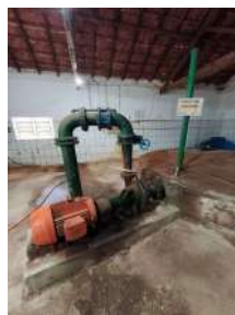
Foto 17 - Conjunto motobomba 1 existente em edificação da unidade. Recalca água do poço de sucção adjacente para a rede (abastecimento em marcha) e para o reservatório da Av. José da Costa.
