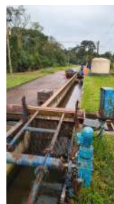
Foto 6 - Canal desarenador possuindo gradeamento automatizado e peneira rotativa.
