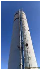
Foto 3 - Tubo extravasor (branco à esquerda).
