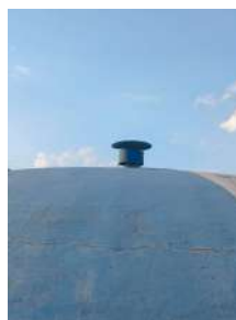
Foto 2 - Ausência de tela de proteção na abertura de ventilação.
