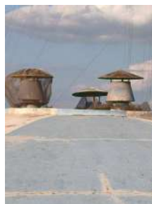
Foto 2 - Aberturas de ventilação sem tela de proteção.
