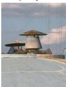
Foto 3 - Aberturas de ventilação sem tela de proteção.
