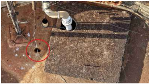
Foto 1 - Abertura na laje deve ser fechada.
