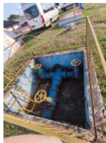
Foto 11 - Caixa de alvenaria adjacente aos reservatório, com registros de manobra.
