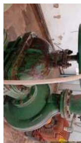
Foto 6 - Vazamento em registro da tubulação de alimentação junto à bomba 2.
