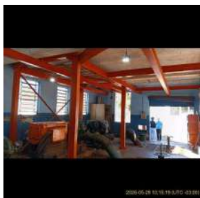
Foto 17 - Estrutura metálica para auxílio em manutenções.
