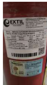
Foto 6 - Prazo para manutenção extintor 2.
