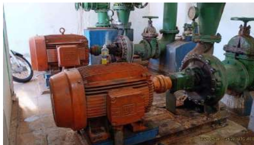
Foto 12 - Bomba 2 (frente) e 1 (fundo).
