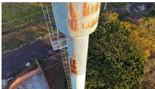
Foto 2 - Ilhoses suporte do condutor do SPDA estão vazias.
