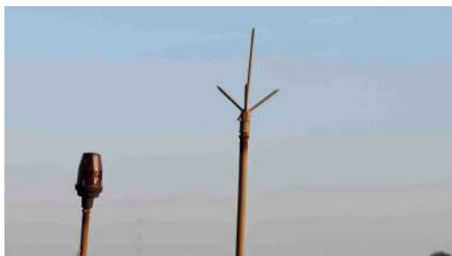
Foto 1 - Antena do SPDA no topo da estrutura.
