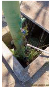
Foto 1 - Vegetação crescendo junto ao cavalete.
