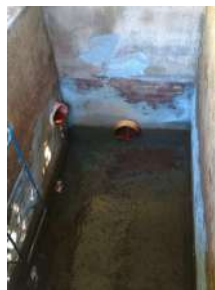
Foto 4 - Caixa de passagem que recebe a água dos dois drenos.
