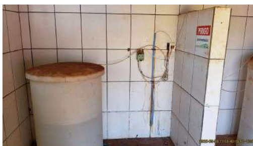
Foto 8 - Tanque para reagente de fluoretação e respectiva bomba dosadora.
