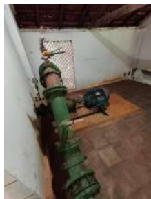
Foto 23 - Conjunto motobomba 2 existente no local, em recinto adjacente ao conjunto motobomba 1.
