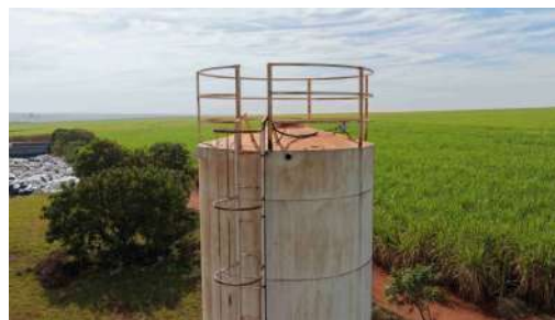
Foto 2 - Reservatório apresenta pintura desgastada e pontos de corrosão.
