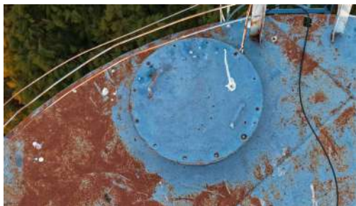
Foto 2 - Corrosão em vários pontos do reservatório.
