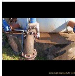
Foto 2 - Base molhada em razão do vazamento.
