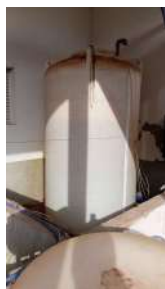
Foto 22 - Reservatório de reagente cloro para ETA.
