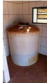
Foto 2 - Necessidade de limpeza na casa de produtos químicos.
