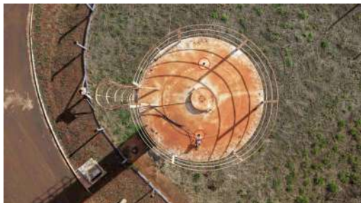
Foto 3 - Aberturas de ventilação (destaque) na parte superior do reservatório não possuem tela de proteção e permitem a entrada de água de chuva.
