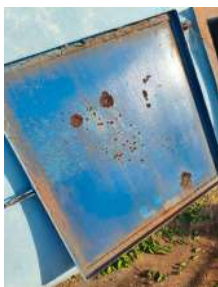
Foto 1 - Tampa de proteção apresenta corrosão.
