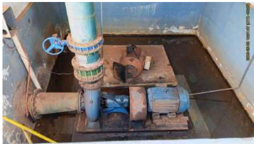
Foto 1 - Bomba chamada booster pelo prestador.
