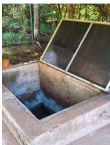
Foto 5 - Caixa de passagem que recebe a água dos dois drenos.
