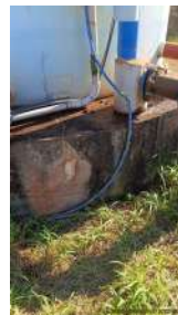
Foto 14 - Ponto de adição de reagentes na entrada do reservatório.
