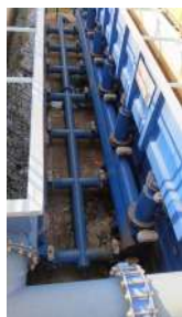
Foto 16 - As tubulações na parte inferior são as saídas dos filtros.
