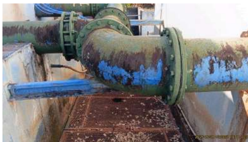
Foto 10 - Abaixo do piso de gradil metálico está a tubulação de sucção do booster.
