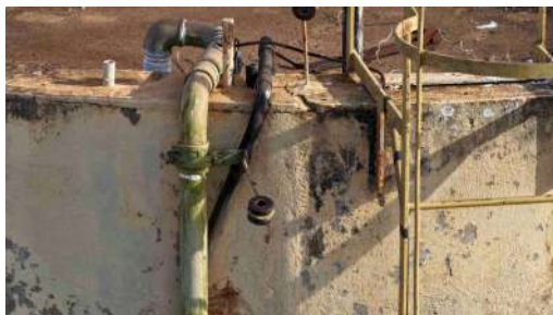
Foto 3 - Ilhoses suporte vazias abaixo do ponto de rompimento do condutor.
