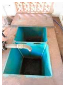
Foto 12 - Caixa que recebe a água dos drenos.
