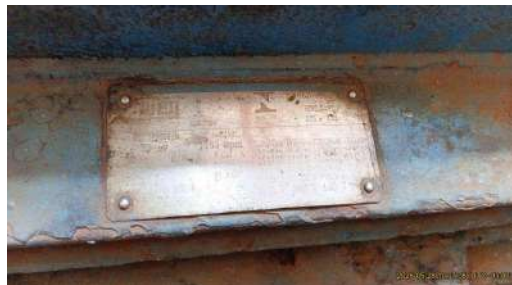
Foto 8 - Placa com dados técnicos do motor em funcionamento no booster.
