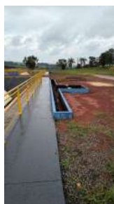
Foto 24 - Distribuidor na entrada dos novos DAFAs.
