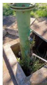
Foto 2 - Vazamento em registro existente no cavalete.
