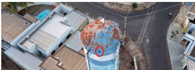
Foto 3 - Extravasor (destacado) sem tela de proteção.
