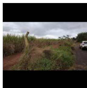
Foto 2 - Dano no cercamento, próximo à saída das lagoas.
