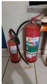
Foto 1 - Extintores existentes na unidade.
