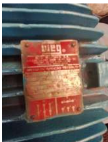
Foto 11 - Placa com especificações do motor 1.
