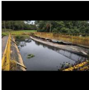
Foto 19 - DAFA 4. A passarela que o atravessava está colapsada.
