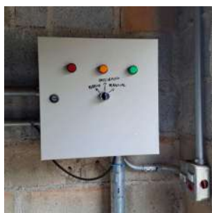
Foto 3 - Painel de comando e controle
