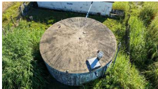
Foto 2 - Reservatório Jardim Itália (circular)
