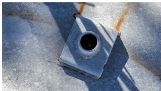
Foto 2 - Tubulação de ventilação, sem proteção
