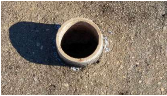
Foto 3 - Tubulação de ventilação, sem proteção
