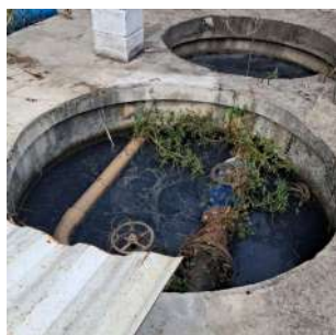
Foto 1 - Barrilete com acúmulo de esgoto
