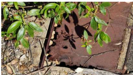
Foto 2 - Tampas de inspeção danificadas
