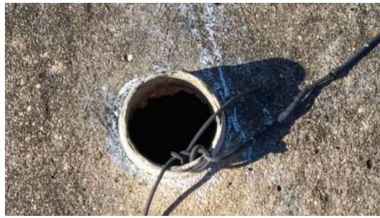
Foto 4 - Tubulação de ventilação, sem proteção
