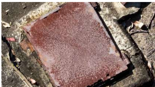
Foto 1 - Tampas de inspeção danificadas
