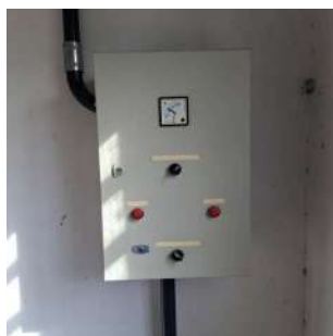
Foto 4 - Pannel de comando e controle
