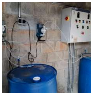
Foto 6 - Dosagem de cloro e flúor (no booster)
