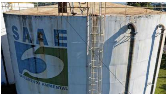
Foto 1 - Pontos de oxidação na lateral do reservatório
