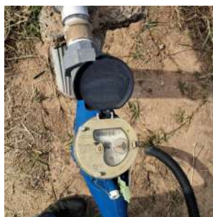
Foto 4 - Medidor de vazão
