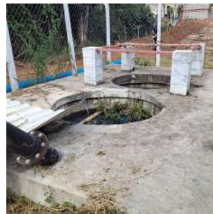
Foto 3 - Vista interna da estação elevatória de esgoto Vale Verde III
