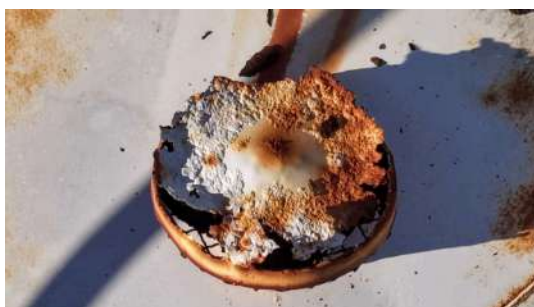
Foto 2 - Respiro e ventilação danificados
