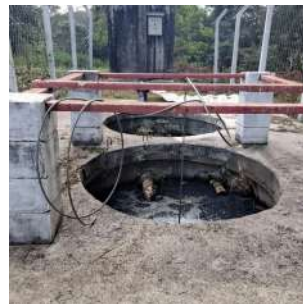
Foto 5 - Vista do acúmulo de esgoto no barrilete e poço de sucção
