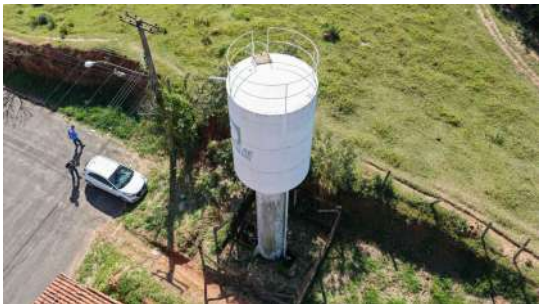
Foto 1 - Ausência do portão de acesso
