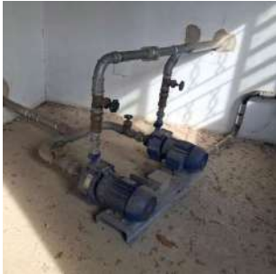
Foto 3 - Vista do interior da casa de bombas
