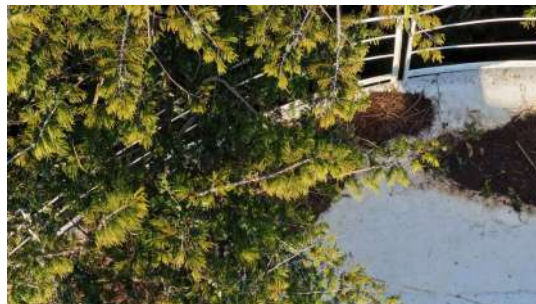
Foto 2 - Vista da cobertura com galhos da árvore
