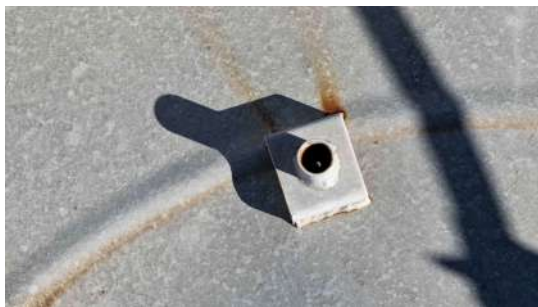
Foto 3 - Tubulação de ventilação, sem proteção
