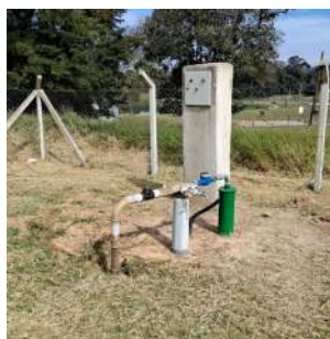
Foto 2 - Cavalete do poço Morada da Baroneza II
