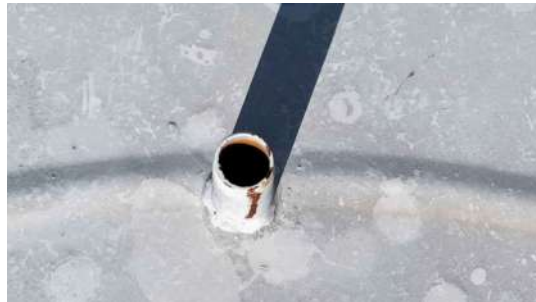
Foto 2 - Tubulação de ventilação, sem proteção
