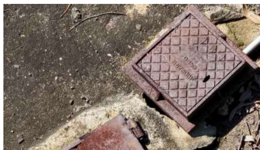
Foto 4 - Tampa de inspeção com aberturas
