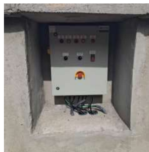
Foto 7 - Pannel de comando e controle
