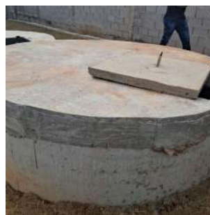
Foto 5 - Poço de sucção, contendo as bombas submersíveis e cesto para coleta de resíduos
