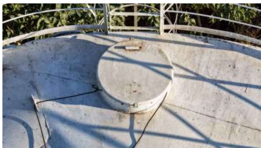
Foto 7 - Tampa de proteção fechada
