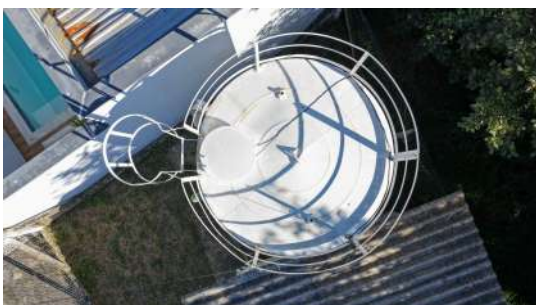
Foto 1 - Vista superior da tubulação de ventilação
