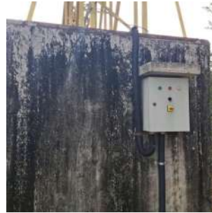
Foto 2 - Painel de Comando e Controle
