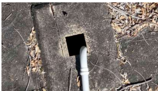
Foto 3 - Entrada de tubulação aberta na cobertura do reservatório
