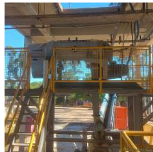
Foto 68 - Centrífuga de lodo.
