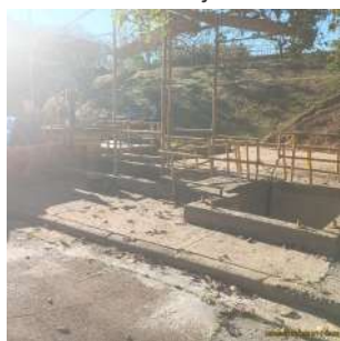
Foto 5 - Chegada do esgoto do emissário Guaraú.
