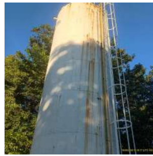
Foto 2 - Pontos de oxidação na lateral superior do reservatório.
