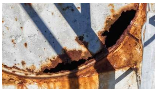
Foto 2 - Situação da tampa de inspeção.
