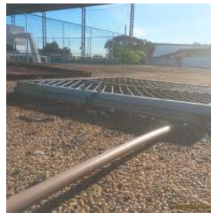
Foto 2 - Tampa de inspeção inadequada.
