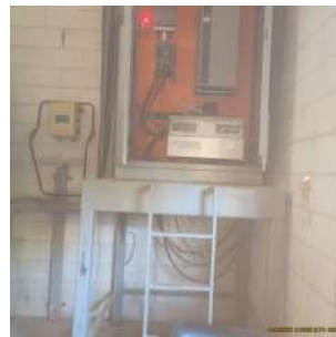
Foto 11 - Painéis elétricos e de comando.
