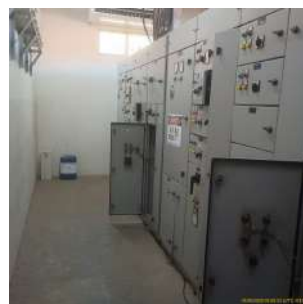
Foto 14 - Painéis elétricos e de comando.
