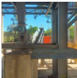
Foto 69 - Centrífuga de lodo.
