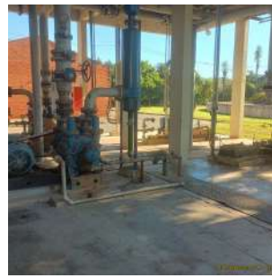
Foto 43 - Vista geral dos compressores e equipamentos de vácuo.
