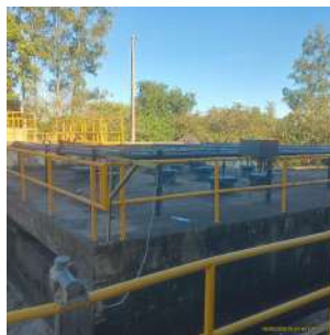
Foto 37 - Tubulações de aplicação de ar no tanque profundo.
