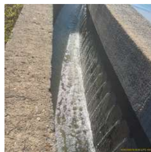
Foto 50 - Saída do efluente do decantador 1.
