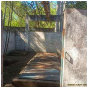
Foto 4 - Pórtico para içamento das bombas.
