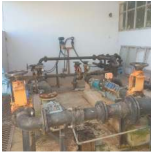
Foto 62 - Bombas de recalque do lodo adensado para a centrífuga.
