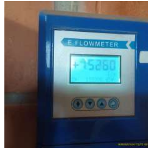
Foto 10 - Tela indicando vazão bombeada.
