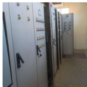
Foto 13 - Painéis elétricos e de comando.
