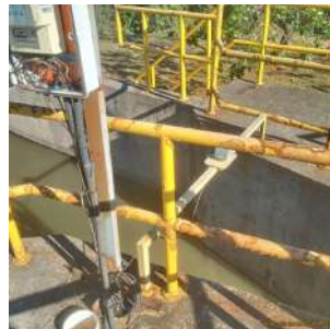
Foto 29 - Macromedidor na calha Parshall.
