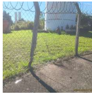
Foto 2 - Trecho do alambrado danificado.
