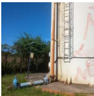
Foto 1 - Oxidação em tubulação lateral do reservatório.
