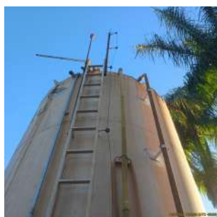
Foto 1 - Vista do tubo extravasor sem tela de proteção.
