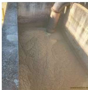
Foto 33 - Recirculação do lodo dos desarenadores, antes do tanque Deep Shaft. Apenas 1 módulo em operação, devido a vazão.
