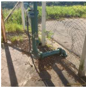
Foto 1 - Parte do alambrado que está danificado.
