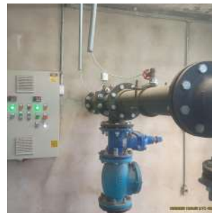
Foto 11 - Vista do painel elétrico da EEAT.
