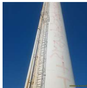
Foto 2 - Oxidação em tubulação lateral do reservatório.
