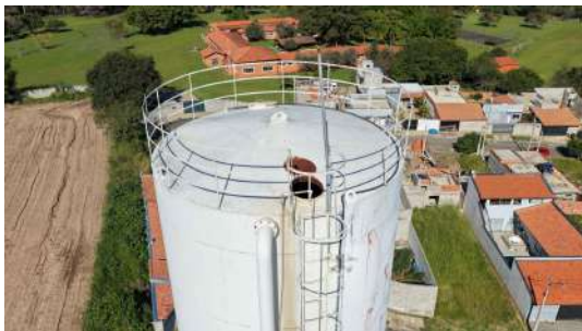
Foto 1 - Ausência de haste de captação e sistema de descida do SPDA.
