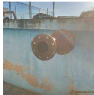
Foto 2 - Ausência de tela de proteção no tubo extravasor.
