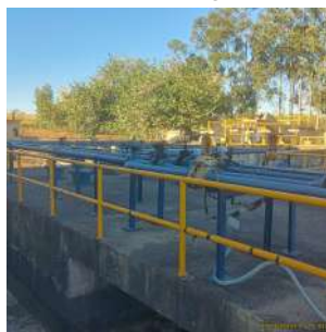
Foto 35 - Tubulações de aplicação de ar no tanque profundo.
