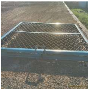
Foto 1 - Tampa de inspeção inadequada.
