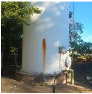
Foto 1 - Ponto de oxidação na lateral do reservatório.
