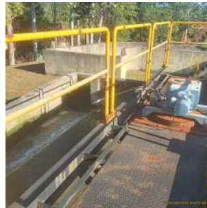
Foto 26 - Desarenador 1 (em operação).
