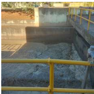
Foto 38 - Efluente que já emergiu do tanque.
