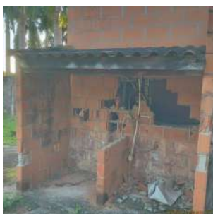
Foto 1 - Situação da parede do abrigo da bomba.
