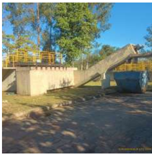
Foto 23 - Desarenador 1 (em operação).
