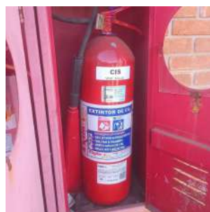
Foto 4 - Extintor de incêndio com validade expirada.
