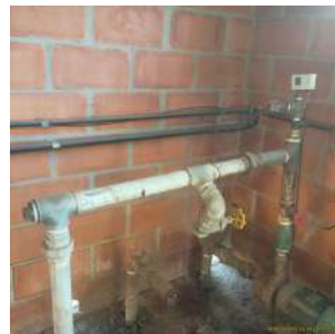
Foto 6 - Barrilete de recalque.
