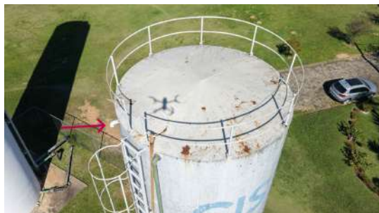
Foto 3 - Indicação do tubo extravasor sem tela.
