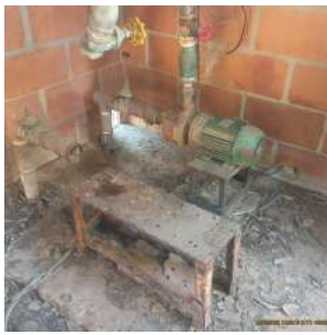
Foto 7 - Único conjunto motobomba do local.
