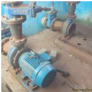
Foto 1 - Único conjunto motobomba instalado na EEAT.
