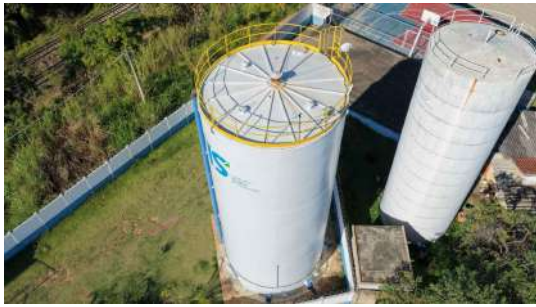
Foto 1 - Ausência de SPDA (haste e descida).
