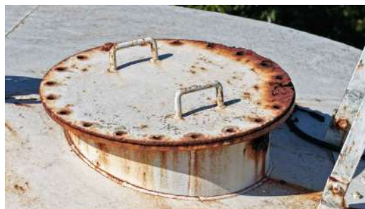
Foto 2 - Situação da tampa do reservatório.
