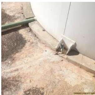
Foto 7 - Aterramento da estrutura do reservatório.
