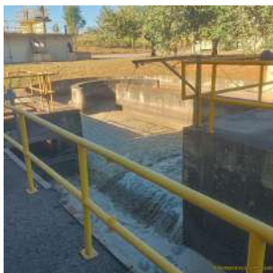
Foto 36 - Efluente que já emergiu do tanque.
