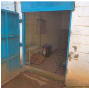
Foto 12 - Vista interna do abrigo dos painéis.
