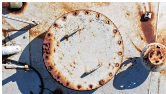
Foto 1 - Situação da tampa do reservatório.
