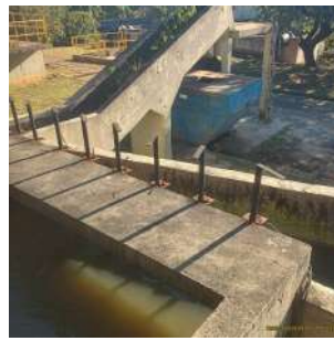
Foto 24 - Desarenador 1 (em operação).
