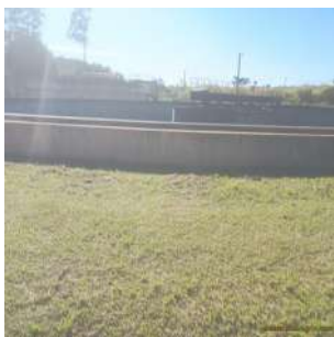
Foto 51 - Decantador 3, não está em operação.
