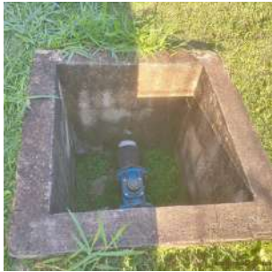
Foto 3 - Caixa de registros/passagem sem fechamento superior.
