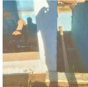
Foto 4 - Vista interna da casa de bombas.
