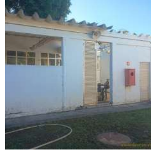
Foto 2 - Ausência de parte da cobertura do abrigo das bombas.
