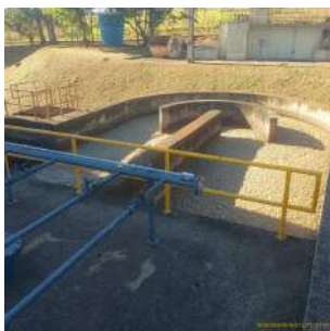
Foto 34 - Módulo em operação.
