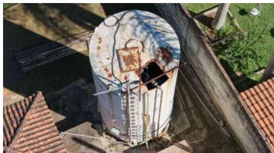
Foto 3 - Escada vertical e cobertura do reservatório, sem guarda-corpo.
