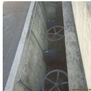
Foto 20 - Tubulações individuais para cada desarenador
