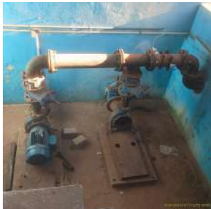
Foto 5 - Vista interna da casa de bombas.
