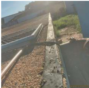
Foto 3 - Tampa de inspeção inadequada.
