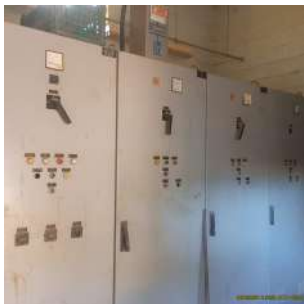
Foto 10 - Painéis elétricos e de comando.
