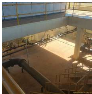
Foto 57 - Tubulações de recalque do lodo em excesso para os adensadores.
