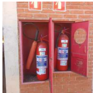
Foto 2 - Extintor de incêndio com validade expirada.
