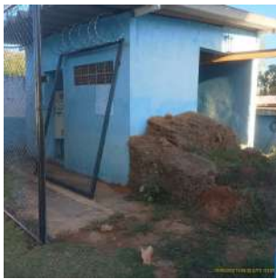
Foto 3 - Acúmulo de materiais próximo à casa de bombas.
