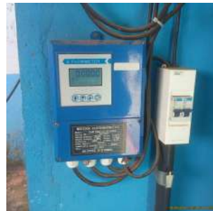
Foto 9 - Sistema de medição de vazão da EEAT.
