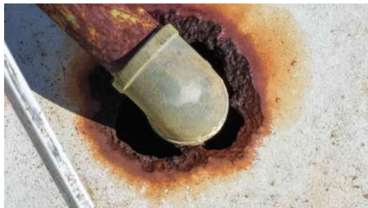
Foto 5 - Situação do vão por onde entra a tubulação que abastece o reservatório.
