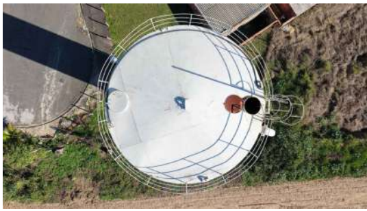
Foto 1 - Vista da cobertura do reservatório, sem tubo de ventilação.
