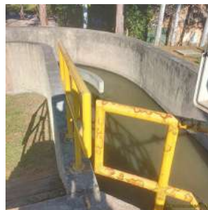
Foto 28 - Vazão unificada após desarenação.
