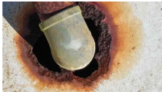
Foto 6 - Situação do vão por onde entra a tubulação que abastece o reservatório.
