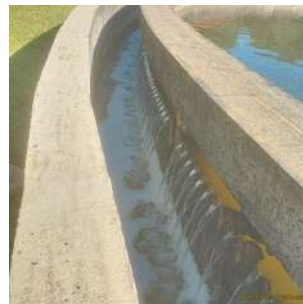
Foto 48 - Saída do efluente do decantador 2.
