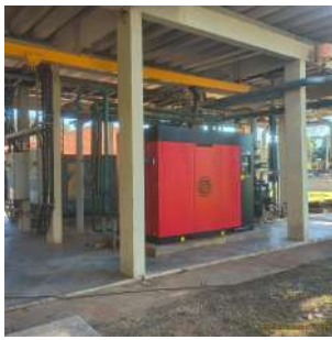
Foto 42 - Vista geral dos compressores e equipamentos de vácuo.
