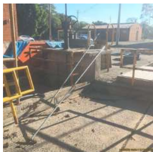
Foto 1 - Ausência de trecho de guarda-corpo.
