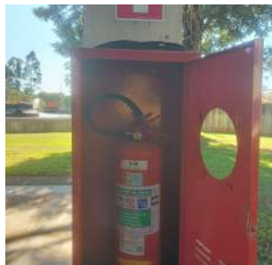
Foto 1 - Extintor de incêndio com validade expirada.
