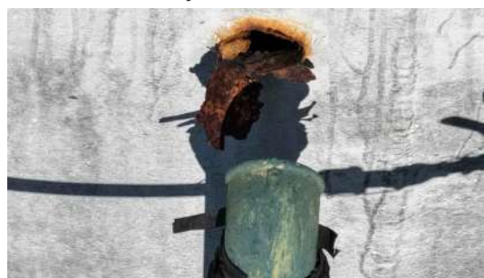
Foto 4 - Situação do tubo vertical sem interligação com o reservatório.
