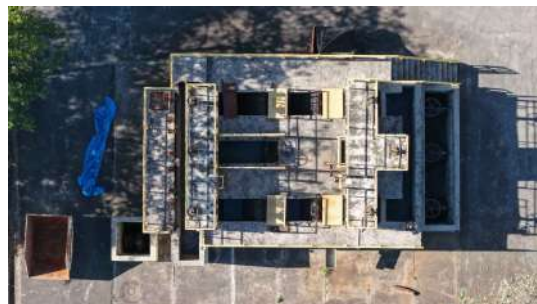
Foto 90 - Segundo gradeamento da ETE.
