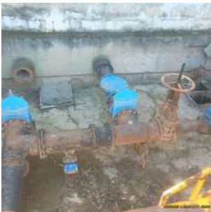
Foto 3 - Barrilete de recalque.
