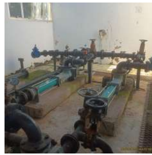
Foto 61 - Bombas de recalque do lodo adensado para a centrífuga.
