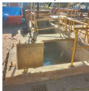
Foto 6 - Gradeamento do esgoto do emissário Guaraú.
