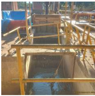
Foto 7 - Gradeamento do esgoto do emissário Guaraú.
