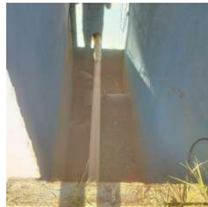
Foto 7 - Interligação entre o reservatório e a EEAT ao lado.
