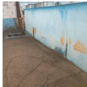
Foto 2 - Vazamento na lateral do reservatório.
