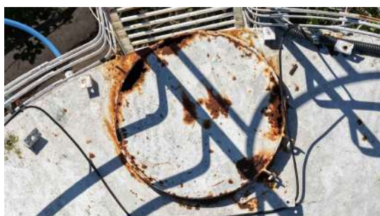
Foto 1 - Situação da tampa de inspeção.
