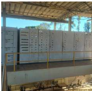
Foto 53 - Painéis elétricos e de comando do segundo abrigo, onde ficam os equipamentos de bombeamento e recirculação de lodo.
