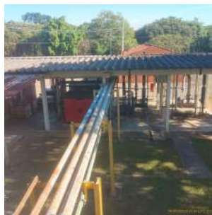
Foto 41 - Vista geral dos compressores e equipamentos de vácuo.
