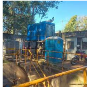
Foto 8 - Gerador a diesel da EEE.
