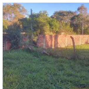
Foto 2 - Situação do alambrado do local.
