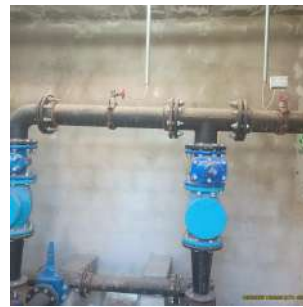
Foto 4 - Barrilete de recalque.
