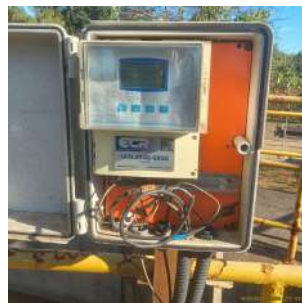
Foto 31 - Painel do macromedidor.
