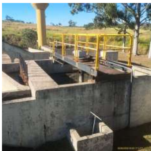
Foto 27 - Desarenador 2 (apesar do esgoto, não está removendo a areia pois a bomba está na manutenção).
