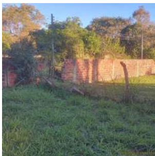
Foto 1 - Situação do alambrado do local.
