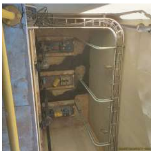
Foto 56 - Bombas de descarte do excesso do lodo para os tanques de adensamento.
