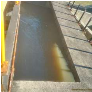
Foto 25 - Desarenador 1 (em operação).
