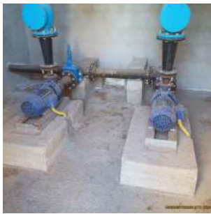
Foto 3 - Vista interna e dos conjuntos motobombas.
