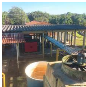
Foto 39 - Vista geral dos compressores e equipamentos de vácuo.
