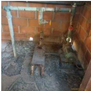
Foto 1 - Único conjunto motobomba instalado.
