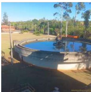
Foto 66 - Vista do segundo tanque de adensamento de lodo.
