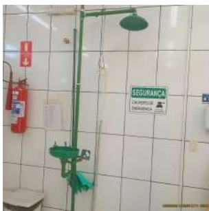
Foto 78 - Chuveiro de emergência e lava-olhos e extintor de incêndio.
