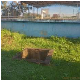
Foto 1 - Caixa de registros/passagem sem fechamento superior.
