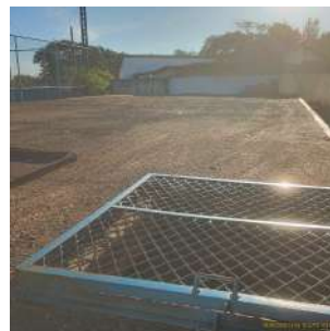
Foto 2 - Tampa de inspeção em grade (possibilita ventilação, porém é inadequada).
