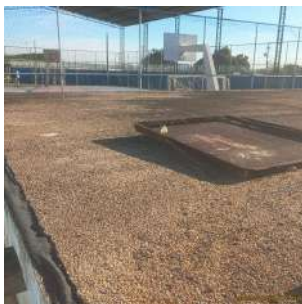
Foto 1 - Vista da cobertura do reservatório sem tubo de ventilação.
