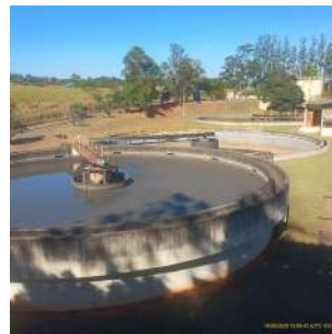
Foto 65 - Vista de um dos tanques de adensamento de lodo.
