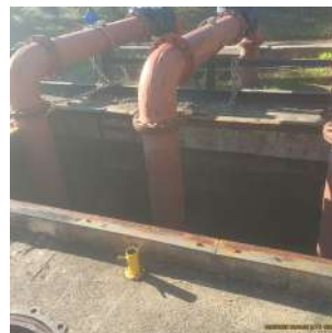
Foto 11 - Tubulações de recalque do esgoto vindo do emissário Guaraú para a segunda etapa do preliminar.
