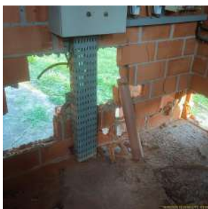
Foto 1 - Situação da parede do local.
