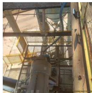
Foto 67 - Centrífuga de lodo.
