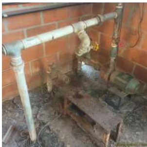
Foto 5 - Único conjunto motobomba do local.
