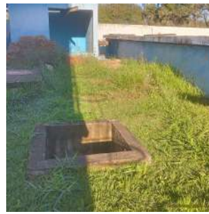
Foto 2 - Caixa de registros/passagem sem fechamento superior.
