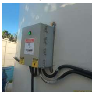
Foto 6 - Painel do sistema anticorrosão do reservatório.
