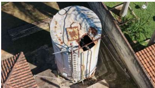
Foto 1 - Vão aberto na cobertura do reservatório.
