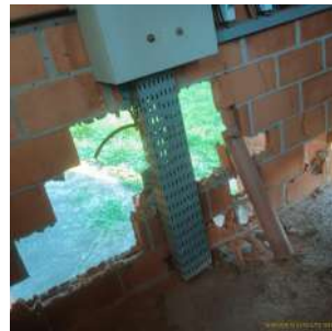
Foto 4 - Parede lateral danificada.
