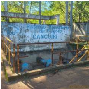
Foto 2 - Identificação interna da EEB (não é possível ver de fora).
