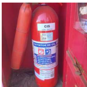
Foto 3 - Extintor de incêndio com validade expirada.
