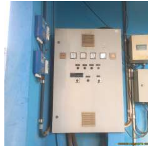
Foto 8 - Pannel elétrico e de comando.
