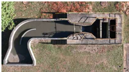
Foto 92 - Unificador de vazão e macromedição.
