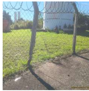
Foto 2 - Trecho do alambrado danificado.
