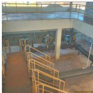
Foto 54 - Tubulações de recalque do lodo em recirculação.
