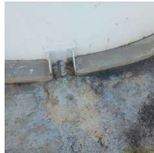
Foto 6 - Aterramento da estrutura do reservatório.
