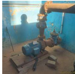
Foto 6 - Único conjunto motobomba da EEAT.
