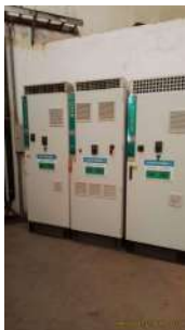
Foto 9 - Painel das bombas maiores, (rede de distribuição).
