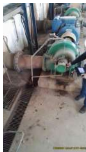
Foto 11 - Tubulação para drenar a água de lubrificação das gaxetas.
