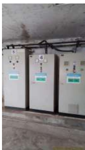
Foto 12 - Painéis das bombas da casa nova.
