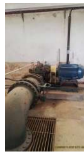
Foto 6 - Identificação de uma das bombas.
