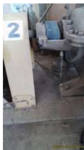
Foto 5 - Tubulação para drenar a água de lubrificação das gaxetas.
