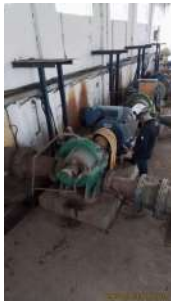
Foto 18 - Bomba passando por inspeção de vibração.
