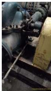
Foto 1 - Tubulação para drenar a água de lubrificação das gaxetas.
