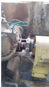
Foto 5 - Tubulação para drenar a água de lubrificação das gaxetas.
