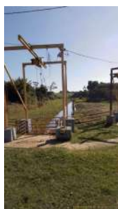
Foto 1 - Tomada de água da captação.
