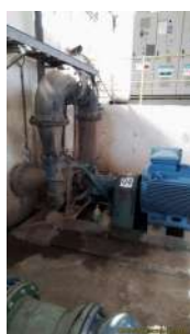
Foto 6 - Bomba da casa nova
