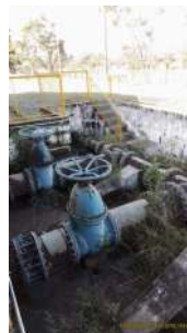
Foto 2 - Barriletes da elevatória
