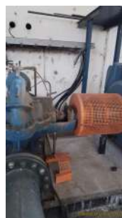
Foto 10 - Tubulação para drenar a água de lubrificação das gaxetas.
