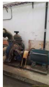
Foto 4 - Identificação de uma das bombas.
