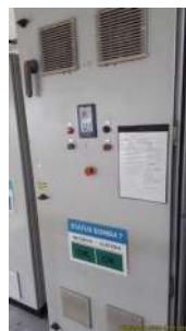
Foto 13 - Painele de comando de bomba.
