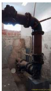
Foto 17 - Recalque da bomba submersa.
