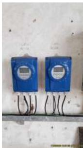
Foto 9 - Display dos medidores de vazão das duas casas de bombas.
