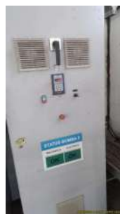
Foto 12 - Painele de comando de bomba.
