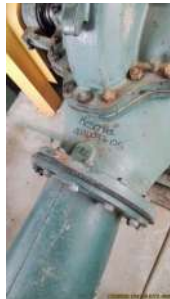
Foto 13 - Identificação de uma das bombas.
