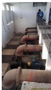
Foto 5 - Tubulações de recalque.
