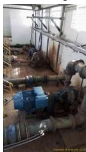
Foto 3 - Casa de bombas velha, com 2 bombas centrífugas em operação
