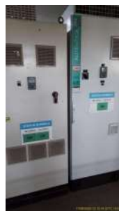
Foto 8 - Painéis de comando das bombas
