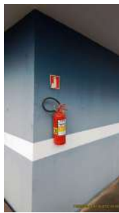
Foto 1 - Extintor na parte externa da elevatória
