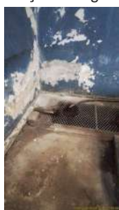
Foto 5 - Tanque que recebe a água de lubrificação das bombas.
