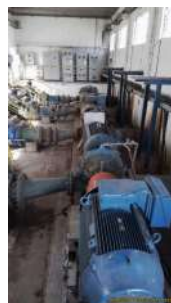
Foto 10 - Casa de bombas .
