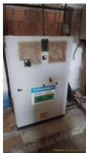
Foto 15 - Painel da bomba submersa.
