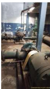
Foto 7 - Casa de bombas.
