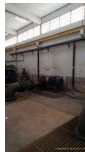
Foto 2 - Bombas da elevatória.
