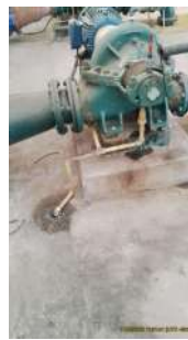
Foto 4 - Tubulação para drenar a água de lubrificação das gaxetas.
