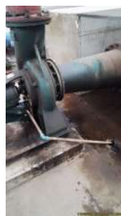
Foto 2 - Tubulação para drenar a água de lubrificação das gaxetas.
