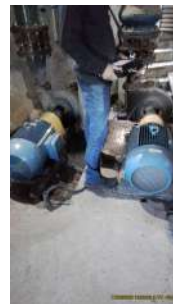
Foto 4 - Bomba passando por inspeção de vibração.
