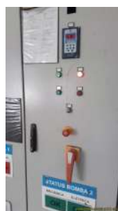
Foto 5 - Painel de bomba da casa nova
