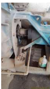
Foto 1 - Tubulação para drenar a água de lubrificação das gaxetas.
