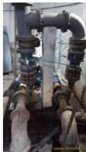
Foto 3 - Bombas da elevatória.
