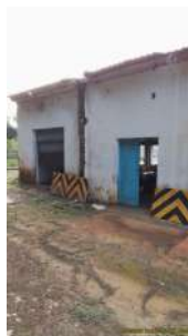
Foto 15 - Casa de bombas velha
