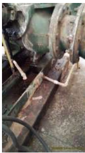
Foto 3 - Tubulação para drenar a água de lubrificação das gaxetas.
