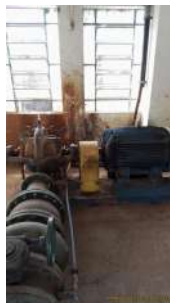
Foto 10 - Bomba da casa nova.
