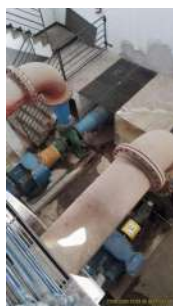
Foto 3 - Interior da elevatória.
