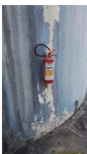
Foto 1 - Extintor próximo à entrada da elevatória.
