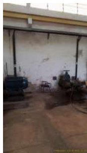
Foto 3 - Bombas da elevatória.
