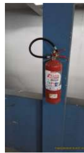
Foto 2 - Extintor no interior da elevatória
