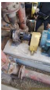
Foto 13 - Bomba passando por inspeção de vibração.
