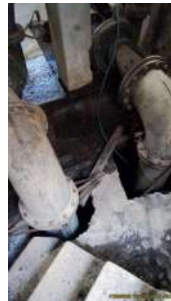
Foto 7 - Sucção das bombas.
