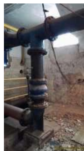
Foto 16 - Recalque da bomba submersa.
