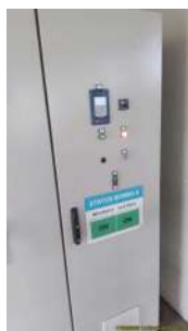
Foto 11 - Painele de uma das bombas da casa nova.
