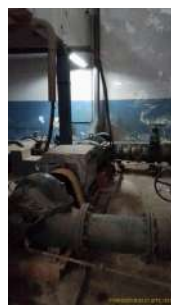
Foto 8 - Casa de bombas.
