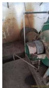
Foto 8 - Tubulação para drenar a água de lubrificação das gaxetas.
