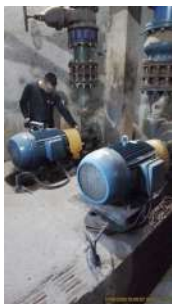
Foto 8 - Bombas da elevatória.
