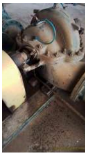
Foto 7 - Tubulação para drenar a água de lubrificação das gaxetas.
