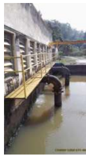
Foto 17 - Sucção da casa de bombas nova.
