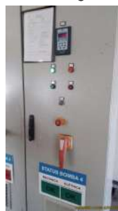
Foto 4 - Painel de bomba da casa velha
