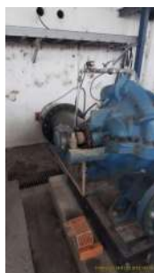
Foto 9 - Tubulação para drenar a água de lubrificação das gaxetas.
