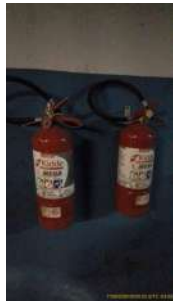
Foto 3 - Extintores na elevatória
