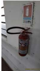
Foto 1 - Extintor em uma das casas de bombas.
