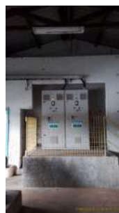
Foto 6 - Painel das bombas da
