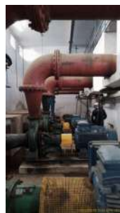
Foto 6 - Bombas que recalcam para centro de distribuição e distrito industrial.
