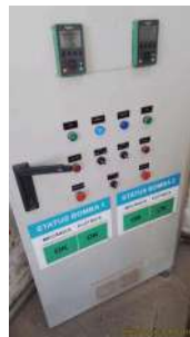
Foto 12 - Painéis das bombas que recalcam para o Ajapi.
