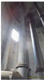
Foto 5 - Recalque das bombas em direção ao reservatório.
