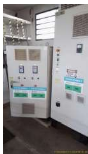
Foto 7 - Painéis de comando das bombas.
