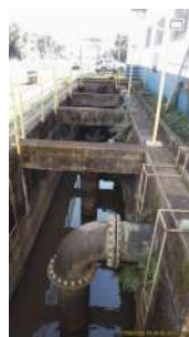
Foto 9 - Sucção casa de bombas nova.
