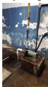
Foto 6 - Bomba para drenar o tanque receptor.
