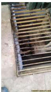
Foto 1 - Grade corroída, soltando.
