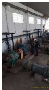
Foto 17 - Interior da casa de bombas nova.
