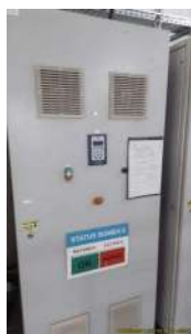
Foto 14 - Painele de comando em manutenção.
