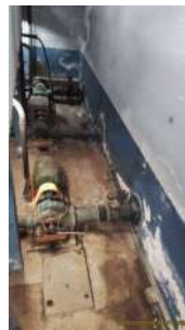
Foto 2 - Casa de bombas.
