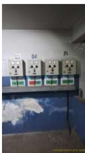
Foto 3 - Painéis de comando das bombas.
