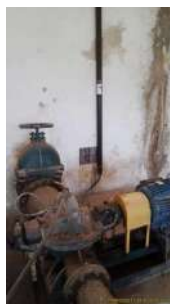
Foto 2 - Identificação da bomba onde se encontra a grade danificada.
