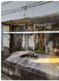
Foto 1 - Infiltrações nos decantadores.
