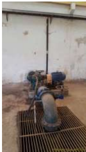
Foto 7 - Bomba que recalca para o distrito industrial.
