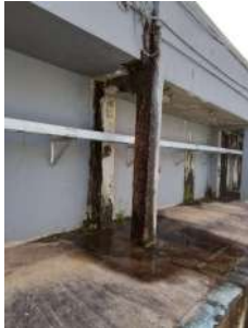
Foto 3 - Infiltrações nos decantadores.
