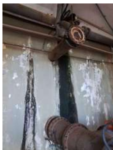
Foto 1 - Vazamentos nas saídas dos filtros decorrentes de infiltrações.
