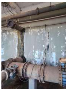
Foto 3 - Vazamentos nas saídas dos filtros decorrentes de infiltrações.
