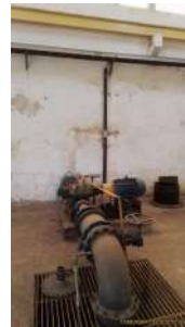
Foto 8 - Bomba que recalca para o distrito industrial.
