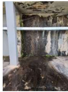
Foto 2 - Infiltrações nos decantadores.
