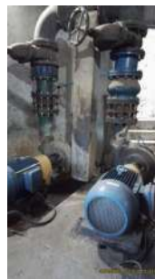
Foto 6 - Bombas da elevatória.
