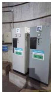
Foto 9 - Painel de comando das bombas
