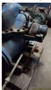
Foto 3 - Tubulação para drenar a água de lubrificação das gaxetas.
