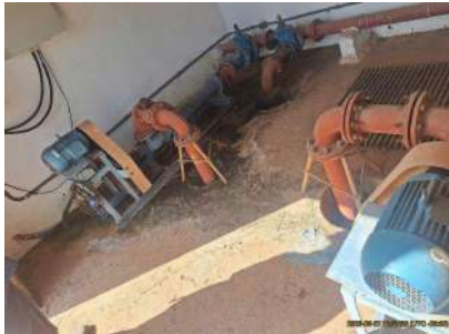
Foto 3 - Dois conjuntos motobomba instalados
