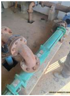
Foto 1 - Bomba sem motor
