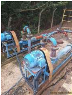
Foto 3 - Dois Conjuntos instalados
