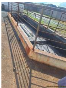
Foto 4 - Canal com gradeamento
