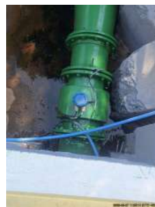
Foto 7 - Sensor do macromedidor
