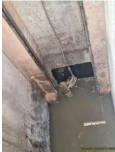
Foto 3 - Detalhe de poço de sucção após o cesto de gradeamento
