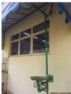
Foto 9 - Chuveiro de emergência
