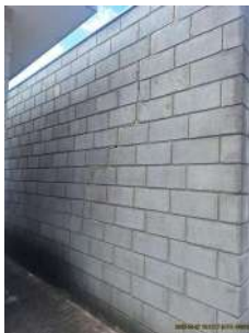
Foto 1 - Parede lateral com trinca estrutural (fissura)
