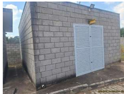
Foto 2 - Local sem circulação de ar
