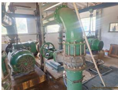
Foto 3 - Dois conjuntos motobomba instalados
