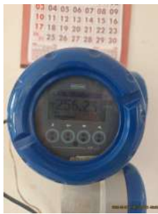
Foto 8 - Conversor do macromedidor
