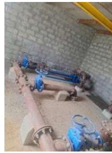
Foto 5 - Dois conjuntos motobomba instalados
