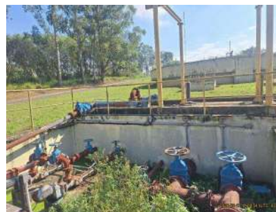
Foto 4 - Recalque do lodo do decantador secundário - corrosão geral e
