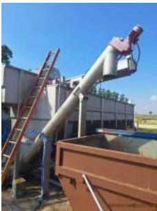
Foto 1 - Unidade de tratamento preliminar
