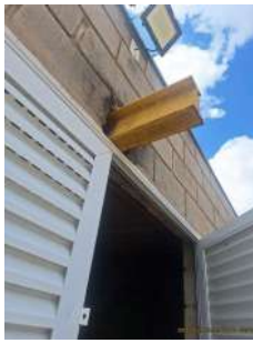
Foto 4 - Acesso para manutenção
