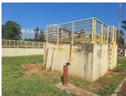
Foto 3 - Tanque de distribuição do esgoto
