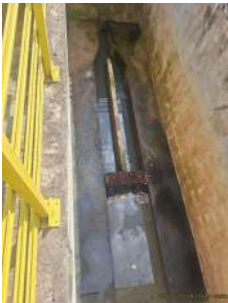
Foto 2 - Gradeamento grosseiro do esgoto
