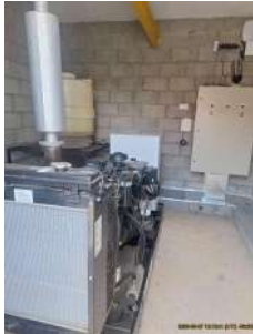
Foto 6 - Gerador de energia
