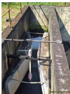
Foto 3 - Presença de espuma no lançamento final de esgoto
