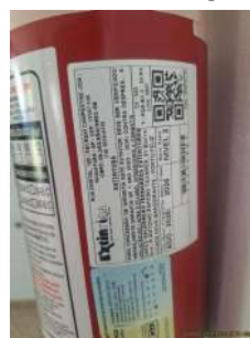
Foto 6 - Extintor com validade regular
