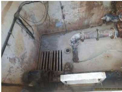
Foto 5 - Dois conjuntos motobomba instalados
