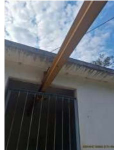
Foto 4 - Monovia para retirada de bombas para manutenção
