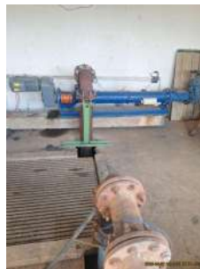
Foto 7 - Conjunto motobomba instalado
