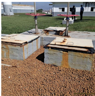
Foto 1 - Tampas de inspeção com partes oxidadas
