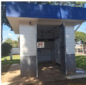
Foto 7 - Vista externa da casa de bomba
