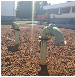
Foto 3 - Tubulação de ventilação
