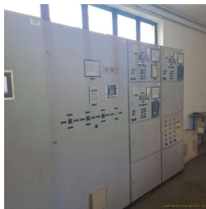
Foto 10 - Painel de comando e controle
