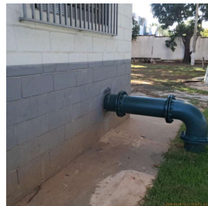
Foto 8 - Entrada de água
