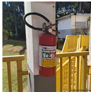
Foto 11 - Extintor de incêndio
