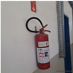
Foto 2 - Extintor de incêndio
