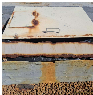
Foto 2 - Tampas de inspeção com partes oxidadas
