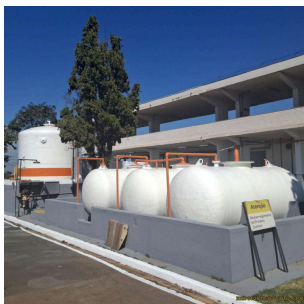
Foto 17 - Armazenamento de flúor e PAC
