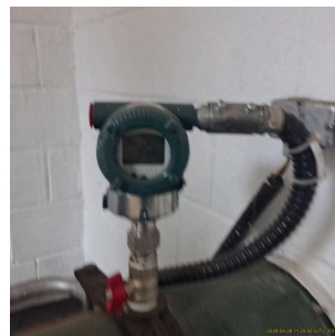
Foto 6 - Display do medidor de pressão
