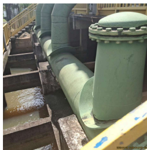
Foto 4 - Poço de sucção
