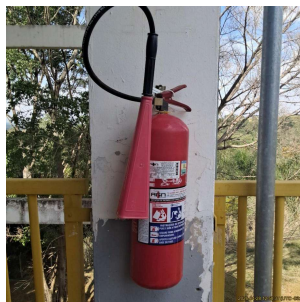
Foto 6 - Extintor de incêndio
