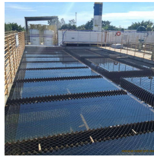
Foto 10 - Vertedores de água decantada
