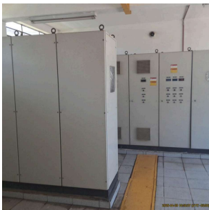
Foto 4 - Painel de comando e controle
