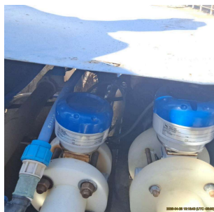
Foto 5 - Medidores da linha de PAC
