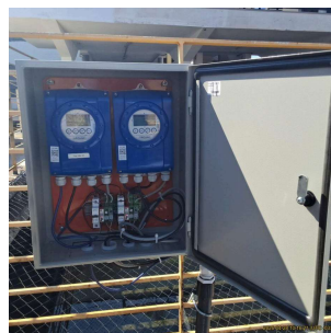
Foto 6 - Painel e display dos medidores da linha de PAC
