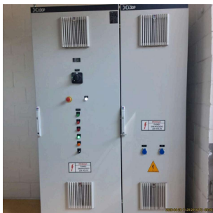
Foto 5 - Painel de comando e controle
