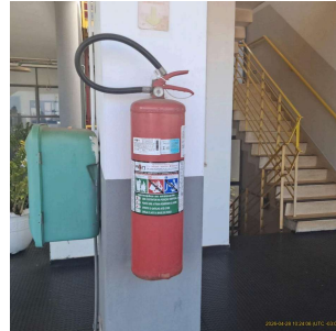
Foto 12 - Extintor de incêndio
