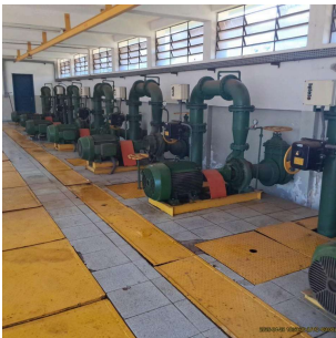
Foto 1 - Vista do interior da EEAT ETA
