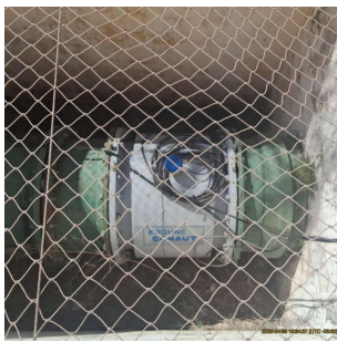
Foto 19 - Medidor de vazão instalado na adutora de água bruta
