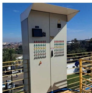
Foto 8 - Painel dos floculadores com 12 inversores
