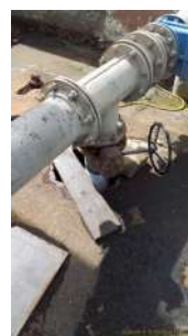
Foto 2 - Entrada de água no reservatório com tampa de inspeção danificada
