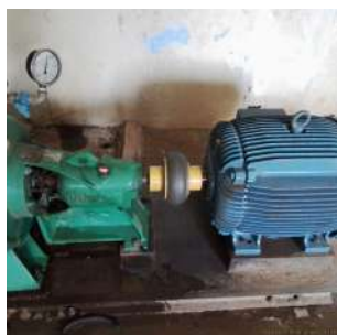
Foto 1 - Ausência do protetor de acoplamento
