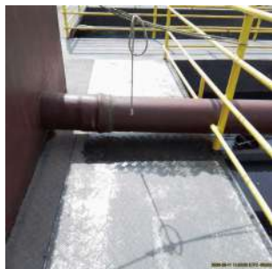
Foto 1 - Vazamento de esgoto na caixa de distribuição para os tanques anaeróbios
