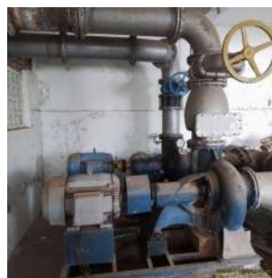
Foto 30 - Conjunto motobomba de lavagem dos filtros
