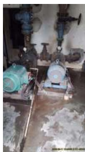
Foto 7 - Vista geral dos conjuntos motobombas
