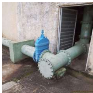
Foto 34 - Tubulação de adução da Captação do Jaguarí
