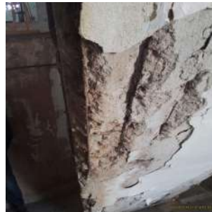
Foto 24 - Lateral da escada com ferragem exposta. Não Conformidades já foram apontadas no Auto de Notificação nº 295/2025.
