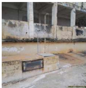
Foto 50 - Medidor de nível da câmara de contato
