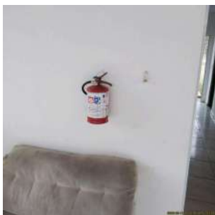
Foto 35 - Extintor de incêndio
