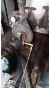
Foto 1 - Vazamento de água em excesso da lubrificação da gaxeta.
