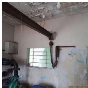
Foto 7 - Ponte rolante e corrente para içamento
