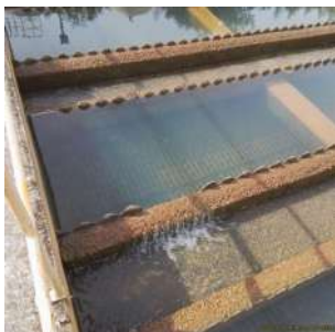
Foto 1 - Vertedores de água quebrado podem diminuir a eficiência do decantador
