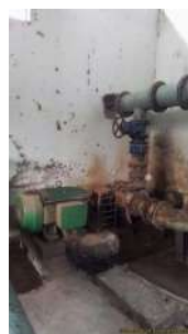
Foto 4 - Conjunto motobomba de recalque para o Centro
