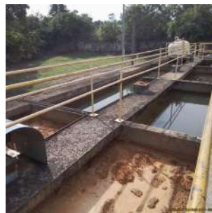
Foto 15 - Misturadores parados e sem funcionamento. Não Conformidades já foram apontadas no Auto de Notificação nº 295/2025.
