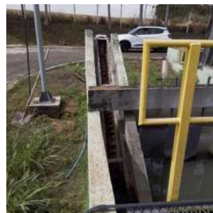
Foto 8 - Rosca helicoidal para remoção de areia
