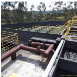
Foto 23 - Tanque aeróbio não operante
