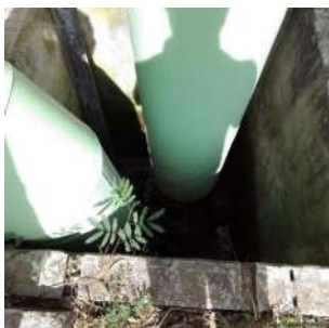
Foto 31 - Saída do efluente tratado
