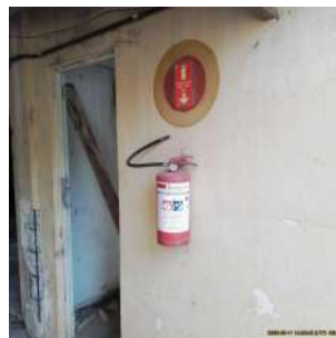
Foto 35 - Extintor de incêndio
