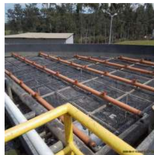
Foto 24 - Tanque aeróbio não operante
