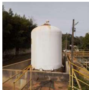
Foto 19 - Tanque de PAC
