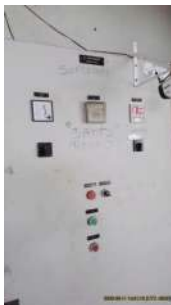
Foto 11 - Painei de comando
