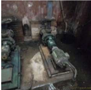
Foto 5 - Vista da bomba inoperante
