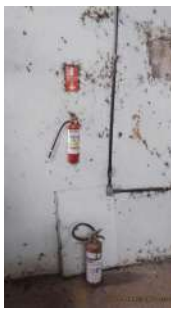
Foto 9 - Extintor de incêndio
