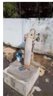
Foto 2 - Tubulação com tela de proteção
