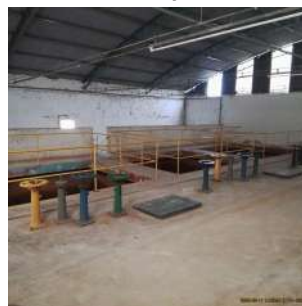
Foto 26 - Vista geral dos filtros
