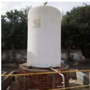
Foto 18 - Tanque 2 de hipoclorito de sódio
