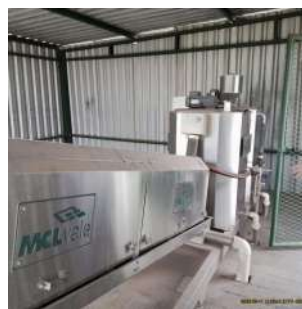
Foto 30 - Centrífuga de desaguamento de lodo
