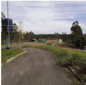
Foto 11 - Vista geral do tratamento secundário
