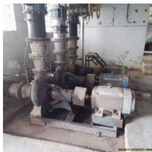
Foto 31 - Vista geral do conjunto motobomba de captação
