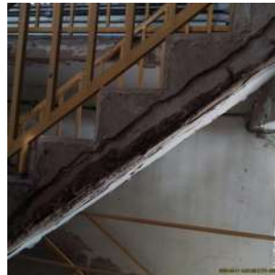
Foto 23 - Armação da escada exposta. Não Conformidades já foram apontadas no Auto de Notificação nº 295/2025.
