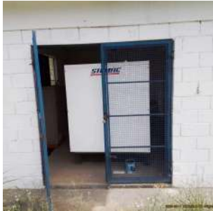
Foto 5 - Gerador de energia
