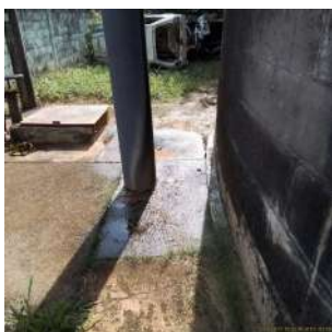
Foto 1 - Mancha de água do vazamento
