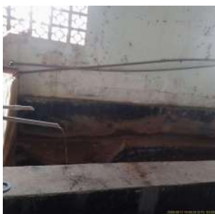
Foto 8 - Adição de cloro para pré-oxidação
