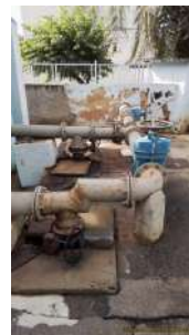
Foto 4 - Válvulas de conexões
