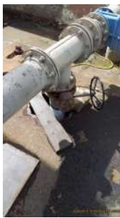
Foto 7 - Entrada de água no reservatório
