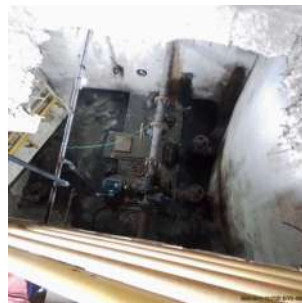
Foto 6 - Casa de bombas alagada com esgoto
