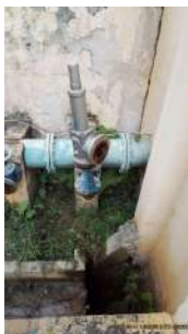
Foto 1 - Vazamento na tubulação
