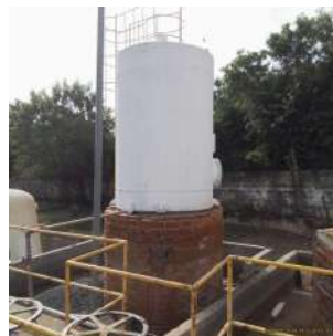
Foto 17 - Tanque 1 de hipoclorito de sódio
