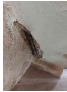
Foto 57 - Ferragem estrutural exposta (escada). Não Conformidades já foram apontadas no Auto de Notificação nº 295/2025.
