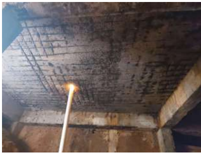
Foto 56 - Laje da passagem dos filtros com a armadura exposta. Não Conformidades já foram apontadas no Auto de Notificação nº 295/2025.
