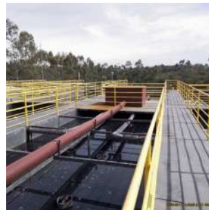
Foto 16 - Tubulação chegando ao tanque de distribuição
