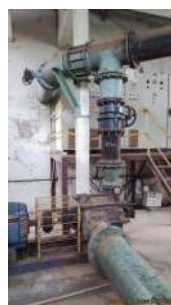
Foto 6 - Vista geral do conjunto motobomba e painéis de comando
