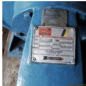
Foto 4 - Identificação da bomba que não está em funcionamento
