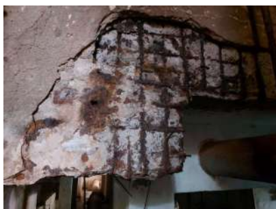
Foto 54 - Ferragem exposta do concreto armada da estrutura. Não Conformidades já foram apontadas no Auto de Notificação nº 295/2025.
