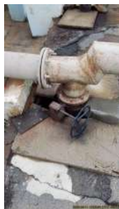
Foto 5 - Tampa de inspeção danificada
