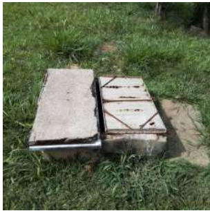
Foto 2 - Tampa de inspeção do gradeamento grosseiro
