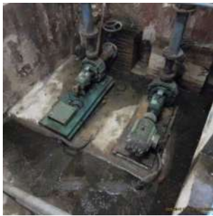
Foto 1 - Bomba sem funcionamento e esgoto sendo lançado in natura
