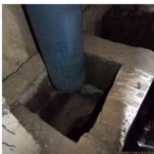
Foto 8 - Saída do tubo extravasor
