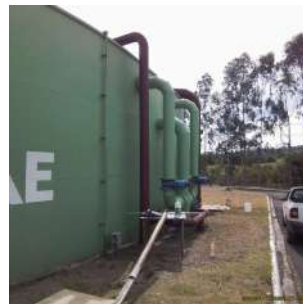
Foto 14 - Tubulação de chegada após o tratamento preliminar
