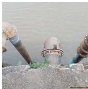
Foto 32 - Tubulação de captação de água bruta
