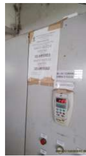
Foto 10 - Painei de comando com instrução de uso
