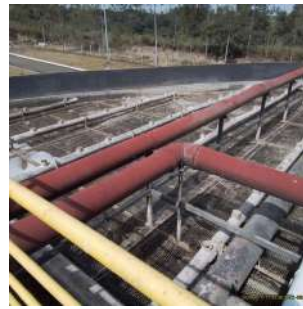
Foto 20 - Tanque aeróbio não operante
