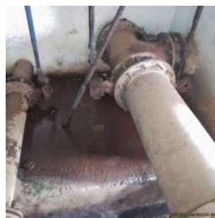
Foto 2 - Vazamento na flange
