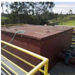
Foto 17 - Tanque de recebimento do efluente após tratamento preliminar. Conduz o esgoto para os tanques de distribuição.
