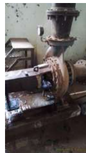
Foto 14 - Água de lubrificação da gaxeta sendo conduzida por canaleta
