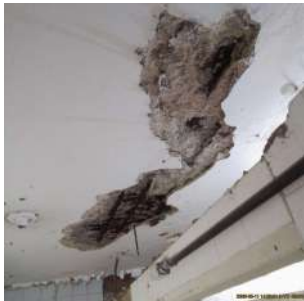
Foto 22 - Exposição das ferragem da armadura do concreto no forro do banheiro masculino. Não Conformidades já foram apontadas no Auto de Notificação nº 295/2025.
