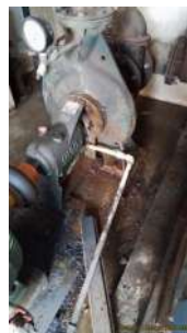
Foto 4 - Drenagem da água de gaxeta
