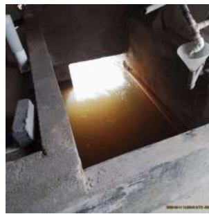
Foto 2 - Entrada de água para a ETA Nova
