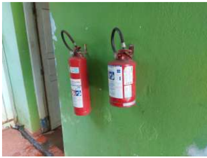
Foto 11 - Extintor de incêndio
