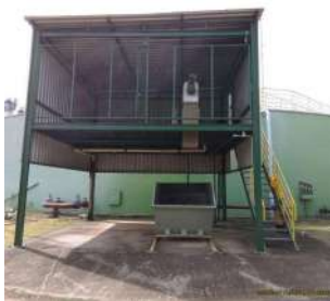
Foto 29 - Vista geral do desaguamento de lodo
