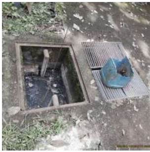
Foto 3 - Cesto para gradeamento grosseiro
