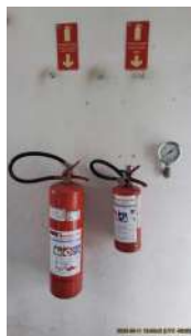
Foto 3 - Extintor de incêndio
