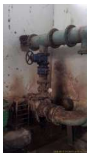
Foto 3 - Bomba centrífuga conduzindo água para o Centro
