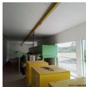
Foto 28 - Vista geral da desinfecção Ultravioleta
