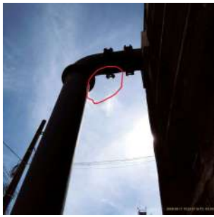
Foto 3 - Detalhe do vazamento na flange
