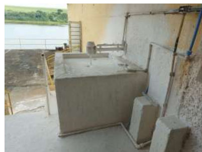
Foto 53 - Tanque preparador de cal
