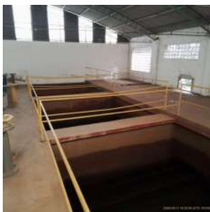
Foto 25 - Vista geral dos filtros
