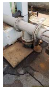
Foto 6 - Tampa de inspeção danificada
