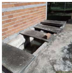
Foto 2 - B - Poço úmido sem tampa de inspeção
