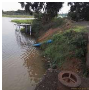
Foto 33 - Tubulação de adução da Captação do Jaguarí
