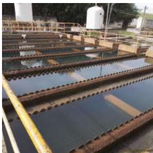
Foto 16 - Decantadores da ETA Nova
