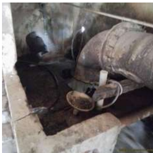
Foto 6 - Tubulação de chegada da água bruta
