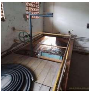
Foto 1 - Entrada de água para a ETA Velha
