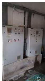
Foto 6 - Painéis de controle
