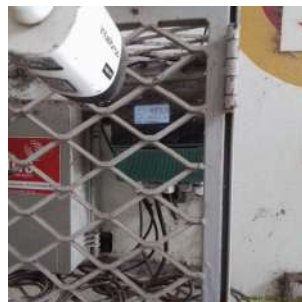
Foto 28 - Medidor de vazão de captação
