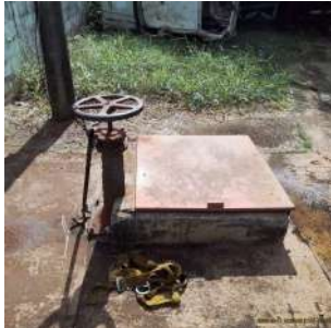
Foto 5 - Registro de manobra e caixa de inspeção
