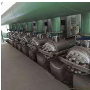
Foto 27 - Equipamento de desinfecção Ultravioleta
