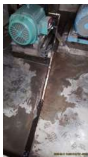
Foto 5 - Drenagem da água de gaxeta
