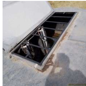
Foto 12 - Poço de sucção do efluente após tratamento secundário
