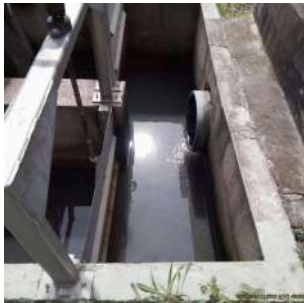
Foto 3 - Tubulação de chegada do esgoto bruto
