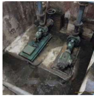
Foto 4 - Vista geral da casa de bomba
