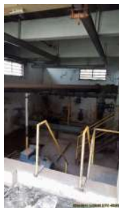
Foto 1 - Vista geral da sala de recalque
