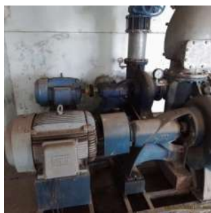
Foto 29 - Conjunto motobomba de lavagem dos filtros
