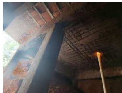
Foto 55 - Laje da passagem dos filtros com a armadura exposta. Não Conformidades já foram apontadas no Auto de Notificação nº 295/2025.
