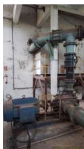
Foto 7 - Vista geral do conjunto motobomba de adução para o Santa Rizzo
