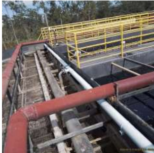
Foto 21 - Tanque aeróbio não operante
