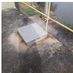
Foto 51 - Tampa de inspeção da câmara de contato
