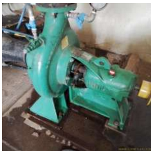
Foto 1 - Excesso de vazamento de água na gaxeta
