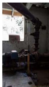
Foto 8 - Vista geral do conjunto motobomba de adução para o Santa Rizzo
