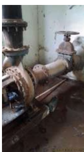
Foto 15 - Água de lubrificação da gaxeta sendo conduzida por canaleta
