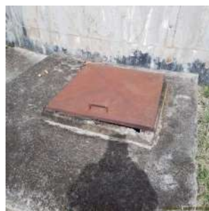
Foto 4 - Tampa de inspeção de válvulas
