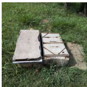
Foto 1 - A - Tampa de inspeção com danos e aberturas
