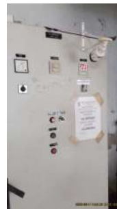
Foto 12 - Painei de comando com instrução de uso
