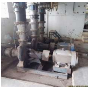
Foto 1 - Conjunto motobomba de captação
