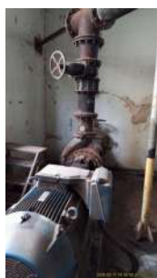
Foto 5 - Conjunto motobomba de recalque para o Santo Rizzo
