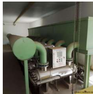
Foto 26 - Equipamento de desinfecção Ultravioleta
