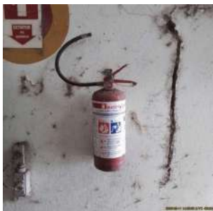
Foto 27 - Extintor de incêndio
