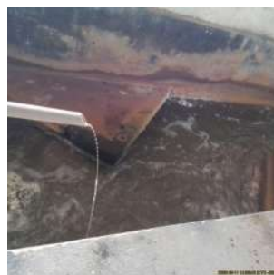
Foto 9 - Adição de cloro para pré-oxidação
