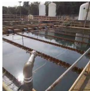
Foto 13 - Decantadores da ETA Velha
