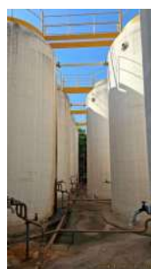
Foto 14 - Passarelas entre os UASB e FAS.
