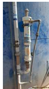
Foto 6 - Sistema de tratamento na tubulação de entrada da água no reservatório.
