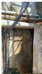
Foto 1 - Vazamento próximo a escada.
