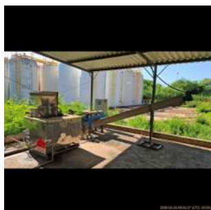
Foto 19 - Tratamento de lodo.
