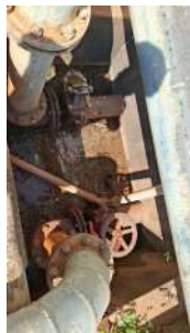
Foto 3 - Outros dois registros com vazamento.
