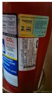
Foto 10 - Validade do extintor de incêndio.
