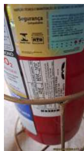
Foto 25 - Validade do extintor sala dos sopradores.
