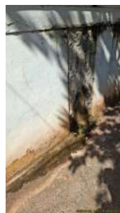
Foto 2 - Vazamento na lateral do reservatório.
