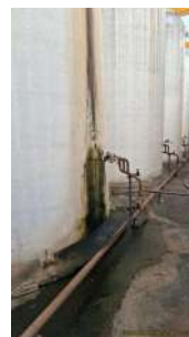
Foto 2 - Efluente escorrendo na base do reator.
