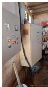
Foto 6 - Painéis de controle e elétrico.
