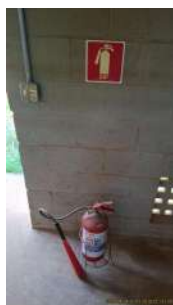
Foto 24 - Extintor de incêndio da sala dos sopradores.
