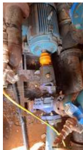
Foto 2 - Vazamento de água da gaxeta.
