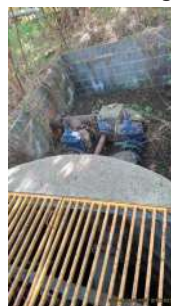
Foto 10 - Tubulações de recalque.
