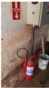
Foto 7 - Extintor de incêndio.
