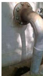
Foto 4 - Detalhe do vazamento da saída do excedente.
