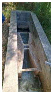
Foto 15 - Calha Parshall da saída.
