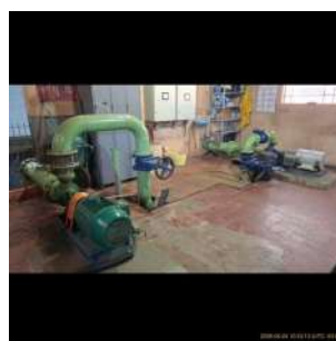
Foto 4 - Sistema de recalque.
