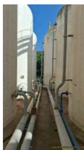
Foto 11 - Tubulação entre os UASB e FAS.
