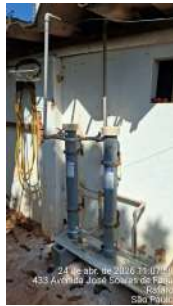
Foto 1 - Sistema de tratamento no Recalque 2.
