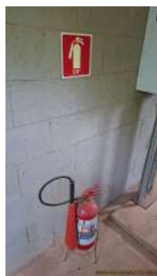
Foto 28 - Extintor de incêndio da sala do gerador.
