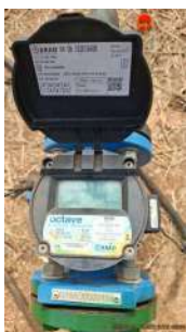
Foto 5 - Medidor de vazão.
