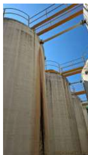
Foto 1 - Vazamento na tubulação de interligação entre o reator UASB e o FAS.
