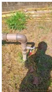
Foto 5 - Torneira para coleta de água bruta.
