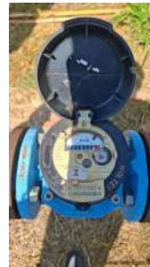
Foto 4 - Medidor de vazão.
