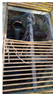
Foto 8 - Elevatória de esgoto da ETE.
