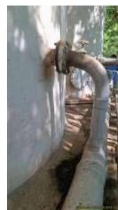
Foto 3 - Vazamento na flange de saída do excedente do reator UASB.
