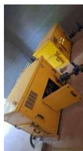
Foto 4 - Os sopradores não se encontravam em funcionamento no momento da fiscalização.
