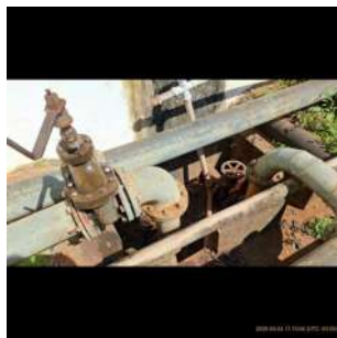
Foto 1 - Vazamento nos registros da sucção
