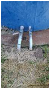
Foto 4 - Tubulações de saída.
