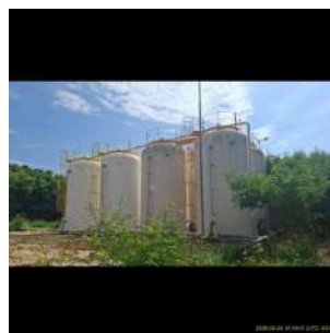
Foto 35 - Reatores UASB em primeiro plano e filtros aerados submersos (FAS) ao fundo.
