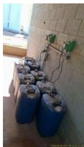
Foto 21 - Sistema de dosagem de cloro, que não se encontrava em funcionamento no momento da fiscalização.
