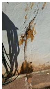
Foto 4 - Mais um vazamento na lateral do reservatório.
