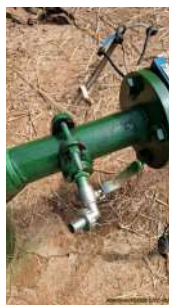
Foto 4 - Torneira de água bruta.
