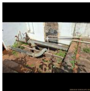
Foto 4 - Tubulações de sucção da EEAT.
