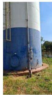
Foto 6 - Tubulação de entrada da água.
