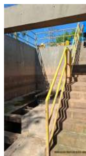
Foto 6 - Escada de entrada do tratamento preliminar.
