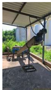
Foto 18 - Centrífuga para desidratação de lodo.
