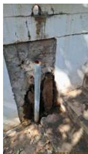
Foto 3 - Outro vazamento na lateral.
