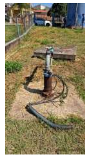
Foto 2 - Cavalete do poço.
