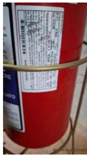
Foto 1 - Validade do extintor da sala do gerador.
