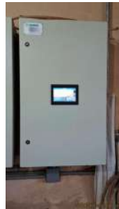
Foto 8 - Painel de controle.
