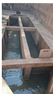
Foto 3 - Caixa de retenção de areia.
