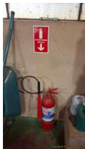
Foto 9 - Extintor de incêndio.
