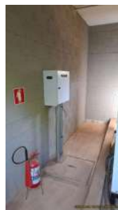
Foto 27 - Painele de energia.
