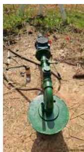
Foto 2 - Cavalete do poço.
