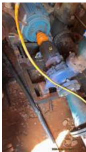
Foto 1 - Drenagem inadequada na gaxeta.
