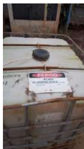
Foto 7 - Armazenamento de flúor para aplicação na entrada do reservatório, que é abastecido pelo Poço Standard 3.
