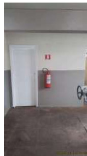
Foto 14 - Extintor na elevatória.
