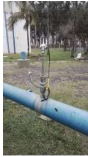
Foto 1 - Medidor de vazão.
