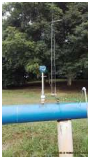
Foto 3 - Medidor de vazão.
