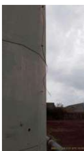
Foto 1 - O SPDA não está devidamente aterrado.
