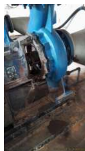
Foto 6 - Drenagem da água de lubrificação da gaxeta.
