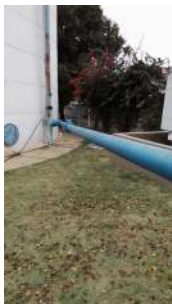
Foto 7 - Tubulação que abastece o reservatório.
