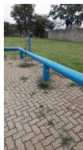
Foto 8 - Tubulação proveniente do poço que alimenta o reservatório.
