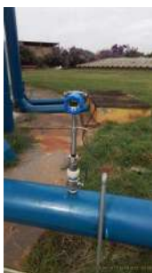
Foto 3 - Medidor de vazão.
