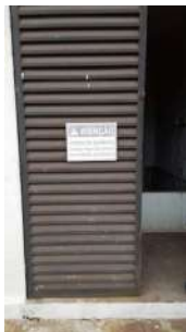
Foto 1 - Abrigo dos produtos químicos.
