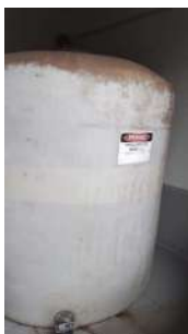
Foto 1 - Armazenamento de hipoclorito de sódio.
