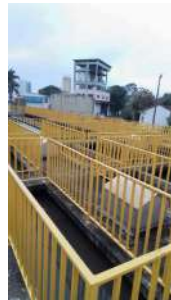
Foto 8 - Floculadores mecanizados: 4 em cada módulo da ETA, totalizando 8.
