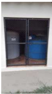
Foto 1 - Abrigo dos produtos químicos.
