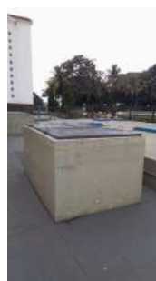
Foto 23 - Tanque onde é dosado flúor após os filtros
