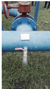
Foto 1 - Tomada de água bruta.
