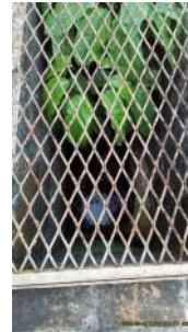
Foto 2 - Caixa que recebe água dos extravasores do R9 e R10
