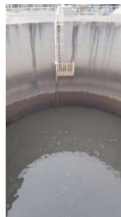
Foto 2 - Tanque de equalização que recebe água de lavagem dos filtros e descarga dos decantadores.
