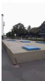
Foto 24 - Tanque de contato.
