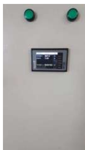
Foto 3 - Display de um dos macromedidores de entrada.
