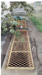
Foto 3 - Calha parshall na saída da parte líquida do tratamento de lodo, encaminhada para a rede de esgoto.
