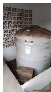
Foto 2 - Armazenamento de hipoclorito de sódio.
