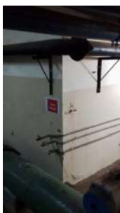
Foto 16 - Área das tubulações de saída dos filtros.
