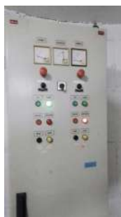
Foto 7 - Painel de controle das bombas.
