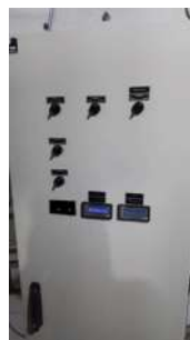
Foto 4 - Pannel de comando das bombas.
