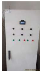
Foto 4 - Painel de comando.
