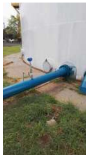
Foto 2 - Saída e macromedidor.
