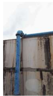
Foto 10 - Aplicação de cloro e flúor na entrada do reservatório, abastecido pelo poço Standard
