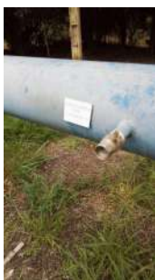
Foto 1 - Tomada de água bruta.
