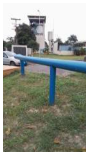
Foto 3 - Tubulação de recalque.
