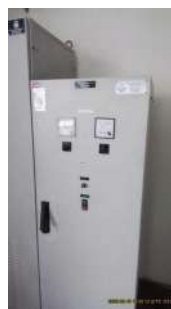
Foto 6 - Painel de uma das bombas.
