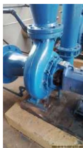
Foto 9 - Drenagem da água de lubrificação da gaxeta.
