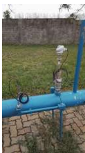
Foto 1 - Medidor de vazão.
