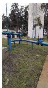
Foto 2 - Tubulações de recalque do poço.
