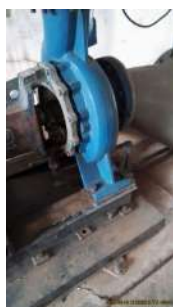
Foto 7 - Drenagem da água de lubrificação da gaxeta.
