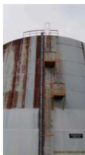
Foto 4 - Escada de acesso à cobertura. De acordo com o prestador, o reservatório está passando por pintura, havendo ainda partes corroídas.
