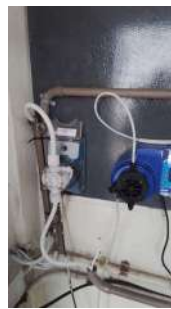
Foto 2 - Bomba dosadora de cloro.
