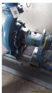
Foto 1 - Drenagem da água de lubrificação da gaxeta.
