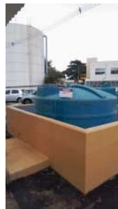
Foto 19 - Armazenamento de hipoclorito de sódio.
