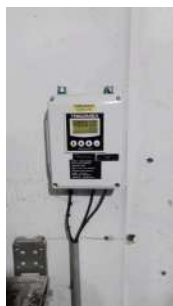
Foto 3 - Display do medidor de vazão.
