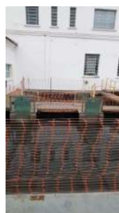
Foto 12 - Filtros, 6 no total. No momento da Fiscalização, estavam sendo substituídos guarda-
