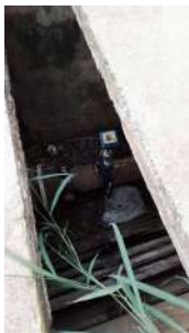
Foto 3 - Medidor de vazão na saída do reservatório.
