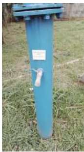
Foto 1 - Tomada de água bruta.
