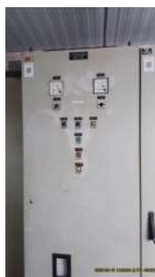
Foto 5 - Painel de uma das bombas.
