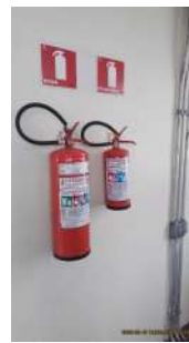
Foto 2 - Extintor na elevatória.
