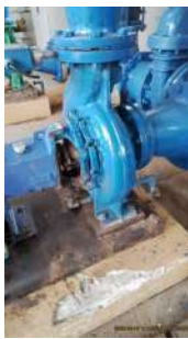
Foto 10 - Drenagem da água de lubrificação da gaxeta.
