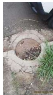
Foto 6 - Chegada do efluente, onde há cesto peneira
