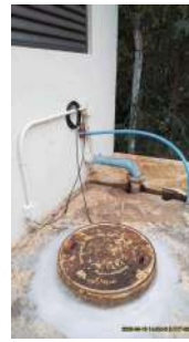
Foto 2 - Sucção da bomba.
