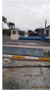
Foto 2 - Tubulações de sucção da casa de bombas 1 a partir do R1.
