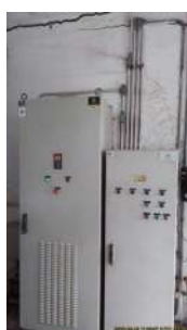
Foto 3 - Painel de comando das bombas.
