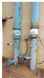
Foto 2 - Macromedidores de outras tubulações de entrada de água bruta.
