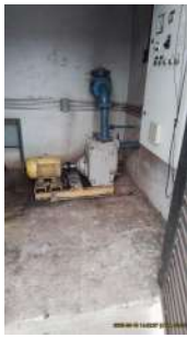
Foto 1 - Apenas uma bomba instalada.
