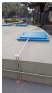
Foto 22 - Dosagem de hipoclorito de sódio no tanque de contato.
