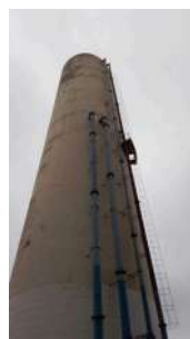
Foto 3 - Tubulações de alimentação das câmaras;
