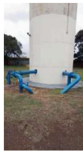
Foto 2 - Tubulações de entrada e saída.
