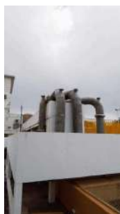
Foto 3 - Tubulações de entrada de água bruta na ETA, após o tanque receptor.
