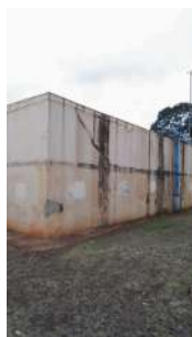
Foto 3 - Reservatório em operação.
