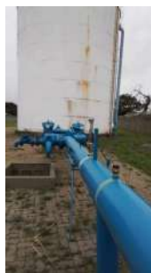
Foto 6 - Tubulação de recalque do booster situado na saída no reservatório.
