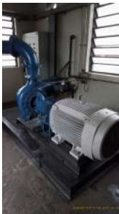
Foto 2 - Bomba abastece o R17, sendo reserva das bombas que estão na casa de bombas 2.
