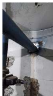
Foto 8 - Tubulação de recalque, que abastece o reservatório elevado R11.
