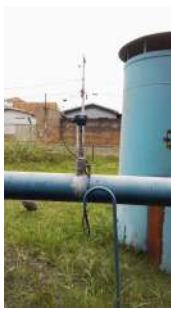
Foto 1 - Medidor de vazão.
