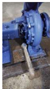
Foto 6 - Drenagem da água de lubrificação da gaxeta.
