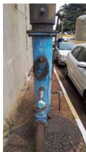
Foto 1 - Macromedidor de uma das tubulações de entrada de água bruta
