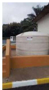
Foto 13 - Armazenamento de hipoclorito
