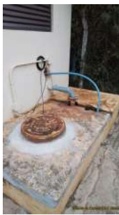
Foto 5 - Poço de sucção.
