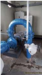
Foto 3 - Abastece o R17. A bomba reserva está na casa de bombas 2.
