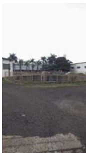
Foto 1 - Tanque de equalização que recebe água de lavagem dos filtros e descarga dos decantadores.
