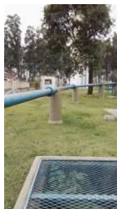
Foto 6 - Tubulação que abastece o reservatório.
