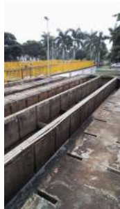
Foto 7 - Floculador hidráulico, havendo 2 módulos espelhados.
