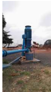
Foto 2 - Bomba do poço.
