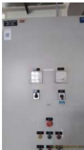
Foto 12 - Painel de comando de uma das bombas.
