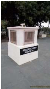
Foto 3 - Identificação, ventilação e telas de proteção.
