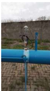
Foto 5 - Macromedidor na saída do booster para o R25.
