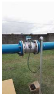
Foto 1 - Medidor de vazão.
