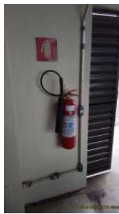
Foto 1 - Extintor na elevatória.
