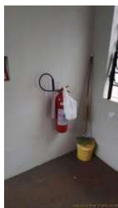
Foto 5 - Extintor no abrigo do painel.
