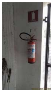
Foto 5 - Extintor na elevatória.
