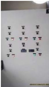
Foto 4 - Painel de comando.
