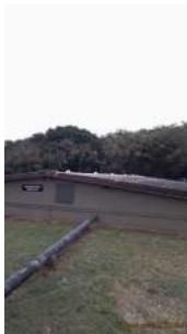
Foto 3 - Placa de identificação e tubulação de alimentação do reservatório.
