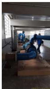
Foto 3 - Bomba que recalca para o R7.
