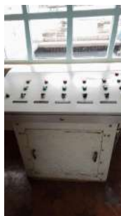
Foto 5 - Mesa de controle de um dos filtros.
