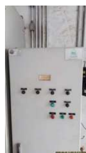
Foto 4 - Painel de comando das bombas.
