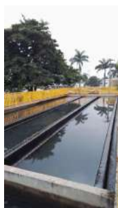
Foto 9 - Decantadores, 2 no total.
