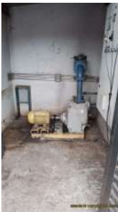
Foto 3 - Interior da elevatória.
