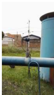
Foto 3 - Medidor de vazão.
