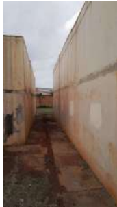
Foto 11 - À esquerda reservatório desativado e à direita, módulo em operação.
