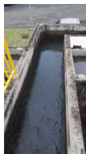
Foto 10 - Água decantada encaminhada para os filtros.
