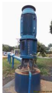
Foto 4 - Bomba do poço.
