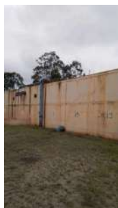
Foto 5 - Reservatório em operação.
