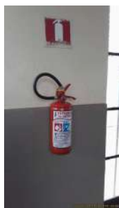
Foto 8 - Extintor da elevatória.
