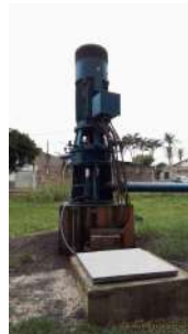
Foto 2 - Bomba do poço.
