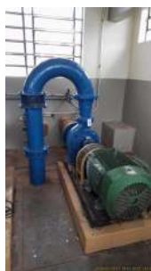
Foto 5 - Bomba que recalca para o R17. A reserva está instalada na casa de bombas 1
