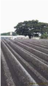
Foto 3 - Dispositivos para ventilação.
