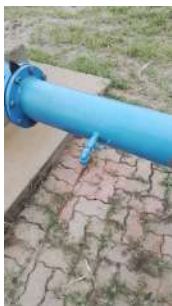
Foto 1 - Tomada de água bruta.
