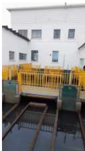
Foto 18 - Filtros já com novos guarda corpos.
