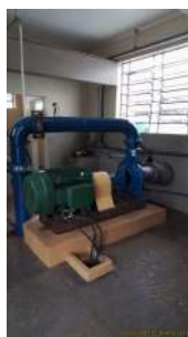
Foto 2 - Bomba que recalca para o R7.
