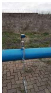
Foto 4 - Macromedidor da saída para a rede de distribuição.
