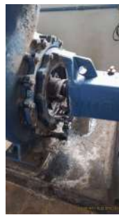
Foto 11 - Drenagem da água de lubrificação da gaxeta.
