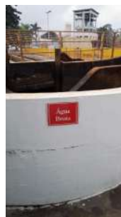
Foto 6 - Indicação da entrada de água bruta no tratamento.
