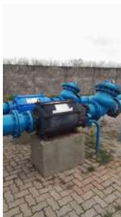
Foto 3 - Booster na saída do reservatório para abastecer o R25.
