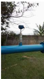
Foto 1 - Medidor de vazão.
