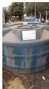
Foto 8 - Armazenamento de hipoclorito de sódio.
