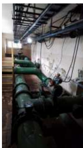
Foto 14 - Saída dos filtros.
