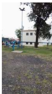
Foto 4 - Tubulação que abastece o R25 a partir do poço.
