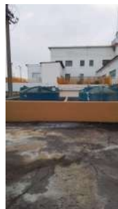
Foto 21 - Diques de contenção de produtos químicos.
