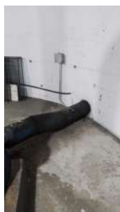
Foto 1 - Tubulação proveniente do R25.
