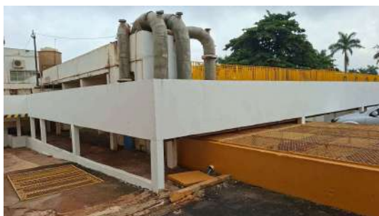
Foto 27 - Entrada de água bruta na ETA.
