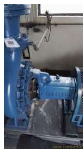
Foto 2 - Drenagem da água de lubrificação da gaxeta.
