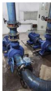
Foto 2 - Bombas da elevatória.
