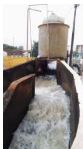
Foto 4 - Calha parshall na entrada de água bruta.
