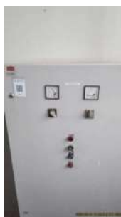
Foto 7 - Paineil de comando de uma das bombas.
