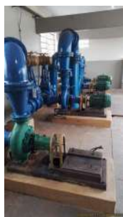
Foto 4 - Demais bombas da elevatória.
