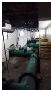
Foto 17 - Saída dos filtros.
