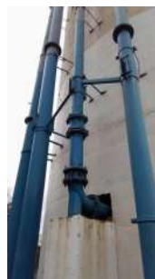
Foto 10 - Tubulação de recalque das bombas.
