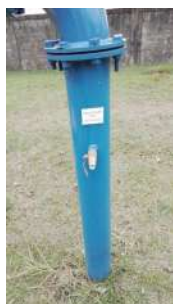
Foto 1 - Tomada de água bruta.
