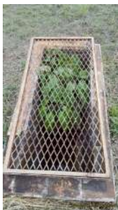
Foto 1 - Caixa que recebe água dos extravasores do R9 e R10.
