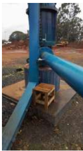
Foto 1 - Torneira para coleta de água bruta.
