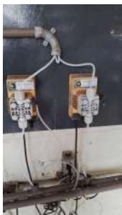
Foto 1 - Bomba dosadora de flúor.
