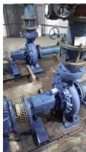
Foto 5 - Bomabs e sistema de drenagem da água de lubrificação.
