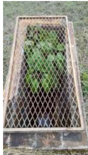
Foto 1 - Caixa que recebe água dos extravasores do R9 e R10
