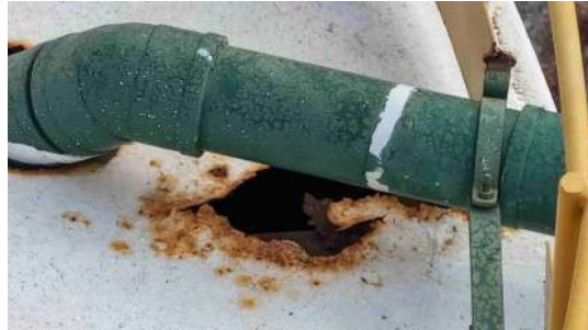
Foto 6 - Aberturas irregulares através das quais está posicionado o tubo de alimentação do reservatório.
