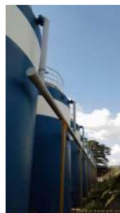
Foto 21 - Saídas para tanque de aeração.
