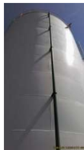
Foto 4 - Tubo de alimentação do reservatório, vindo do poço 1 (localizado ao lado).
