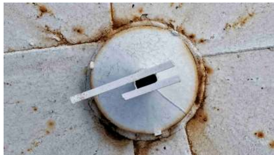
Foto 2 - Corrosão no topo do reservatório.
