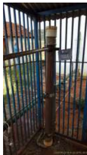
Foto 10 - Sistema para cloração da água.
