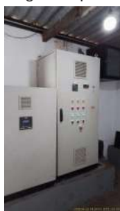
Foto 19 - Painéis elétricos para comando da bomba do poço.
