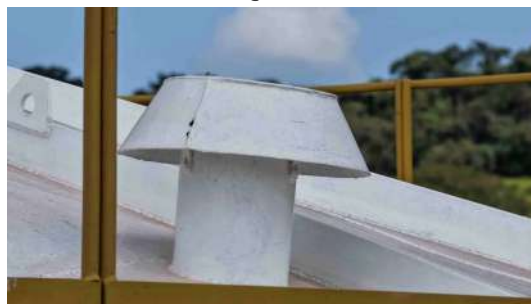
Foto 19 - Tubulação de ventilação na parte superior do reservatório.
