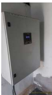
Foto 18 - Pannel elétrico com banco de capacitores.
