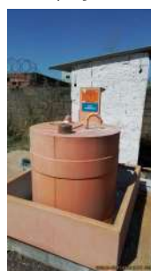
Foto 8 - Reservatório de armazenamento de reagente para fluoretação.
