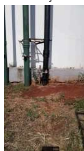
Foto 16 - Derivação para adição de cloro antes da alimentação do reservatório.
