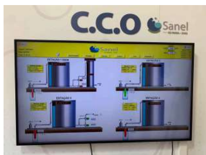
Foto 25 - Vista geral do sistema de reservação no CCO.
