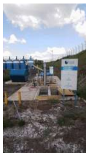
Foto 4 - Tratamento preliminar da ETE.
