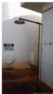
Foto 18 - Chuveiro de emergência instalado na unidade.
