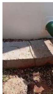
Foto 12 - Condutor para aterramento da estrutura.
