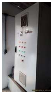
Foto 15 - Pannel elétrico da bomba do poço.
