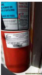
Foto 13 - Extintor de incêndio presente na unidade.
