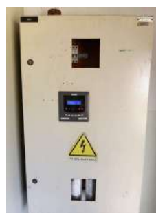
Foto 15 - Painel elétrico da bomba do poço.
