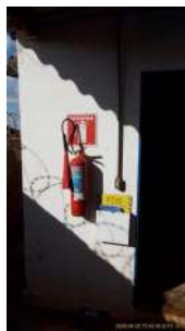
Foto 12 - Extintor de incêndio presente na unidade.
