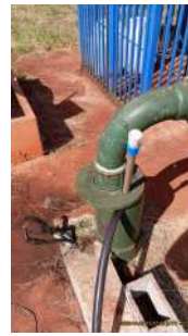
Foto 2 - Tubo de medição de nível.
