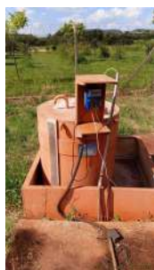
Foto 8 - Reservatório e bomba dosadora de reagente flúor.
