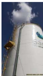
Foto 1 - Abertura do extravasor não está protegida com tela.
