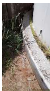
Foto 8 - Aterramento da estrutura.
