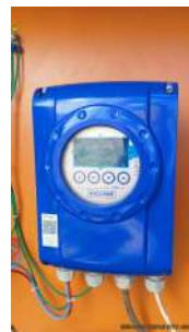
Foto 5 - Painel com interface do macromedidor.
