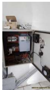
Foto 11 - Pannel elétrico da unidade.
