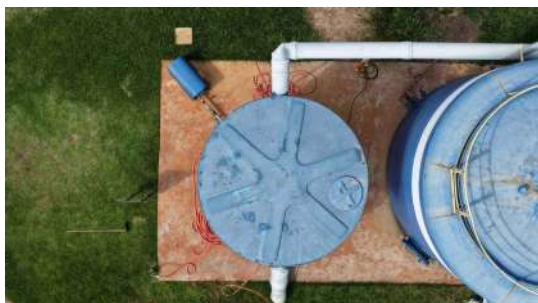
Foto 68 - Vista superior do tanque de aeração.
