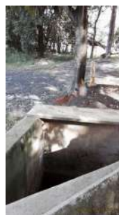
Foto 58 - Caixa de passagem na saída da unidade.
