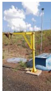
Foto 18 - Braço para montagem de talha em operação de manutenção.
