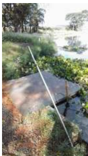
Foto 41 - Caixa de saída de efluente da lagoa.
