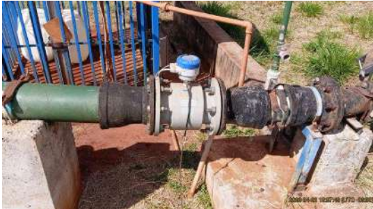
Foto 3 - Macromedidor instalado na saída do poço. Torneira para coleta de água bruta à direita.
