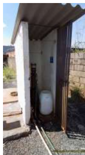
Foto 10 - Abrigo para dosadora de cloro.
