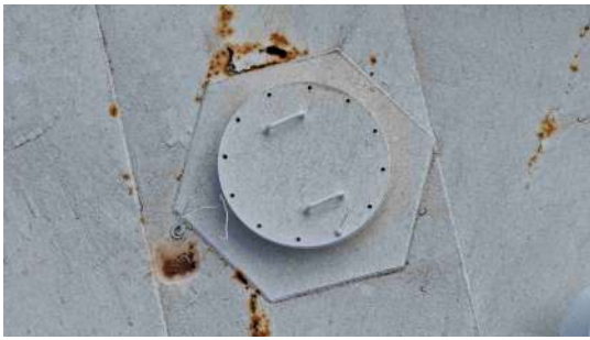
Foto 3 - Corrosão no topo do reservatório.
