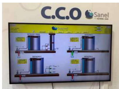
Foto 26 - Vista geral do sistema de reservação no CCO.
