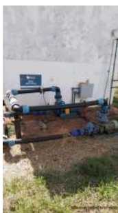
Foto 1 - Vista geral da captação e placa de identificação.
