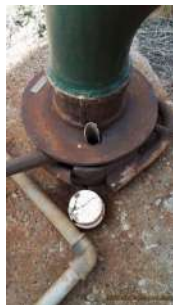
Foto 1 - Tubo de medição com extremidade quebrada, no momento da fiscalização.
