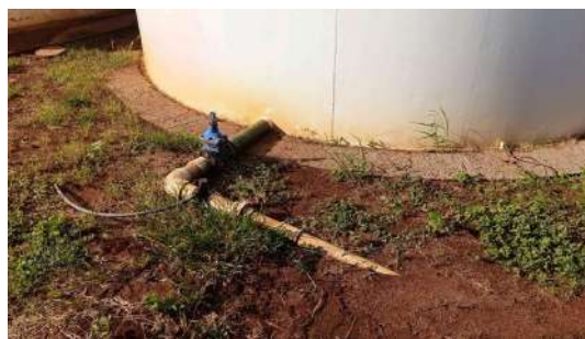
Foto 14 - Tubulação de saída do reservatório.
