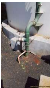
Foto 12 - Adição de flúor na tubulação entre o poço e o reservatório.
