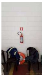
Foto 51 - Extintor de incêndio instalado no local.
