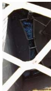
Foto 42 - Calha parshall na saída da ETE.
