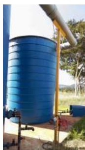
Foto 24 - Tanque de aeração.
