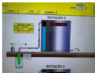
Foto 26 - Detalhes do reservatório 2 no CCO.
