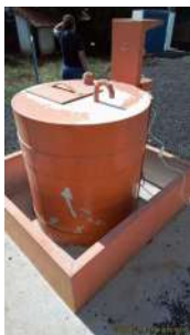
Foto 9 - Reservatório de reagente utilizado na fluoretação da água.
