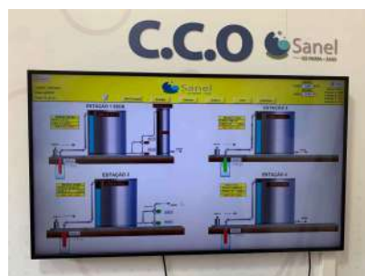
Foto 23 - Vista geral do sistema de reservação no CCO.
