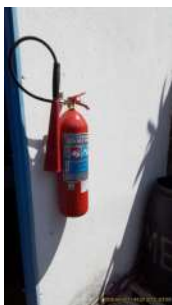
Foto 14 - Extintor de incêndio instalado no local.
