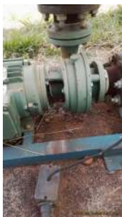
Foto 4 - Acoplamento motor e bomba.
