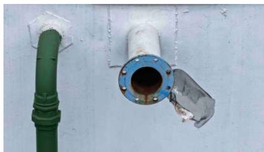
Foto 2 - Abertura do extravasor não está protegida com tela.
