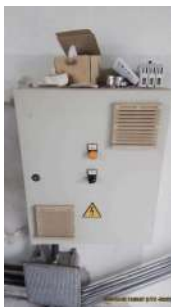
Foto 10 - Pannel elétrico da unidade.
