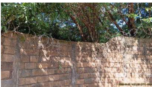
Foto 2 - Concertina colapsando em um segundo ponto do perímetro, vista a partir do interior da unidade, próximo ao reservatório.
