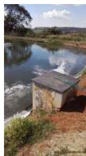
Foto 29 - Entrada de efluente na lagoa.
