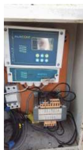
Foto 11 - Painel do controle de vazão afluente.
