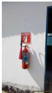
Foto 7 - Extintor de incêndio instalado na unidade.
