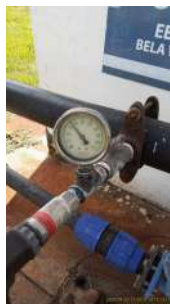
Foto 5 - Manômetro na linha de racalque.
