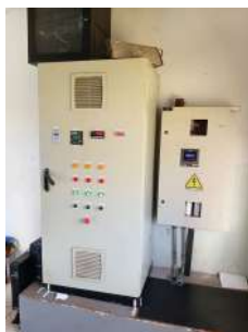
Foto 12 - Painel elétrico da bomba do poço.
