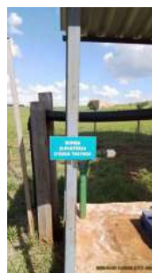
Foto 2 - Placa de identificação da instalação.
