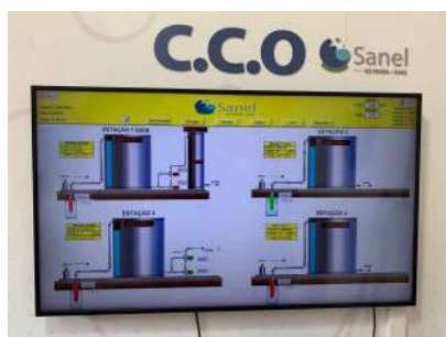
Foto 24 - Vista geral do sistema de reservação no CCO.
