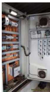
Foto 17 - Pannel elétrico da bomba do poço.
