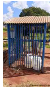
Foto 7 - Abrigo onde se encontram os reagentes utilizados no tratamento da água captada.
