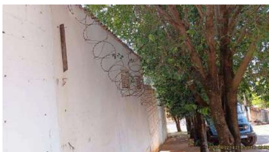
Foto 1 - Concertina colapsando, vista a partir do passeio público.
