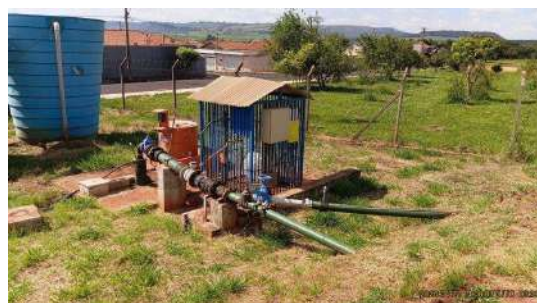
Foto 9 - Abrigo onde se encontram os reagentes utilizados no tratamento da água captada.
