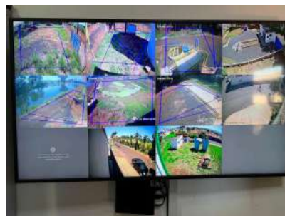
Foto 27 - Sistema de vigilância dos subsistemas. Reservatório 2 no canto superior esquerdo.
