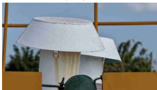
Foto 5 - Tubulações de ventilação sem tela de proteção.
