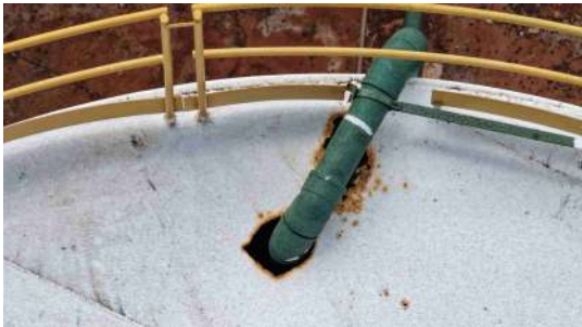
Foto 7 - Aberturas irregulares através das quais está posicionado o tubo de alimentação do reservatório.
