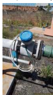
Foto 6 - Macromedidor instalado na saída do poço.
