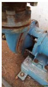
Foto 3 - Acoplamento motor e bomba.
