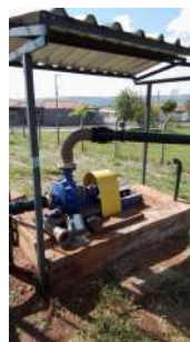
Foto 4 - Vista geral da elevatória.
