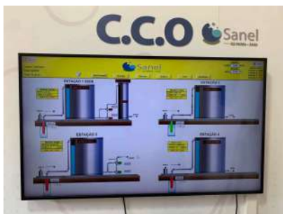
Foto 28 - Vista geral do sistema de reservação no CCO.
