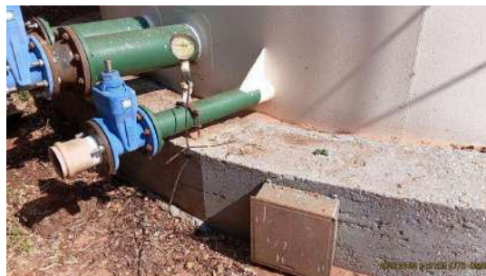
Foto 10 - Medidor de nível do reservatório (manômetro e sensor para telemetria).
