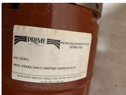
Foto 21 - Detalhe da bomba reserva do poço 2 e 3.
