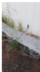
Foto 6 - Aterramento da estrutura.
