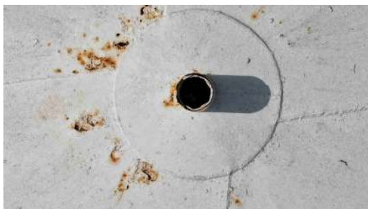
Foto 3 - Abertura no centro da parte superior do reservatório, sem tela de proteção.
