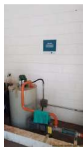
Foto 56 - Equipamento para preparo de polímero empregado na desidratação do lodo.
