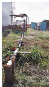
Foto 5 - Linha de recalque para a região do poço 4.
