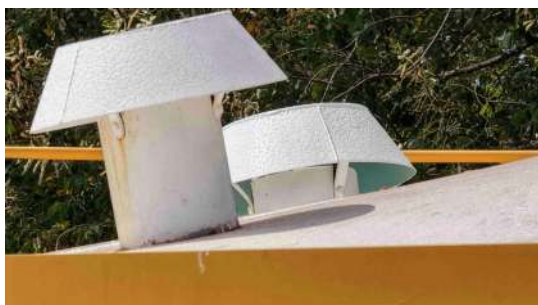
Foto 1 - Tubos de ventilação sem tela de proteção.
