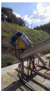
Foto 10 - Equipamento automatizado para remoção de areia.
