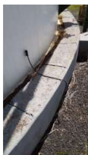
Foto 5 - Aterramento da estrutura.
