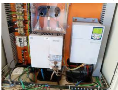
Foto 14 - Painel elétrico da bomba do poço.
