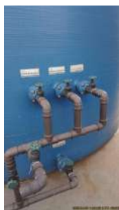
Foto 22 - Saídas para retirada de lodo do UASB.
