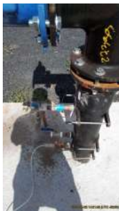
Foto 7 - Torneira para coleta de água bruta.
