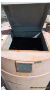
Foto 9 - Reservatório de armazenamento de reagente para fluoretação.
