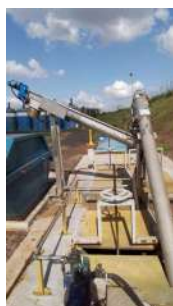
Foto 8 - Equipamento automatizado para remoção de areia.
