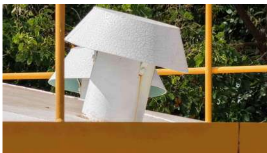
Foto 2 - Tubos de ventilação sem tela de proteção.
