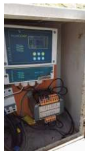
Foto 12 - Painel do controle de vazão afluente.
