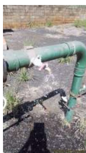
Foto 7 - Torneira para coleta de água bruta.
