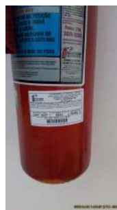
Foto 18 - Extintor de incêndio existente na unidade.
