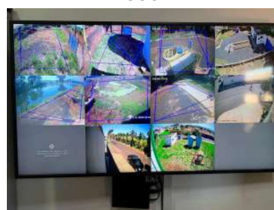
Foto 23 - Sistema de vigilância dos subsistemas. Reservatório 3 no canto inferior direito.
