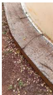
Foto 13 - Condutor para aterramento da estrutura.
