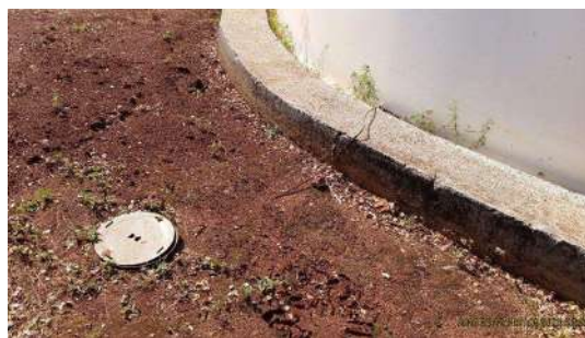
Foto 14 - Condutor para aterramento da estrutura.
