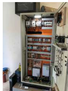
Foto 13 - Painel elétrico da bomba do poço.
