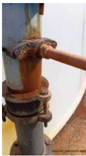
Foto 1 - Tubulação onde foi identificado vazamento.
