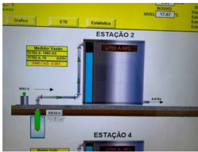
Foto 24 - Detalhes do poço 2 no CCO.
