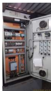
Foto 20 - Painéis elétricos para comando da bomba do poço.
