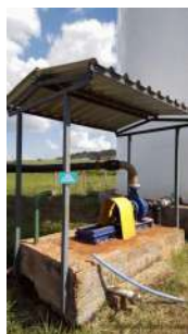
Foto 3 - Vista geral da elevatória.
