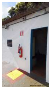
Foto 17 - Edificação de alvenaria existente no local para abrigo dos painéis elétricos.
