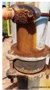
Foto 2 - Tubulação onde foi identificado vazamento.
