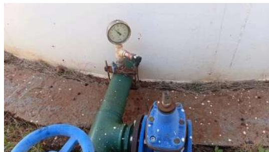
Foto 12 - Medidor de nível do reservatório (manômetro e sensor para telemetria).
