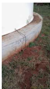
Foto 10 - Aterramento da estrutura.
