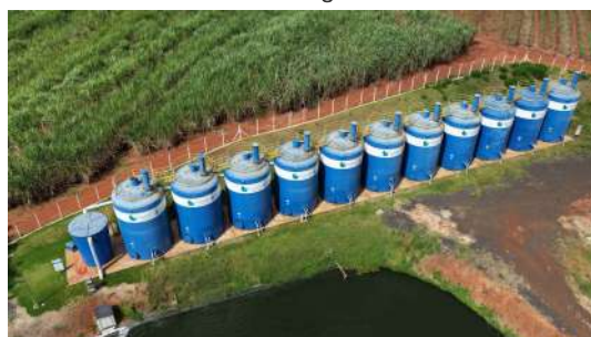
Foto 65 - UASBs em paralelo.
