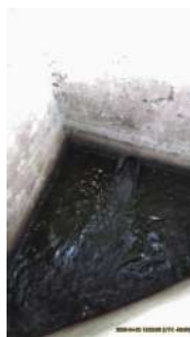
Foto 59 - Caixa de passagem na saída da unidade.
