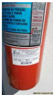
Foto 15 - Extintor de incêndio instalado no local.
