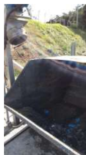
Foto 9 - Caçamba para armazenamento dos sólidos retidos no tratamento preliminar.
