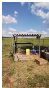
Foto 1 - Vista geral da elevatória.
