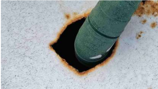
Foto 5 - Aberturas irregulares através das quais está posicionado o tubo de alimentação do reservatório.
