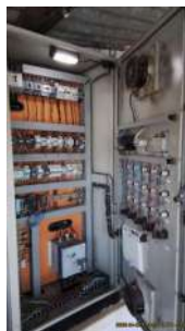
Foto 17 - Painel elétrico da bomba da captação.
