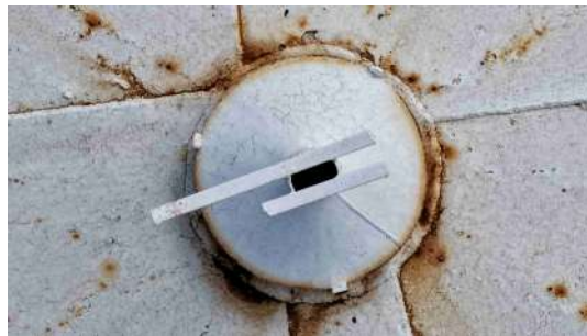
Foto 2 - Abertura de ventilação no centro da parte superior do reservatório não possui tela de proteção e permite entrada de água de chuva.
