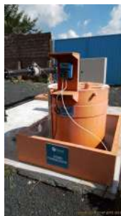
Foto 10 - Reservatório de reagente utilizado na fluoretação da água.
