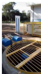
Foto 48 - Centrífuga para secagem de lodo, não utilizada até o momento.
