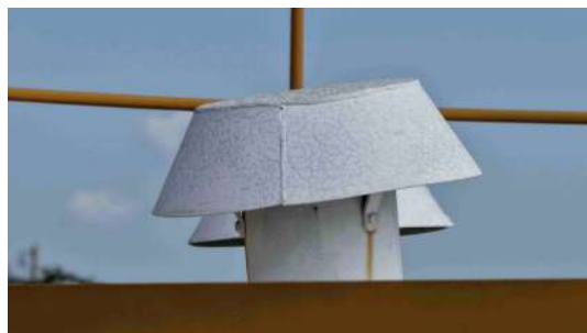
Foto 4 - Tubulações de ventilação sem tela de proteção.
