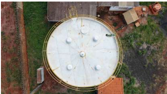
Foto 1 - Pontos de corrosão na parte superior do reservatório.
