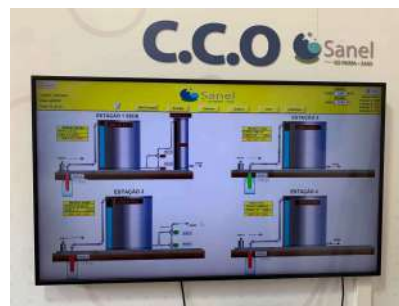
Foto 21 - Vista geral do sistema de reservação no CCO.
