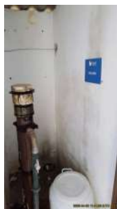
Foto 11 - Dosadora de cloro.
