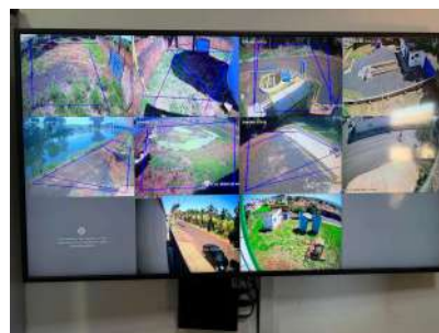
Foto 26 - Sistema de vigilância dos subsistemas. Reservatório 4 no canto superior direito.
