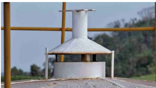
Foto 3 - Abertura de ventilação no centro da parte superior do reservatório não possui tela de proteção e permite entrada de água de chuva.
