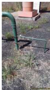
Foto 13 - Adição de cloro na tubulação entre o poço e o reservatório.
