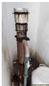
Foto 1 - Dosadora de cloração com vazamento, no momento da fiscalização.
