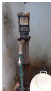
Foto 2 - Registro fotográfico enviado pelo prestador, antes do fechamento do relatório de fiscalização, evidenciando resolução do vazamento.
