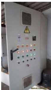
Foto 16 - Painel elétrico da bomba da captação.
