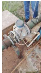
Foto 5 - Macromedidor instalado na captação.
