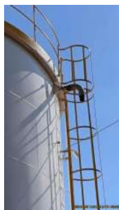
Foto 11 - Tubo extravasor (ao lado da escada) do reservatório.
