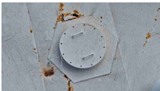
Foto 22 - Tampa de inspeção do reservatório 1 entreaberta.
