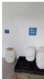
Foto 14 - Armazenamento de produto utilizado na cloração.
