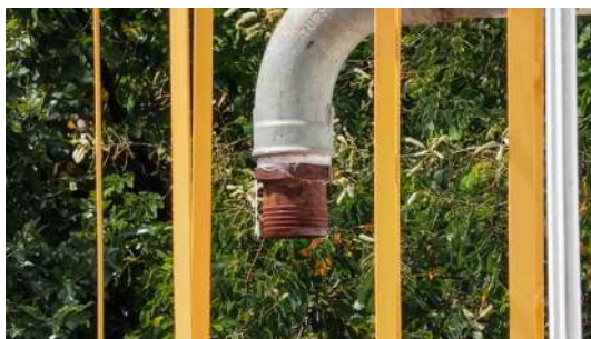
Foto 4 - Tubulação de extravasão afixada no topo do costado do reservatório, sem tela de proteção
