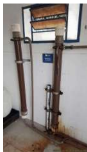
Foto 13 - Sistema de cloração empregado.
