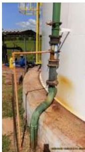
Foto 3 - Tubulação onde foi identificado vazamento.
