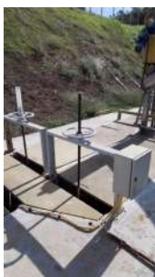
Foto 13 - Comportas das vias do desarenador.
