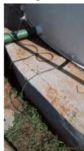
Foto 9 - Aterramento da estrutura.
