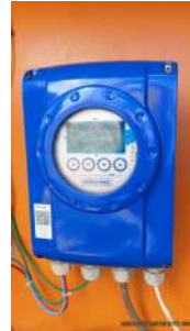
Foto 4 - Painel com interface do macromedidor.
