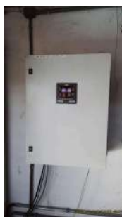
Foto 16 - Pannel com banco de capacitores para ganho na eficiência energética da unidade.
