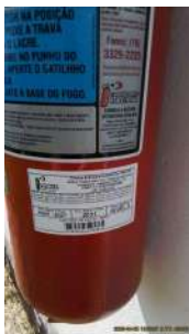
Foto 8 - Extintor de incêndio instalado na unidade.
