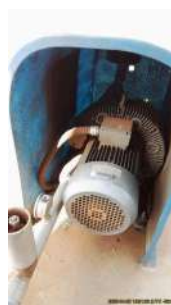
Foto 25 - Compressor utilizado na aeração.
