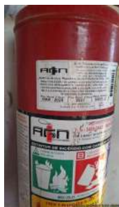
Foto 1 - Validade do extintor de incêndio.
