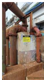
Foto 2 - Caixa de entrada de água bruta.
