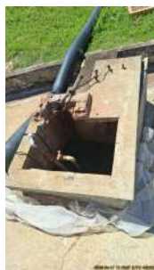
Foto 1 - Abertura sem tampa.
