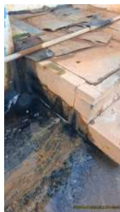
Foto 1 - Vazamento na escada.
