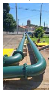
Foto 4 - Tubulações de água tratada provenientes do sistema de tratamento convencional.
