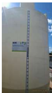
Foto 30 - Tanque de armazenamento de hipoclorito de sódio gerado.
