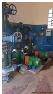
Foto 1 - Vista dos conjuntos motobombas.
