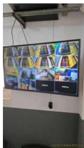
Foto 35 - Sistema de monitoramento dos filtros.
