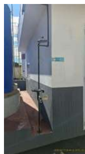
Foto 31 - Chuveiro de emergência.
