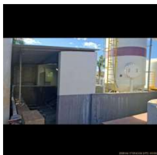
Foto 28 - Sistema de preparo e dosagem de Geocálcio, atualmente desativado.
