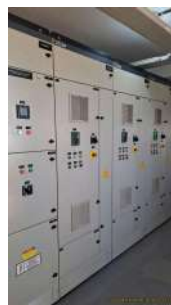
Foto 32 - Painéis de controle da elevatória.
