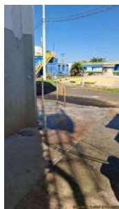
Foto 3 - Chão molhado em decorrência dos vazamentos.
