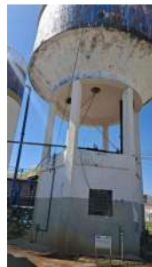
Foto 2 - Vista geral dos vazamentos.
