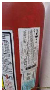
Foto 1 - Validade do extintor de incêndio.
