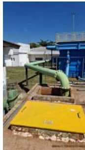
Foto 9 - Entrada da água tratada da ETA Compacta.
