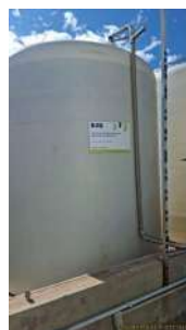
Foto 29 - Tanque de armazenamento de hipoclorito de sódio.
