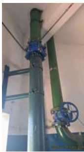
Foto 5 - Tubulações do reservatório.
