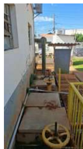
Foto 13 - Recalque para o sistema de tratamento compacto.
