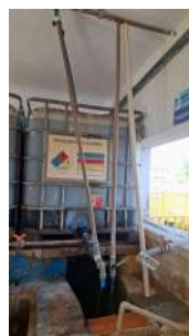
Foto 9 - Sistema de dosagem de PAC (policloreto de alumínio).
