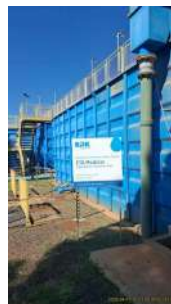
Foto 52 - ETA modular (compacta).
