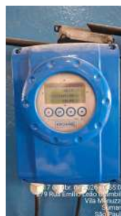
Foto 65 - Medidor de vazão na saída da ETA compacta.
