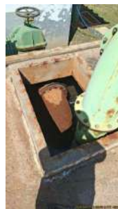
Foto 2 - Outra entrada de água sem fechamento.
