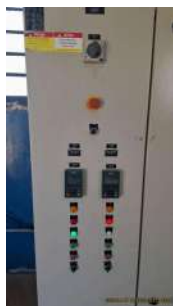
Foto 3 - Painel de controle.
