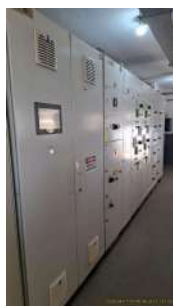
Foto 33 - Painéis de controle dos filtros.
