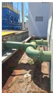
Foto 11 - Tubulação de sucção.
