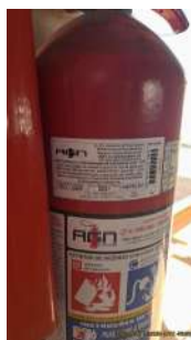
Foto 1 - Validade do extintor de incêndio.
