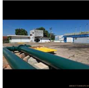
Foto 8 - Entrada da água tratada da ETA convencional.
