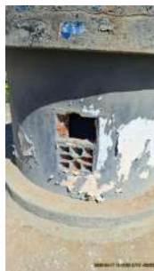
Foto 1 - Abertura na chaminé do reservatório.
