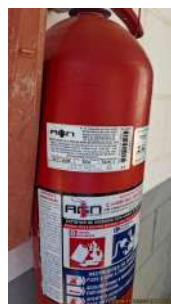
Foto 10 - Validade do extintor de incêndio.
