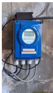
Foto 7 - Medidor de vazão Vila Menuzzo.
