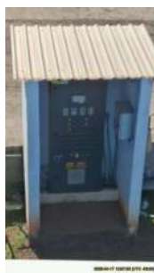
Foto 60 - Painel de controle da ETA compacta.
