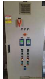
Foto 8 - Painele de controle.
