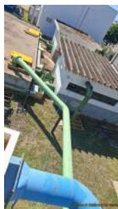
Foto 62 - Tubulação de saída de água tratada.
