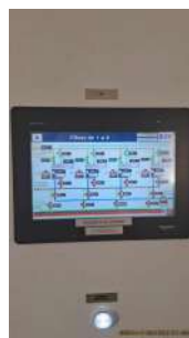
Foto 34 - Tela de comando dos filtros.
