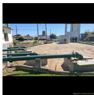
Foto 4 - Tubulações de sucção no reservatório.
