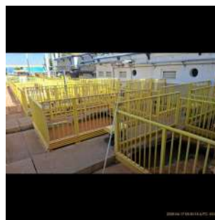
Foto 11 - Linhas de floculação e decantação.
