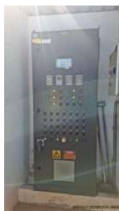
Foto 64 - Painel de controle da ETA compacta.
