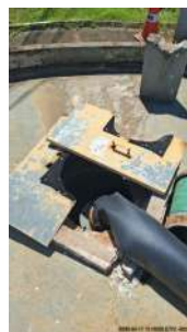
Foto 2 - Entrada de água sem fechamento.
