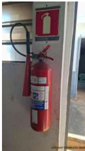
Foto 3 - Extintor de incêndio.
