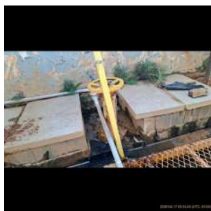
Foto 3 - Vazamento na haste do registro.
