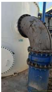
Foto 51 - Saída da água tratada da ETA Convencional.
