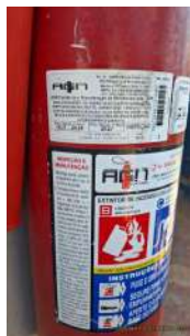
Foto 1 - Validade do extintor de incêndio.
