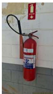
Foto 9 - Extintor de incêndio.
