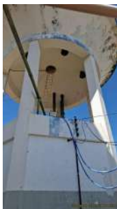
Foto 9 - Saídas do reservatório.
