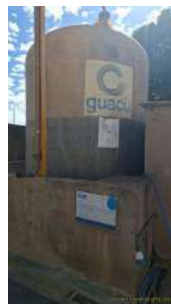
Foto 25 - Policloreto de Alumínio (PAC)
