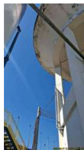
Foto 4 - Detalhe dos vazamentos na base do reservatório.
