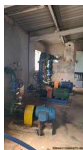
Foto 4 - Os dois primeiros conjuntos motobomba são Planalto do Sol, operam simultaneamente.
