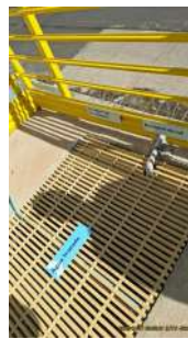
Foto 40 - Sistema de dosagem pós-filtração.
