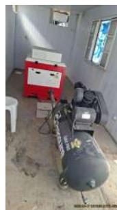
Foto 63 - Soprador e compressor da ETA compacta.
