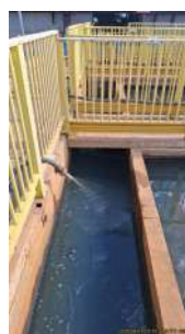
Foto 19 - Calha de saída do decantador.
