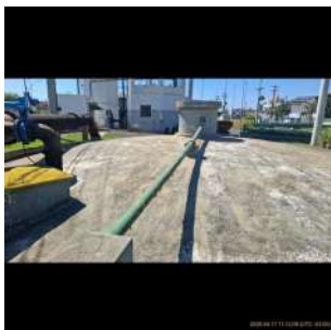
Foto 5 - Vista da outra lateral do reservatório.
