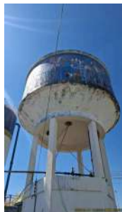
Foto 1 - Vazamentos no reservatório.
