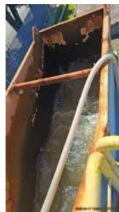
Foto 55 - Entrada da água bruta.
