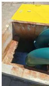
Foto 1 - Entrada de água sem fechamento.
