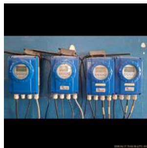
Foto 8 - Medidores de vazão.
