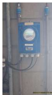
Foto 6 - Medidor de vazão Res. Ravagnani.
