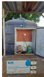
Foto 27 - Tanque de armazenamento de ácido fluossilícico.
