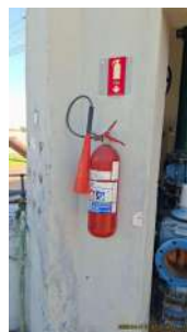
Foto 2 - Extintor de incêndio.
