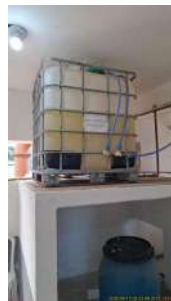
Foto 4 - Sistema de backup de hipoclorito.
