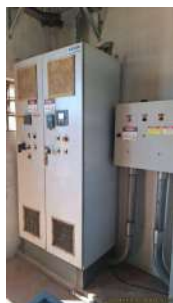
Foto 9 - Painel de controle.
