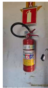
Foto 6 - Extintor de incêndio.
