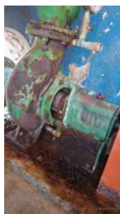
Foto 1 - Gaxeta vazando na bomba 2.
