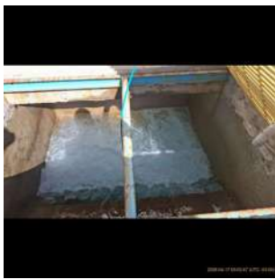
Foto 39 - Caixa de saída da água filtrada.
