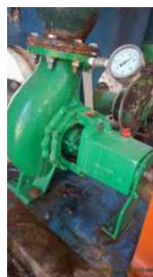
Foto 2 - Gaxeta vazando na bomba 1.
