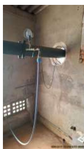
Foto 5 - Manômetro e tubulação de recalque.
