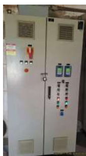
Foto 4 - Painel de controle.
