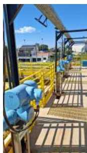
Foto 37 - Atuadores dos filtros.
