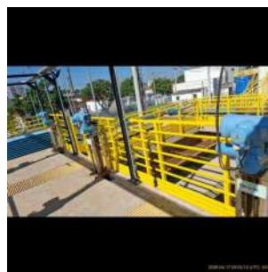
Foto 38 - Vista dos filtros.
