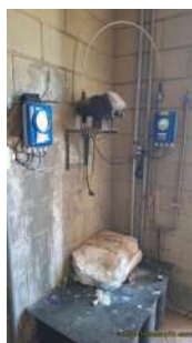
Foto 5 - Medidores de vazão.
