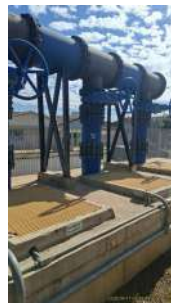
Foto 23 - Elevatória de água decantada.
