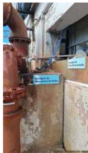
Foto 3 - Dosagem de produtos químicos na entrada.
