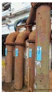
Foto 1 - Tubulações de entrada de água bruta.
