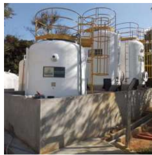
Foto 21 - Tanque de armazenamento de hipoclorito de sódio (esquerda) e de PAC 12 (centro e direita)
