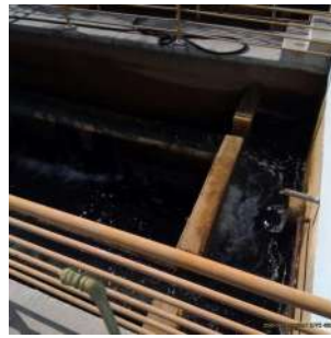
Foto 18 - Entrada de água no filtro
