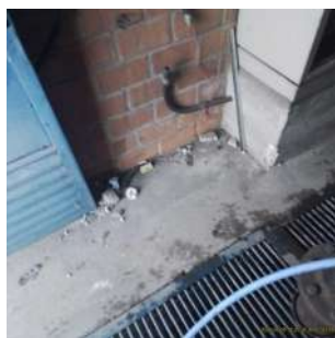
Foto 1 - Entulho no local
