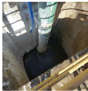
Foto 4 - Poço de sucção
