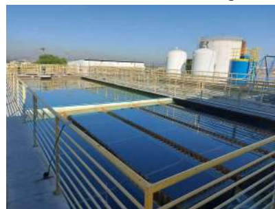
Foto 32 - Vista geral do decantador
