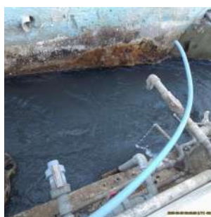
Foto 2 - Aplicação na entrada de hidróxido de cálcio, PAC e hipoclorito de sódio
