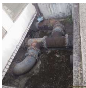
Foto 8 - Tubulações e conexões
