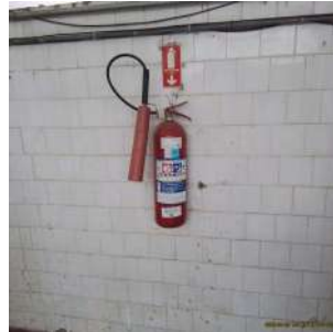
Foto 22 - Extintor de incêndio
