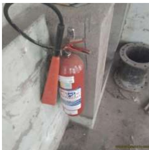
Foto 1 - Extintor de incêndio
