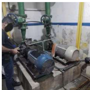
Foto 1 - Bombas de recalque para os reservatórios do Jd. América e Vila Martins
