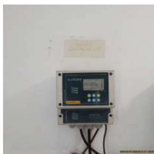
Foto 5 - Macromedidor de vazão de entrada
