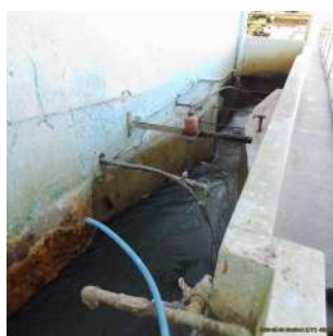
Foto 1 - Calha Parshall e chegada de água bruta
