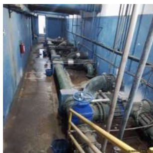
Foto 36 - Vista geral das tubulações e conexões de entrada para a galeria
