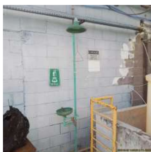
Foto 14 - Chuveiro de emergência
