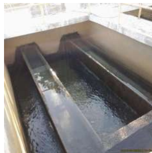
Foto 16 - Filtro com bloco Leopold
