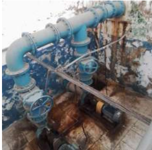
Foto 7 - Barrilete de recalque
