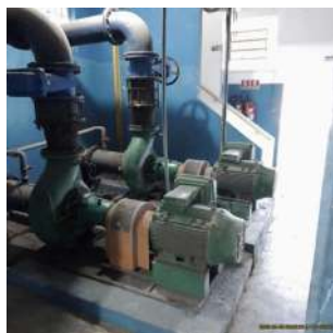
Foto 40 - Vista geral dos conjuntos motobombas
