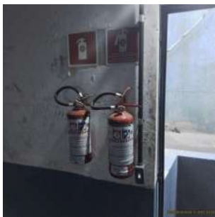
Foto 21 - Extintor de incêndio
