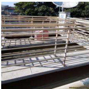
Foto 11 - Vista geral dos floculadores
