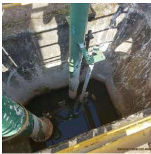
Foto 3 - Poço de sucção
