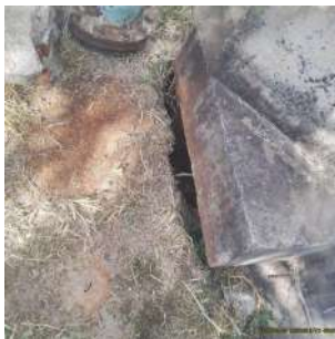
Foto 1 - Sinais de erosão na base de apoio do reservatório
