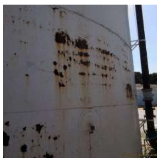
Foto 3 - Sinais de início processo corrosivo do reservatório
