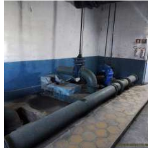
Foto 20 - Tubulações e registros de manobra
