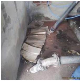
Foto 5 - Lixo espalhado na casa de bombas do elevado moradas
