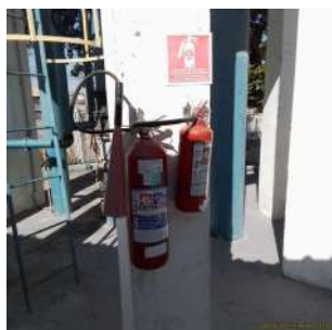
Foto 3 - Extintor de incêndio
