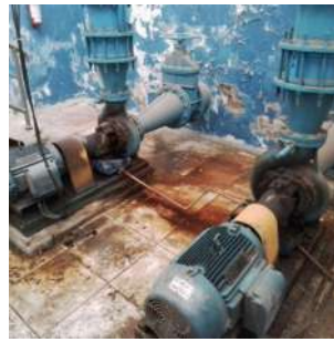
Foto 6 - Vista geral dos conjuntos motobombas
