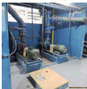
Foto 39 - Vista geral dos conjuntos motobombas
