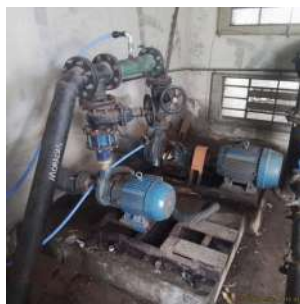
Foto 9 - Conjunto motobombas para o Reservatório Moradas
