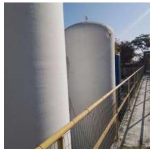
Foto 14 - Armazenamento de produto químico na ordem: hipoclorito de sódio, PAC e hidróxido de cálcio
