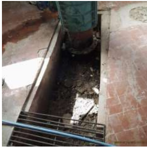
Foto 1 - A - Vala de drenagem com muitos resíduos
