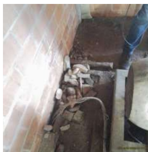
Foto 2 - Entulho espalhado na casa de bombas
