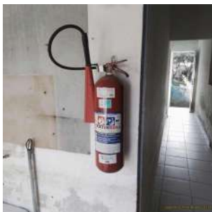
Foto 24 - Extintor de incêndio
