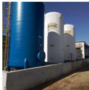
Foto 22 - Vista geral dos tanques de armazenamento de produtos químicos
