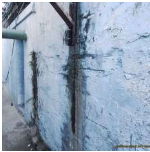
Foto 1 - Vazamentos na parede do decantador
