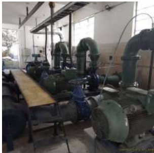
Foto 13 - Vista geral da casa de bombas
