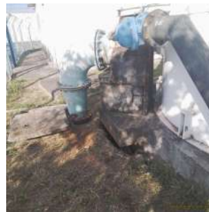
Foto 2 - Sinais de erosão na base de apoio do reservatório
