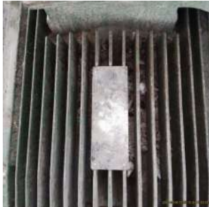
Foto 11 - Placa de identificação do motor 4
