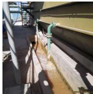
Foto 4 - Descarga dos decantadores
