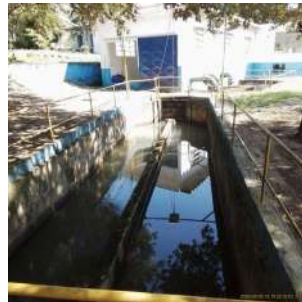
Foto 16 - Caixa de areia
