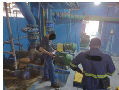
Foto 41 - Realização da inspeção preditiva no conjunto motobomba
