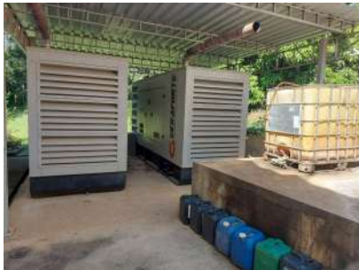
Foto 23 - Geradores de energia
