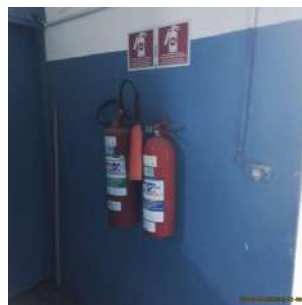
Foto 24 - Extintor de incêndio
