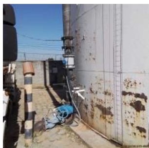
Foto 3 - Tubulação de entrada com macromedidor
