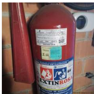
Foto 1 - Extintor de incêndio com validade vencida
