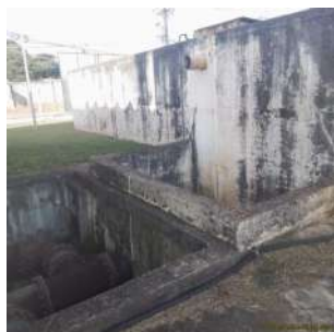
Foto 1 - Local sem guarda corpo
