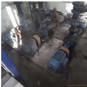
Foto 5 - Vista geral dos conjuntos motobombas.
