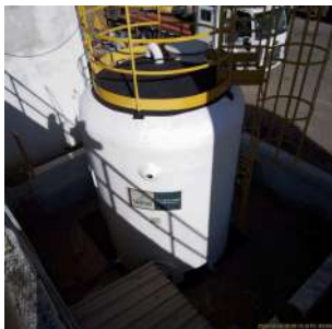
Foto 13 - Armazenamento de hipoclorito de sódio
