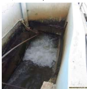
Foto 4 - Misturador rápido hidráulico
