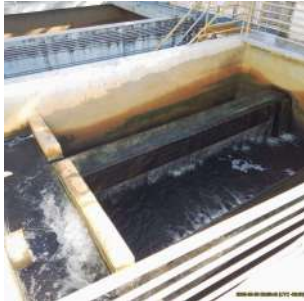
Foto 19 - Distribuição de água no filtro
