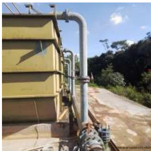
Foto 3 - Entrada de água nos decantadores
