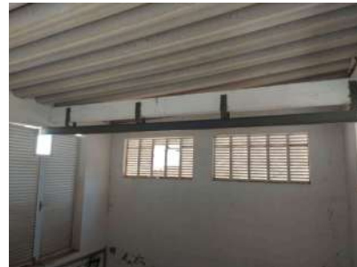
Foto 12 - Trilho para içamento para movimentação das bombas
