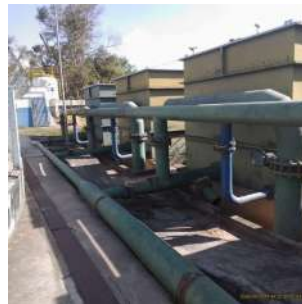
Foto 8 - Tubos e conexões de saída e lavagem dos filtros
