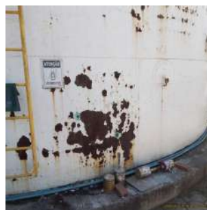
Foto 2 - Sinais de início processo corrosivo do reservatório
