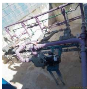
Foto 19 - bombas dosadoras de hidróxido de cálcio
