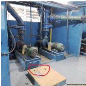
Foto 1 - Tampa de inspeção com furos
