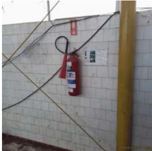
Foto 21 - Extintor de incêndio
