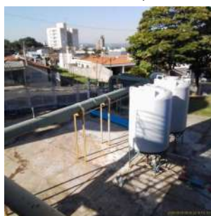
Foto 6 - Tubulação de água tratada para reservatório
