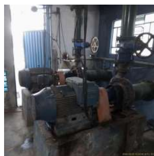
Foto 17 - Bombas encaminham para o Reservatório João Jabour (Cristo)
