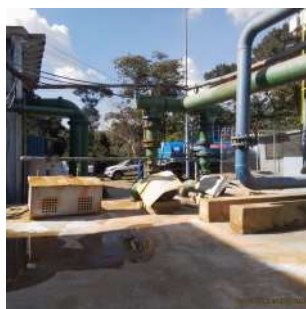
Foto 11 - Conjunto motobomba para lavagem dos filtros
