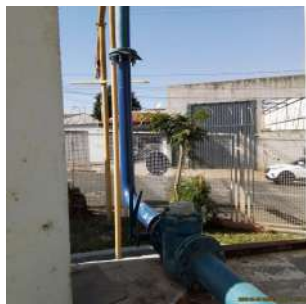
Foto 5 - Tubulação de alimentação de caminhões pipa
