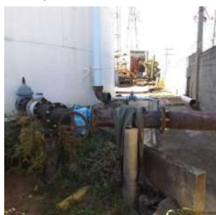
Foto 5 - Tubulações de saída com macromedidor
