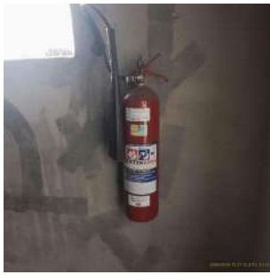
Foto 10 - Extintor de Incêndio
