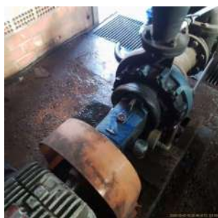
Foto 1 - Gaxeta com vazamento excessivo de água
