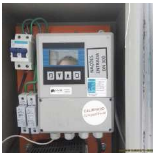
Foto 1 - Medidor de vazão de entrada está marcando negativo
