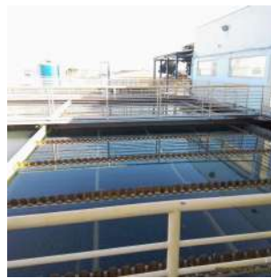
Foto 8 - Vista lateral dos decantadores
