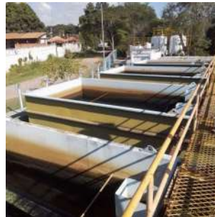
Foto 6 - Vista geral dos filtros
