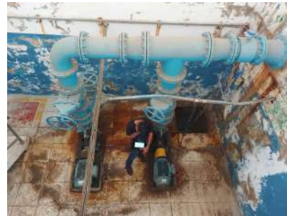
Foto 10 - Inspeção preditiva das bombas
