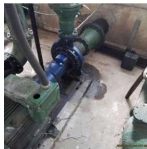
Foto 6 - B - Presença de mancha de óleo fresca entorno da bomba centrífuga
