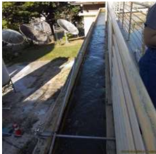
Foto 9 - Canal de água após Calha Parshall
