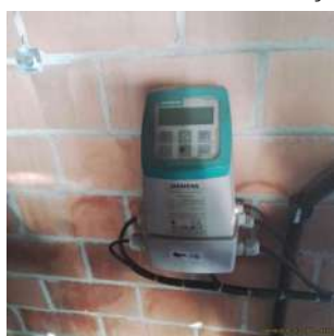
Foto 3 - Medidor de vazão
