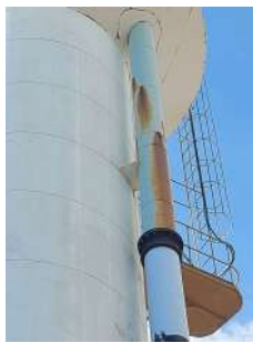
Foto 1 - Vazamento na tubulação de entrada
