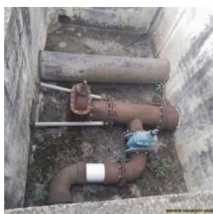
Foto 7 - Válvulas de manobra
