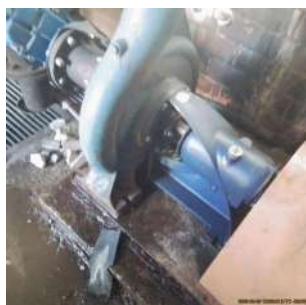
Foto 3 - Gaxeta com vazamento excessivo de água
