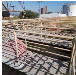
Foto 10 - Vista geral dos floculadores
