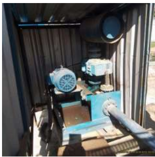
Foto 1 - Sistema de soprador de ar
