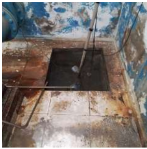
Foto 5 - Poço de sucção da água de gaxeta
