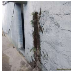
Foto 2 - Vazamentos na parede do decantador
