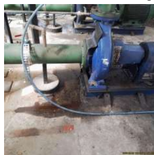
Foto 8 - B - Presença de mancha de óleo fresca entorno da bomba centrífuga
