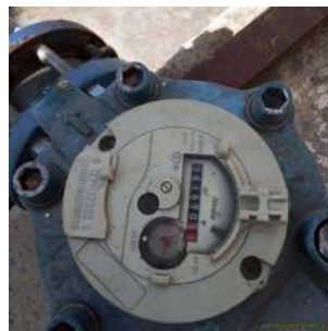
Foto 6 - Macromedidor da saída de alimentação de caminhões pipa
