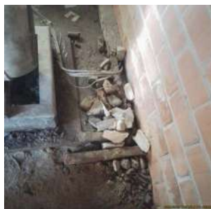
Foto 3 - Entulho espalhado na casa de bombas
