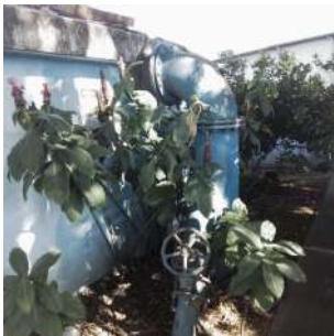
Foto 4 - Tubulação de entrada de água
