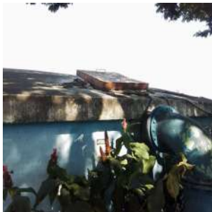
Foto 1 - Ausência de guarda-corpos na cobertura do reservatório, próximo à tampa de inspeção.
