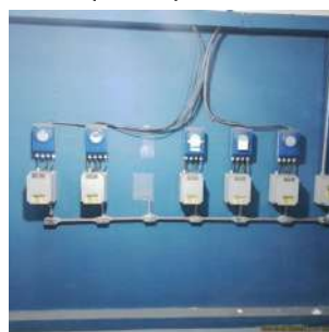
Foto 35 - Vista geral dos macromedidores de saída da Galeria
