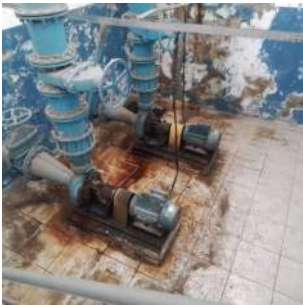
Foto 1 - Vista geral dos conjuntos motobombas
