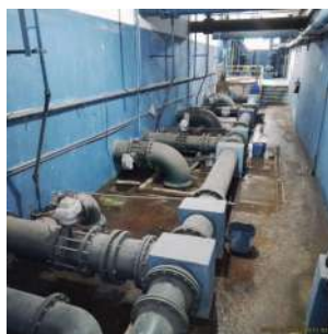
Foto 37 - Vista geral das tubulações e conexões de entrada para a galeria
