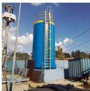
Foto 18 - Tanque de armazenamento de hidróxido de cálcio
