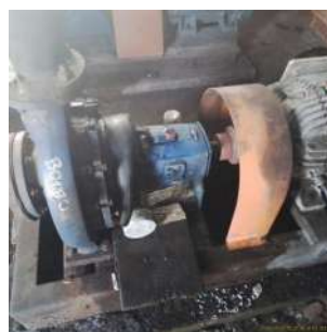
Foto 2 - Gaxeta com vazamento excessivo de água
