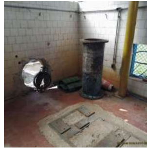
Foto 2 - A - Peças não organizadas espalhadas pela casa de bombas
