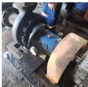
Foto 5 - Vapor saindo da gaxeta por trabalhar a seco
