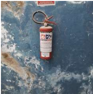
Foto 2 - Extintor de incêndio
