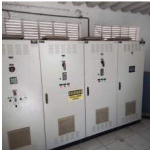
Foto 9 - Vista geral dos painéis elétricos
