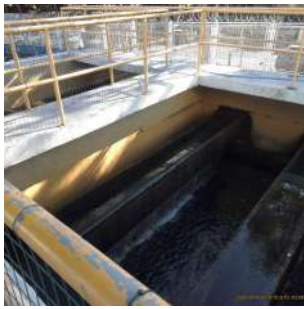
Foto 17 - Vista geral do filtro
