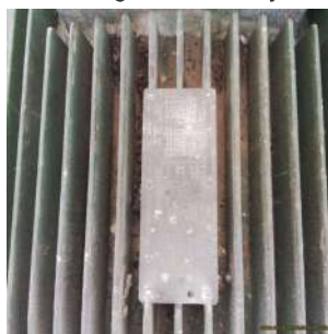
Foto 6 - Placa de identificação do motor 1
