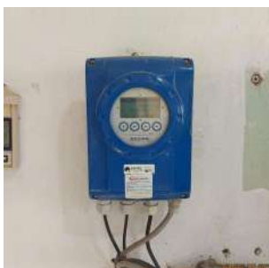
Foto 10 - Macromedidor de entrada na ETA
