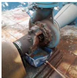
Foto 1 - Bomba com sinais forte de corrosão
