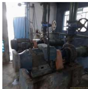
Foto 2 - Bombas encaminham para o Reservatório João Jabour (Cristo)
