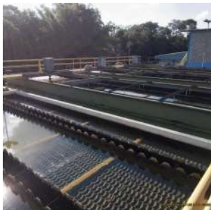
Foto 7 - Vista geral dos decantadores lamelares
