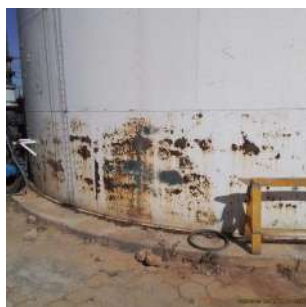
Foto 1 - Sinais de início processo corrosivo do reservatório
