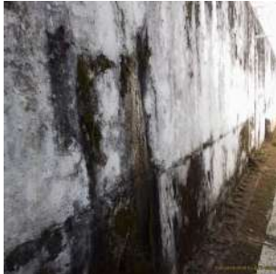
Foto 3 - Vazamentos na parede do decantador
