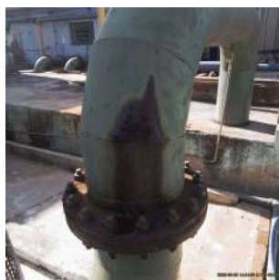
Foto 1 - Vazamento na tubulação de entrada no tanque de contato
