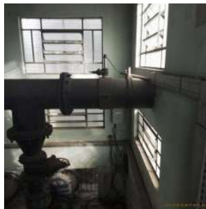
Foto 6 - Tubulação de saída e medidor de vazão
