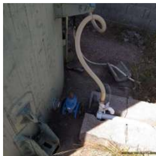
Foto 3 - Válvula registro e tomada de água bruta
