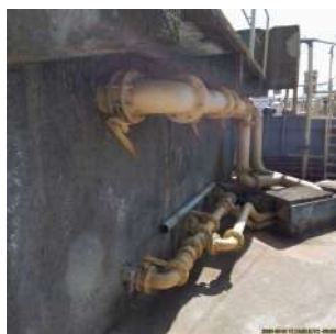
Foto 17 - Tubulações do sistema de filtração
