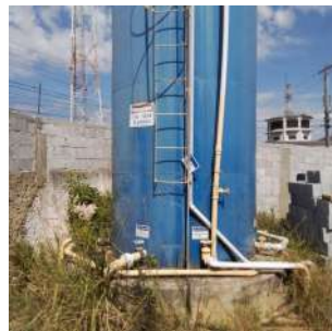
Foto 4 - Vista da base do reservatório com indicações nas tubulações
