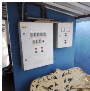
Foto 5 - Painel de controle
