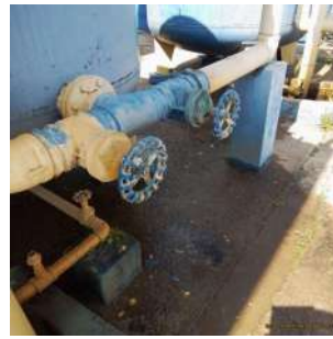
Foto 2 - B - Vazamento no registro de fechamento
