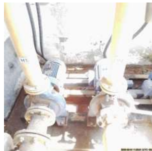
Foto 10 - Conjunto motobomba para lavagem dos filtros da ETA 2
