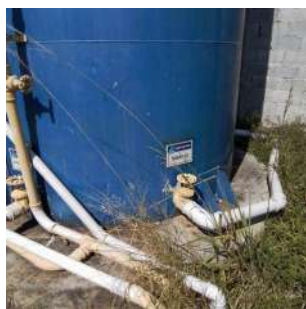
Foto 5 - Tubulação indicando local de abastecimento Marf III
