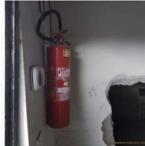
Foto 7 - Extintor de incêndio
