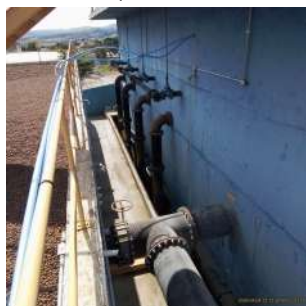
Foto 30 - Tubulações de saída da ETA
