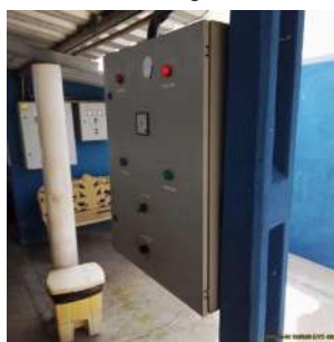
Foto 4 - Painel de controle
