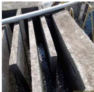
Foto 19 - Passagem de água pré-filtro
