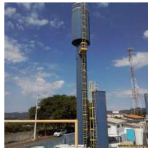
Foto 29 - Reservatório maior para distribuição de água e o menor para lavagem dos filtros
