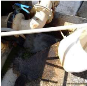
Foto 2 - Chegada da água bruta
