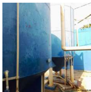
Foto 17 - Decantadores de alta taxa
