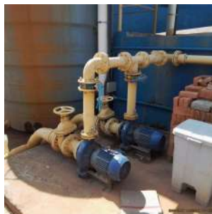
Foto 14 - Bombeamento da ETA Anexo para os filtros da ETA 2
