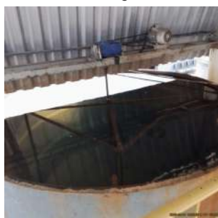
Foto 3 - Tanque em processo de decantação
