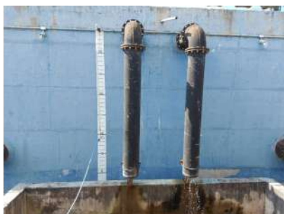
Foto 5 - Extravasor e medidor de nível
