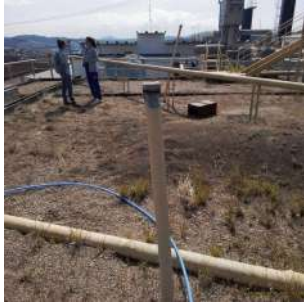
Foto 3 - Tubulação de respiro
