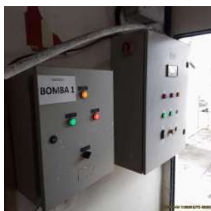
Foto 7 - Painéis de controle
