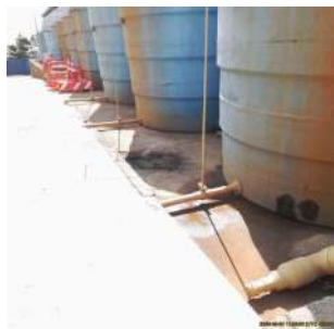
Foto 13 - Tubulação de saída do lodo
