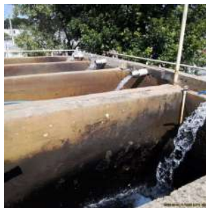
Foto 22 - Distribuição de água nos filtros
