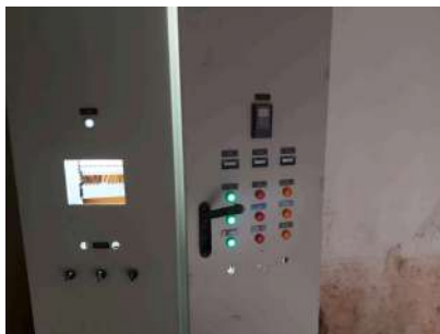
Foto 8 - Painel elétrico fechado
