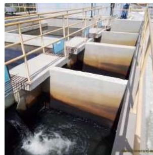
Foto 27 - Vista geral dos filtros
