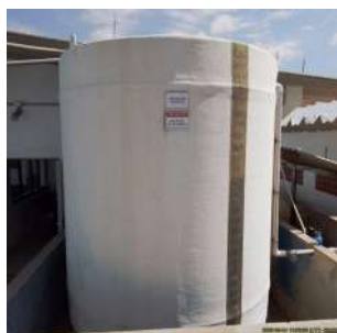
Foto 15 - Armazenamento de sulfato de alumínio
