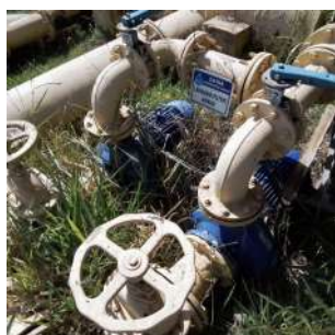
Foto 1 - Mato alto cobrindo o conjunto motobomba da lavagem dos filtros da ETA 2
