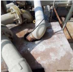
Foto 20 - Entrada de água no tanque de contato pós tratamento
