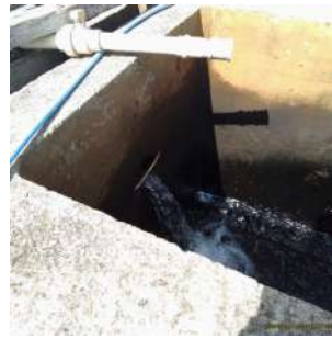
Foto 24 - Chegada de água do Ribeirão da Serra (7 m 3 por h)
