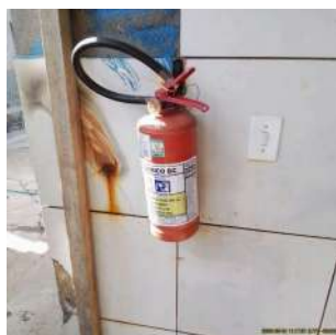
Foto 13 - Extintor de incêndio
