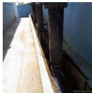
Foto 31 - Saída da lavagem do filtro
