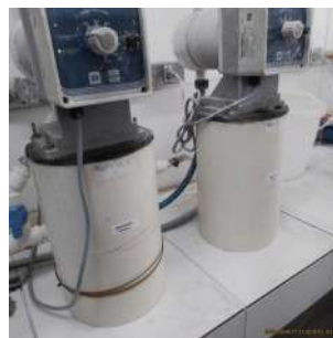
Foto 15 - Bomba dosadora de sulfato de alumínio
