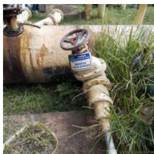
Foto 6 - Booster para a caixa elevada
