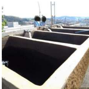
Foto 20 - Vista geral dos filtros
