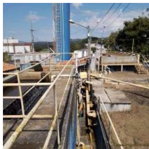
Foto 1 - Tubulações em desuso prejudicando visibilidade e locomoção na ETA
