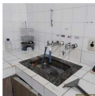
Foto 5 - Saída de amostra de água da ETA 2
