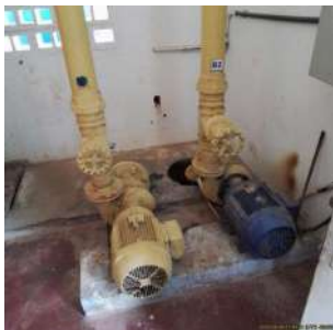
Foto 9 - Conjunto motobomba para lavagem dos filtros da ETA 1
