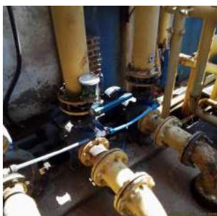
Foto 11 - Conjunto motobomba do tanque de contato para o reservatório apoiado
