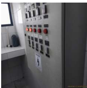
Foto 16 - Painel de acionamento
