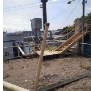
Foto 4 - Tubulação de respiro
