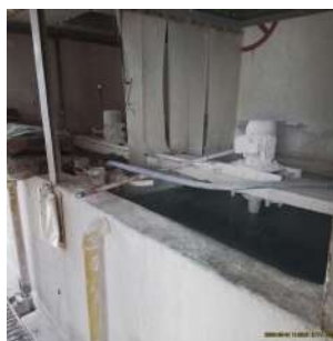
Foto 6 - Tanque de preparo de hidróxido de cálcio
