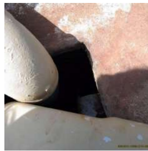
Foto 19 - Entrada de água no tanque de contato pós tratamento
