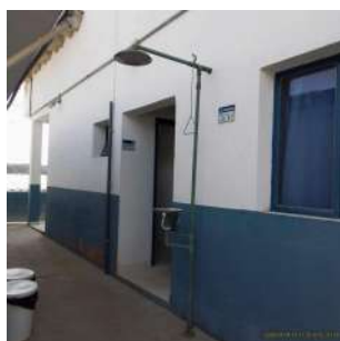
Foto 13 - Chuveiro de emergência
