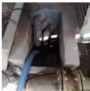
Foto 14 - Entrada do tanque de contato
