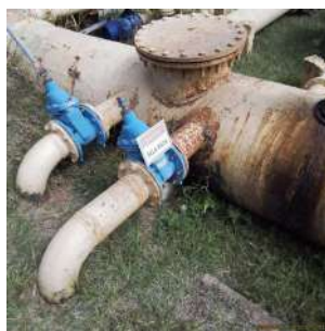
Foto 7 - Tubulação de saída sistema Bela Vista
