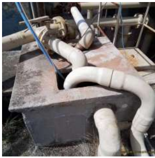
Foto 1 - Entrada da tubulação no reservatório
