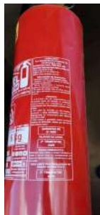
Foto 10 - Validade do extintor de incêndio
