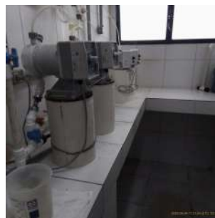
Foto 14 - Bomba dosadora de sulfato de alumínio
