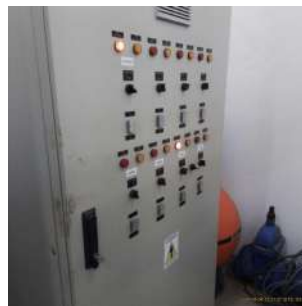
Foto 2 - Painel de comando
