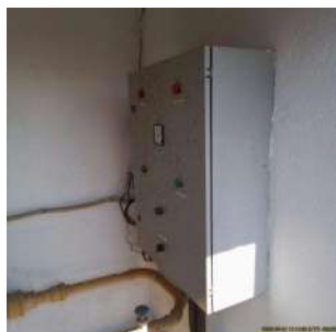
Foto 15 - Painel de controle
