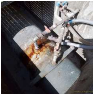
Foto 1 - A - Aplicação de hidróxido de cálcio na tubulação de água bruta que distribui para todas as ETAs com sinais de corrosão e possível vazamento
