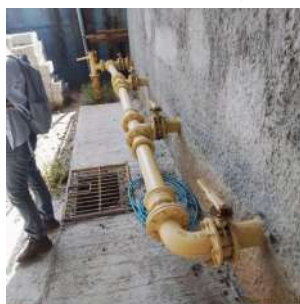
Foto 18 - Tubulações do sistema de filtração
