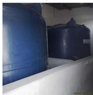
Foto 14 - Armazenamento de hipoclorito de sódio
