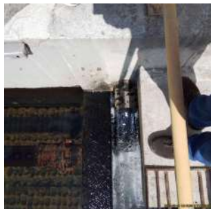
Foto 28 - Entrada de água do Ribeirão da Serra direto para os filtros
