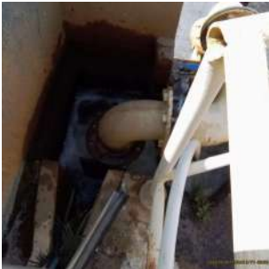
Foto 1 - Chegada da água bruta
