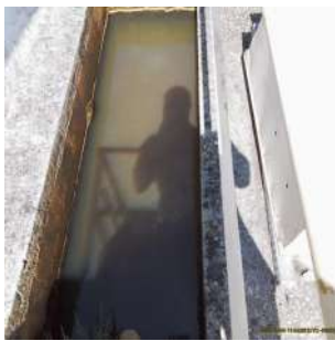
Foto 3 - Vista parcial do floculador
