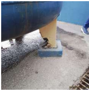
Foto 1 - Corrosão do pé do filtro
