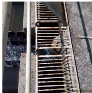
Foto 6 - Saída de água do decantador
