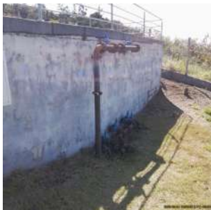
Foto 3 - Válvulas de manobra e tomada de água bruta
