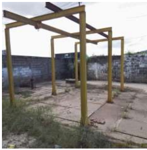
Foto 4 - Monovia para içamento de bombas
