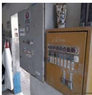
Foto 8 - Painéis de controle
