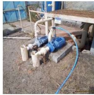
Foto 2 - Conjunto motobomba para adução do reservatório apoiado para o elevado
