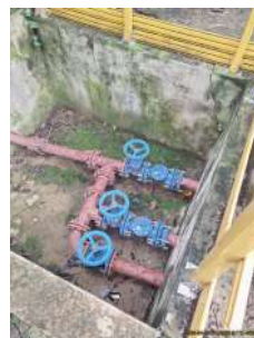
Foto 6 - Linha de recalque
