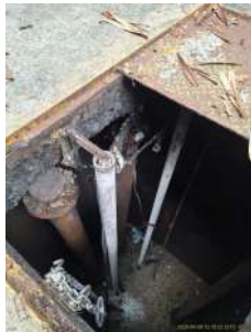
Foto 5 - Poço com bombas instaladas
