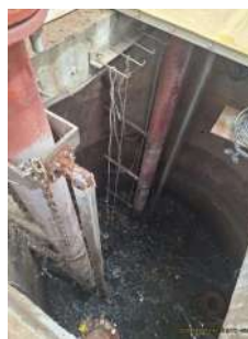
Foto 6 - Dois conjuntos motobombas instalados
