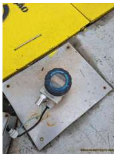
Foto 6 - Conversor (transmissor) do macromedidor
