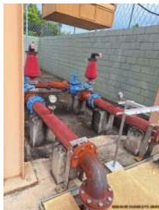
Foto 7 - Linhas de recalque
