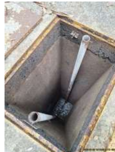
Foto 6 - Cesto de gradeamento
