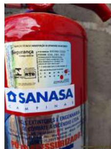
Foto 5 - Extintor de incêndio com validade regular
