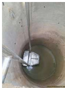
Foto 7 - Cesto de gradeamento
