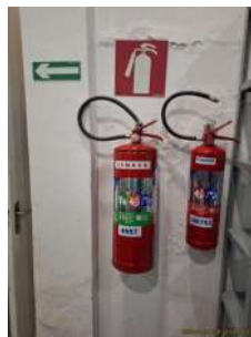
Foto 7 - Extintores de incêndio
