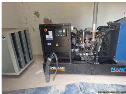
Foto 11 - Gerador de energia
