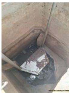
Foto 5 - Cesto de gradeamento
