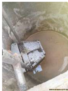
Foto 10 - Cesto de gradeamento
