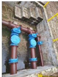
Foto 8 - Linhas de recalque
