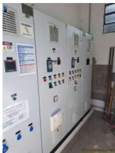
Foto 3 - Painéis de comando dos conjuntos motobomba
