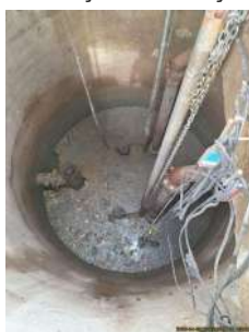
Foto 8 - Poço com bombas submersas
