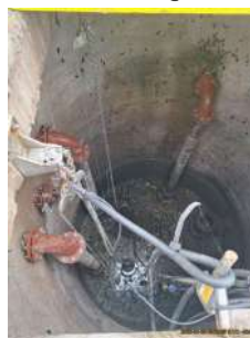
Foto 9 - Poço com bombas submersas
