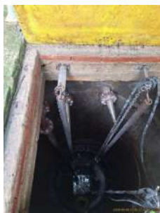
Foto 5 - Conjuntos motobomba instalados
