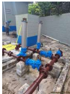
Foto 8 - Linhas de recalque com ventosas
