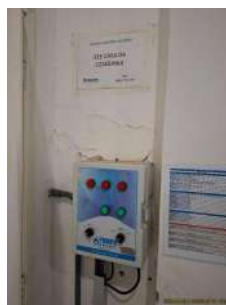
Foto 2 - Painel de controle das bombas e identificação da elevatória
