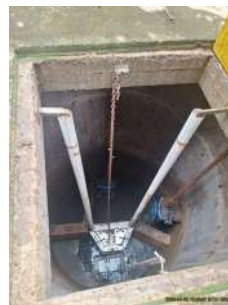
Foto 4 - Cesto de gradeamento
