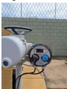
Foto 3 - Válvula de controle elétrico
