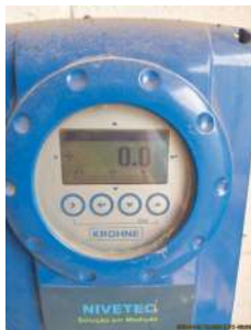
Foto 11 - Conversor do macromedidor
