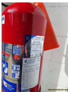
Foto 4 - Extintor - validade regular
