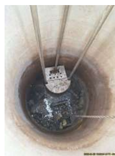
Foto 7 - Cesto de gradeamento
