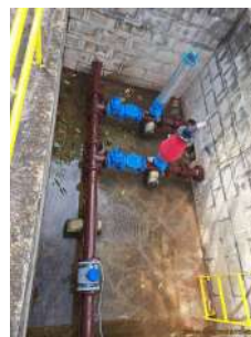
Foto 3 - Linhas de recalque
