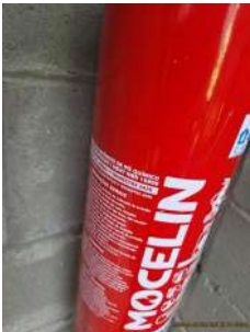
Foto 2 - Extintor de incêndio com validade regular
