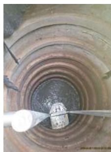
Foto 6 - Cesto de gradeamento
