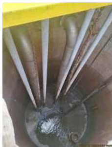
Foto 7 - Dois conjuntos motobomba instalados
