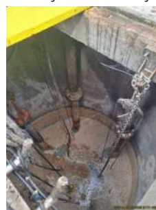
Foto 5 - Poço com duas bombas submersas instaladas
