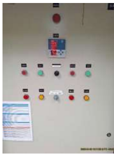
Foto 3 - Painel de acionamento das bombas
