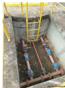
Foto 3 - Linha de recalque
