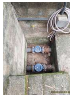
Foto 4 - Linha de recalque
