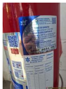
Foto 2 - Extintor de incêndio com validade regular
