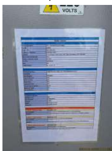
Foto 6 - Informações - Estação elevatória
