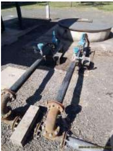
Foto 2 - Tubulação da EEE.
