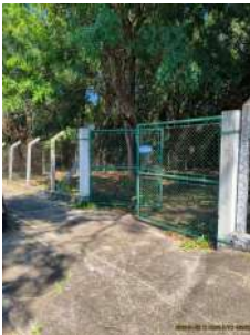
Foto 1 - Vista da EEE.
