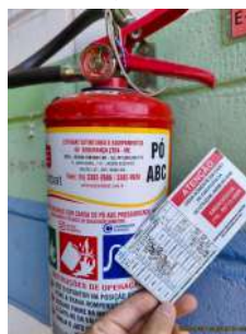
Foto 8 - Extintor de incêndio.
