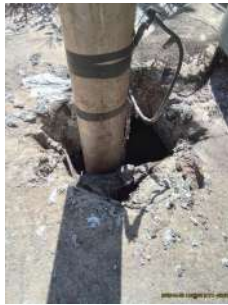
Foto 1 - Abertura junto à tubulação.
