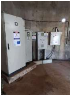
Foto 3 - Painéis elétricos da EAT.
