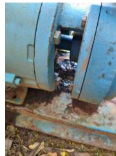
Foto 2 - Detalhe do vazamento.
