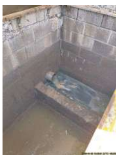
Foto 1 - Chegada do esgoto bruto sem gradeamento.
