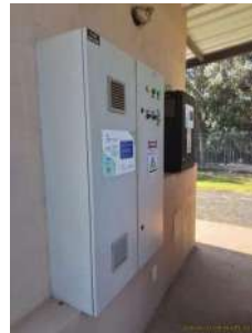
Foto 6 - Pannel elétrico da EEE.
