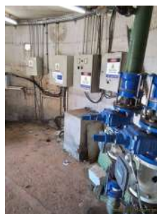
Foto 5 - Vista dos painéis elétricos e tubulação de recalque.
