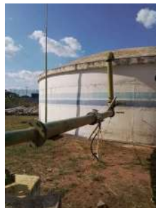
Foto 4 - Alimentação do reservatório (direto do poço Cardim).
