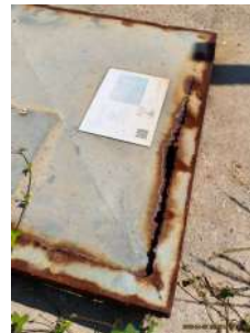
Foto 2 - Detalhe da corrosão.
