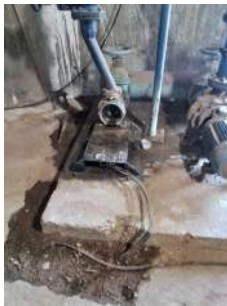
Foto 1 - Ausência da bomba reserva.
