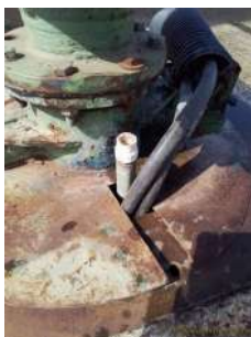
Foto 3 - Tubo de medição de nível.
