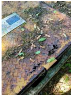
Foto 3 - Detalhe da tampa deteriorada.
