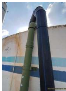
Foto 6 - A tubulação azul é a que abastece o reservatório apoiado com água bruta do Poço Santa Cruz.
