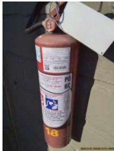
Foto 7 - Extintor junto ao local.
