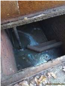
Foto 3 - Chegada do esgoto.
