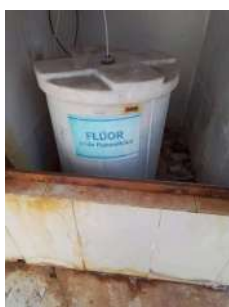
Foto 7 - Tanque de flúor.
