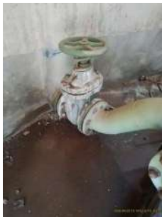
Foto 3 - Detalhe do vazamento junto ao registro.
