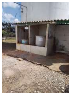
Foto 6 - Estocagem dos produtos químicos. A aplicação é feita junta do reservatório apoiado.
