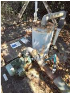
Foto 2 - Parte interna da EEE.
