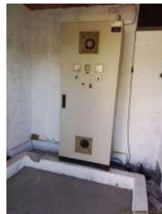
Foto 11 - Painel elétrico junto ao poço.
