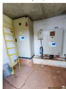
Foto 10 - Painéis elétricos no abrigo.
