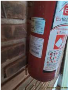
Foto 2 - Extintor e validade regular.
