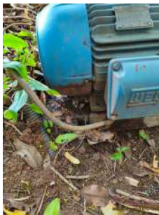
Foto 1 - Vazamento identificado junto ao motor.
