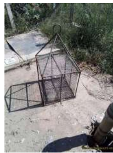
Foto 4 - Gradeamento da EEE não sendo utilizado. De acordo com o prestador, o material do atual gradeamento não resiste adequadamente à corrosividade do esgoto e será substituído por um gradeamento de outro material.
