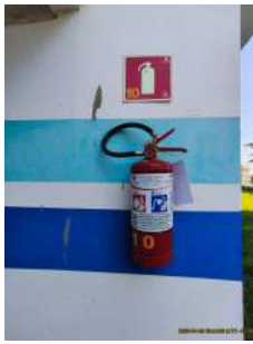
Foto 11 - Extintor do local.
