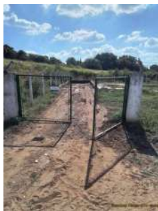
Foto 1 - Cercamento do local sem qualquer identificação.
