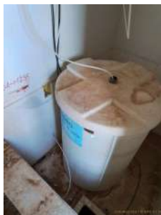
Foto 9 - Tanque de cloro.
