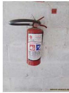
Foto 9 - Extintor junto ao painel elétrico.
