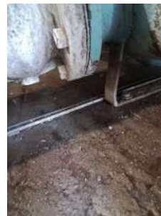
Foto 2 - Detalhe 2 do vazamento.
