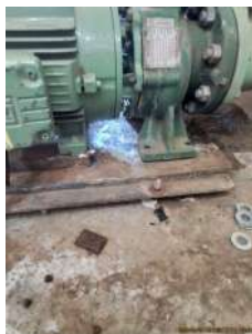
Foto 1 - Detalhe 1 do vazamento junto à bomba.
