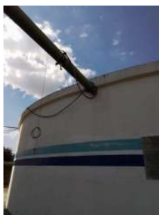
Foto 3 - Alimentação do reservatório (poço Jardim Brasil).
