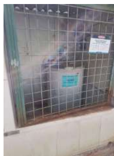
Foto 2 - Tanque de flúor.
