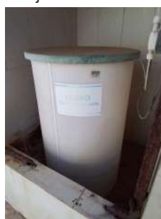
Foto 8 - Tanque de cloro.
