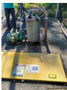
Foto 5 - Tampa de inspeção da EEE.
