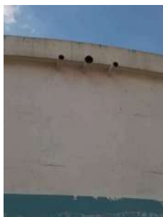
Foto 1 - Detalhe da tubulação sem tela de proteção.
