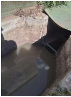
Foto 8 - Gradeamento DA EEE.
