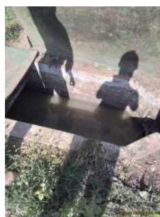
Foto 7 - Caixa de areia e calha parshall.
