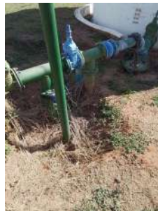
Foto 3 - Booster enterrado próximo à EAT.
