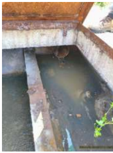
Foto 1 - Chegada do esgoto sem gradeamento.
