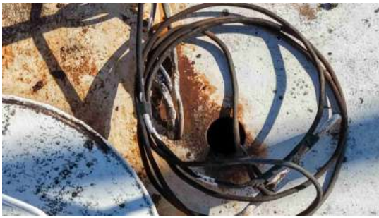
Foto 1 - Detalhe da deterioração próxima à tampa de inspeção.
