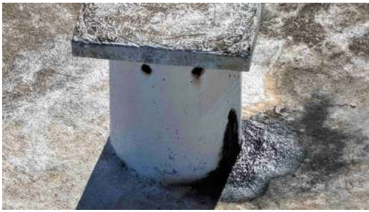
Foto 5 - Vazamento 5 - identificado junto à ventilação no topo do reservatório.
