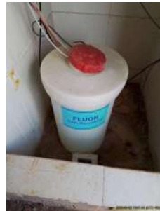
Foto 8 - Tanque de flúor.
