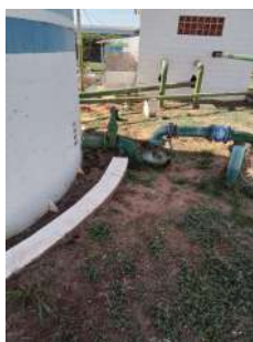
Foto 5 - Booster enterrado próximo ao reservatório.
