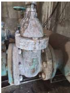
Foto 1 - Detalhe 1 do vazamento.
