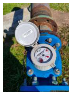
Foto 6 - Macromedidor do poço.
