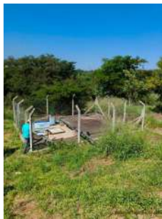
Foto 1 - Vista da EEE.
