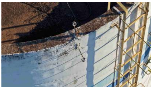
Foto 2 - Detalhe do condutor de descida rompido.
