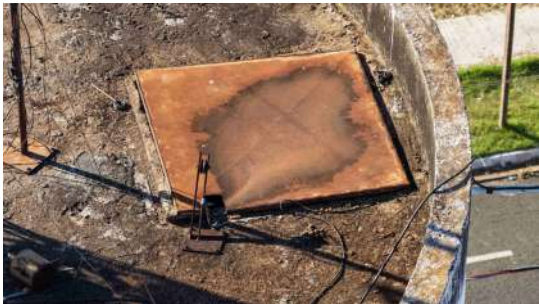
Foto 1 - Detalhe da tampa de inspeção oxidada.
