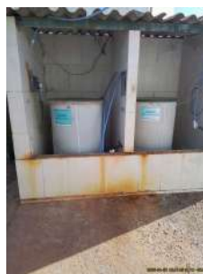
Foto 2 - Estocagem dos produtos químicos junto do reservatório.
