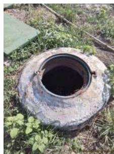
Foto 3 - Abertura próxima à caixa de areia.
