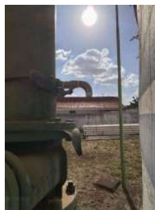
Foto 4 - Tomada para coleta de água bruta.
