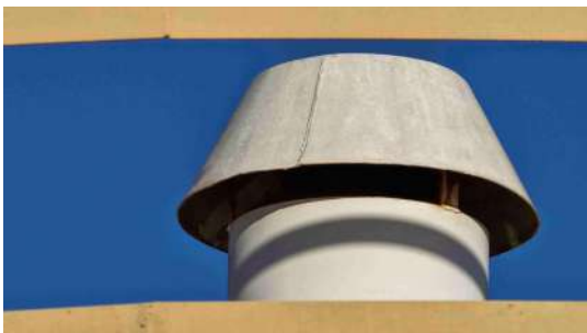
Foto 1 - Detalhe da ventilação no topo do reservatório sem tela de proteção.
