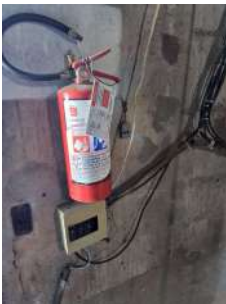
Foto 2 - Extintor com validade regular.
