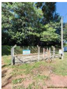
Foto 1 - Vista externa da EEE.
