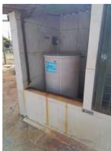
Foto 1 - Tanque de cloro
