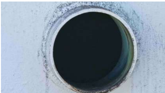
Foto 1 - Tubulação sem tela.
