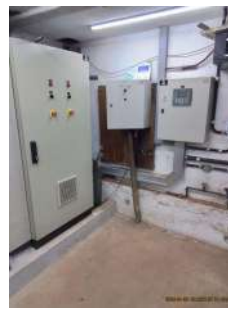
Foto 4 - Paineis elétricos da EEAT.
