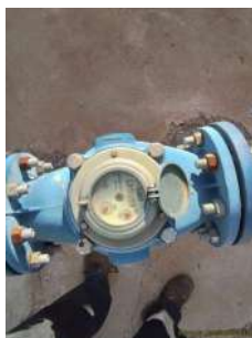
Foto 3 - Macromedidor do poço.
