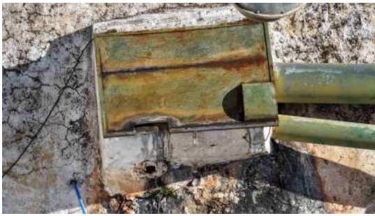
Foto 1 - A tampa de inspeção encontra-se danificada, sendo necessária a sua manutenção.
