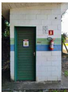
Foto 7 - Abrigo do painel elétrico.
