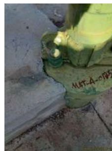
Foto 4 - Tubo de medição de nível.
