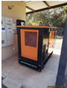
Foto 5 - Gerador da EEE.
