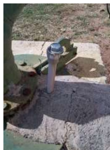
Foto 2 - Tubo de medição de nível.
