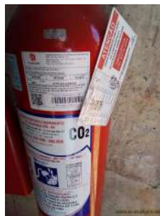
Foto 2 - Extintor com validade regular.
