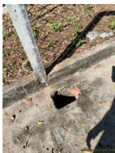
Foto 1 - Abertura próxima ao cercamento.
