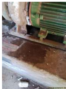
Foto 2 - Detalhe 2 do vazamento junto à bomba.
