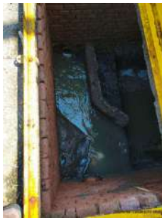
Foto 1 - Chegada do esgoto sem evidência de gradeamento.
