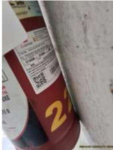
Foto 10 - Validade do extintor.
