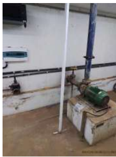
Foto 3 - Bomba da EEAT em funcionamento - a reserva está no almojarifado.
