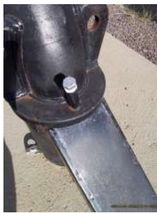
Foto 5 - Tubo de medição de nível.
