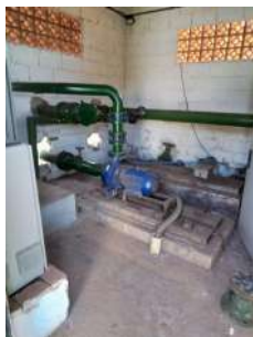
Foto 1 - Bomba da EAT. A reserva é estocada no almoxarifado.
