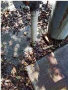
Foto 4 - Tubulações da EEE.
