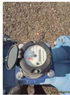
Foto 6 - Macromedidor do poço.
