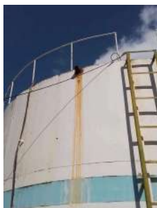
Foto 1 - Tubulação sem tela de proteção.
