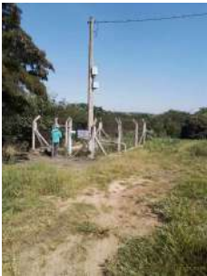
Foto 1 - Vista da EEE.
