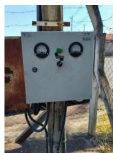
Foto 6 - Pannel elétrico da EEE.
