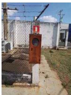
Foto 4 - Extintor do local.
