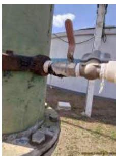
Foto 1 - Vazamento junto da tomada para coleta de água bruta.
