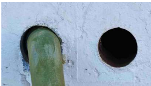
Foto 2 - Detalhe da abertura sem rede.
