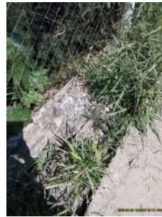
Foto 2 - Acúmulo de resíduos retidos no gradeamento.
