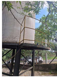
Foto 2 - Detalhe de guarda-corpo
