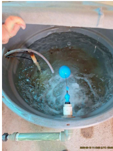
Foto 3 - Reservatório de chegada da água da nascente
