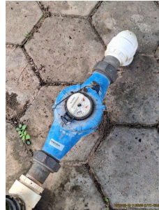
Foto 4 - Macromedidor do reservatório
