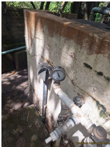
Foto 4 - Manômetro e ponto de tomada de água
