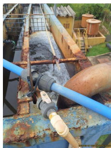
Foto 1 - Chegada de água bruta e pré-cloração com hipoclorito de sódio
