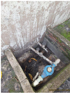
Foto 2 - Macromedidor do reservatório
