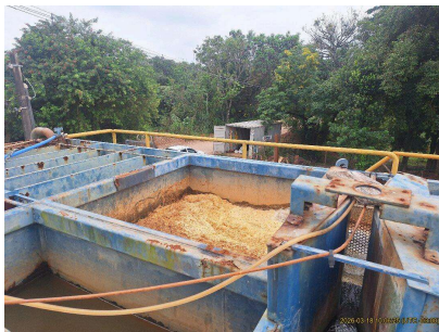
Foto 7 - Câmara de floculação sem agitador
