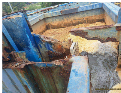
Foto 4 - Dosagem de PAC (coagulante) na mistura rápida e detalhe de estrutura degradada
