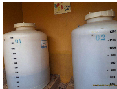
Foto 23 - Armazenamento - hipoclorito de sódio
