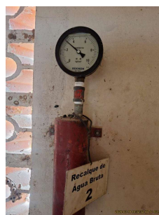
Foto 2 - Medidor de pressão do recalque
