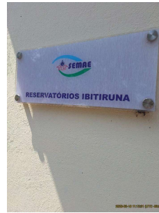
Foto 2 - Identificação do reservatório
