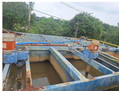
Foto 4 - 4 - Vigas que suportam misturadores com degradação severa
