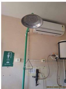
Foto 18 - Chuveiro de emergência com funcionamento regular
