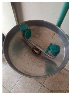
Foto 19 - Lavador de olhos com funcionamento regular
