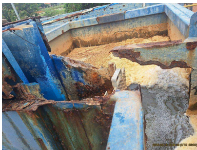
Foto 3 - 3 - Oxidação generalizada e corrosão profunda da interface de ar e água entre o ponto de mistura do coagulante e a câmara de floculação.
