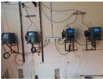
Foto 22 - Bombas de hipoclorito
