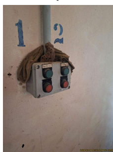
Foto 3 - Botões de acionamento de bombas
