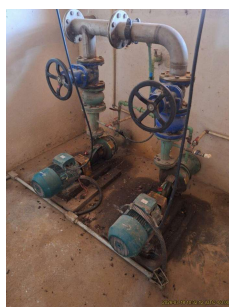
Foto 1 - Dois conjuntos motobomba
