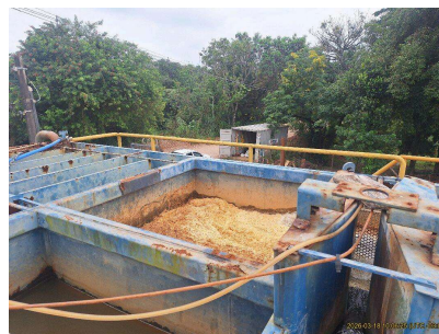
Foto 2 - 2- Uma das câmaras de floculação sem misturador (em manutenção)
