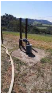
Foto 2 - Cavalete do poço.
