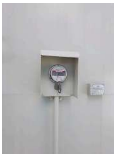
Foto 1 - Monitoramento de nível do reservatório.
