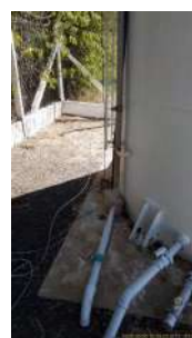
Foto 2 - Dosagem na tubulação de alimentação do reservatório.
