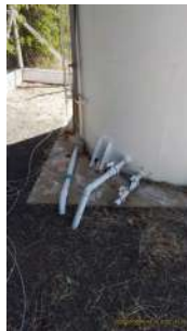
Foto 3 - Tubulações de alimentação, saída e mangueiras para dosagem de cloro e flúor.
