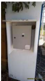
Foto 7 - Painel de comando da bomba do poço.
