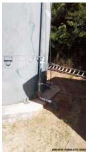
Foto 3 - Tubulação de alimentação do reservatório e mangueiras para dosagem de cloro e flúor.
