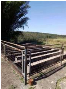
Foto 1 - Chicana na saída da ETE.
