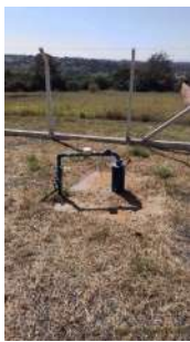
Foto 3 - Cavalete do poço.
