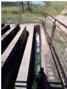
Foto 3 - Chicana na saída da ETE.
