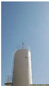
Foto 3 - Para-raios na cobertura
