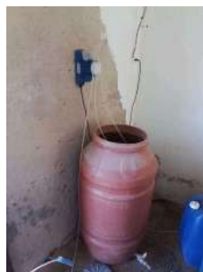
Foto 7 - Hipoclorito dosado na saída.
