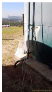
Foto 2 - Dosagem de cloro e flúor na tubulação de alimentação do reservatório.
