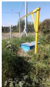
Foto 3 - A área necessita de capina regular.
