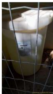
Foto 5 - armazenamento de hipoclorito de sódio.
