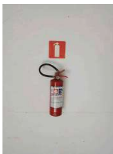
Foto 5 - Extintor instalado junto ao abrigo de hipoclorito.
