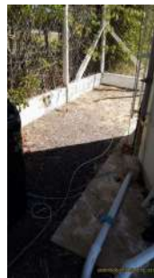
Foto 6 - Aplicação e dosagem de cloro e flúor na entrada do reservatório.
