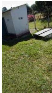
Foto 2 - O vazamento era proveniente do abrigo do macromedidor. Nesta fiscalização verificou-se que o local estava seco, sem vazamento.
