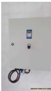
Foto 3 - PAINEL DA BOMBA.
