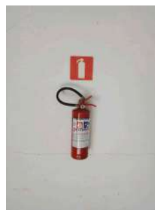
Foto 2 - Extintor instalado no abrigo do hipoclorito e bomba dosadora.
