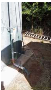
Foto 1 - Mangueiras para aplicação de cloro e flúor.
