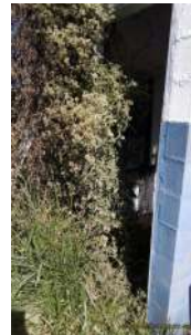
Foto 2 - Mato prejudicando o acesso ao abrigo do painel das bombas.
