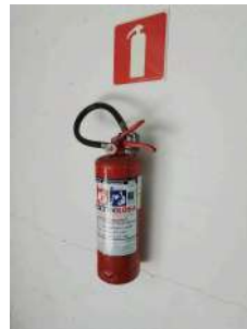
Foto 4 - Extintor instalado junto ao abrigo de hipoclorito.
