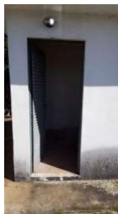
Foto 4 - ABRIGO DO PAINEL DA BOMBA.
