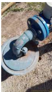
Foto 1 - Tubo de medição de nível
