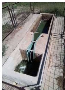
Foto 6 - Calha parshall na saída.
