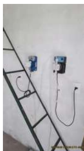
Foto 3 - Bombas dosadoras de cloro e flúor.
