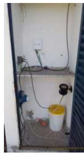
Foto 4 - Abrigo das bombas dosadoras de produtos químicos e da telemetria.
