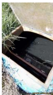
Foto 5 - Poço úmido com cesto peneira. Devido ao furto de equipamentos elétricos, a bomba não estava operando. O prestador está realizando remoção do esgoto com caminhão limpa fossa
