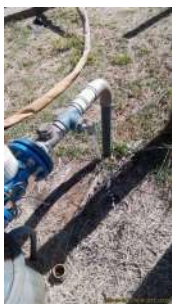
Foto 1 - Tomada de água bruta.
