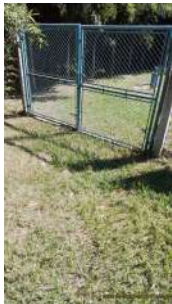
Foto 1 - Em fiscalização anterior (Relatório 274/2025) havia vazamento deixando a área alagada.
