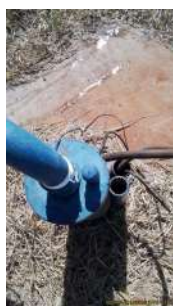
Foto 1 - Tubo de medição de nível
