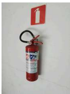
Foto 1 - Extintor instalado no abrigo do hipoclorito e bomba dosadora.
