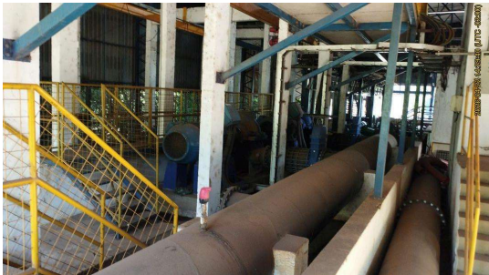
Foto 16 - Adutora da ETA 4, ao fundo os conjuntos moto-bomba do sistema.
