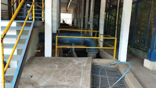
Foto 14 - Canaleta de sucção das bombas.
