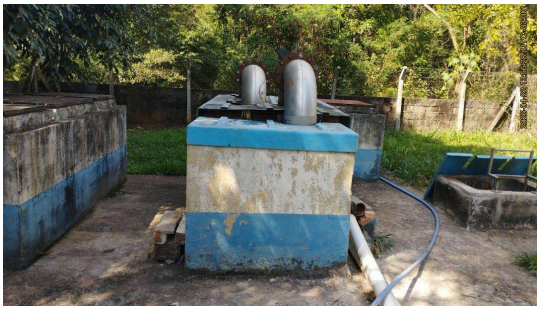
Foto 6 - Poço de sucção das bombas.
