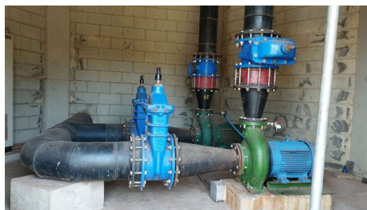
Foto 4 - Vista geral da elevatória.
