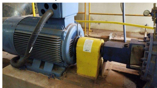
Foto 20 - Detalhe do conjunto moto-bomba das indústrias.
