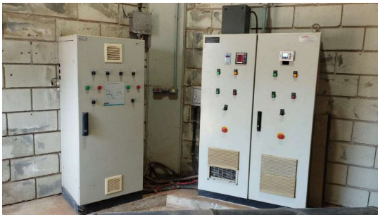
Foto 6 - Painéis elétricos instalados no interior da edificação.
