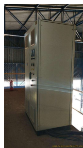
Foto 21 - Painel elétrico instalado no piso superior.
