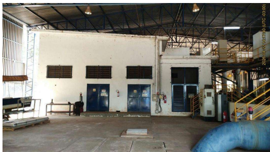
Foto 7 - Vista geral da casa de bombas. Ao fundo, a cabine de alta tensão das bombas da adutora da ETA 2.
