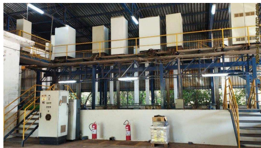
Foto 9 - Área das bombas e painéis elétricos.
