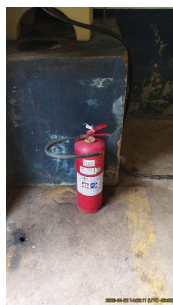
Foto 12 - Extintor de incêndio instalado no interior da edificação que abriga o gerador.
