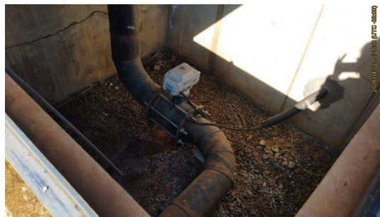
Foto 8 - Atuador responsável pelo abastecimento do reservatório.
