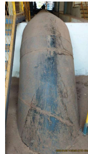
Foto 17 - Adutora da ETA 4.
