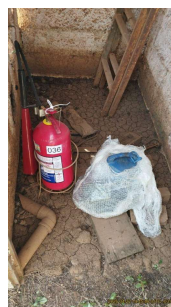
Foto 4 - Conjunto moto-bomba reserva e extintor de incêndio existentes no local no momento da inspeção.
