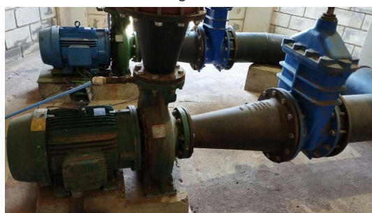
Foto 5 - Há dois conjuntos moto-bomba instalados, um em funcionamento e o segundo como reserva.
