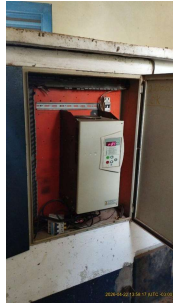
Foto 8 - Painel do inversor de frequência das bombas.
