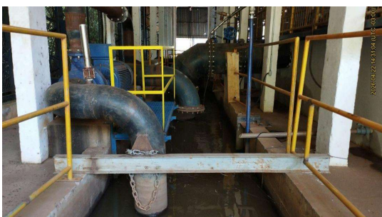
Foto 19 - Canaleta de sucção das bombas. À esquerda da imagem, observa-se um conjunto moto-bomba que, segundo informado pelo prestador, não pertence ao DAE. De acordo com
