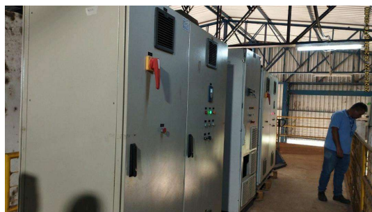
Foto 25 - Painéis elétricos instalados no piso superior.
