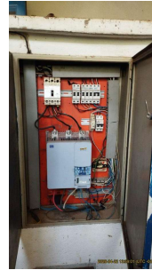
Foto 9 - Painel do equipamento soft starter das bombas.
