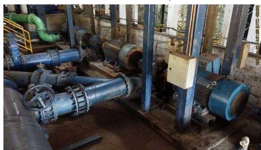
Foto 11 - Conjuntos moto-bomba. Dois conjuntos pertencem ao sistema de adução da ETA 2, o terceiro conjunto é reserva do sistema de adução da ETA 4.
