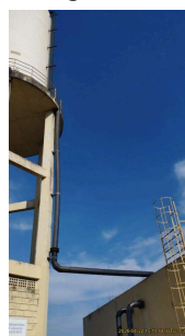
Foto 5 - Tubo extravasor. Em caso de extravasamento, a água é conduzida para o reservatório apoiado.
