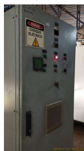
Foto 23 - Painel elétrico instalado no piso superior.
