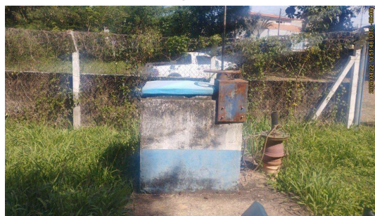
Foto 5 - Comportada de entrada de esgoto bruto na elevatória.
