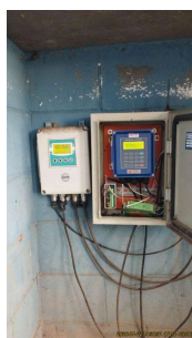
Foto 28 - Macromedidor de vazão do sistema de adução da ETA 2.
