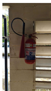
Foto 8 - Extintor de incêndio instalado no interior da edificação.
