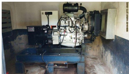
Foto 11 - Gerador de energia elétrica da elevatória.
