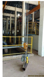
Foto 18 - Equipamento para manuseio dos conjuntos moto-bomba.
