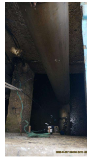
Foto 7 - Vista interna do poço de sucção das bombas. Há dois conjuntos moto-bomba instalados, um em funcionamento e o segundo como reserva.
