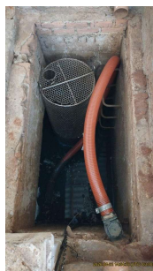
Foto 1 - Detalhe do cesto instalado no interior do poço de sucção da bomba.
