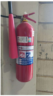
Foto 7 - Extintor de incêndio instalado no interior da edificação.
