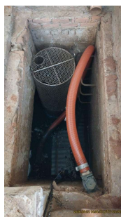
Foto 4 - Ponto de chegada do esgoto na elevatória, também é o poço de sucção da bomba.
