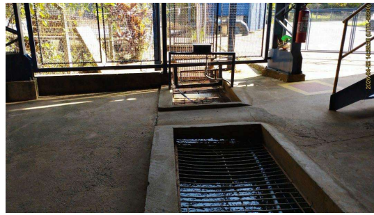
Foto 13 - Chegada da água bruta na canaleta de sucção das bombas.
