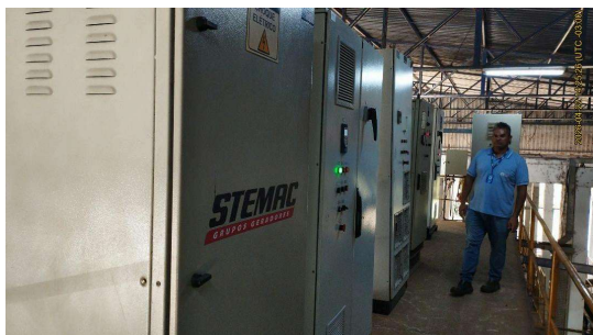
Foto 22 - Painéis elétricos instalados no piso superior.
