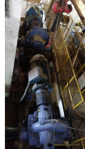
Foto 15 - Conjuntos moto-bomba do sistema de adução da ETA 4.
