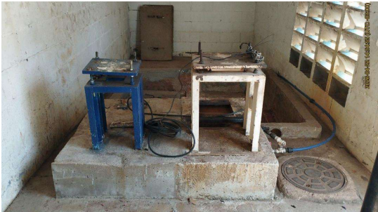
Foto 3 - Vista geral da elevatória.
