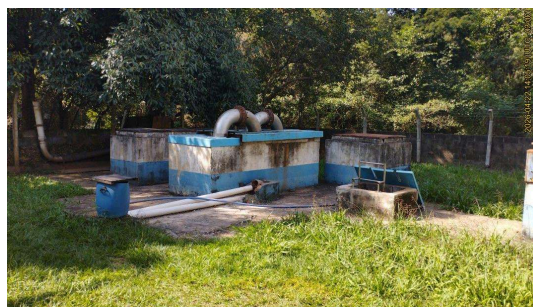
Foto 4 - Vista geral da elevatória.
