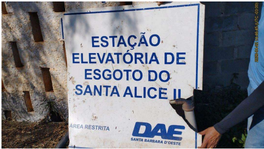
Foto 1 - Placa de identificação que se encontrava caída sobre o poço de sucção.
