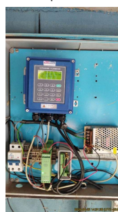
Foto 27 - Detalhe do macromedidor de vazão do sistema de adução da ETA 4.
