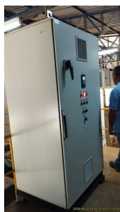
Foto 24 - Painel elétrico instalado no piso superior.
