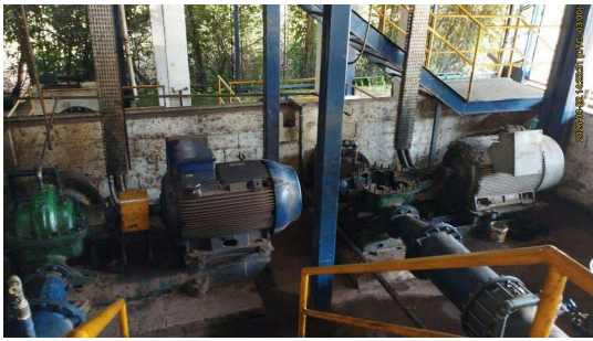
Foto 12 - Conjuntos moto-bomba reserva do sistema de adução da ETA 2.
