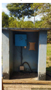
Foto 26 - Abrigo do macromedidor de vazão do sistema de adução da ETA 4.
