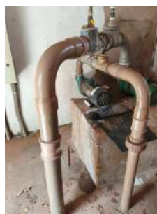
Foto 10 - Vista do conjunto motobomba, evidenciando tubulações de sucção e recalque, conexões e estado de conservação.
