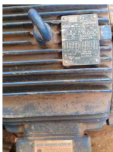
Foto 6 - Detalhe da placa de identificação do conjunto motobomba 1, contendo especificações técnicas do equipamento.
