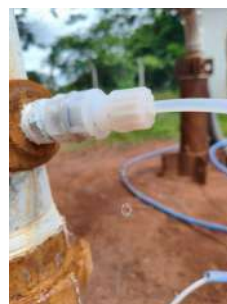
Foto 2 - Vazamento em conexão da tubulação de dosagem.
