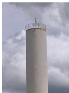
Foto 11 - Vista da parte superior do reservatório elevado com detalhe ao posicionamento da haste do Sistema de Proteção contra Descargas Atmosféricas (SPDA)
