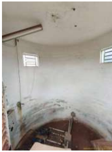
Foto 1 - Estação Elevatória sem dispositivo de içamento para manutenção.
