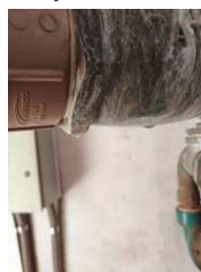
Foto 4 - Detalhe de conexão hidráulica com sinais de vazamento.
