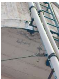
Foto 1 - Parede do reservatório com sinais de vazamento.
