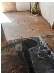
Foto 3 - Área da base do conjunto motobomba com acúmulo de água, indicando vazamento no sistema.
