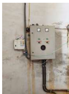
Foto 9 - Em detalhe o painel de comando do sistema de bombeamento, responsável pelo acionamento e proteção das motobombas.
