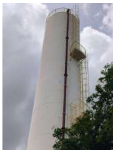
Foto 1 - Evidência da falta de identificação da área.
