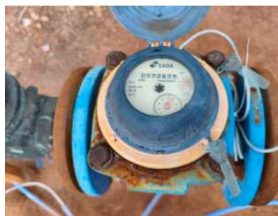
Foto 4 - Vista do macromedidor de vazão.
