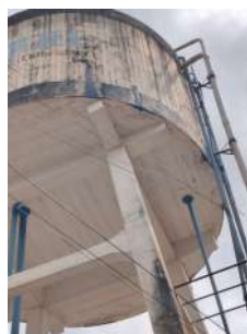
Foto 2 - Infiltração visível na parede do reservatório.
