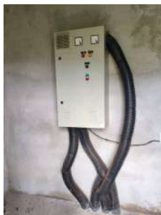
Foto 12 - Detalhe do painel de controle do poço.
