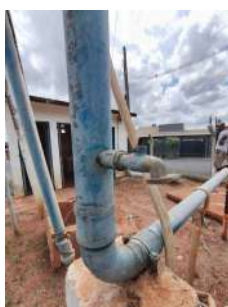
Foto 1 - Detalhe do registro do ponto de coleta sem válvula de acionamento.
