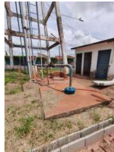
Foto 2 - Vista geral do poço, com destaque para a condição da laje de proteção e do reservatório adjacente.
