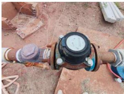
Foto 3 - Detalhe do macromedidor de vazão.
