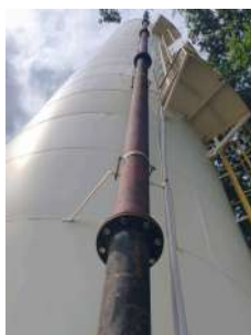
Foto 5 - Em detalhe a fita condutora do Sistema de Proteção contra Descargas Atmosféricas (SPDA).
