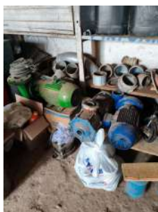
Foto 10 - Bombas reservas no almoxarifado do prestador.
