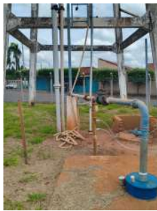
Foto 1 - Início da escada a altura superior a 2,0 metros do solo.
