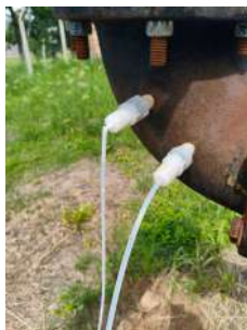
Foto 1 - Mangueira do dosador de flúor danificada.
