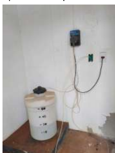
Foto 10 - Vista do local de armazenamento e de dosagem de Flúor.
