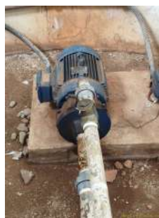
Foto 5 - Vista geral do conjunto motobomba 1, evidenciando o estado de conservação, conexões hidráulicas e base de instalação.
