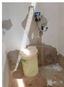
Foto 9 - Vista do local de armazenamento e de dosagem de Cloro.
