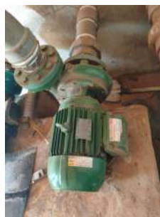
Foto 6 - Vista geral do conjunto motobomba 2, evidenciando o estado de conservação, conexões hidráulicas e base de instalação.
