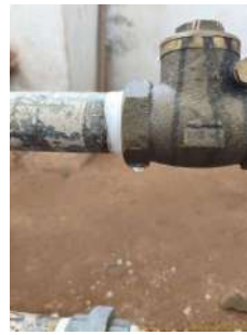
Foto 2 - Detalhe de conexão hidráulica com sinais de vazamento.
