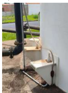
Foto 4 - Ditalhe do aterramento da fita condutora do Sistema de Proteção contra Descargas Atmosféricas (SPDA).
