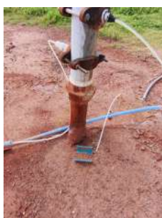
Foto 1 - Detalhe das áreas com oxidação localizada.
