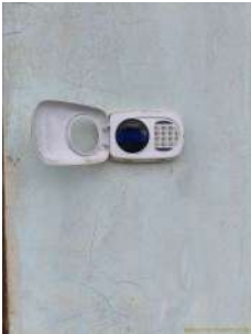
Foto 2 - Detalhe do alarme anti-furto da estação elevatória de água.
