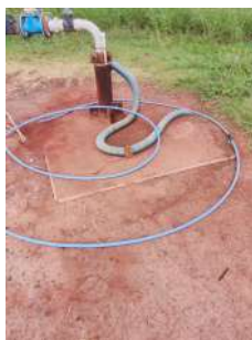
Foto 1 - Área do poço sem laje de proteção.
