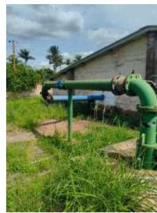
Foto 2 - Tubulação de entrada sem derivação para coleta de amostras.
