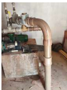
Foto 9 - Vista complementar do conjunto motobomba, com destaque para o arranjo hidráulico e interligações do sistema.
