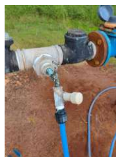
Foto 2 - Ponto localizado de oxidação no cavalete do poço.
