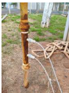
Foto 5 - Detalhe do ponto de dosagem de cloro e flúor.
