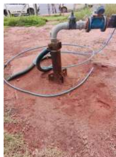
Foto 2 - Vista lateral da estrutura do poço, evidenciando a ausência de laje de proteção.
