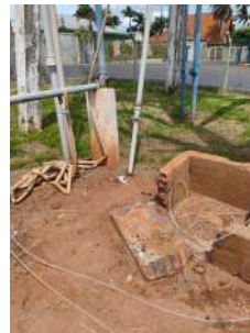
Foto 2 - Presença de entulhos e materiais dispostos no entorno da unidade.
