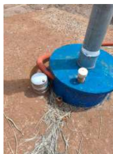
Foto 2 - Vista geral do tubo de medição de nível.
