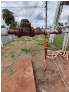
Foto 1 - Encanamento do cavalete do poço com sinais de corrosão.
