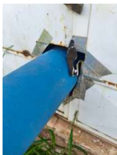
Foto 1 - Detalhe de tela rompida permitindo acesso de vetores.
