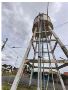
Foto 4 - Detalhe do tubo extravasor interligando o reservatório elevado P3 ao reservatório semienterrado com capacidade de 1.500.000 L.
