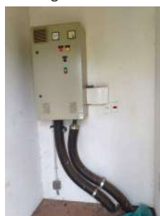
Foto 11 - Em detalhe o painel elétrico de comando do poço.
