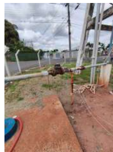
Foto 4 - Vista do macromedidor de vazão.
