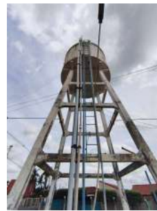
Foto 2 - Evidência de escada de acesso a parte superior do reservatório sem guarda-corpo.
