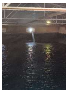
Foto 6 - Detalhe da tubulação de entrada com água proveniente de poço, responsável pelo abastecimento de reservatório semienterrado com capacidade de 1.500.000 L.
