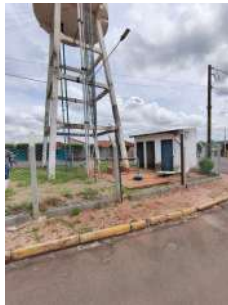
Foto 1 - Vista geral da localização do poço e condição do cercamento da área sem portão metálico para o controle de acesso.
