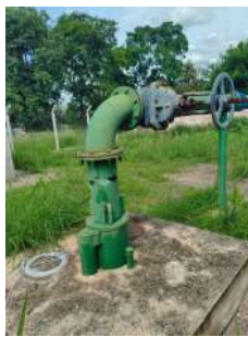
Foto 1 - Ponto de captação sem dispositivo para coleta de água bruta.
