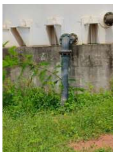
Foto 10 - Detalhe do tubo extravasor do reservatório.
