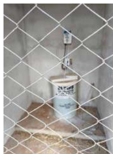
Foto 4 - Evidência da necessidade de limpeza imediata da bombas dosadoras e da casa de armazenamento/dosagem de cloro e flúor.
