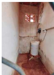
Foto 8 - Vista do local de armazenamento e de dosagem de Flúor.
