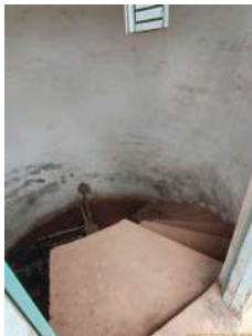
Foto 1 - evidência de Escada de acesso interno sem corrimão.
