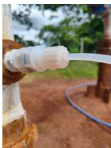
Foto 1 - Detalhe de vazamento em conexão da tubulação de dosagem de cloro e flúor.
