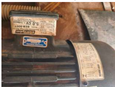
Foto 5 - Detalhe da placa de identificação do conjunto motobomba 1, contendo especificações técnicas do equipamento.
