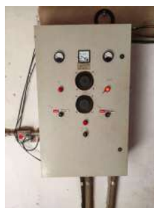
Foto 8 - Em detalhe o painel de comando do sistema de bombeamento, responsável pelo acionamento e proteção das motobombas.
