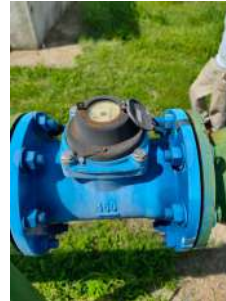
Foto 2 - Detalhe do macromedidor de vazão.
