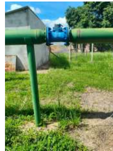
Foto 3 - Detalhe do macromedidor evidenciando a posição elevada do visor de leitura.
