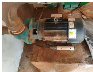
Foto 4 - Vista geral do conjunto motobomba 1, evidenciando o estado de conservação, conexões hidráulicas e base de instalação.
