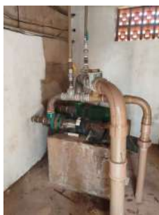
Foto 3 - Conjunto de motobombas instalado em paralelo, operando de forma alternada para garantir continuidade operacional e segurança do sistema.
