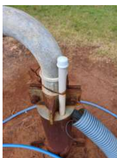
Foto 6 - Detalhe da tubulação para medição de nível do lençol freático.
