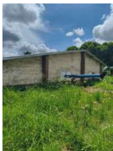
Foto 10 - Presença de vegetação alta no entorno da unidade fiscalizada, evidenciando a necessidade de roçada, conforme apontamento registrado na Ficha de Fiscalização nº 14.220.
