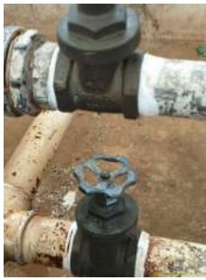
Foto 1 - Vista do conjunto motobomba com indícios de vazamento nas conexões hidráulicas.
