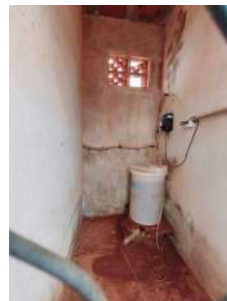
Foto 4 - Abrigo de armazenamento e dosagem de cloro e flúor em condições inadequadas de limpeza.
