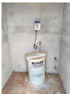
Foto 3 - Fragmentos de mangueira rompida próximos aos containers de armazenamento de flúor.
