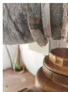
Foto 2 - Detalhe de conexão com evidência de vazamento (presença de umidade e incrustações).
