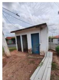
Foto 6 - Abrigo de armazenamento e dosagem de produtos químicos.
