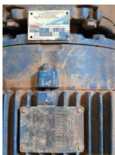
Foto 8 - Detalhe da placa de identificação do conjunto motobomba 2, contendo especificações técnicas do equipamento.
