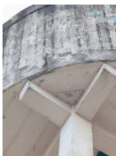
Foto 3 - Detalhe de ponto com vazamento na estrutura.
