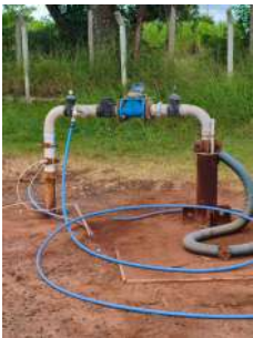
Foto 2 - Detalhe do poço sem laje de proteção.
