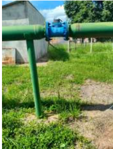
Foto 1 - Vista geral do macromedidor instalado em altura elevada, dificultando a visualização direta da leitura.
