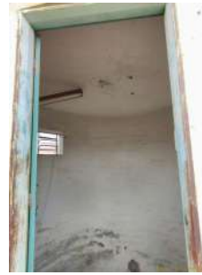
Foto 2 - Evidência da ausência de ponte rolante e talha na área de equipamentos
