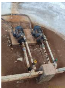
Foto 4 - Detalhe do conjunto de motobombas instalado em paralelo, operando de forma alternada
