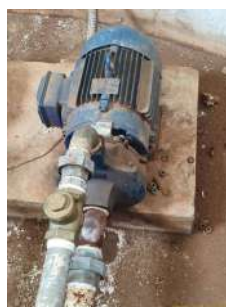
Foto 7 - Vista geral do conjunto motobomba 2, evidenciando o estado de conservação, conexões hidráulicas e base de instalação.
