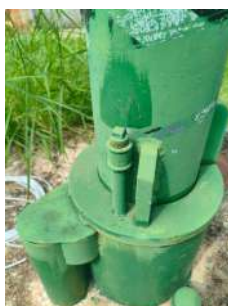
Foto 6 - Em detalhe a tubulação para monitoramento do nível do lençol freático.
