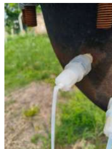
Foto 2 - Detalhe da mangueira rompida, impedindo a dosagem.
