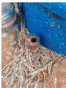
Foto 1 - Detalhe do Tubo de medição de nível sem tampa de proteção.
