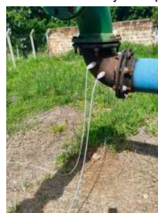
Foto 7 - Detalhe do ponto de dosagem de cloro e flúor
