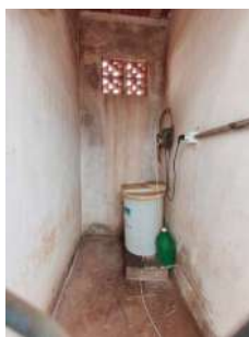
Foto 7 - Vista do local de armazenamento e de dosagem de cloro.
