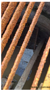
Foto 4 - Gradeamento de esgoto bruto.
