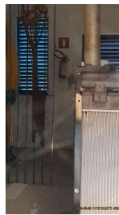
Foto 5 - Extinto de incêndio e gerador.
