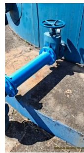
Foto 4 - Tubulação de distribuição de água.
