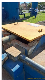
Foto 1 - Estrutura danificada próxima à tubulação de entrada de água, apresentando abertura que permite a possível entrada de contaminantes no sistema.
