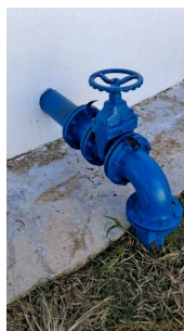
Foto 6 - Tubulação de distribuição de água.
