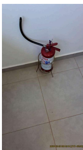
Foto 5 - Extintor de incêndio.
