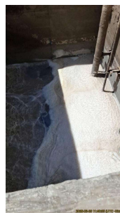
Foto 10 - Ponto de entrada do esgoto nos tanques de tratamento.
