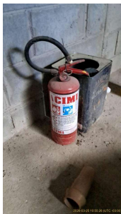
Foto 8 - Extintor de incendio.
