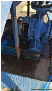
Foto 1 - Extravasamento de água em um dos conjuntos motobomba, com acúmulo no entorno da bomba.
