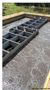
Foto 15 - Vista geral das câmaras de tratamento, onde ocorre a remoção de sólidos e a estabilização do efluente.
