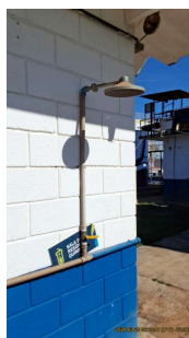
Foto 14 - Chuveiro de emergência.
