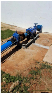
Foto 2 - Moto bomba para recalque da água.
