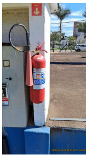
Foto 5 - Extintor de incêndio.
