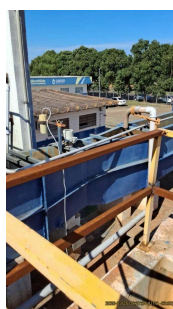
Foto 20 - Calha Parshall e macromedidor.
