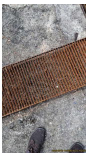
Foto 1 - Grade de proteção do poço, retirada devido à sua fragilidade estrutural.
