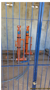
Foto 5 - Área de apoio destinada à realização dos processos de cloração e fluoretação do sistema.
