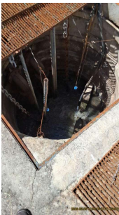
Foto 1 - Poço de sucção contendo conjunto de motobombas submersas destinadas ao recalque do esgoto, operando em regime de alternância, com uma bomba em funcionamento e outra em reserva.
