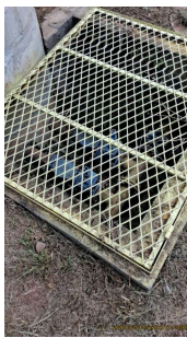
Foto 6 - Conjunto de registros e válvulas.
