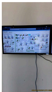
Foto 18 - Tela de monitoramento com exibição das informações de volume dos reservatórios e da vazão de entrada na ETA.
