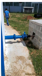
Foto 3 - Tubulação de entrada de água.
