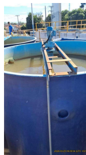
Foto 25 - Unidade de filtração em fibra.
