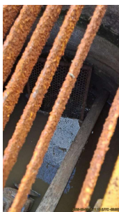
Foto 1 - Abertura lateral à grade permitindo o escoamento do esgoto sem passagem pelo sistema de gradeamento.
