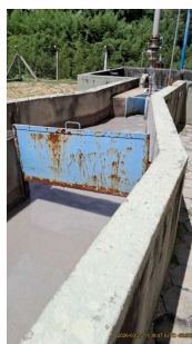
Foto 8 - Canal de passagem de esgoto com presença de comporta, utilizado para controle e condução do fluxo de efluente ao longo da unidade.
