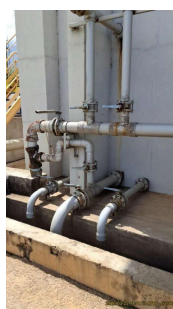
Foto 11 - Ponto de descarga de lodo com válvulas de controle, utilizado para o esgotamento do lodo acumulado na unidade.
