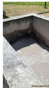
Foto 7 - Ponto de entrada do esgoto bruto.
