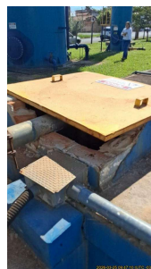
Foto 2 - Tubulação de entrada de água.
