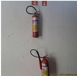
Foto 9 - Extintores de incêndio
