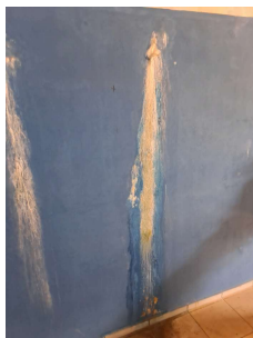
Foto 13 - Vista 13 - Vazamento na parede do decantador 1
