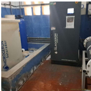
Foto 20 - Gerador de hipoclorito de sódio
