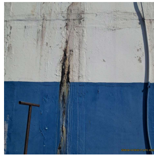
Foto 4 - Vista 4 - Vazamentos na parede do reservatório
