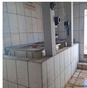
Foto 19 - Armazenamento de Flúor
