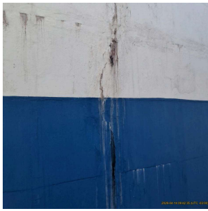
Foto 3 - Vista 3 - Vazamentos na parede do reservatório
