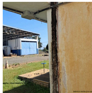
Foto 4 - Vista 4 - Vazamento na junta do decantador 2
