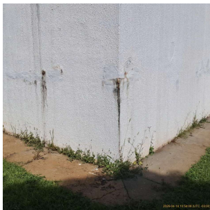
Foto 11 - Vista 11 - Vazamento na parede do filtro 1
