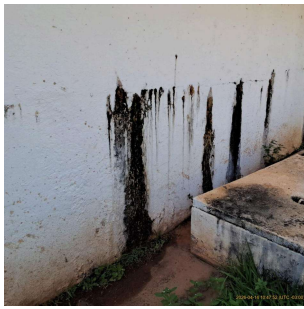
Foto 5 - Vista 5 - Vazamento na parede do decantador 1
