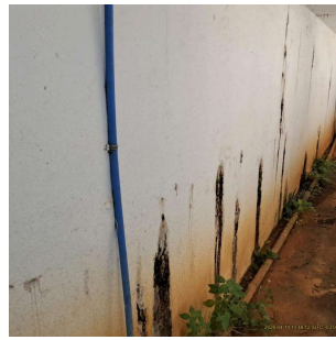
Foto 6 - Vista 6 - Vazamento na parede do decantador 1
