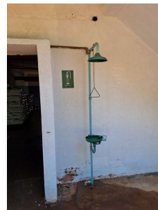
Foto 21 - Chuveiro de emergência
