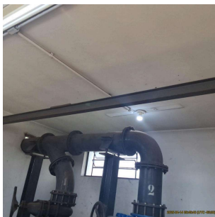
Foto 7 - Talha para içamento de bombas
