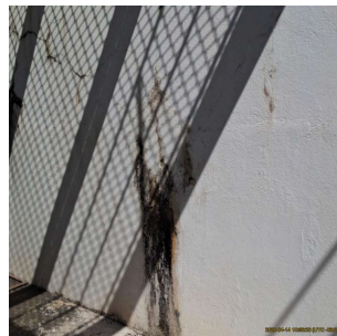
Foto 12 - Vista 12 - Vazamento na parede do filtro 1
