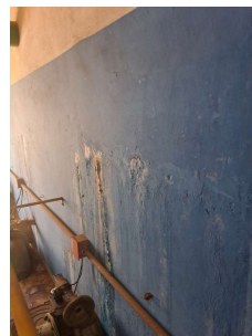
Foto 14 - Vista 14 - Vazamento na parede do filtro 1
