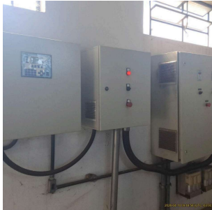
Foto 5 - Painel de comando e controle
