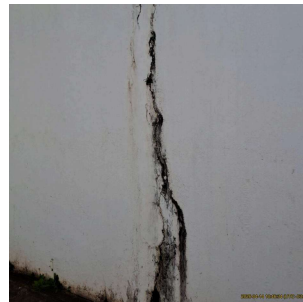
Foto 2 - Vista 2 - Vazamento na parede do decantador 2
