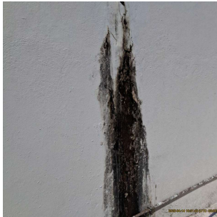
Foto 7 - Vista 7 - Vazamento na parede do decantador 2
