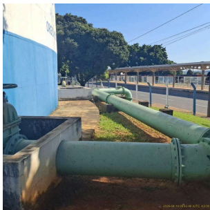
Foto 5 - Tubulação de saída de água
