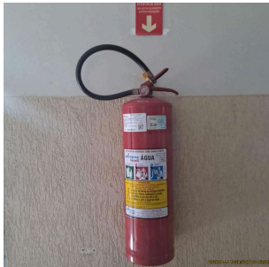
Foto 11 - Extintor de incêndio
