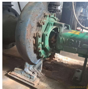
Foto 8 - Drenagem de lubrificacao da gaxeta
