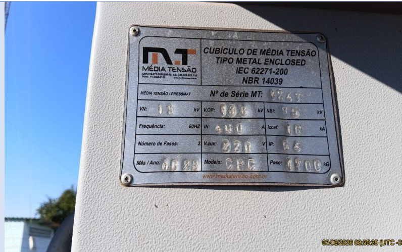
Figura TEC 18. Plaqueta com especificações da instalação.
