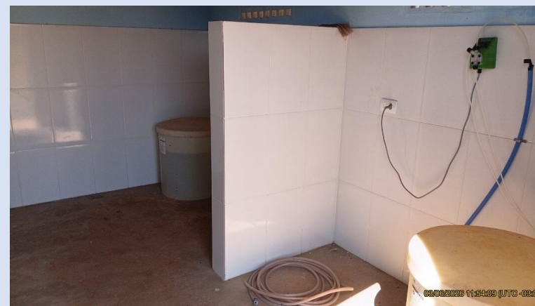
Figura TEC 13. Dosagem de produtos químicos, Poço Monterrey.
