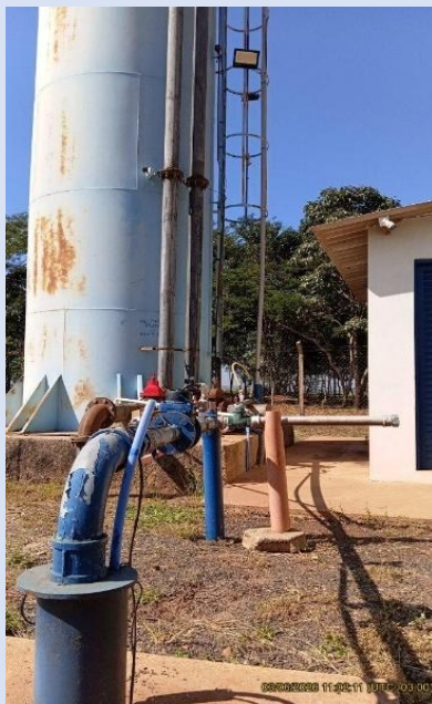
Figura TEC 8. Poço Monterrey interligado ao reservatório da unidade.
