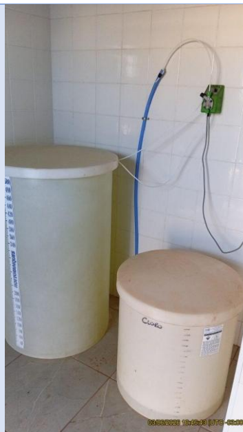
Figura TEC 12. Dosagem de produtos químicos, Poço Jacarandás.
