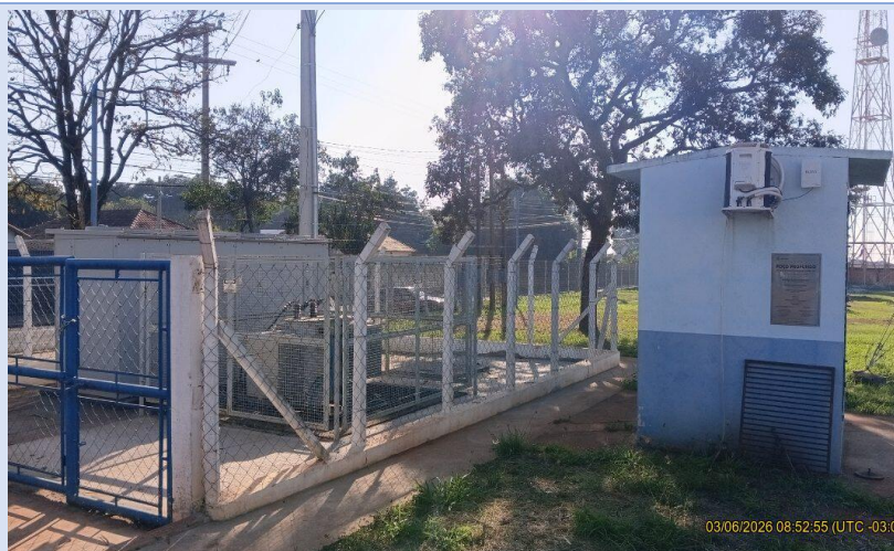
Figura TEC 17. Entrada de energia, Poço da ETA.
