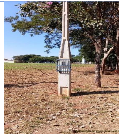
Figura TEC 7. Poste padrão de energia Poço Monterrey.
