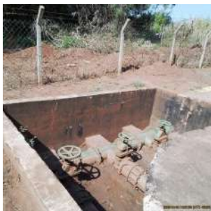
Foto 9 - Barrilete de recalque
