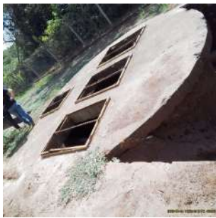
Foto 5 - Vista geral do tanque de equalização
