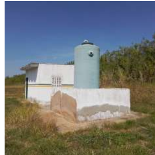
Foto 20 - Tanque de armazenamento de hipoclorito de sódio
