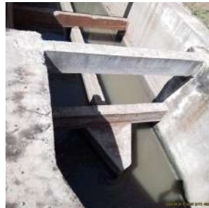
Foto 8 - Caixa de areia
