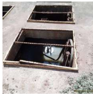
Foto 6 - Vista geral do tanque de equalização
