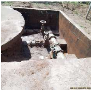
Foto 4 - Barrilete de Recalque
