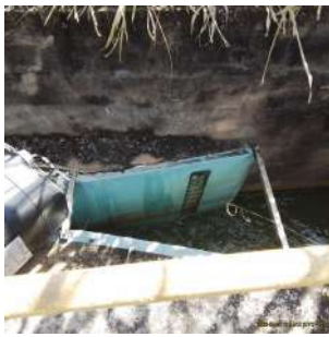
Foto 23 - Calha Parshall para controle de vazão de saída
