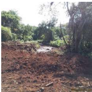
Foto 1 - Vista geral por onde o esgoto era conduzido in natura
