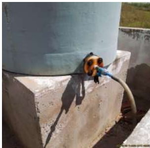
Foto 21 - Tanque de contenção
