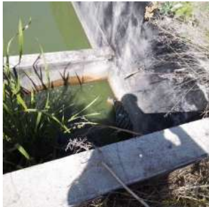
Foto 19 - Local da entrada de esgoto no tanque de contato e dosagem de cloro
