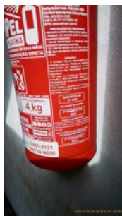
Foto 27 - Extintor existente no local.
