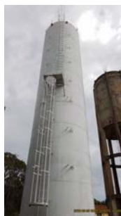
Foto 3 - Escada e guarda corpo do reservatório.
