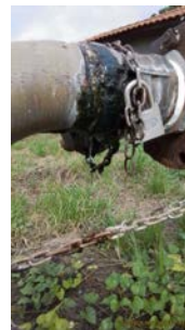
Foto 2 - Vazamento na tubulação do poço.
