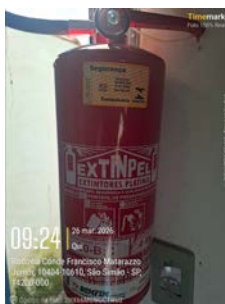
Foto 3 - Extintor presente na unidade. Foto enviada pelo prestador em 26/03/2026.
