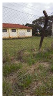
Foto 2 - Mourão de concreto quebrado e colapsando.
