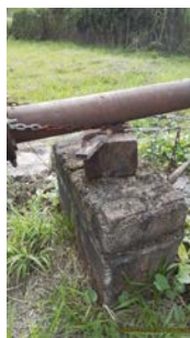
Foto 1 - Apoio e ancoragem precários na tubulação entre o poço e o reservatório.
