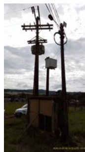
Foto 4 - O abrigo da entrada de energia na unidade apresenta danos nas portas. É necessário realizar o fechamento da parte da porta que está ausente, tratar a corrosão e pintar para proteção.
