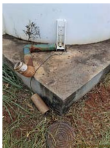
Foto 1 - Aterramento da estrutura.
