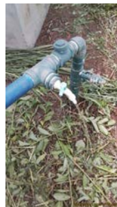
Foto 11 - Torneira para coleta de água bruta.
