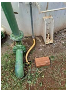
Foto 7 - Condutor para cabos de energia e/ou envio de sinal, na base do reservatório.
