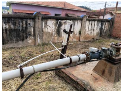
Foto 9 - Equipamento instalado para dosagem de reagentes através de pastilhas cloro/flúor.
