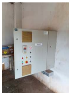
Foto 13 - Painelelétrico da bomba do poço.
