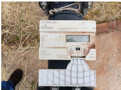
Foto 8 - Macromedidor da captação.
