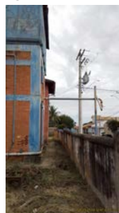
Foto 8 - Tubulação para abastecimento de caminhão pipa.
