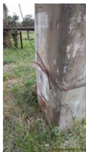
Foto 1 - Conductor do SPDA rompido.
