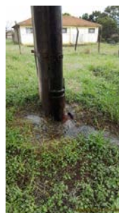
Foto 2 - Vazamento e acúmulo de água na base do reservatório.
