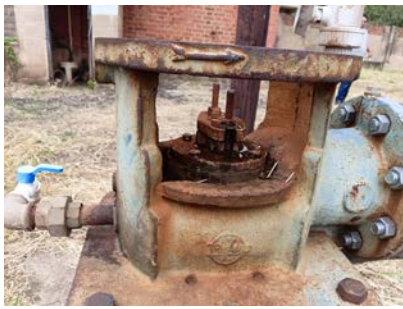
Foto 3 - Ausência de tubo para medição de nível.
