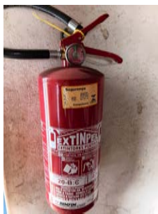
Foto 16 - Extintor de incêndio presente na unidade.
