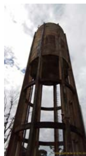
Foto 8 - Vazamento na estrutura do reservatório.
