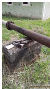
Foto 3 - Apoio e ancoragem precários na tubulação entre o poço e o reservatório.
