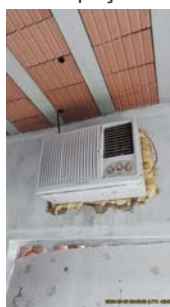
Foto 20 - Equipamento de ar condicionado instalado na edificação.
