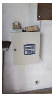
Foto 18 - Painel elétrico para comando da bomba do poço.
