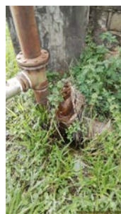
Foto 4 - Vazamento em registro adjacente ao reservatório.
