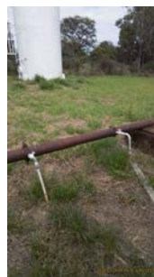
Foto 7 - Derivação na tubulação de saída, para dosagem de reagentes.
