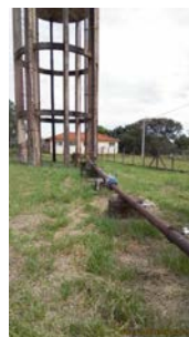
Foto 3 - Tubulação que conduz a água captada ao reservatório de concreto existente na área.
