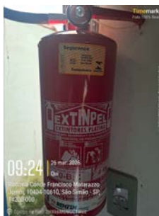
Foto 9 - Extintor instalado na EEA. Imagem enviada pelo prestador em 26/03/2026.
