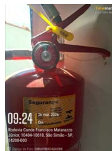
Foto 4 - Extintor presente na unidade. Foto enviada pelo prestador em 26/03/2026.
