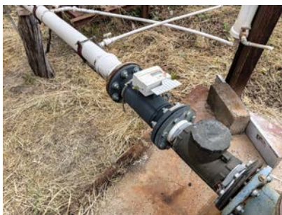
Foto 6 - Macromedidor da captação.
