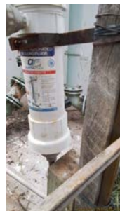
Foto 15 - Sistema para dosagem de reagentes utilizados no tratamento da água.
