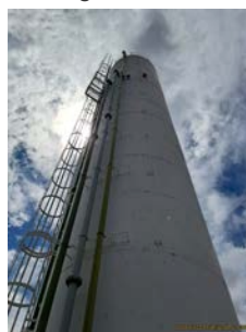
Foto 8 - Tubo extravasor, à direita.
