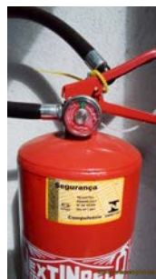
Foto 26 - Extintor existente no local.
