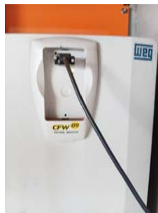
Foto 15 - Inversor de frequência para controle da bomba do poço.
