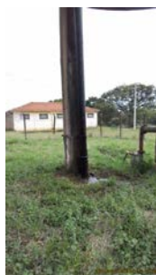
Foto 1 - Vazamento e acúmulo de água na base do reservatório.
