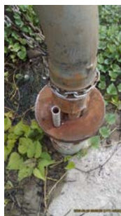
Foto 14 - Tubo para medição de nível. Recomenda-se o fechamento com cap.
