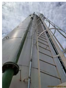
Foto 6 - Tubo de alimentação da caixa superior à esquerda e condutor para cabos de energia/sensores.
