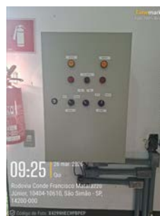
Foto 6 - Painel elétrico da EEA. Imagem enviada pelo prestador em 26/03/2026.
