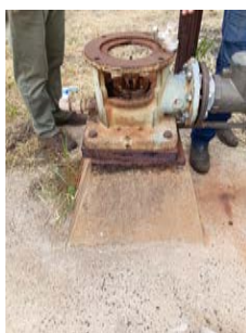
Foto 1 - Ausência de tubo para medição de nível.
