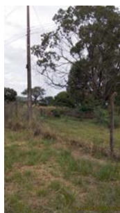
Foto 1 - Alambrado metálico colapsado.
