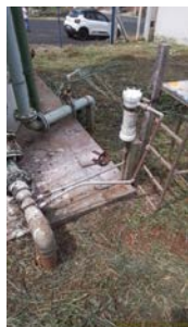
Foto 14 - Sistema para dosagem de reagentes utilizados no tratamento da água.
