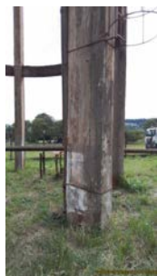
Foto 3 - Conductor do SPDA rompido.
