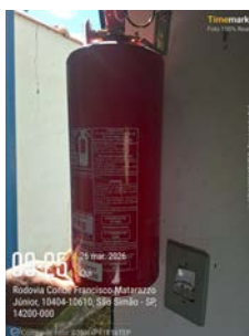
Foto 11 - Extintor instalado na EEA. Imagem enviada pelo prestador em 26/03/2026.
