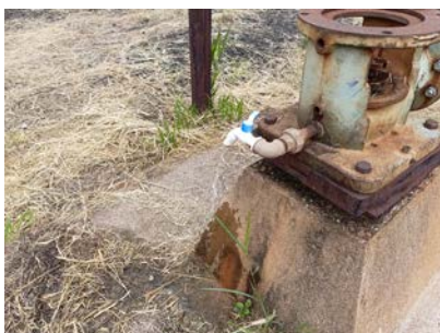
Foto 12 - Torneira para captação de água bruta.
