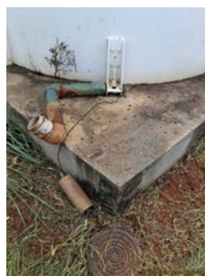
Foto 11 - Aterramento da estrutura.
