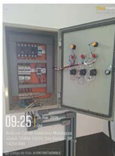
Foto 7 - Painel elétrico da EEA. Imagem enviada pelo prestador em 26/03/2026.
