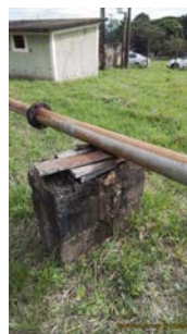
Foto 2 - Apoio e ancoragem precários na tubulação entre o poço e o reservatório.
