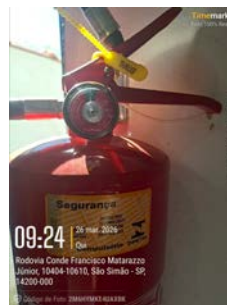
Foto 10 - Extintor instalado na EEA. Imagem enviada pelo prestador em 26/03/2026.
