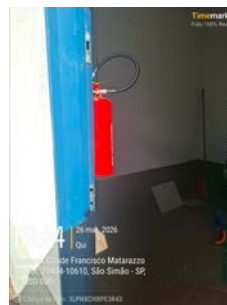
Foto 8 - Extintor instalado na EEA. Imagem enviada pelo prestador em 26/03/2026.
