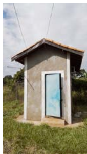
Foto 16 - Edificação em alvenaria existente no local, na qual são abrigados os painéis elétricos de comando da bomba do poço e os reagentes utilizados no tratamento.
