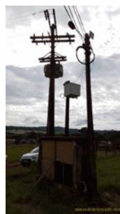
Foto 30 - Poste, transformador e abrigo da entrada de energia na unidade.
