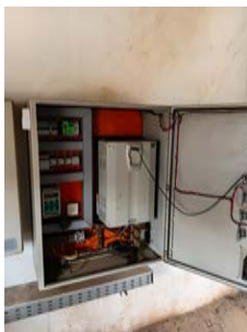
Foto 14 - Painelelétrico da bomba do poço.
