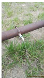
Foto 8 - Torneira para coleta de água bruta.
