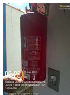
Foto 2 - Extintor presente na unidade. Foto enviada pelo prestador em 26/03/2026.
