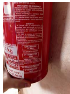
Foto 17 - Extintor de incêndio presente na unidade.
