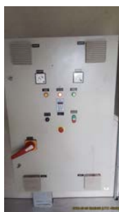
Foto 19 - Painel elétrico para comando da bomba do poço.
