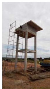
Foto 20 - Estrutura da primeira caixa de divisão.
