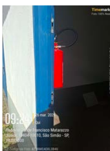
Foto 1 - Extintor presente na unidade. Foto enviada pelo prestador em 26/03/2026.
