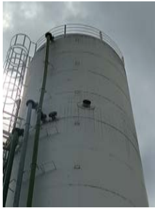
Foto 1 - Abertura de ventilação sem tela de proteção.
