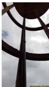
Foto 3 - Vazamento no reservatório, a água escorre junto a tubulação mostrada.
