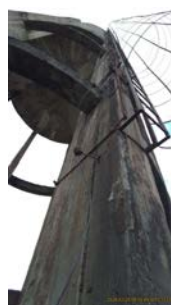
Foto 2 - Descida do conductor do SPDA.
