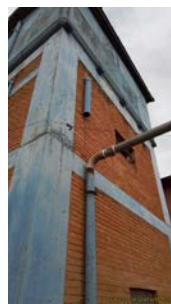
Foto 10 - Tubulação (acima) que era utilizada para abastecimento cortada.
