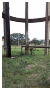
Foto 11 - Vista da base do reservatório, a tubulação horizontal vem de um poço existente no mesmo local.
