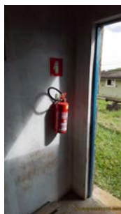
Foto 25 - Extintor existente no local.
