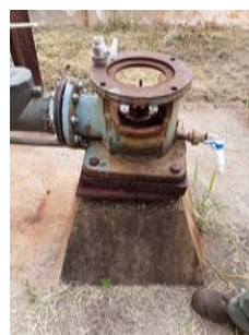
Foto 2 - Ausência de tubo para medição de nível.
