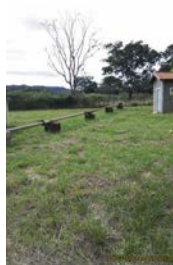
Foto 1 - Vista geral da área, mostrando tubulação que conduz a água captada no poço até o reservatório elevado de concreto existente no local.
