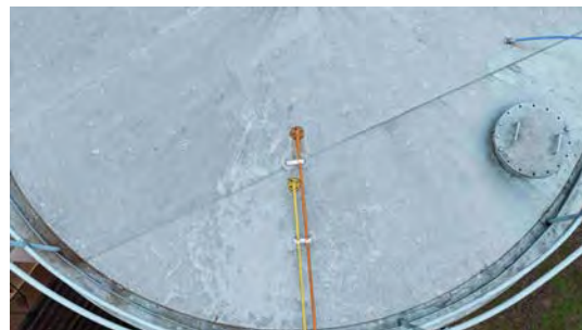
Foto 10 - Local de aplicação de produtos químicos.
