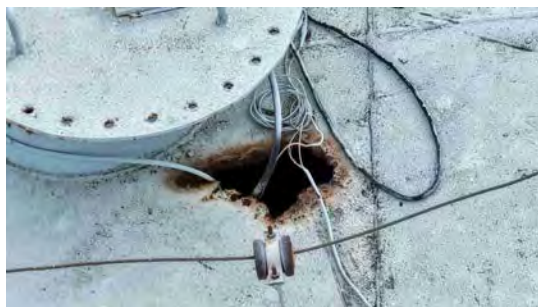
Foto 1 - Aberturas ocasionadas por corrosão.
