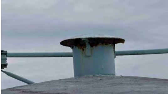
Foto 3 - Tubulação de ventilação sem tela.
