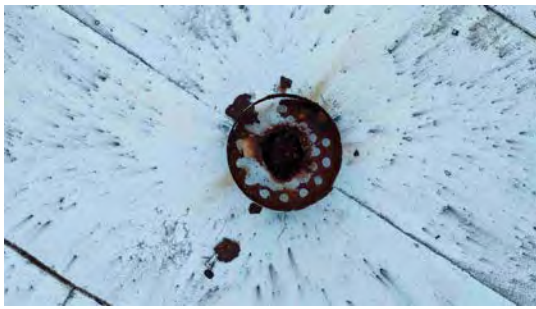
Foto 1 - Tubulação de ventilação danificada.
