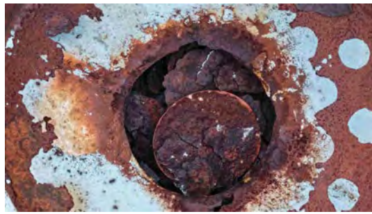
Foto 2 - Tubulação de ventilação danificada.
