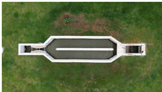
Foto 3 - Vista do tratamento preliminar.
