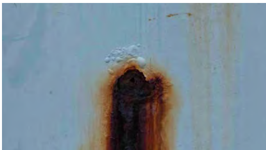
Foto 11 - Ponto de corrosão da estrutura.
