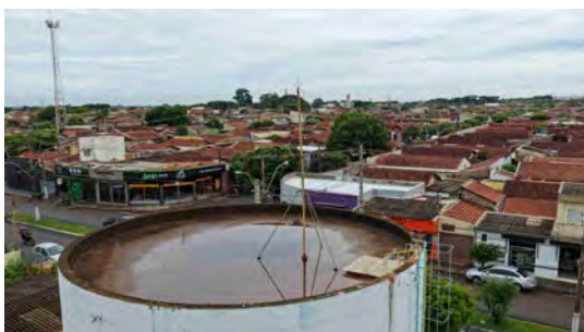
Foto 1 - Ausência de guarda-corpo no topo do reservatório de concreto.
