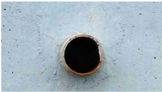
Foto 1 - Extravasor sem tela de proteção.
