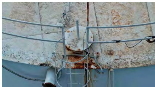
Foto 1 - Corrosão próxima à tampa de inspeção.
