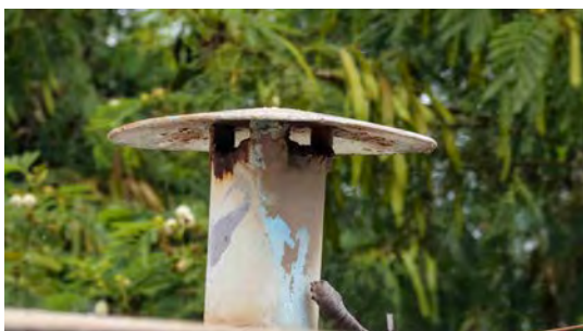
Foto 1 - Tubulação de ventilação sem tela.
