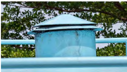
Foto 18 - Tubulação de ventilação.
