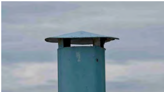
Foto 1 - Tubulação de ventilação sem tela de proteção.
