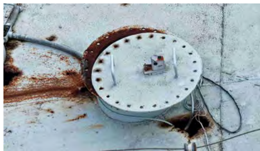
Foto 2 - Aberturas ocasionadas por corrosão.
