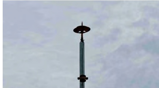
Foto 9 - Receptor de descarga atmosférica.
