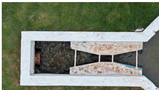
Foto 5 - Detalhe da calha Parshall de entrada.
