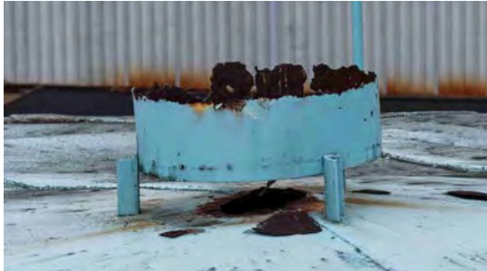
Foto 3 - Tubulação de ventilação danificada.
