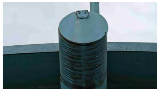
Foto 12 - Extravador do reservatório 1.
