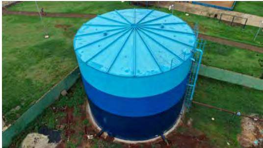
Foto 17 - Vista geral do reservatório metálico (novo).
