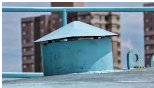
Foto 10 - Tubulação de ventilação.
