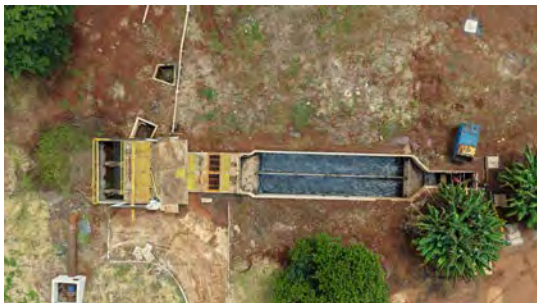
Foto 1 - Vista geral da EEE.
