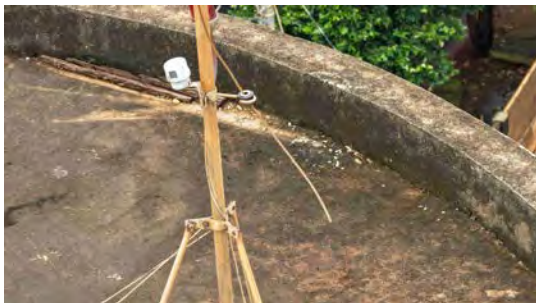
Foto 1 - Cabo de descida do SPDA rompido.
