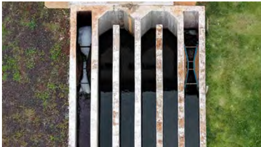
Foto 13 - Detalhe das calhas Parshall de entrada e saída do tanque de contato.
