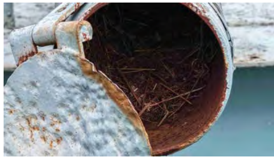
Foto 2 - Presença de possível ninho no interior do extravasor. Deve ser removido e limpo.
