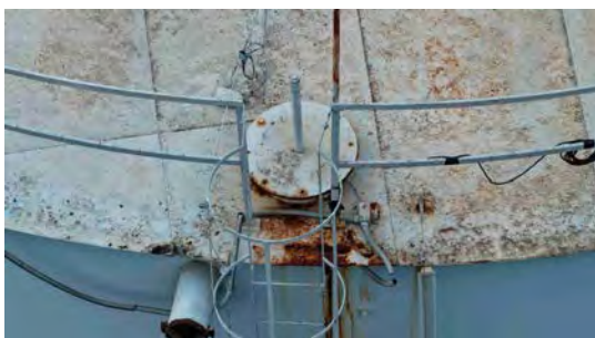
Foto 1 - Ausência de barra de rodapé no guarda-corpo.
