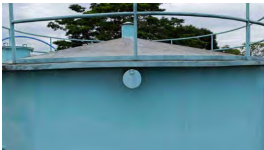
Foto 11 - Extravador do reservatório 1.
