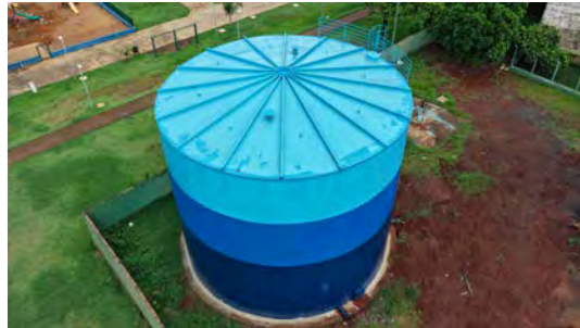
Foto 18 - Vista geral do reservatório metálico (novo).
