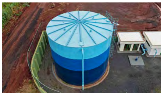
Foto 2 - Ausência de guarda-corpo para acessar a tampa de inspeção oposta à escada.
