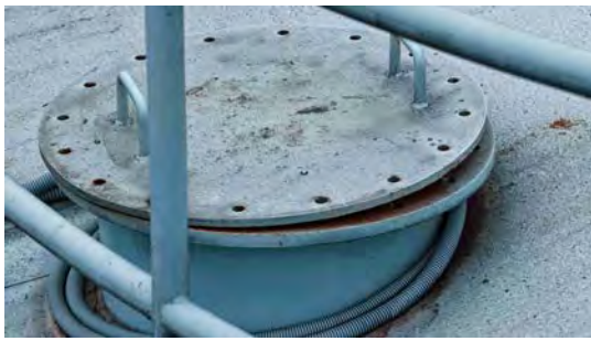
Foto 1 - Tampa de inspeção semiaberta no reservatório 2.
