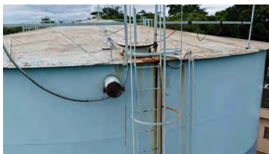
Foto 3 - Corrosão próxima à tampa de inspeção.
