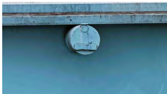
Foto 22 - Extravador do reservatório 2.
