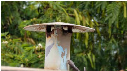
Foto 9 - Tubulação de ventilação.
