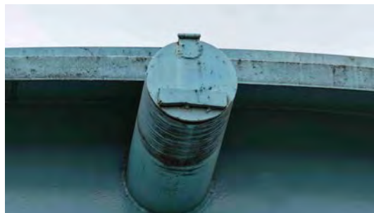
Foto 23 - Extravador do reservatório 2.
