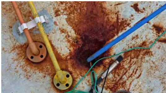
Foto 9 - Ponto de corrosão da estrutura.
