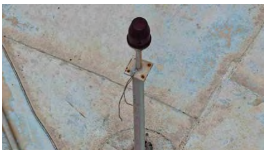
Foto 1 - Lâmpada de sinalização desativada.
