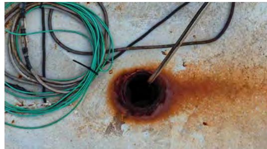
Foto 10 - Ponto de corrosão da estrutura.
