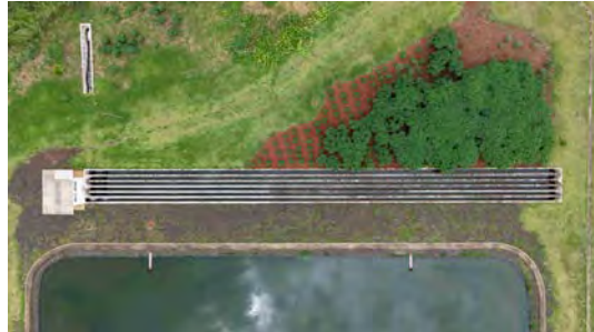
Foto 12 - Vista do tanque de contato e escada de aeração final.
