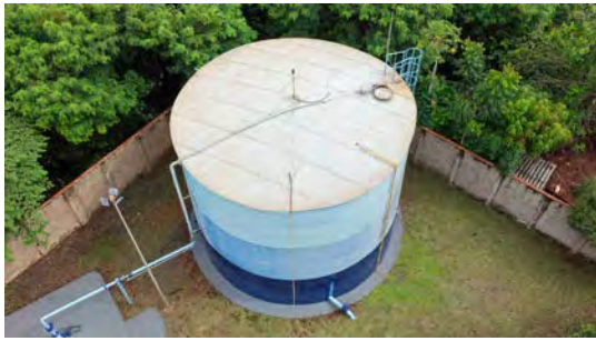
Foto 1 - Ausência de SPDA.
