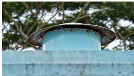
Foto 2 - Tubulação de ventilação do reservatório 2 sem tela.
