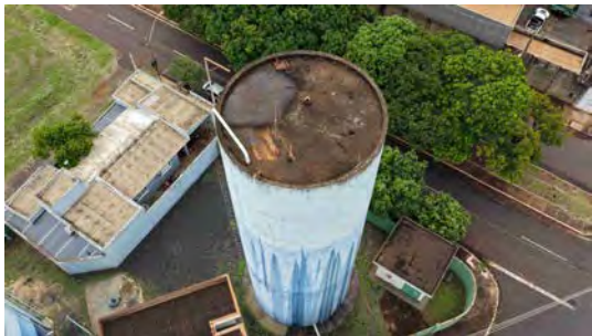
Foto 2 - Vazamento na estrutura de concreto.
