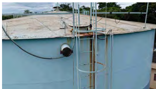
Foto 2 - Ausência de barra de rodapé no guarda-corpo.
