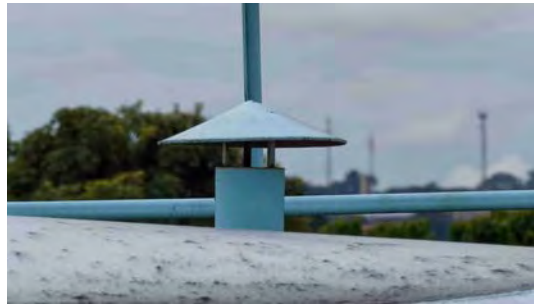
Foto 2 - Tubulação de ventilação sem tela.
