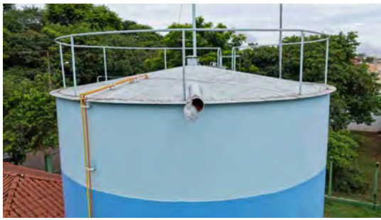
Foto 1 - Guarda-corpo do topo apenas com travessa superior.
