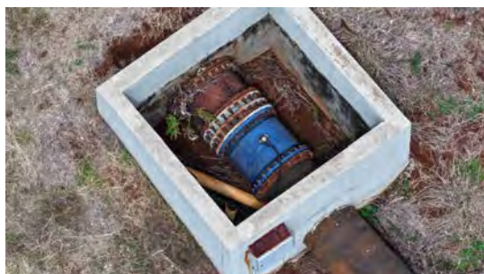
Foto 9 - Linha de recalque.
