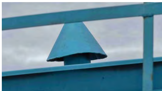
Foto 13 - Tubulações de ventilação.
