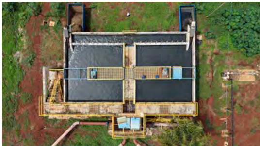
Foto 10 - Vista do tratamento preliminar.
