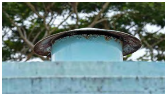
Foto 24 - Tubulação de ventilação do reservatório 2.
