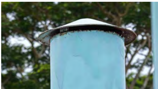
Foto 13 - Tubulação de ventilação do reservatório 1.
