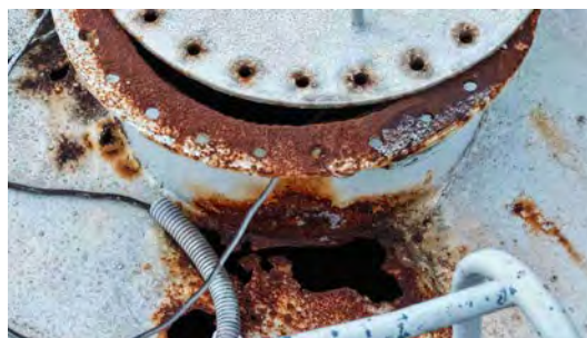
Foto 6 - Aberturas ocasionadas por corrosão.
