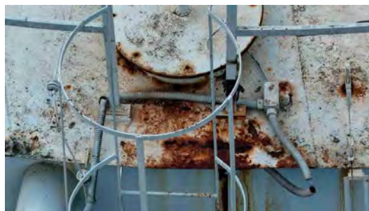
Foto 2 - Corrosão próxima à tampa de inspeção.
