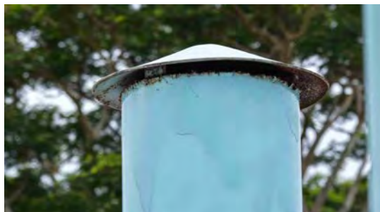
Foto 1 - Tubulação de ventilação do reservatório 1 sem tela.
