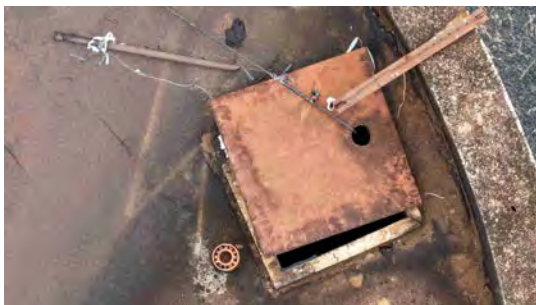
Foto 1 - Tampa de inspeção com buraco para ventilação. Adequar conforme a norma de referência.
