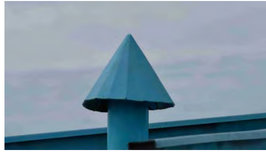
Foto 2 - Ausência de tela de proteção na tubulação de ventilação.
