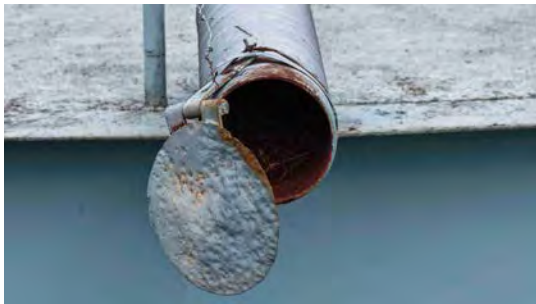
Foto 1 - Corrigir a portinhola de proteção.
