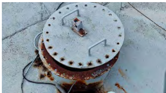
Foto 3 - Aberturas ocasionadas por corrosão.
