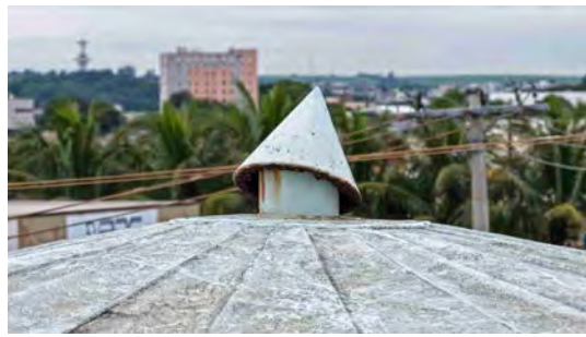
Foto 12 - Tubulação de ventilação.
