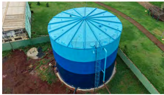
Foto 16 - Vista geral do reservatório metálico (novo).
