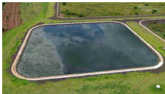
Foto 6 - Vista da lagoa anaeróbia 01.
