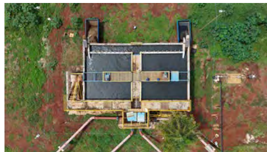
Foto 9 - Vista do tratamento preliminar.
