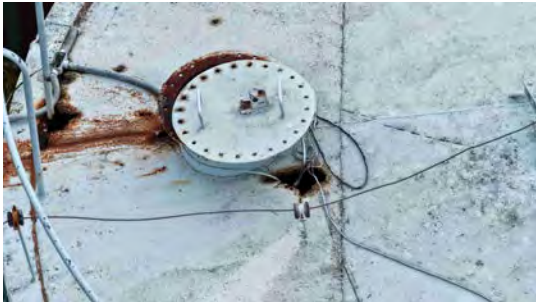
Foto 3 - Tampa de inspeção e aberturas por corrosão.
