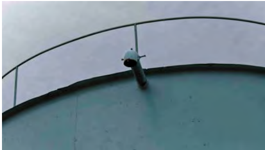
Foto 1 - Adequar guarda-corpo superior com travas intermediária e rodapé.
