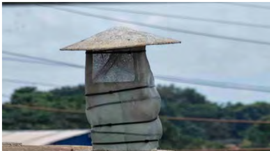
Foto 13 - Tubulação de ventilação com tela.
