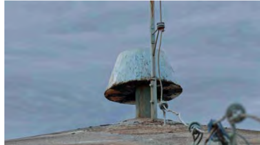
Foto 12 - Tubulações de ventilação e descida do SPDA.
