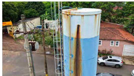
Foto 12 - Ponto de corrosão da estrutura.
