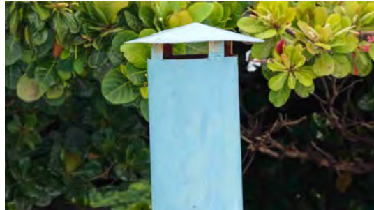
Foto 8 - Tubulação de ventilação.
