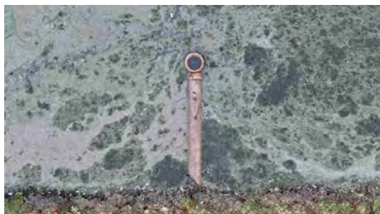
Foto 7 - Detalhe do tubo de saída 01 da lagoa anaeróbia 01.
