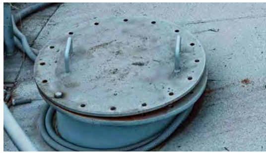
Foto 2 - Tampa de inspeção semiaberta no reservatório 2.
