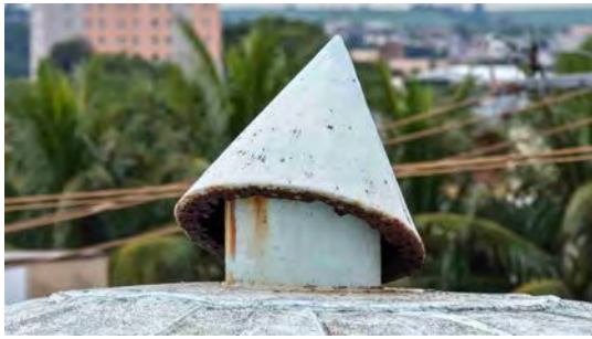
Foto 1 - Chapéu de proteção da tubulação de ventilação necessitando de raparo.
