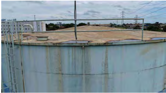
Foto 1 - Instalar barra de rodapé no gaurda-corpo do reservatório metálico.
