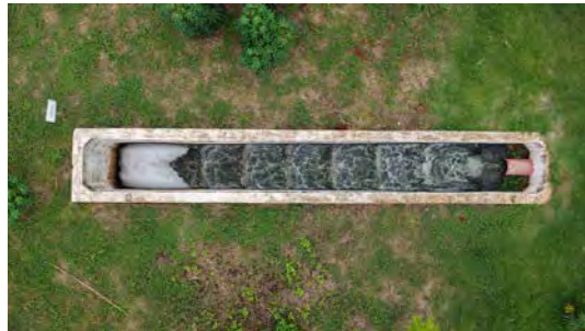
Foto 14 - Detalhe da escada de aeração final.
