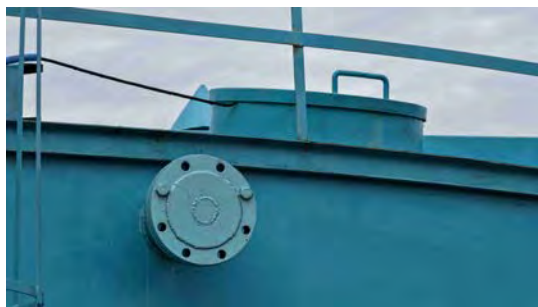
Foto 11 - Ponto de conexão.
