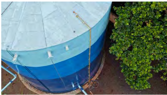
Foto 14 - Tubulação de aplicação de produtos químicos.
