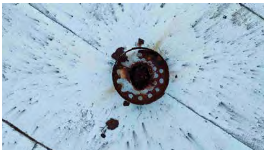
Foto 1 - Tubulação de ventilação sem tela.
