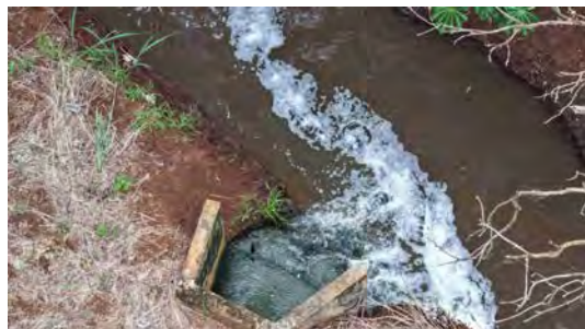
Foto 17 - Detalhe do lançamento do efluente tratado.
