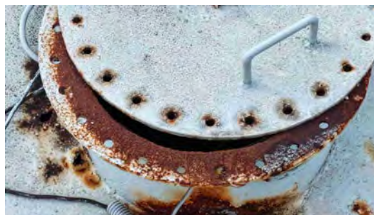
Foto 4 - Aberturas ocasionadas por corrosão.
