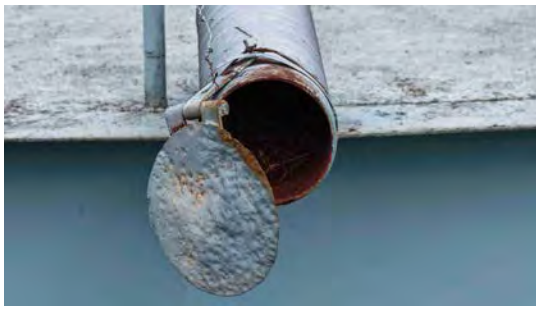
Foto 1 - Extravasor com proteção de vedação comprometida.
