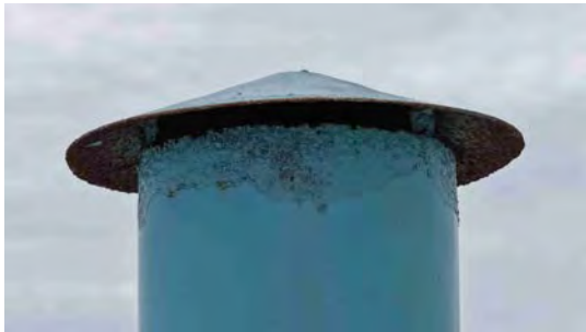
Foto 1 - Tubulação de ventilação sem tela.
