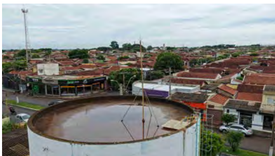
Foto 3 - Cabeamento cortado na segunda anélha.
