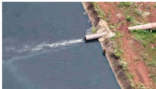
Foto 23 - Entrada na lagoa anaeróbia.
