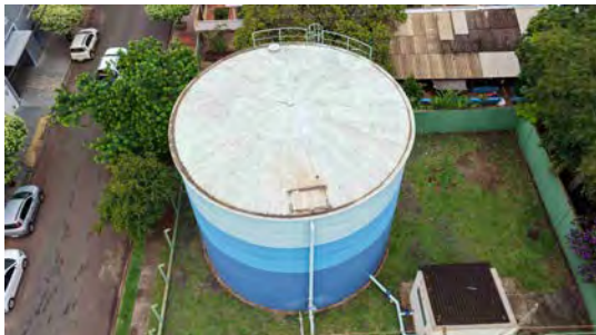
Foto 1 - Ausência de guarda-corpo para acessar a tampa de inspeção oposta à escada.
