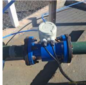
Foto 8 - Macromedidor de vazão do poço
