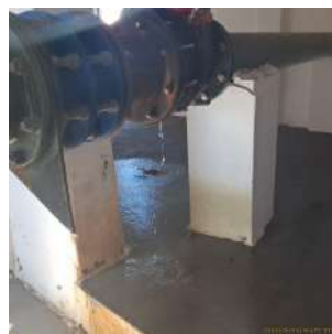
Foto 2 - Detalhe do vazamento na válvula de retenção
