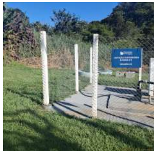
Foto 1 - Ausência do portão de acesso
