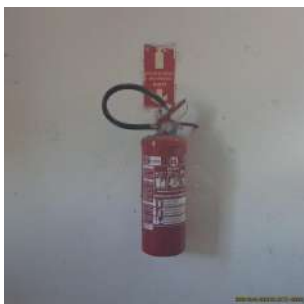
Foto 8 - Extintor de incêndio
