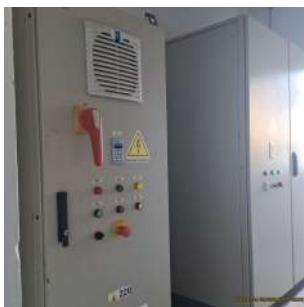
Foto 4 - Pannel de comando e controle
