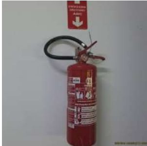
Foto 28 - Extintor de incêndio
