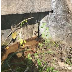
Foto 1 - Vista lateral do vazamento aparente
