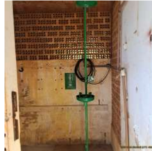
Foto 9 - Chuveiro de emergência
