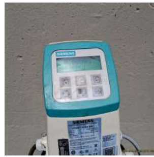
Foto 17 - Display do medidor de vazão da saída ETA (Sete de Setembro)
