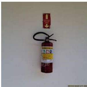
Foto 3 - Extintor de incêndio
