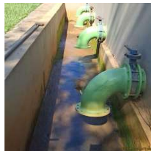
Foto 23 - Saída da água de lavagem dos filtros
