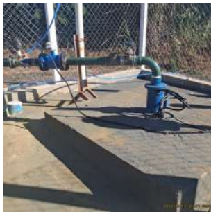
Foto 5 - Cavalete do poço
