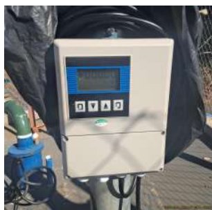
Foto 1 - Display do macromedidor
