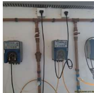
Foto 13 - Bombas dosadoras de PAC e flúor
