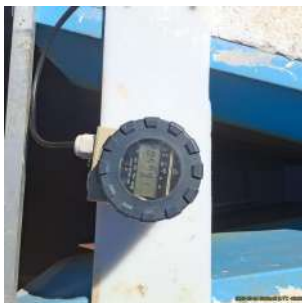
Foto 14 - Display do medidor de vazão da entrada da ETA
