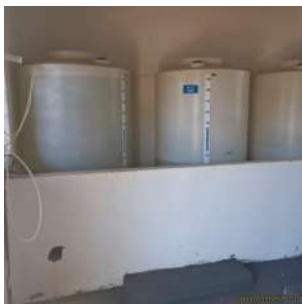
Foto 10 - Armazenamento de hipoclorito de sódio
