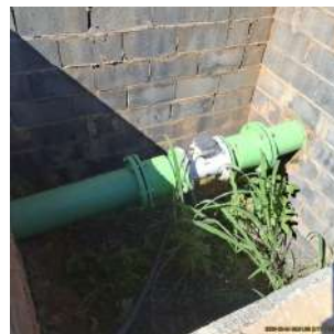
Foto 15 - Medidor de vazão da saída ETA (Talamoni)
