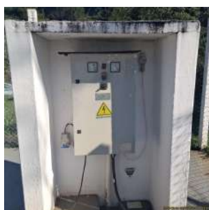
Foto 7 - Painel de comando e controle
