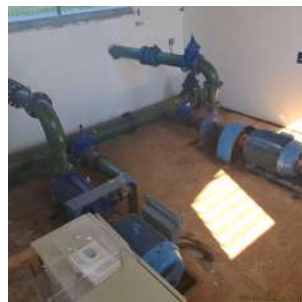
Foto 4 - Vista do interior da EEAT Sete de Setembro
