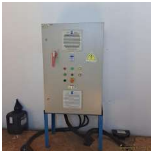
Foto 7 - Painele de comando e controle
