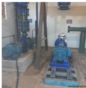
Foto 6 - Vista interna da EEAB Aurora
