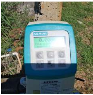
Foto 16 - Display do medidor de vazão da saída ETA (Talamoni)
