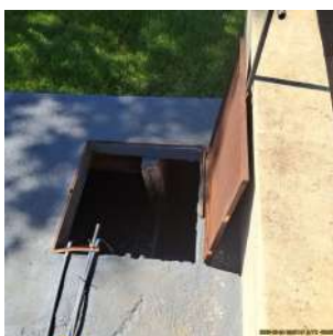
Foto 1 - Tampa de proteção danificada
