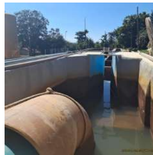
Foto 2 - Calha Parshall e chegada da água bruta
