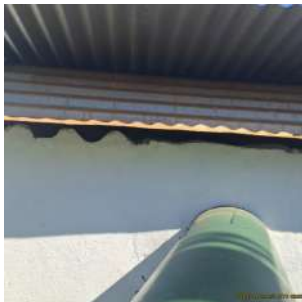
Foto 1 - Abertura na lateral do telhado
