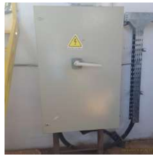
Foto 6 - Painele de comando e controle
