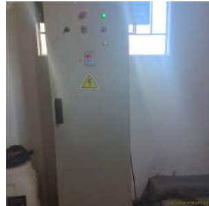
Foto 12 - Painel de comando e controle
