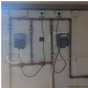
Foto 12 - Bombas dosadoras de cloro
