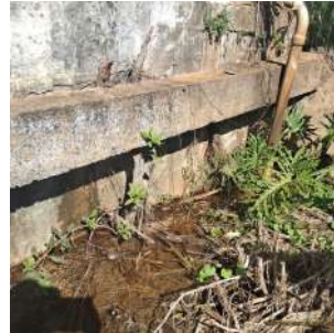
Foto 2 - Vista lateral do vazamento aparente
