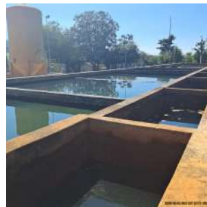
Foto 3 - Floculadores e decantadores
