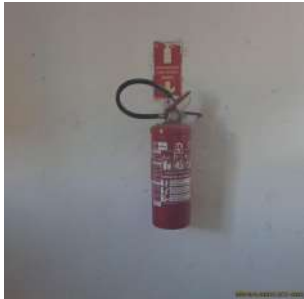
Foto 11 - Extintor de incêndio
