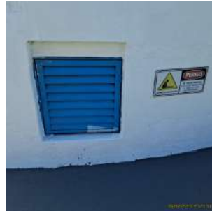
Foto 4 - Aviso de espaço confinado
