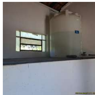
Foto 11 - Armazenamento de flúor
