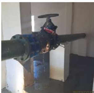
Foto 1 - Vazamento na válvula de retenção
