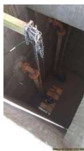
Foto 2 - Duas bombas submersa.
