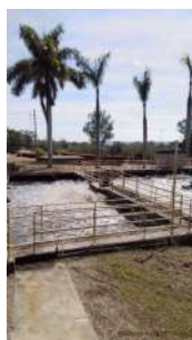
Foto 27 - Tanque de aeração.
