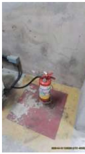
Foto 1 - Extintor no abrigo do gerador.
