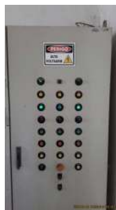
Foto 8 - Pannel de controle das bombas.
