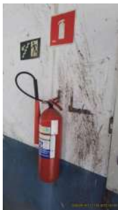
Foto 1 - Extintor junto às centrífugas de lodo
