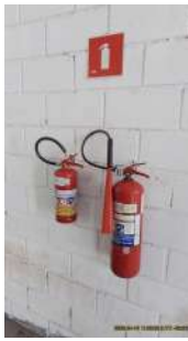
Foto 1 - Extintores da elevatória.
