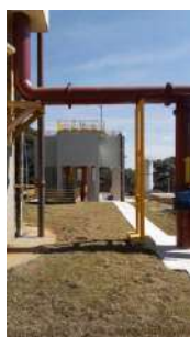
Foto 8 - Unidade de tratamento preliminar e tubulação que encaminha o efluente para os reatores.
