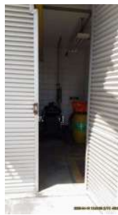
Foto 2 - Abrigo gerador e painéis de comando.
