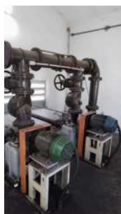
Foto 1 - Duas bombas centrífugas.
