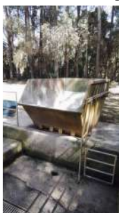
Foto 3 - Caçamba para disposição de sólidos contidos pelo gradeamento.
