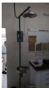
Foto 1 - Chuveiro de emergência no laboratório.
