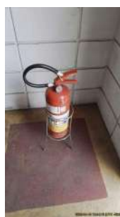
Foto 2 - Extintor da elevatória.
