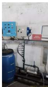
Foto 15 - Sistema neutralizador de odores.
