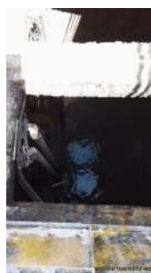
Foto 2 - Poço da outra bomba.
