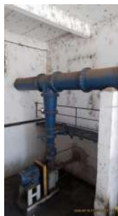
Foto 10 - Recalque do esgoto para a ETE.
