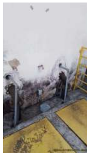
Foto 7 - Sucção das bombas.
