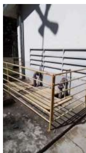
Foto 9 - Sucção das bombas.
