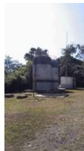
Foto 4 - UASB e filtro aerado submerso (FAS)
