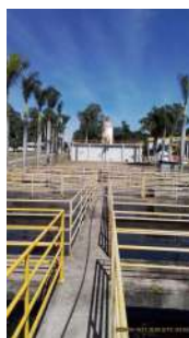
Foto 20 - Decantadores e aeradores atrás.
