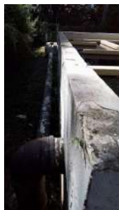
Foto 15 - Saída do efluente após o tanque de cloração;
