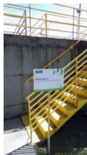
Foto 17 - Identificação dos decantadores, etapa final do tratamento, após a aeração.
