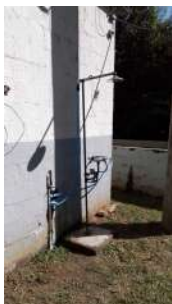
Foto 1 - Chuveiro de emergência.
