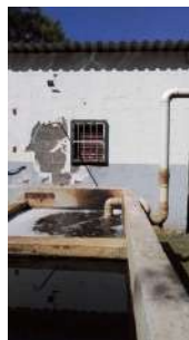
Foto 16 - Entrada do efluente no tanque de cloração após o filtro aerado.
