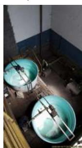
Foto 6 - Tanques para mistura de polímero, na ocasião do tratamento.
