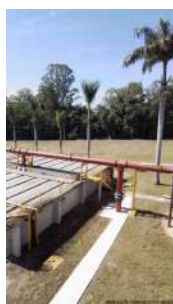
Foto 5 - Entrada do efluente nos reatores UASB após o tratamento preliminar.
