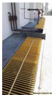
Foto 2 - Canaleta para escoamento do lodo dos reatores
