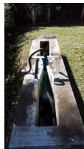
Foto 2 - Calha parshall na saída com medidor de vazão.
