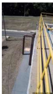
Foto 14 - Saída de um dos reatores UASB.
