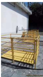
Foto 5 - Poços de sucção.
