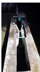
Foto 3 - Calha parshall na saída com medidor de vazão.
