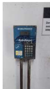
Foto 5 - Display do medidor de vazão.
