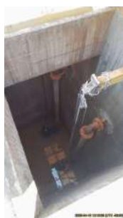
Foto 1 - Duas bombas submersa.
