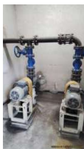
Foto 1 - Duas bombas centrífugas.
