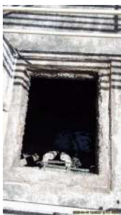
Foto 3 - Poço de sucção de uma das bombas.
