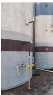
Foto 1 - Pontos de remoção de lodo do UASB.
