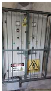
Foto 5 - Painel de comando das bombas.
