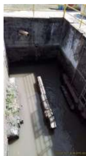
Foto 6 - Entrada do esgoto bruto na elevatória.
