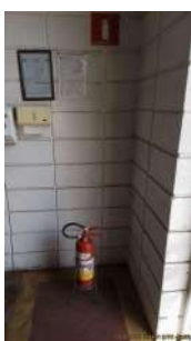
Foto 1 - Extintor da elevatória.
