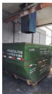
Foto 4 - Caçamba para disposição do lodo ressecado pelas centrífugas.
