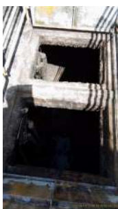
Foto 1 - Poço de uma das bombas.
