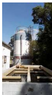
Foto 12 - Tanque de cloração (chicanas) e FAS ao fundo.
