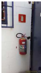
Foto 1 - Extintor da elevatória.
