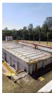
Foto 6 - 4 módulos de reatores UASB.
