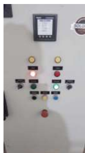
Foto 2 - Painel de comando das bombas.
