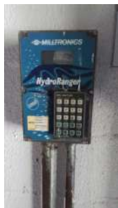
Foto 1 - Display do medidor de vazão da saída da ETE.
