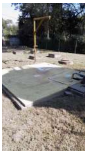
Foto 1 - Elevatória de esgoto interna.
