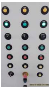
Foto 9 - Painele de controle das bombas.
