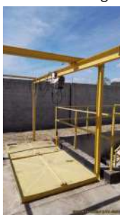
Foto 5 - Poço com cesto peneira.
