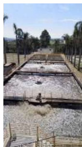
Foto 13 - Tanque de aeração.
