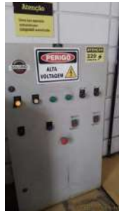
Foto 4 - Paineis de comando das bombas.
