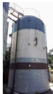
Foto 8 - Filtro aerado submerso (FAS)
