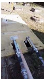
Foto 1 - Duas bombas submersas.
