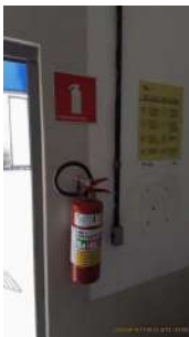
Foto 2 - Extintor nas salas dos operadores.
