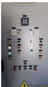
Foto 7 - Painel de controle das bombas.
