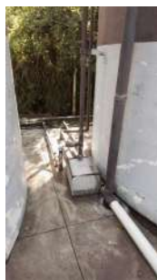
Foto 13 - Bomba para recirculação de lodo,
