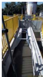
Foto 2 - Calha parshall no tratamento preliminar.
