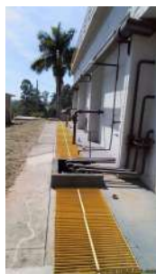
Foto 31 - Canaleta para descarte e transporte de lodo dos reatores 2 e 4, encaminhando-o para a unidade de centrífugas.
