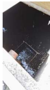
Foto 6 - Cesto peneira da elevatória.
