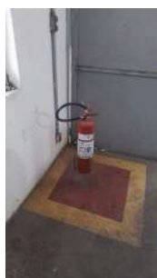
Foto 1 - Extintor na casa de bombas.
