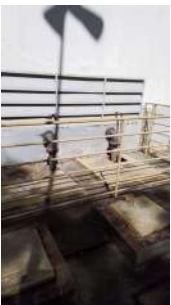
Foto 2 - Poço de sucção.
