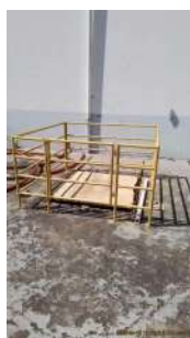
Foto 3 - Poço de lodo antes das centrífugas
