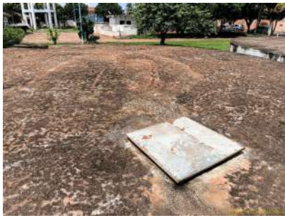
Foto 1 - Tampa de inspeção apresenta corrosão e está rente à superfície superior do reservatório.
