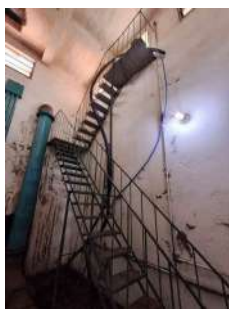
Foto 1 - vista da área interna da estação sem dispositivo de içamento para retirada dos conjuntos motobomba.
