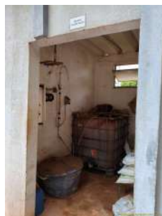
Foto 6 - Edificação adjacente com o reagente químico flúor utilizado no tratamento.
