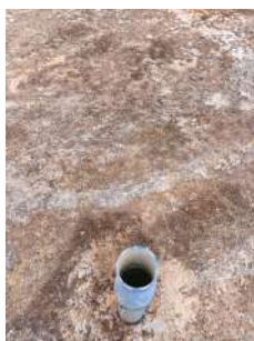
Foto 1 - Tubos de ventilação possuem tela, porém permitem a entrada de água da chuva no reservatório.
