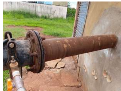
Foto 2 - Corrosão na estrutura da captação.
