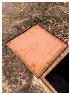
Foto 3 - Tampa de inspeção apresenta corrosão e está rente à superfície superior do reservatório.
