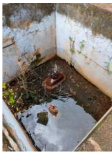
Foto 1 - Vazamento em tubulação adjacente ao reservatório.
