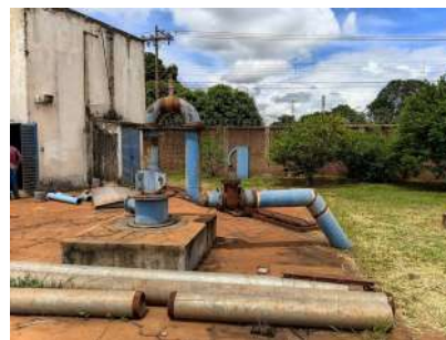
Foto 7 - Material depositado sobre a laje, ao redor da captação.
