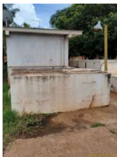
Foto 5 - A água captada no Poço Santo Antônio é recebida neste reservatório, no qual ocorre a adição dos reagentes cloro e flúor.
