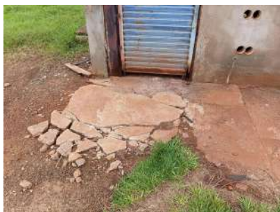
Foto 7 - Dano no pavimento na entrada do abrigo para reagentes químicos.
