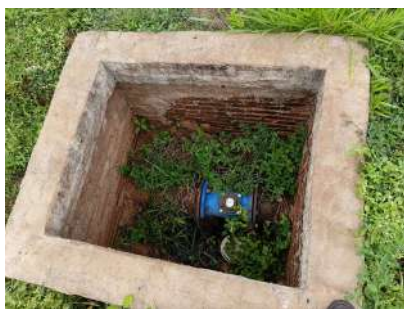
Foto 10 - Macromedidor em caixa de passagem adjacente à captação.
