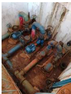
Foto 3 - Vista geral da EEA.
