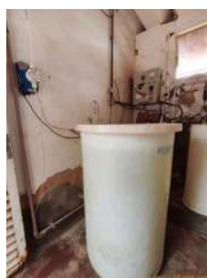
Foto 9 - Interior da edificação adjacente com o reagente químico cloro utilizado no tratamento.
