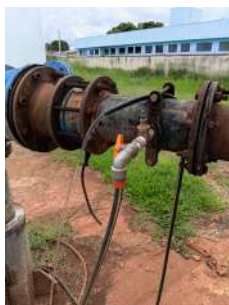
Foto 12 - Torneira para coleta de água bruta.
