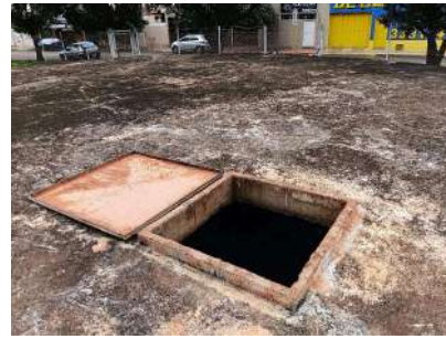
Foto 2 - Tampa de inspeção apresenta corrosão e está rente à superfície superior do reservatório.
