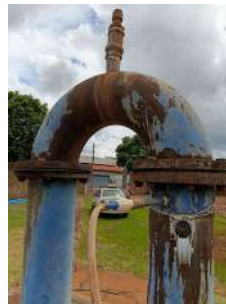
Foto 5 - Corrosão em tubulação da captação.
