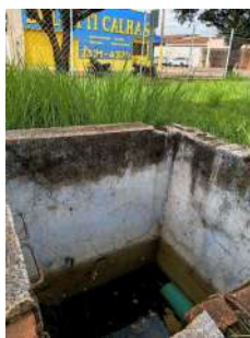
Foto 3 - Vazamento em registro adjacente ao reservatório.
