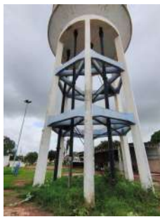
Foto 9 - Tubulações de alimentação, extravasão e saída do reservatório.
