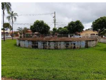
Foto 1 - Há acúmulo de lodo na superfície ao redor do reservatório, sendo necessário limpeza e pintura.
