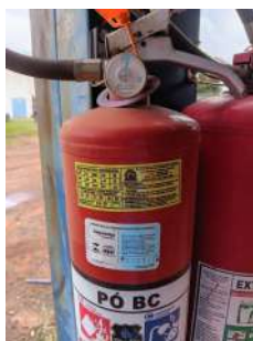
Foto 3 - Extintor de pó químico com manutenção vencida em 01/2026.
