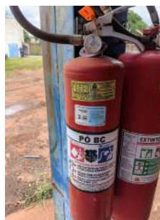
Foto 4 - Extintor de pó químico com manutenção vencida em 01/2026.
