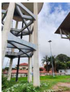
Foto 7 - Descida do condutor do SPDA
