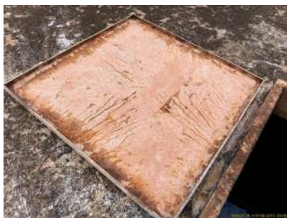
Foto 3 - Tapa de inspeção apresenta corrosão e está rente à superfície superior do reservatório.
