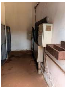
Foto 9 - Quadros elétricos no interior da edificação que abriga o transformador.
