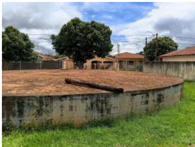
Foto 1 - Remover tronco seco depositado sobre o reservatório.
