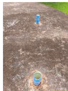
Foto 9 - Tubulações de ventilação, protegidas com tela, na parte superior do reservatório.
