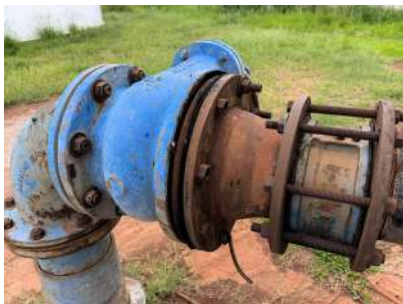
Foto 1 - Corrosão na estrutura da captação.
