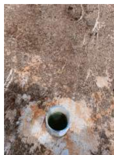
Foto 2 - Tubos de ventilação possuem tela, porém permitem a entrada de água da chuva no reservatório.
