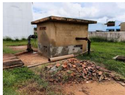
Foto 4 - Entulho depositado ao lado do abrigo de reagentes químicos.
