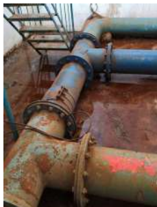
Foto 3 - Área da estação com sinais de drenagem inadequada e presença de umidade constante.
