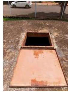
Foto 2 - Tampa de inspeção apresenta corrosão e está rente à superfície superior do reservatório.
