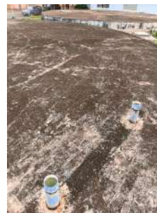
Foto 5 - Tubos de ventilação protegidos com tela, na parte superior do reservatório.
