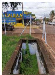
Foto 6 - Caixa de passagem, adjacente ao reservatório RSE 03, contendo registro apresentando vazamento.
