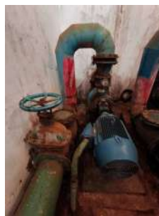
Foto 4 - Conjunto motobomba 1 da EEA.
