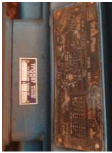
Foto 5 - Placa com identificação do motor do conjunto 1.
