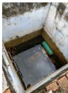
Foto 4 - Vazamento em registro adjacente ao reservatório.
