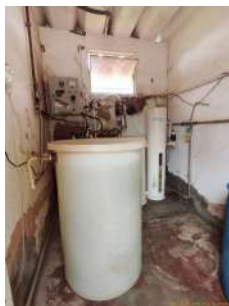
Foto 10 - Interior da edificação adjacente com o reagente químico cloro utilizado no tratamento.
