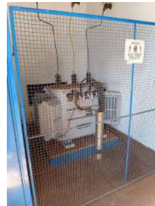
Foto 8 - Transformador instalado em edificação ao lado da captação.
