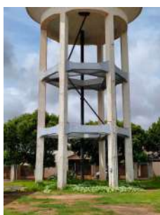
Foto 1 - Escadas do reservatório não possuem guarda corpo.
