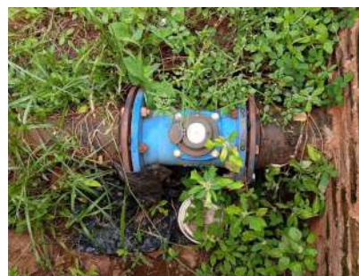
Foto 11 - Macromedidor em caixa de passagem adjacente à captação.
