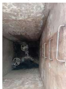
Foto 3 - Escada para descida até os registros não possui guarda corpo.
