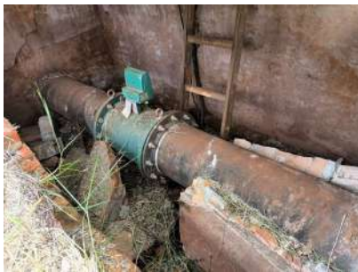
Foto 3 - Vegetação e entulho dentro da caixa de passagem, ao redor do macromedidor.
