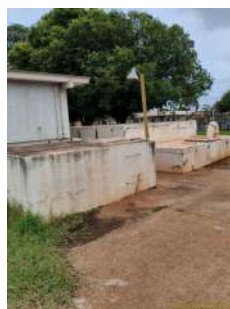
Foto 4 - No local existem dois reservatório interligados, à direita e à esquerda na imagem.
