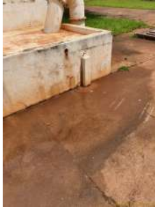
Foto 1 - Vazamento na estrutura do reservatório causa acúmulo de água no pavimento ao redor.
