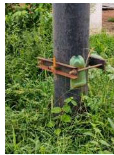
Foto 10 - Torneira para coleta de água na saída do reservatório.
