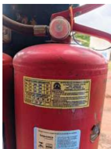
Foto 1 - Extintor de água com manutenção vencida em 01/2026.
