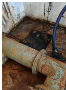
Foto 2 - Ponto com acúmulo de água decorrente da lubrificação das gaxetas.
