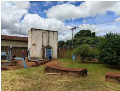
Foto 2 - Vista da área interna da unidade, evidenciando caixas de passagem com tampa metálica (a frente, a direita) e edificação ao fundo com transformadores.
