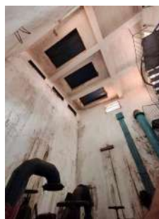
Foto 2 - Abertura superior sem estrutura (viga/suporte) para instalação de talha ou ponte rolante.
