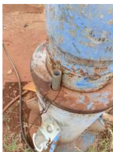
Foto 1 - Tubo de medição de nível.
