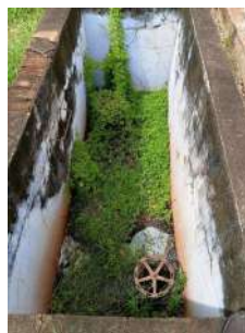
Foto 7 - Caixa de passagem, adjacente ao reservatório RSE 03, contendo registro apresentando vazamento.
