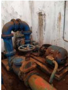
Foto 8 - Conjunto moto bomba 3 da EEA.
