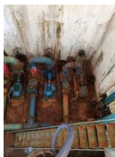
Foto 2 - Vista da EEA, localizada abaixo do nível do solo, a partir da porta de entrada ao recinto.
