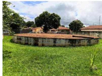
Foto 2 - Há acúmulo de lodo na superfície ao redor do reservatório, sendo necessário limpeza e pintura.
