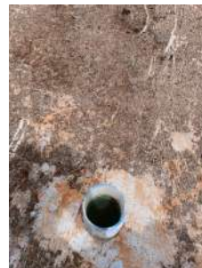
Foto 7 - Tubo de ventilação, protegido com tela, na parte superior do reservatório.
