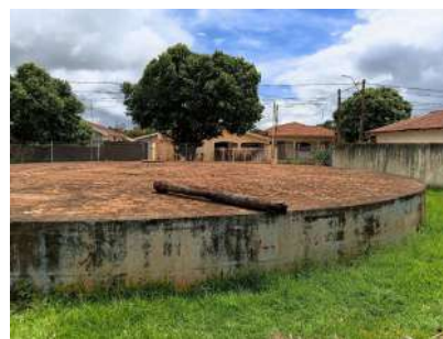
Foto 2 - Não foi evidenciada a presença de tubulação de ventilação no reservatório.
