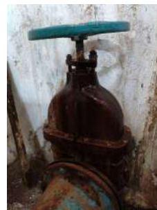
Foto 4 - Evidência de vazamentos aparente no registro de gaveta.
