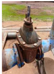
Foto 4 - Corrosão em registro da captação.
