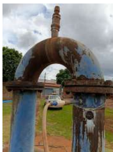
Foto 6 - Corrosão em tubulação da captação.
