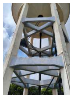
Foto 2 - Escadas do reservatório não possuem guarda corpo.
