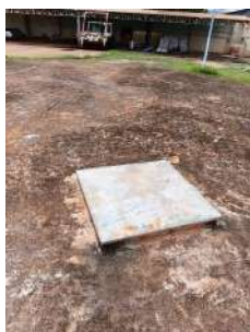
Foto 1 - Tampa de inspeção apresenta corrosão e está rente à superfície superior do reservatório.
