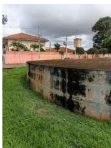
Foto 1 - Ponto de vazamento na estrutura do reservatório.
