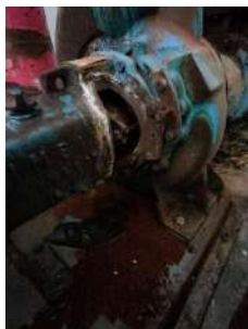
Foto 3 - Vazamento no conjunto motobomba 1.
