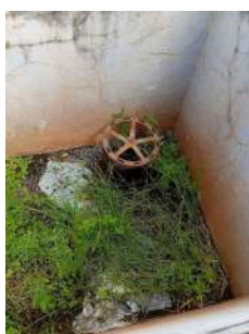
Foto 8 - Vazamento em registro localizado em caixa de passagem adjacente ao reservatório RSE 03.
