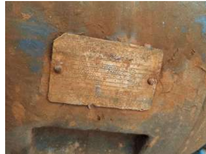
Foto 9 - Placa com identificação do motor do conjunto 3.
