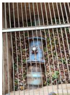
Foto 13 - Macromedidor do Poço Santo Antônio, instalado em caixa de passagem adjacente à caixa de distribuição.
