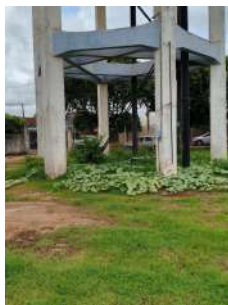
Foto 1 - Vegetação crescendo sob o reservatório.
