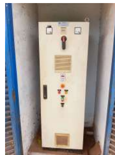
Foto 10 - Quadro de comando elétrico da captação.
