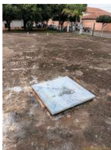
Foto 1 - Tapa de inspeção apresenta corrosão e está rente à superfície superior do reservatório.
