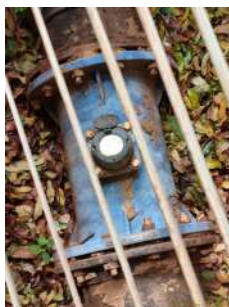
Foto 14 - Macromedidor do Poço Santo Antônio, instalado em caixa de passagem adjacente à caixa de distribuição.
