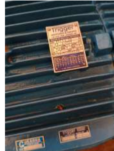
Foto 7 - Placa com identificação do motor do conjunto 2.
