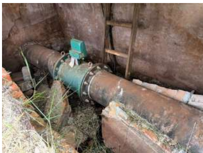
Foto 11 - Macromedidor da captação, instalado em tubulação em caixa de passagem adjacente ao poço.
