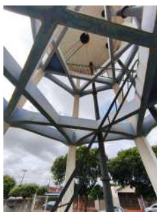
Foto 3 - Escadas do reservatório não possuem guarda corpo.
