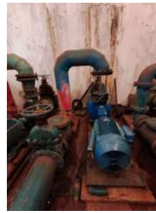
Foto 6 - Conjunto motobomba 2 da EEA.
