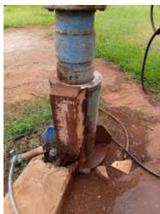
Foto 3 - Corrosão na estrutura da captação.
