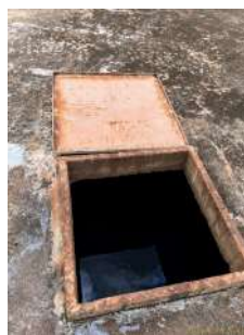
Foto 2 - Tapa de inspeção apresenta corrosão e está rente à superfície superior do reservatório.
