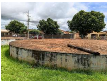
Foto 1 - Não foi evidenciada a presença de tubulação de ventilação no reservatório.
