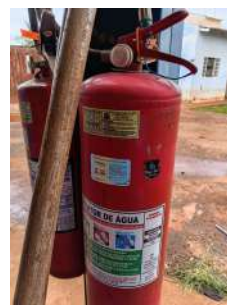
Foto 2 - Extintor de água com manutenção vencida em 01/2026.
