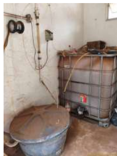
Foto 7 - Interior da edificação adjacente com o reagente químico flúor utilizado no tratamento.
