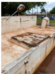
Foto 1 - Tampa de inspeção apresentando corrosão.
