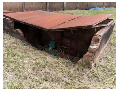
Foto 2 - Parte da alvenaria da caixa de passagem colapsou.
