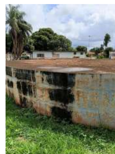
Foto 2 - Ponto de vazamento na estrutura do reservatório.
