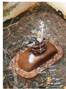
Foto 2 - Vazamento em tubulação adjacente ao reservatório.
