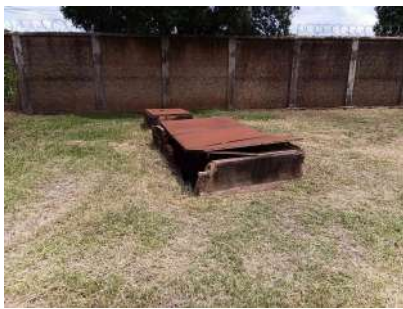
Foto 1 - Caixa de passagem ao lado da captação; a tampa apresenta corrosão.
