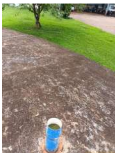
Foto 10 - Tubulações de ventilação, protegidas com tela, na parte superior do reservatório.
