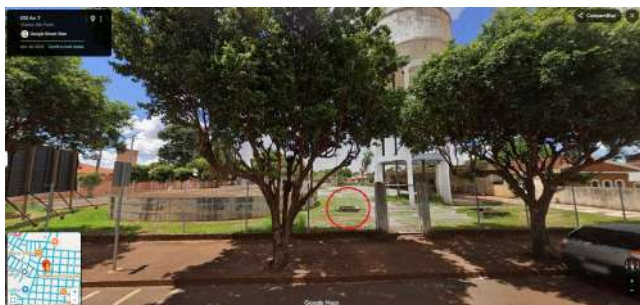
Foto 5 - Imagem obtida no Google Street View, indicando uma das caixas de passagem com vazamento, adjacente ao reservatório semienterrado 03.
