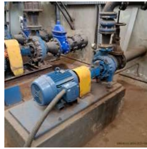
Foto 6 - Conjunto de motobombas de menor potência.
