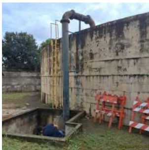
Foto 1 - Escada de acesso ao topo sem guarda corpo.
