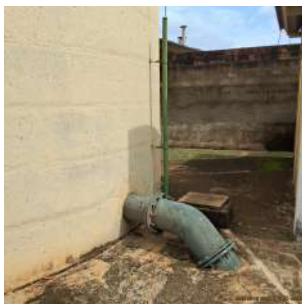
Foto 3 - Tubulação de distribuição.
