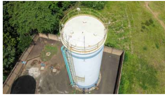
Foto 8 - Escada de acesso ao topo do Reservatório 2, tubulação de entrada de água e tubo extravasor (com saída protegida por tela).
