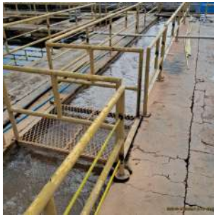
Foto 11 - Condução da água em direção aos floculadores e decantadores.
