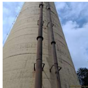
Foto 4 - Tubulação de entrada de água e tubo extravasor.
