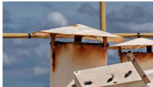
Foto 13 - Tubo de ventilação do Reservatório 2.
