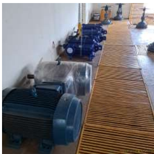
Foto 11 - Conjunto de moto bombas reservas.
