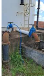
Foto 3 - Tubulação de distribuição.
