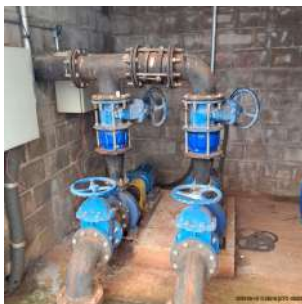
Foto 1 - Conjunto de motobombas, sendo uma em operação e outra em reserva.
