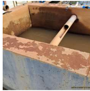
Foto 8 - Entrada da água na estação de tratamento.
