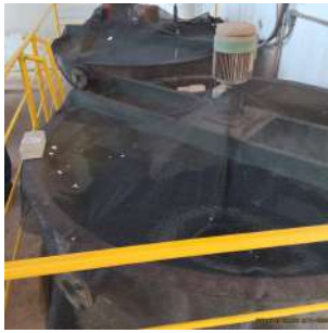
Foto 25 - Tanque de armazenamento de PAC.
