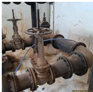
Foto 3 - Tubulação e registros.
