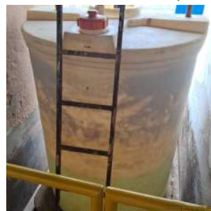
Foto 24 - Tanque de armazenamento de hidróxido de sódio.
