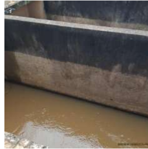
Foto 2 - Passagem da água bruta.
