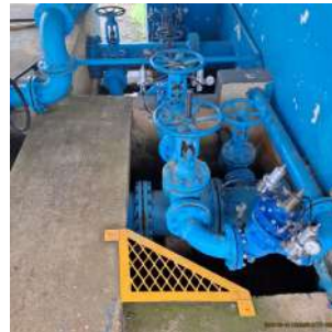
Foto 5 - Conjunto de válvulas e registros para controle.
