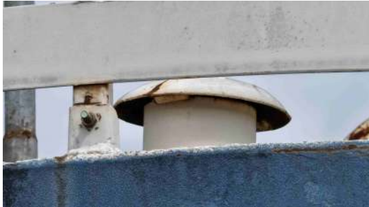
Foto 6 - Tubo de ventilação.
