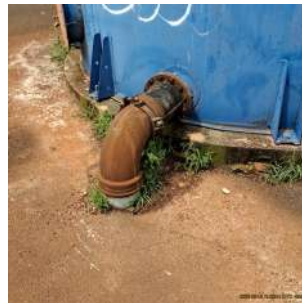
Foto 2 - Tubulação de distribuição.
