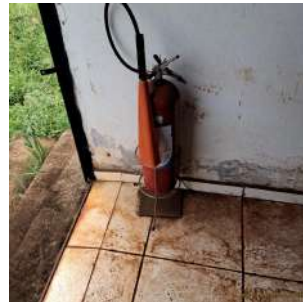
Foto 6 - Extintor de incêndio.
