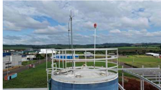
Foto 7 - Para-raios e guarda corpo.
