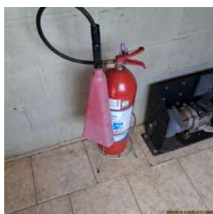
Foto 3 - Extintor de incêndio.
