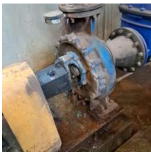
Foto 1 - Região da gaxeta com extravasamento de água, com acúmulo no entorno da bomba.
