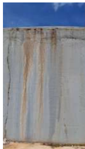
Foto 1 - Vazamento observado na lateral do reservatório.
