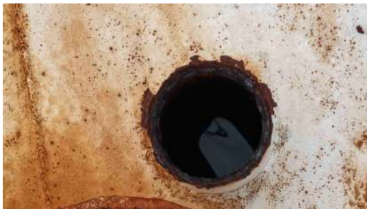
Foto 1 - Abertura decorrente do desprendimento da tampa do tubo de ventilação.
