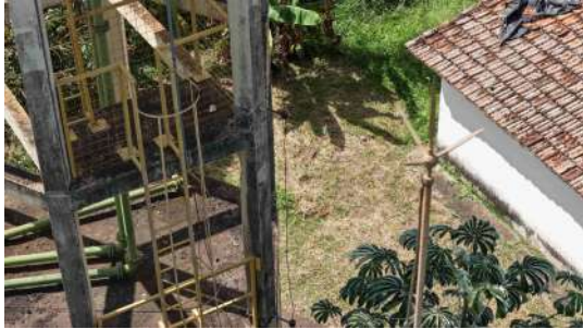
Foto 6 - Escada de acesso à estrutura e tubulações de entrada e distribuição de água.
