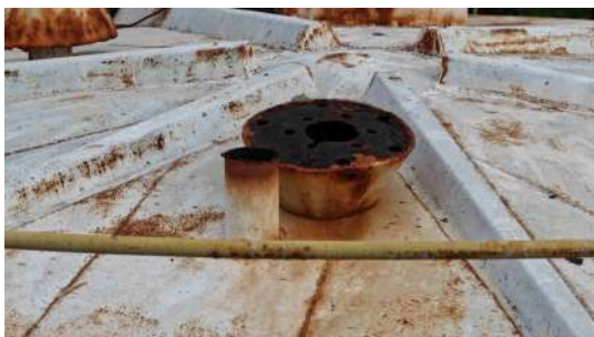
Foto 3 - Tampa que protegia o tubo de ventilação, caída ao lado da abertura.
