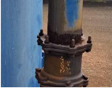
Foto 1 - Ponto de corrosão na tubulação de entrada de água.
