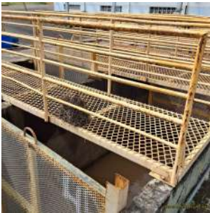
Foto 3 - Gradeamento para conter sólidos grosseiros.
