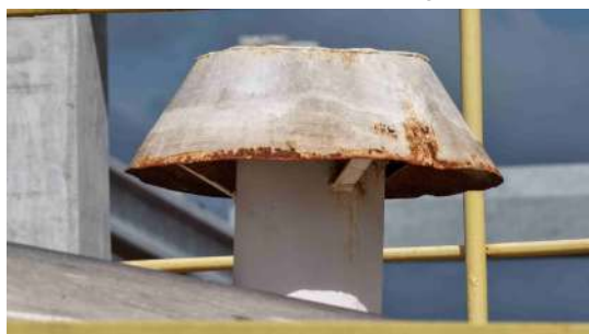
Foto 9 - Tubo de ventilação.
