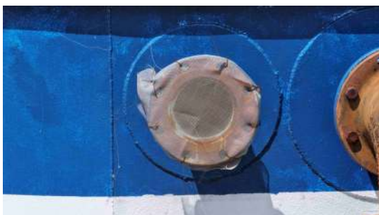
Foto 14 - Tubo extravasor do Reservatório 1.
