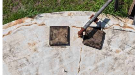
Foto 6 - Tampas de inspeção.
