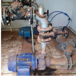
Foto 3 - Conjunto de motobombas.
