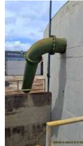
Foto 10 - Tubo extravasor no Reservatório 2.
