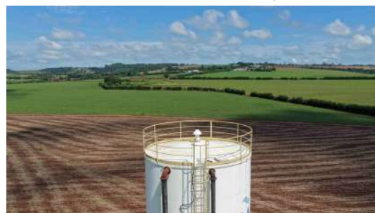
Foto 10 - Topo do reservatório, com destaque para as tubulações de entrada e o extravasador, além do tubo de respiro.
