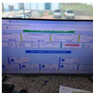
Foto 5 - Display informativo para acompanhamento da vazão de captação, da vazão de entrada e do nível dos reservatórios.
