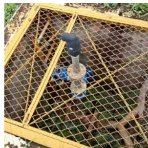
Foto 8 - Caixa de válvulas com tubulação e conexões hidráulicas.
