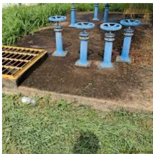
Foto 9 - Conjunto de registros e válvulas de controle.
