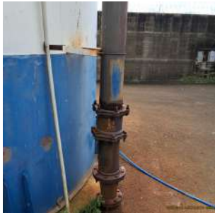
Foto 3 - Tubulação de entrada.
