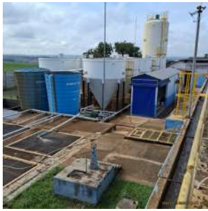
Foto 16 - Sistema de tratamento de lodo.
