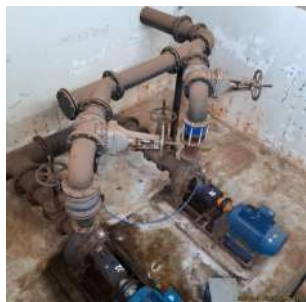
Foto 5 - Conjunto de motobombas.
