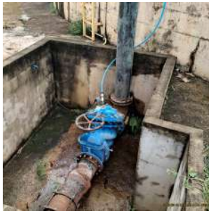
Foto 3 - Abertura que abriga o registro, sem proteção.
