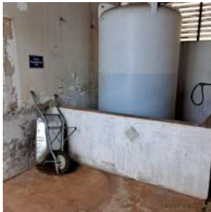
Foto 20 - Tanque de armazenamento de ácido flússilicato.
