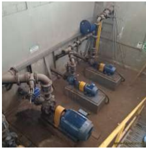
Foto 5 - Conjunto de motobombas com duas unidades de maior potência e duas de menor potência, sendo uma de cada em operação e a outra em reserva.
