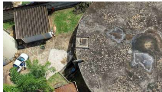
Foto 2 - Área no entorno da tampa de inspeção sem proteção.
