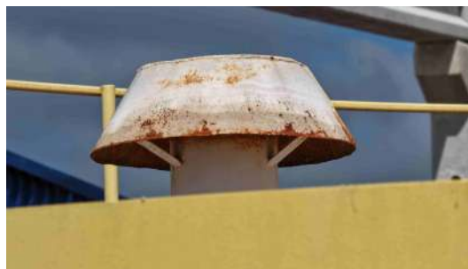
Foto 8 - Tubo de ventilação.
