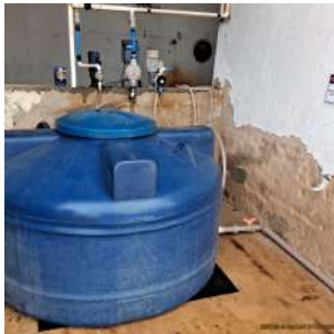
Foto 1 - Tanque de hipoclorito de sódio sem proteção.
