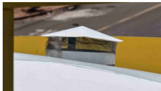
Foto 6 - Tubulação de ventilação (com tela de proteção).
