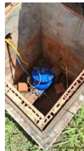
Foto 2 - Caixa junto ao reservatório com conjunto hidráulico instalado.
