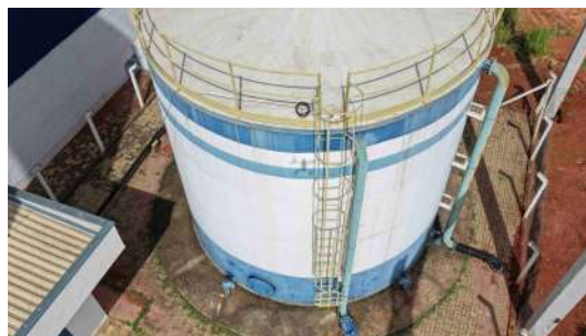
Foto 6 - Tubulação de entrada de água e extravasor.
