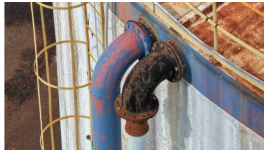
Foto 11 - Tubo extravasor e tubo de entrada de água.
