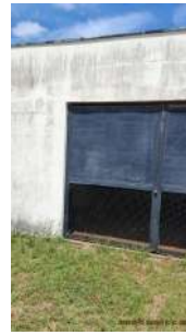
Foto 4 - Vista geral da estação elevatória de água.
