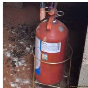
Foto 2 - Extintor de incêndio.
