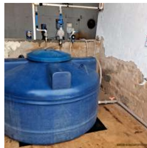
Foto 22 - Tanque de hipoclorito de sódio (tanque de menor volume, ao qual estão conectadas as bombas dosadoras).
