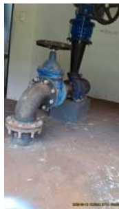
Foto 1 - Motobomba (Faz parte de um conjunto, sendo uma utilizada em operação, e outra em reserva).
