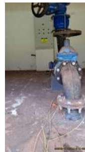
Foto 2 - Motobomba (Faz parte de um conjunto, sendo uma utilizada em operação, e outra em reserva).
