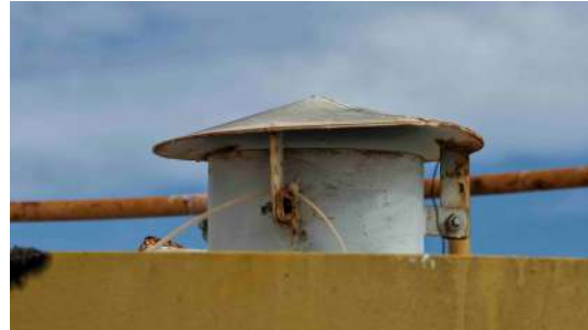
Foto 8 - Tubo de ventilação.
