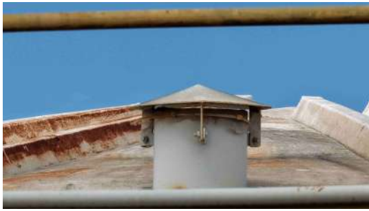
Foto 12 - Tubo de ventilação.
