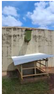
Foto 11 - Tubo extravasor no Reservatório 1.
