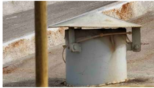
Foto 13 - Tubo de ventilação, com visualização da tela de proteção.
