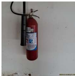
Foto 12 - Extintor de incêndio.
