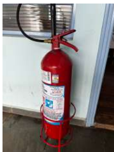
Foto 7 - Extintor de incêndio.
