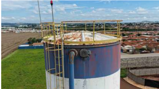
Foto 7 - Tubo de entrada de água e, ao lado, tubo extravasor.
