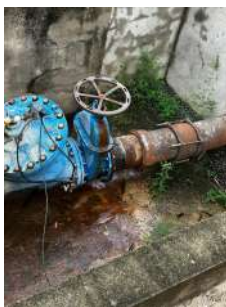
Foto 1 - Vazamento observado em um dos registros.
