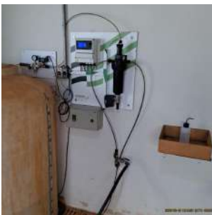
Foto 6 - Aparelho de medição de turbidez. O equipamento ainda não se encontra em operação, porém está previsto para entrar em funcionamento
