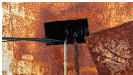
Foto 2 - Abertura observada no topo do reservatório.
