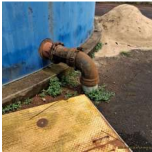
Foto 6 - Tubulação para distribuição de água.
