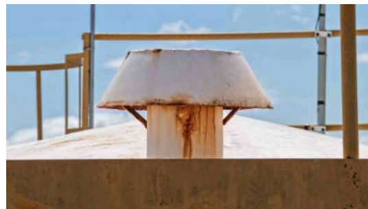
Foto 9 - Tubo de ventilação.
