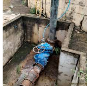
Foto 6 - Conjuntos de válvulas e registros.
