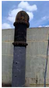
Foto 8 - Ponto de entrada de água no Reservatório 3.
