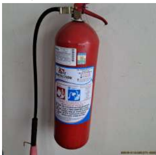
Foto 13 - Extintor de incêndio.
