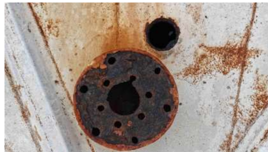
Foto 2 - Tampa que protegia o tubo de ventilação, caída ao lado da abertura.
