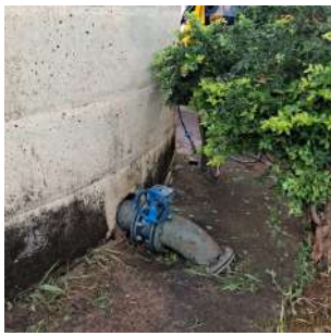
Foto 5 - Tubulação de distribuição.
