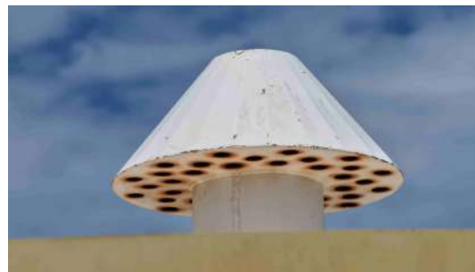
Foto 8 - Tubo de ventilação.
