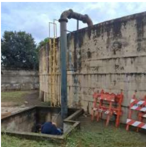
Foto 1 - Ponto de entrada de água no reservatório.
