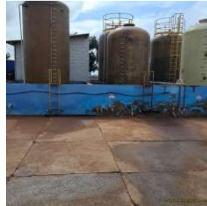
Foto 19 - Tanque de armazenamento de hipoclorito de sódio.
