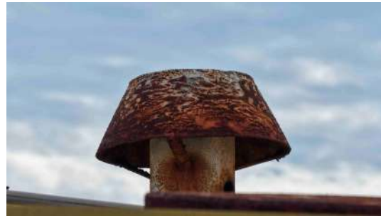
Foto 5 - Tubo de ventilação.
