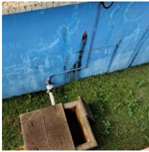
Foto 1 - Vazamento nas paredes dos decantadores da ETA.
