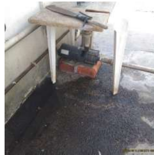
Foto 10 - Bomba para dosagem do carvão ativado
