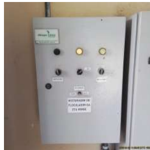
Foto 22 - Painéis elétricos para comando do Misturador do Floculador da ETA Verde
