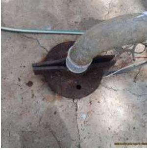
Foto 1 - Ausência de tubo de medição de nível
