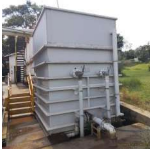
Foto 29 - Vista Lateral do filtro da ETA Branca
