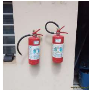
Foto 36 - Extintores de incêndio
