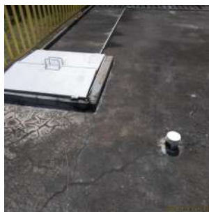
Foto 4 - Tampa de inspeção e respiro
