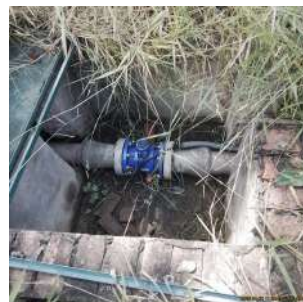
Foto 4 - Medidor de entrada de água na ETA
