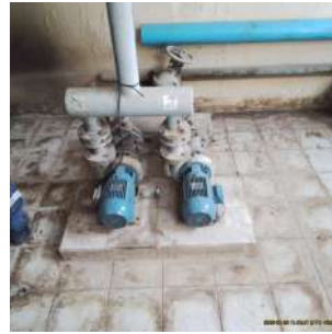
Foto 4 - Conjunto motobomba para lavagem do filtro
