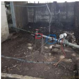
Foto 1 - Aplicação de cloro (azul) e local em que seria aplicado o flúor (vermelho)
