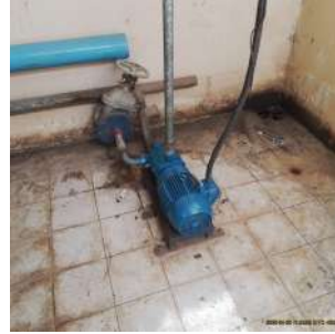
Foto 2 - Motobomba elevatória para o bairro novo Reserva Vianna
