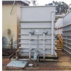
Foto 28 - Vista Lateral do filtro da ETA Verde
