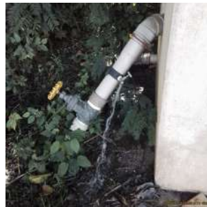
Foto 6 - Tomada de água bruta
