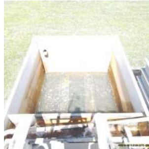
Foto 18 - Filtro da ETA Branca
