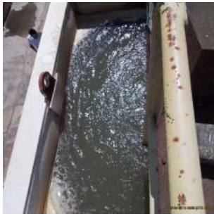
Foto 15 - Floculador da ETA Branca
