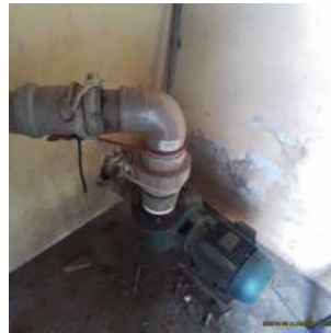
Foto 2 - Motobomba vista geral
