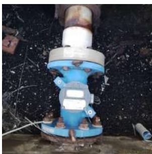
Foto 33 - Macromedidor de saída
