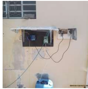
Foto 26 - Bomba dosadora de PAC da ETA Verde e Branca
