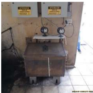
Foto 23 - Armazenamento do PAC para dosagem
