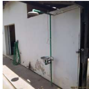
Foto 40 - Chuveiro de Emergência
