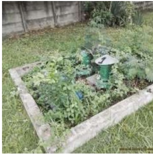
Foto 1 - Válvulas e conexões comprometidas pelo mato
