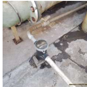
Foto 12 - Tubulação do carvão ativado
