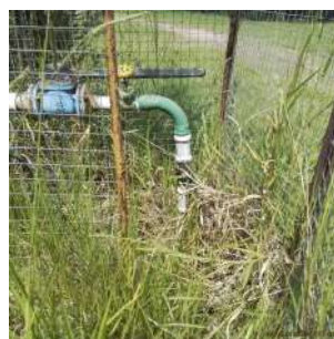
Foto 2 - Vista da tubulação de distribuição da água bruta
