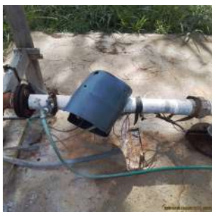
Foto 5 - Tomada de água bruta
