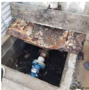
Foto 31 - Macromedidor de saída
