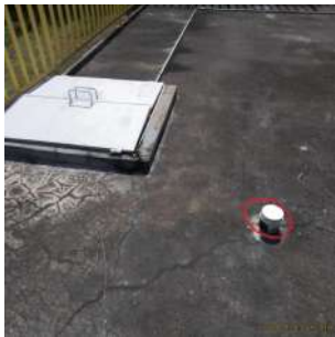
Foto 1 - Tubulação de ventilação permitindo o acesso de insetos e pequenos animais
