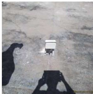
Foto 2 - Sensor de nível conectado ao Reservatório Elevado Portal dos Nobres
