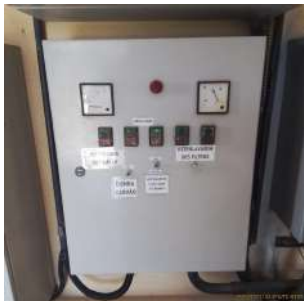
Foto 21 - Painéis elétricos para comando
