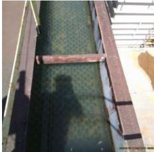
Foto 17 - Decantador da ETA Branca
