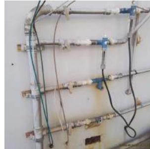
Foto 8 - Tubulação de dosagem de carvão ativado e PAC
