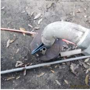
Foto 1 - Medidor de nível sem tampa
