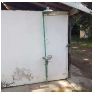
Foto 3 - Chuveiro de Emergência
