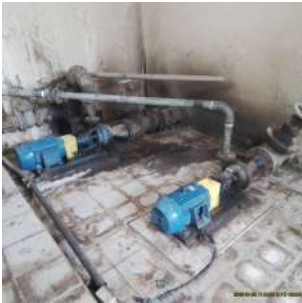
Foto 5 - Conjunto motobomba e booster para Portal dos Nobres e Reservatório Elevado (Distribuição em marcha)
