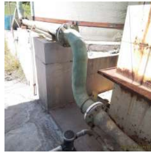
Foto 6 - Tubulação conduzindo para a ETA Verde
