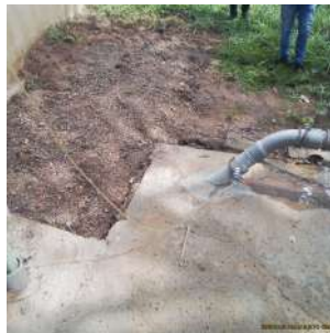
Foto 4 - Tubulação de adução
