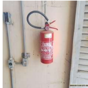
Foto 6 - Extintor de incêndio
