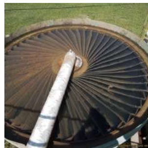
Foto 14 - Decantador lamelar da ETA Verde
