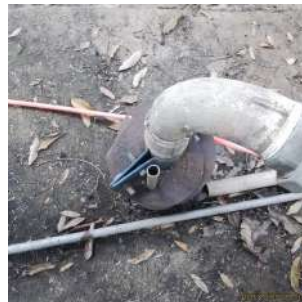
Foto 4 - Tubo de medição de nível
