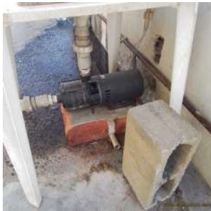
Foto 11 - Bomba para dosagem do carvão ativado
