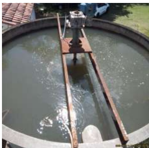
Foto 13 - Floculador da ETA Verde
