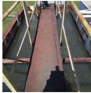
Foto 16 - Decantador da ETA Branca
