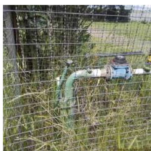
Foto 3 - Vista apontando o medidor de nível, macromedidor e tomada de água bruta
