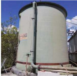
Foto 7 - Floculador da ETA Verde
